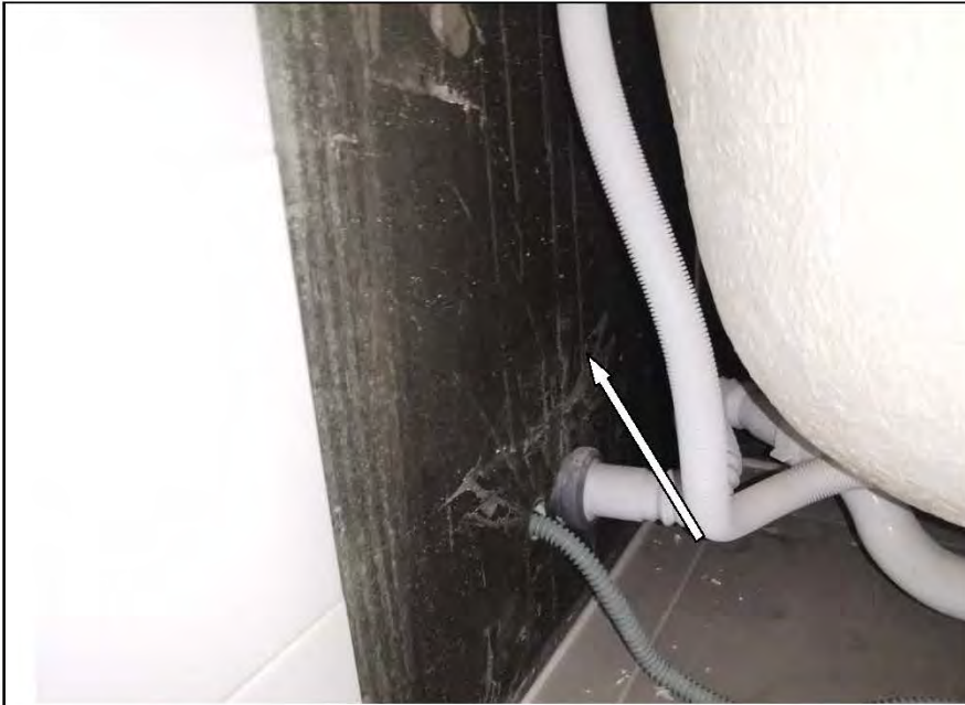
Фото №19. Частично отсутствует настенная керамическая плитка за ванной
