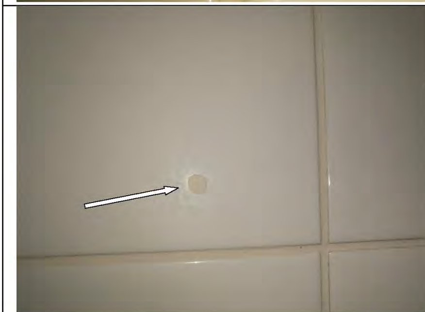
Фото №18. Нарушение целостности настенной керамической плитки в ванной комнате.
