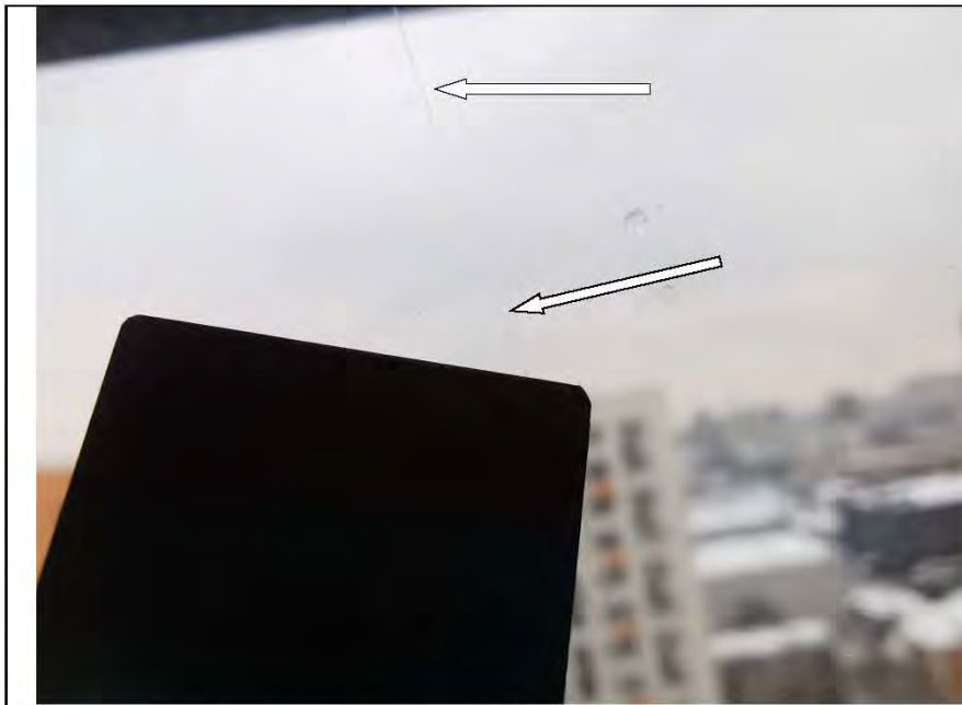
Фото №46. Царапины на стеклопакете оконного блока ПВХ на кухне.
