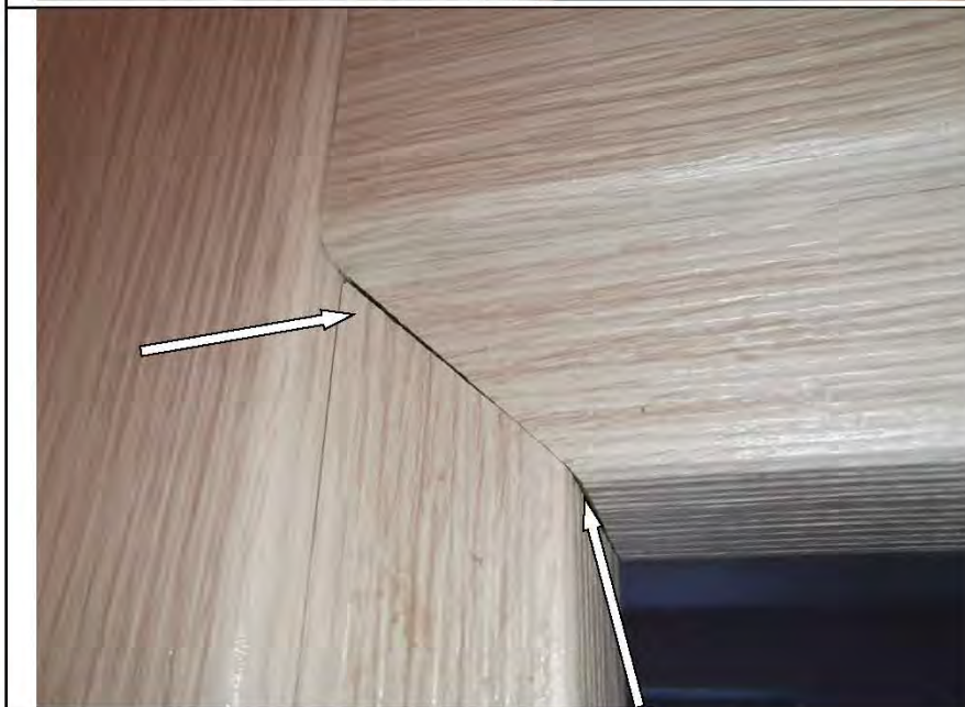
Фото №56. Ненадежное соединение элементов короба деревянного дверного блока в спальне.
