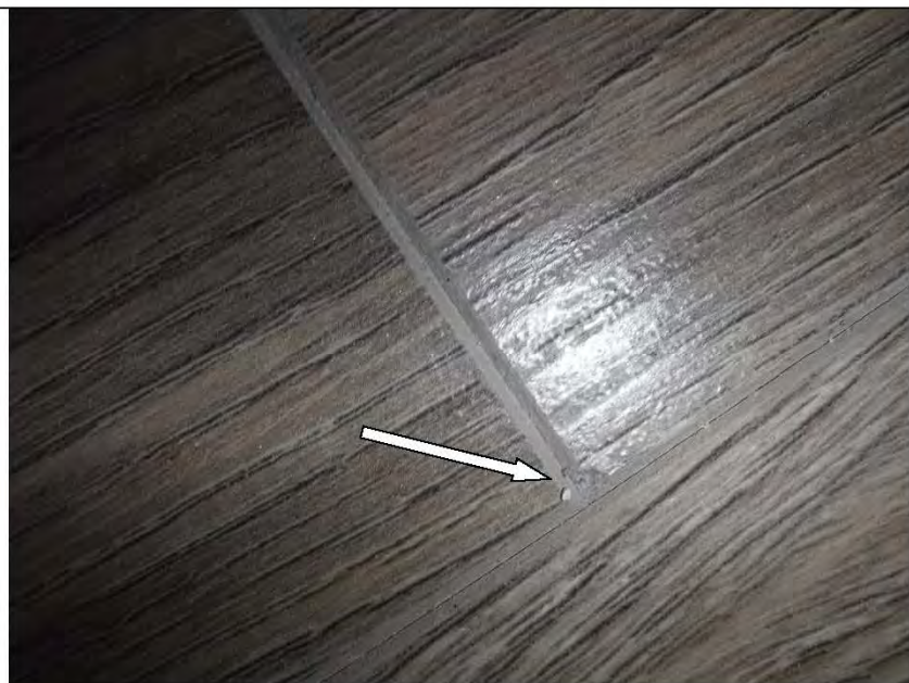
Фото №22. Скол на напольном покрытии из ламината в спальне.
