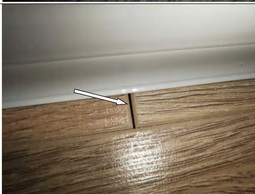
Фото №23. Зазор между соседними досками ламината в спальне.
