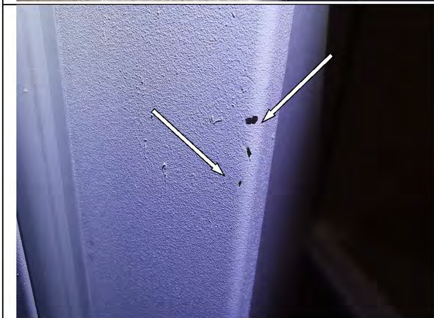
Фото №57. Потертости на коробе входного дверного блока.
