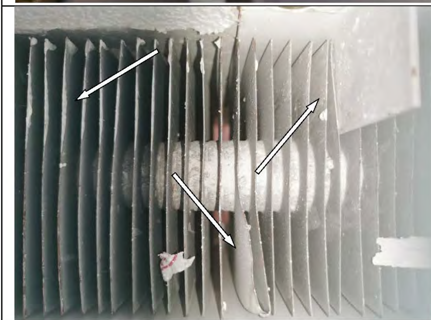
Фото №63. Радиатор в кухне имеет дефекты (загрязнение, замытие сот).
