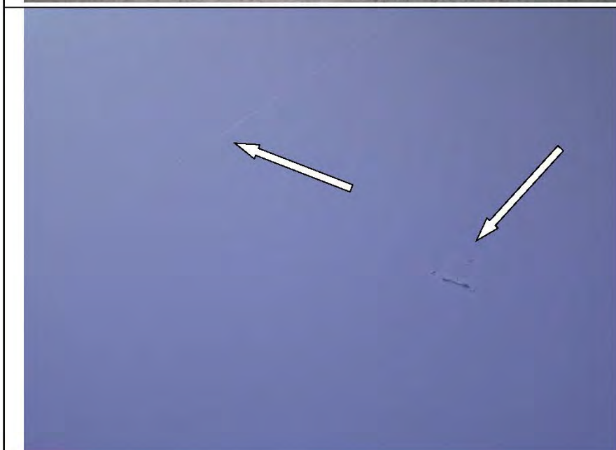
Фото №33. Загрязнение полотна натяжного потолка в коридоре.
