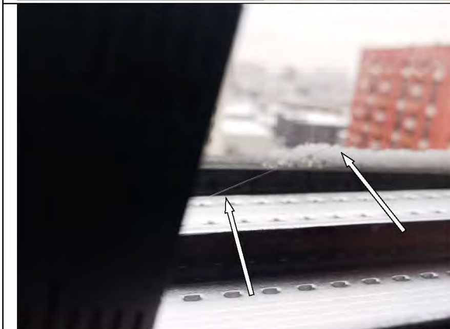
Фото №47. Царапины на стеклопакете оконного блока ПВХ в спальне.
