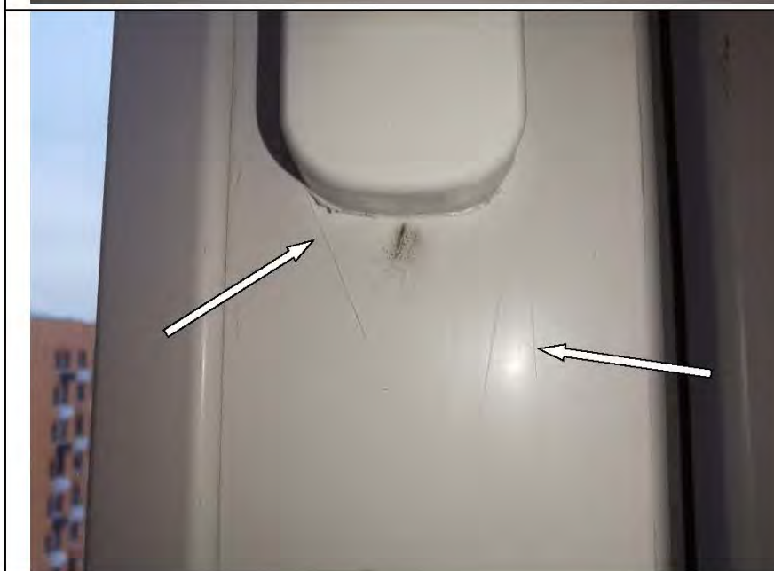
Фото №39. Царапины на профиле ПВХ оконного блока на кухне.
