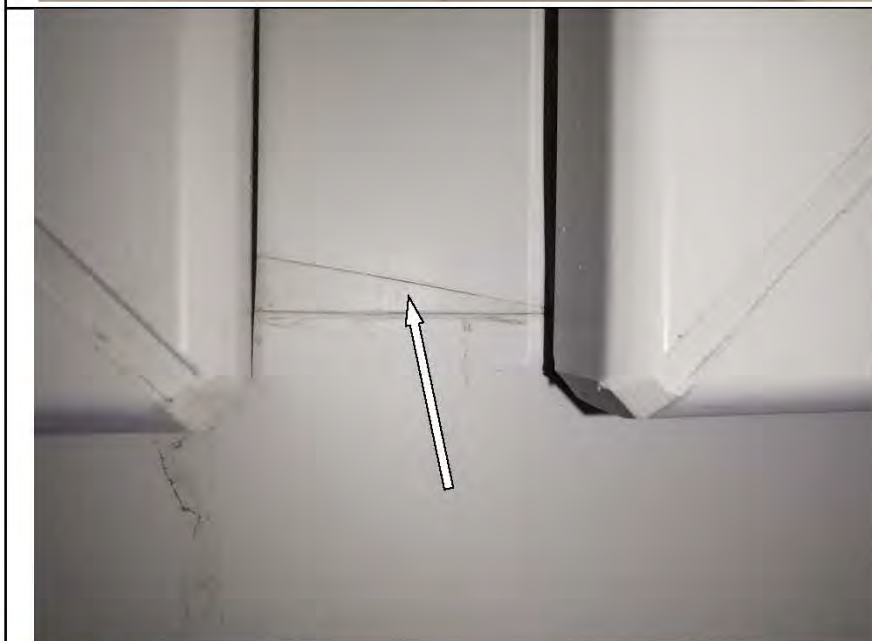
Фото №38. Царапины на профиле ПВХ оконного блока на кухне.
