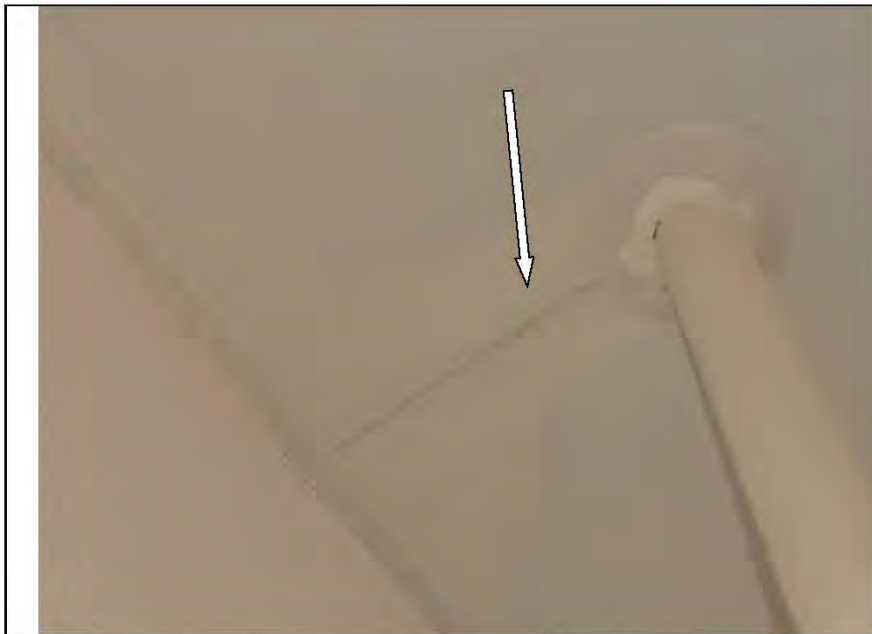
Фото №37. Отсутствие декоративных пластиковых обводов в проходе труб отопления в спальне.
