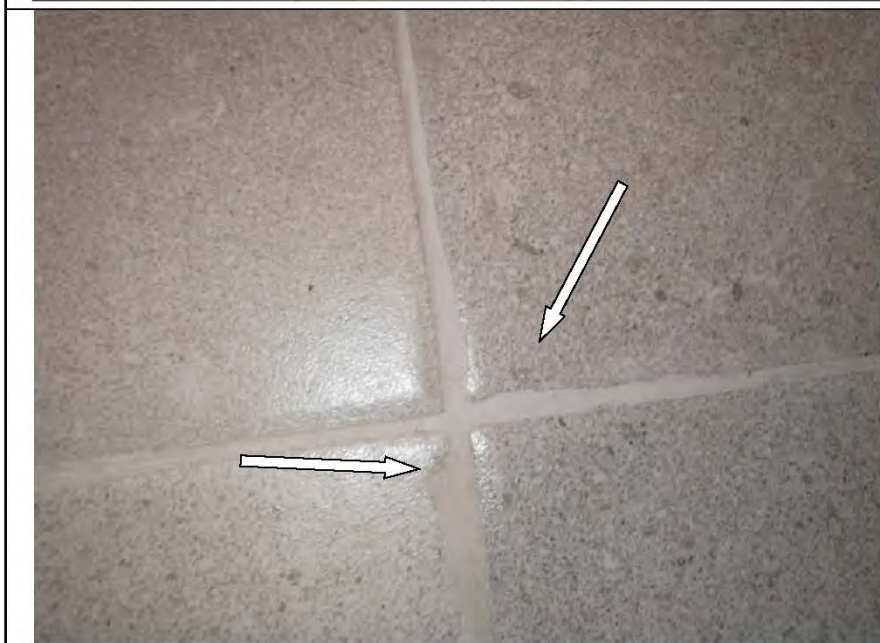
Фото №32. Некачественно выполнена затирка швов напольной керамической плитки на кухне.
