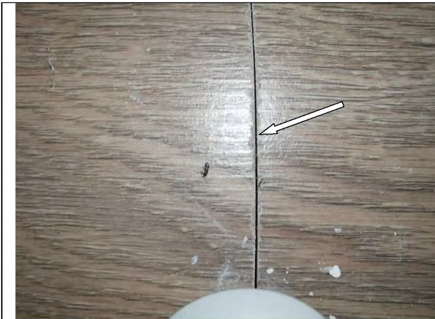
Фото №25. Зазор между соседними досками ламината в спальне.
