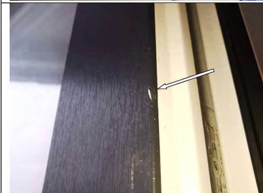
Фото №42. Потертости на профиле ПВХ оконного блока в спальне.
