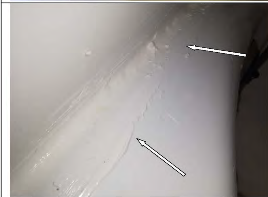
Фото №66. Ванная имеет дефекты (загрязнения).
