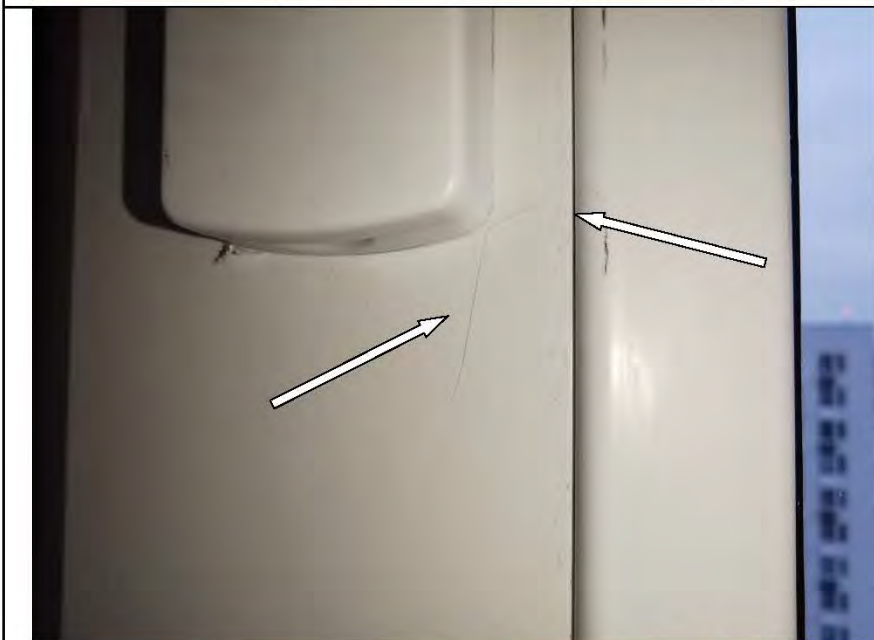
Фото №41. Царапины на профиле ПВХ оконного блока в спальне.
