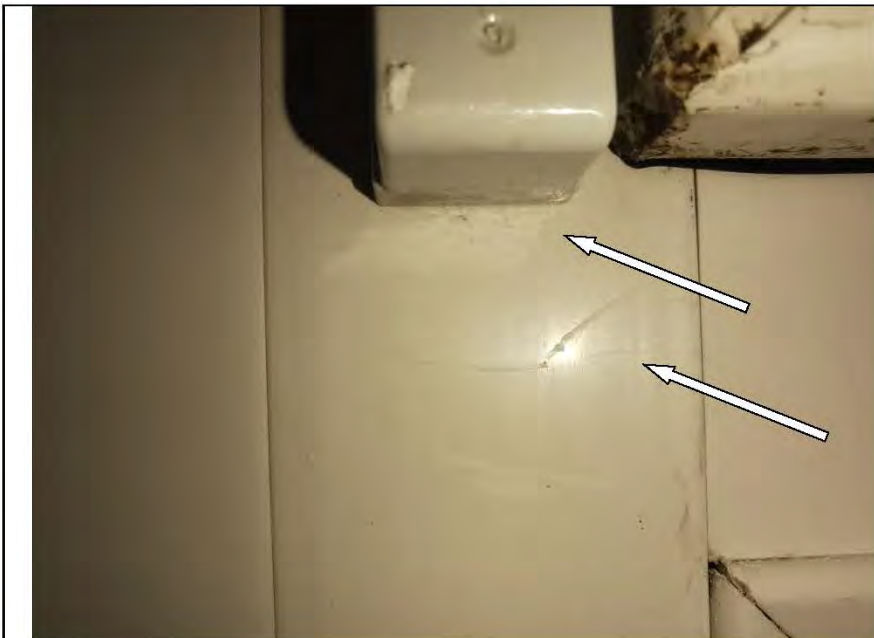
Фото №40. Царапины и загрязнения на профиле ПВХ оконного блока в спальне.
