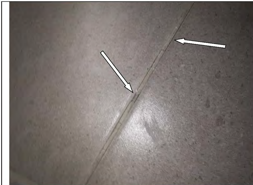
Фото №31. Некачественно выполнена затирка швов напольной керамической плитки в ванной комнате.
