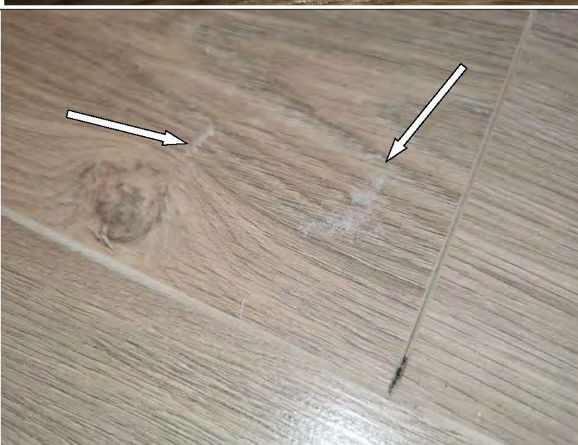
Фото №24. Загрязнение на напольном покрытии из ламината на кухне.
