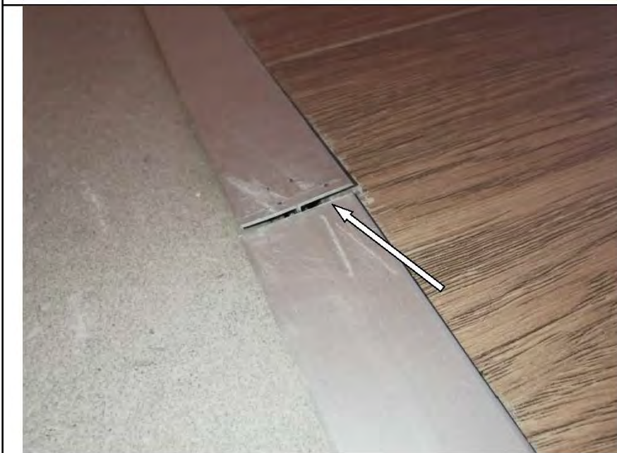
Фото №68. Металлический порог на кухне выполнен с дефектом (щель в стыке).
