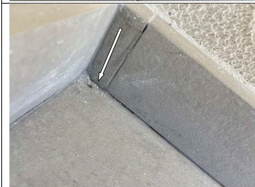
Фото №44. Неровные швы напольной керамической плитки на лоджии.
