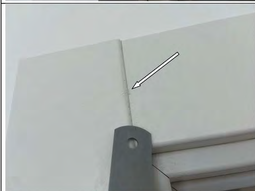
Фото №95. Загрязнения на наличниках деревянного дверного блока в кухне.
