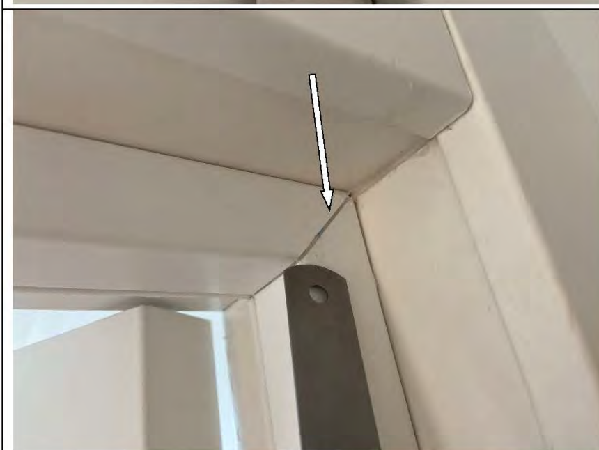
Фото №105. Загрязнения на коробке деревянного дверного блока в детской.
