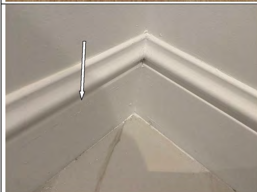
Фото №53. Дефекты на напольном плинтусе ПВХ в спальне.
