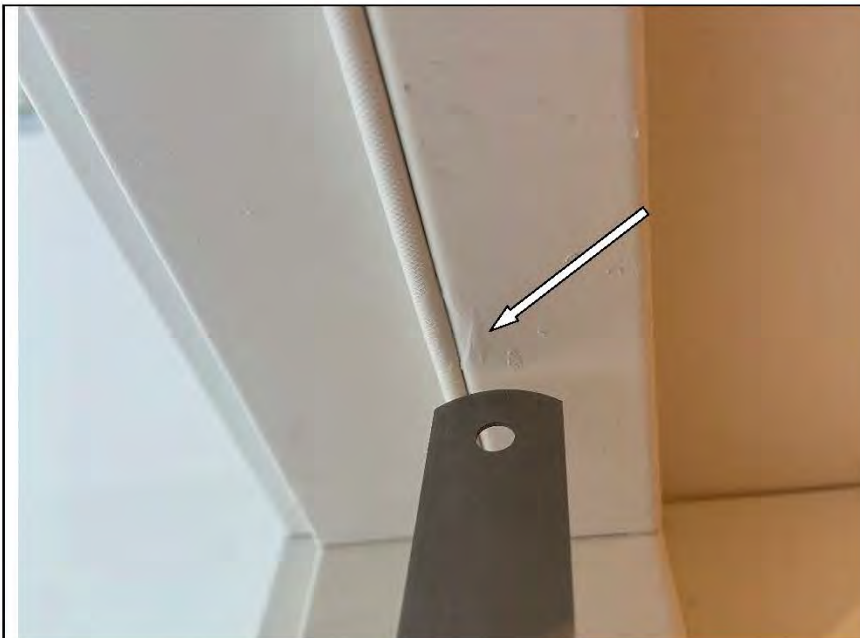
Фото №103. Загрязнения на коробке деревянного дверного блока в ванной комнате.
