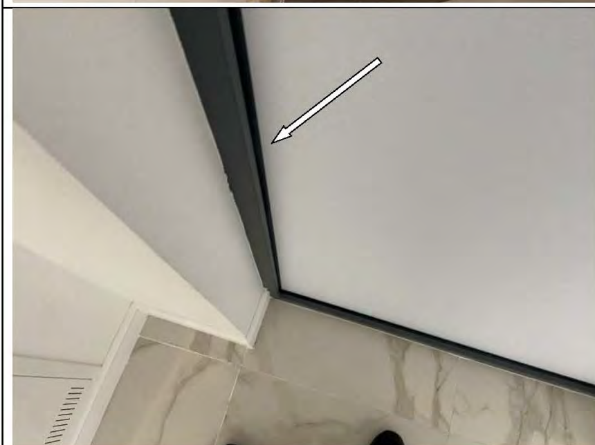
Фото №125. Отклонения по вертикали входного дверного блока в коридоре.
