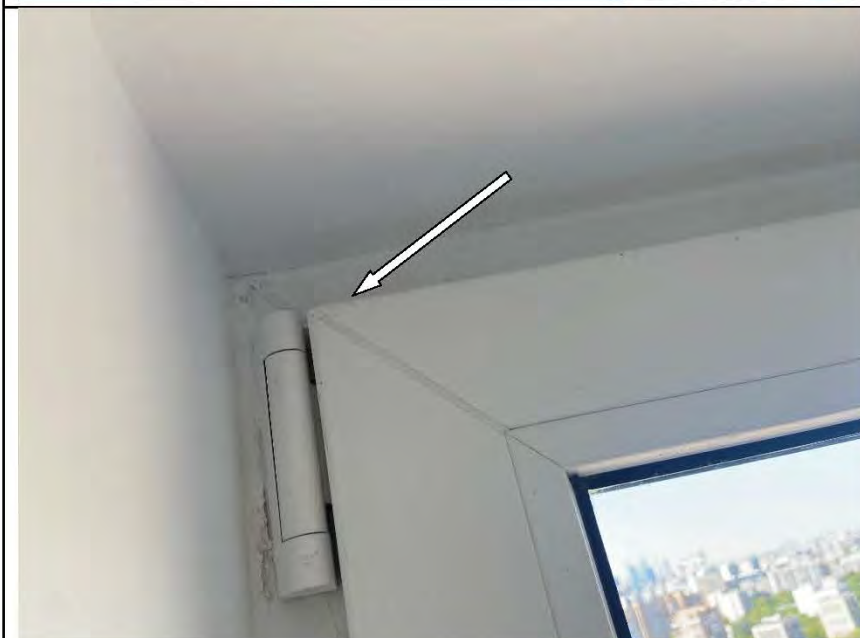
Фото №71. Загрязнения на профиле оконного блока ПВХ в детской.
