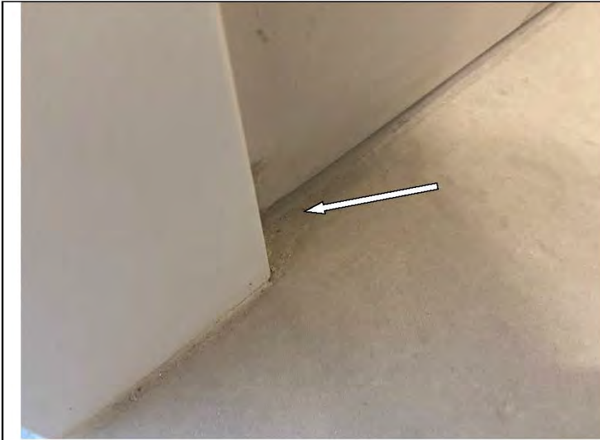
Фото №40. Загрязнения на напольной керамической плитке в ванной комнате.
