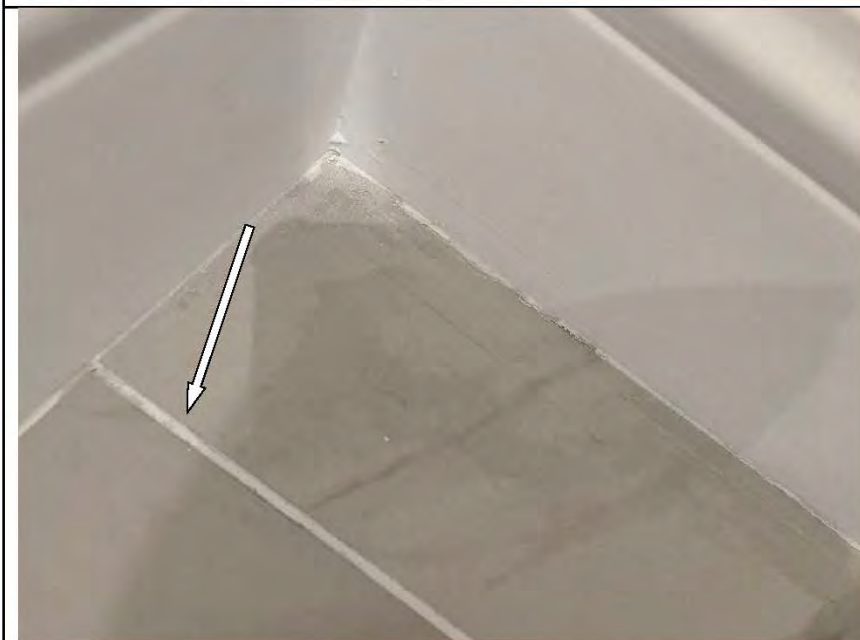
Фото №47. Неровные швы напольной керамической плитки в прачечной.
