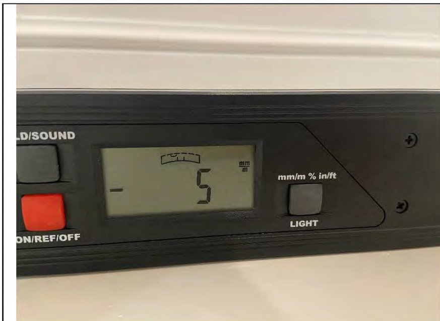
Фото №31. Отклонения напольного покрытия из керамической плитки в прачечной.
