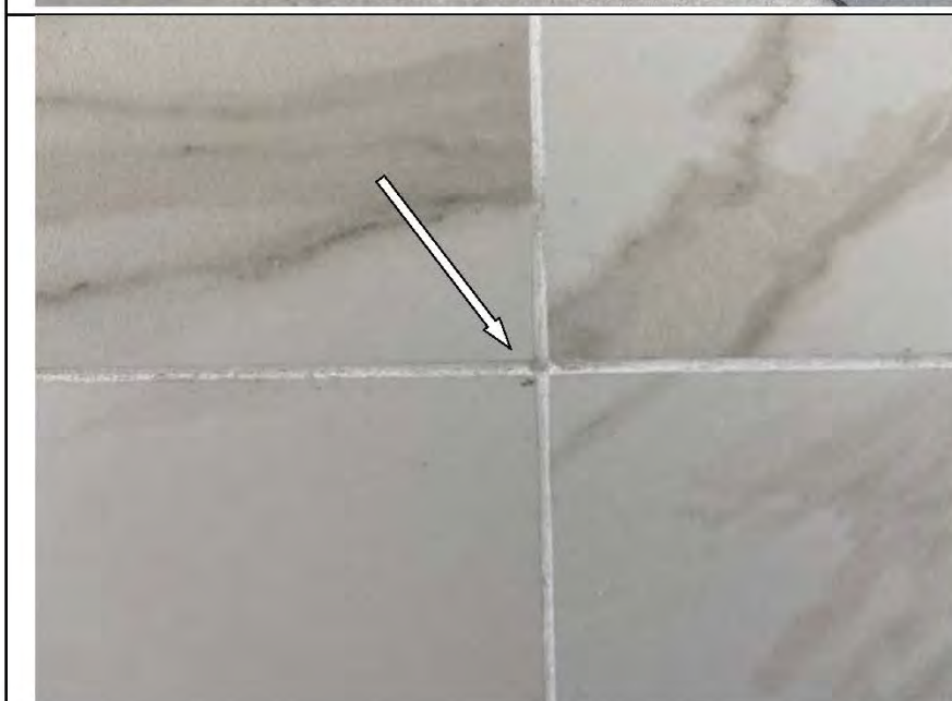
Фото №45. Неровные швы напольной керамической плитки в кухне.
