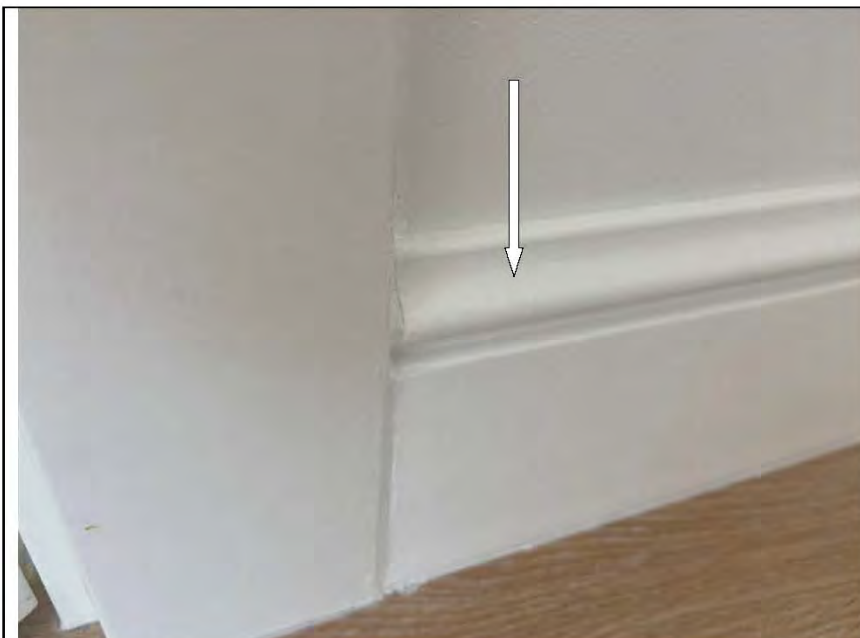
Фото №49. Дефекты на напольном плинтусе ПВХ в кабинете.
