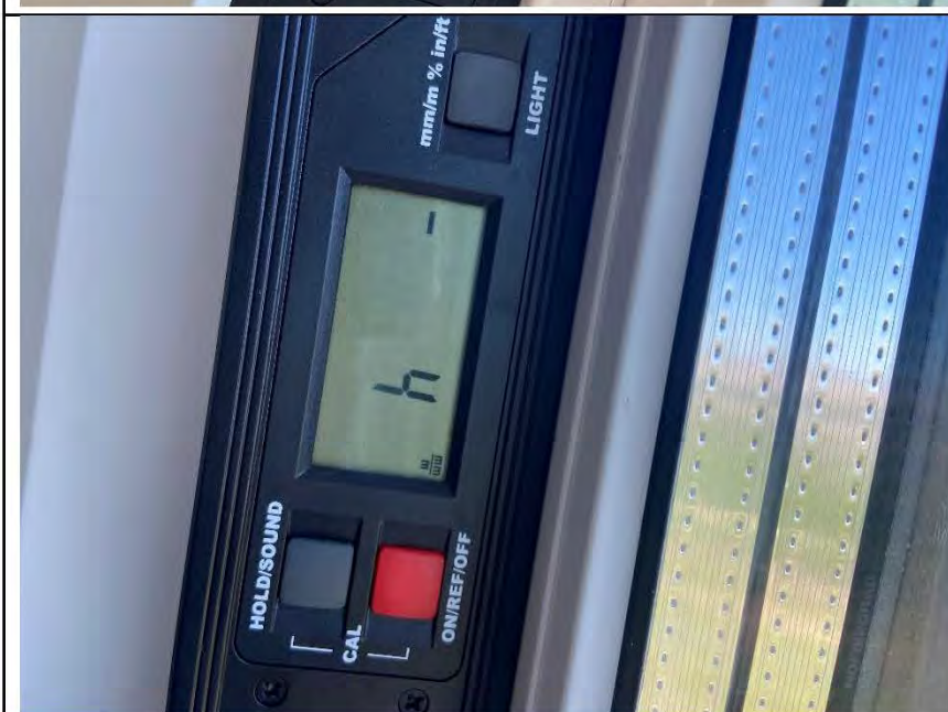
Фото №81. Отклонения по вертикали оконного блока ПВХ в детской.
