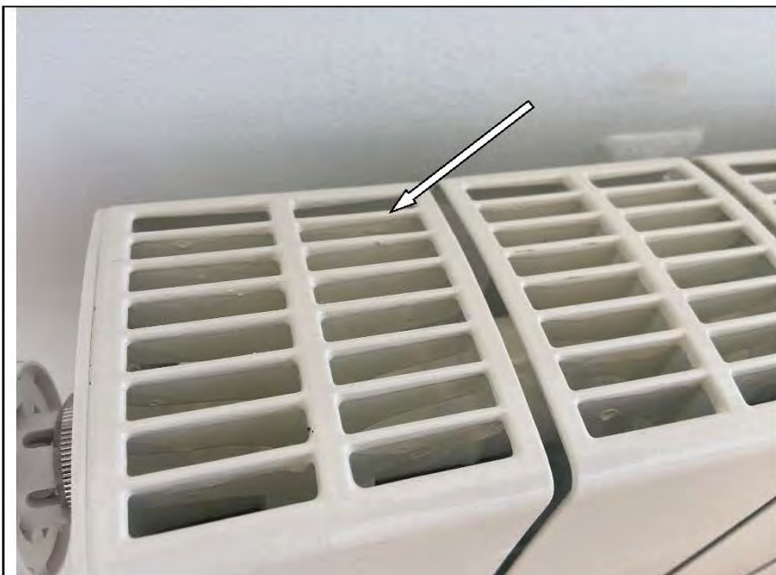
Фото №118. Загрязнения на кожухе отопительного прибора в кабинете.
