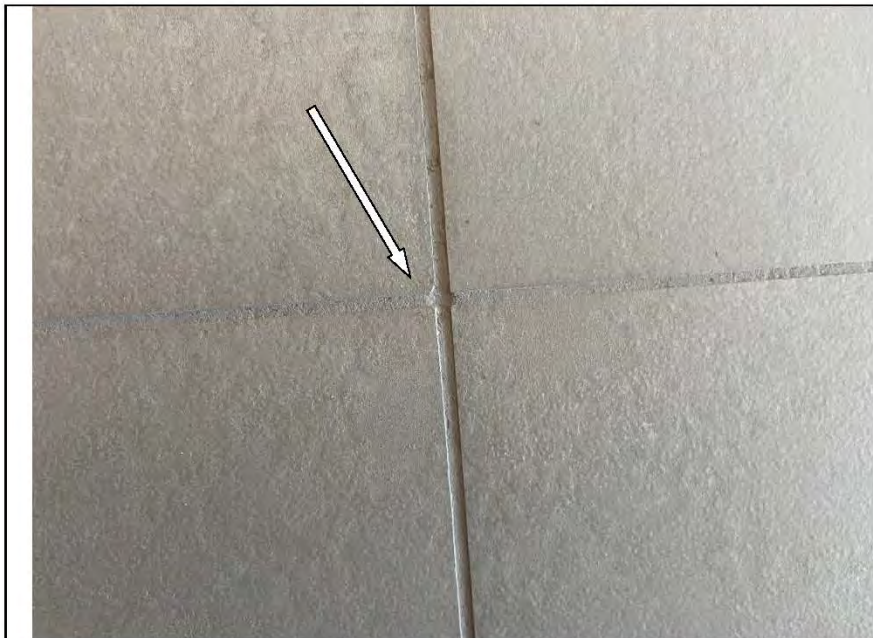
Фото №43. Неровные швы напольной керамической плитки в санузле.
