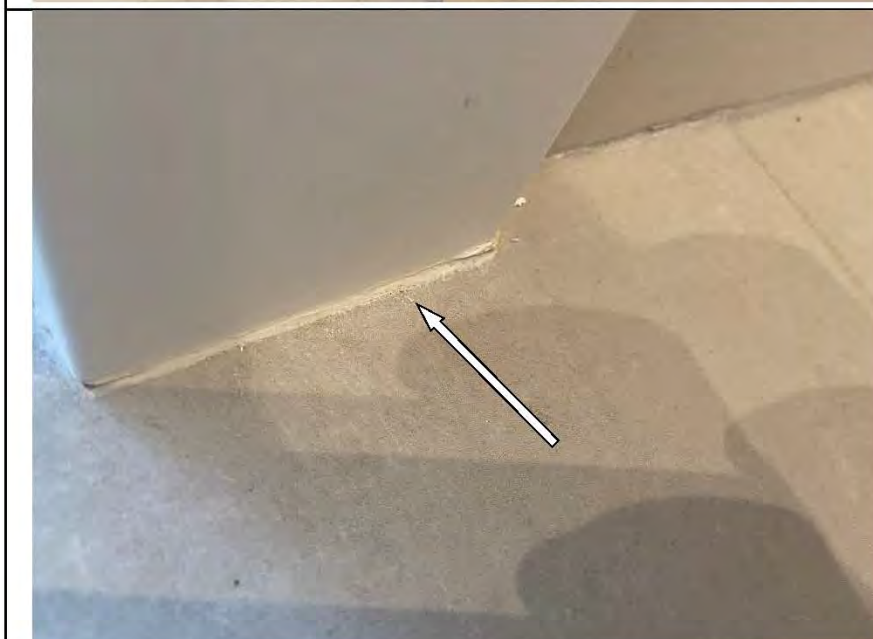
Фото №36. Загрязнения на напольной керамической плитке в санузле.
