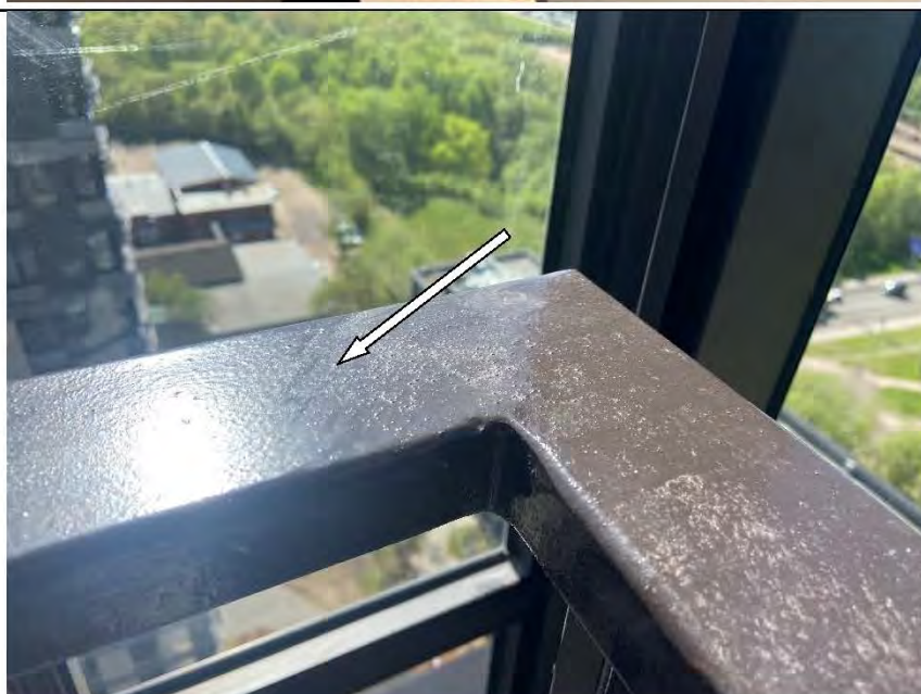
Фото №108. Дефект на металлическом ограждении на лоджии.
