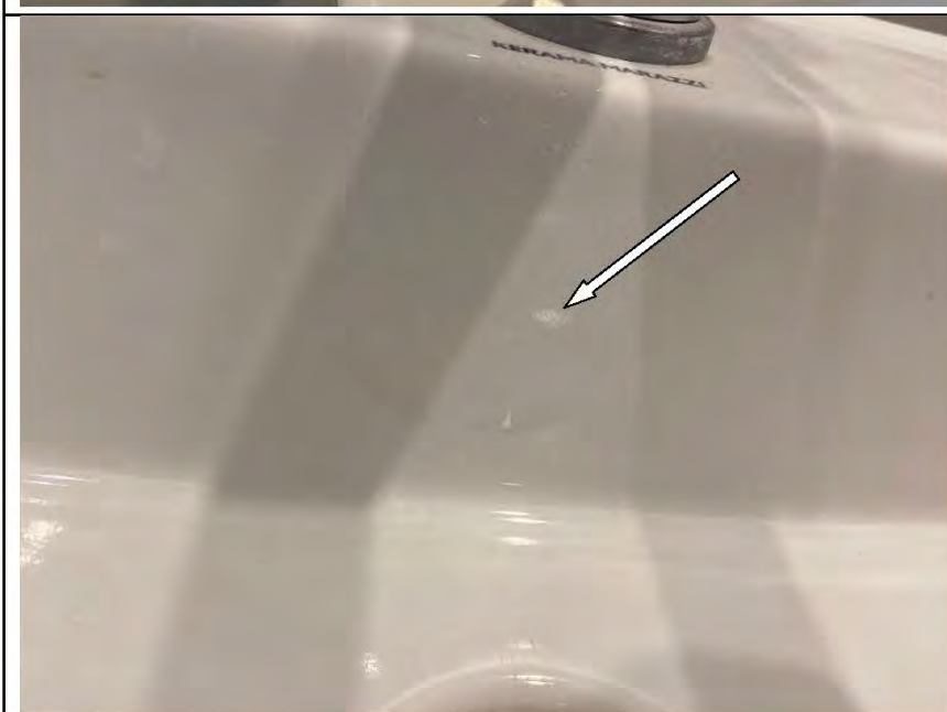
Фото №123. Загрязнения на раковине в ванной комнате.
