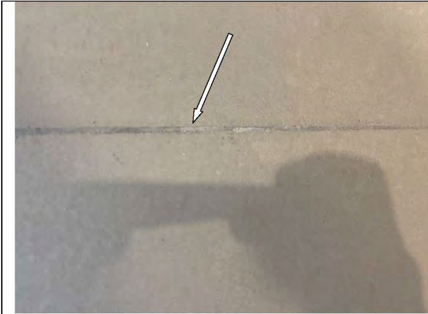
Фото №46. Неровные швы напольной керамической плитки в ванной комнате.
