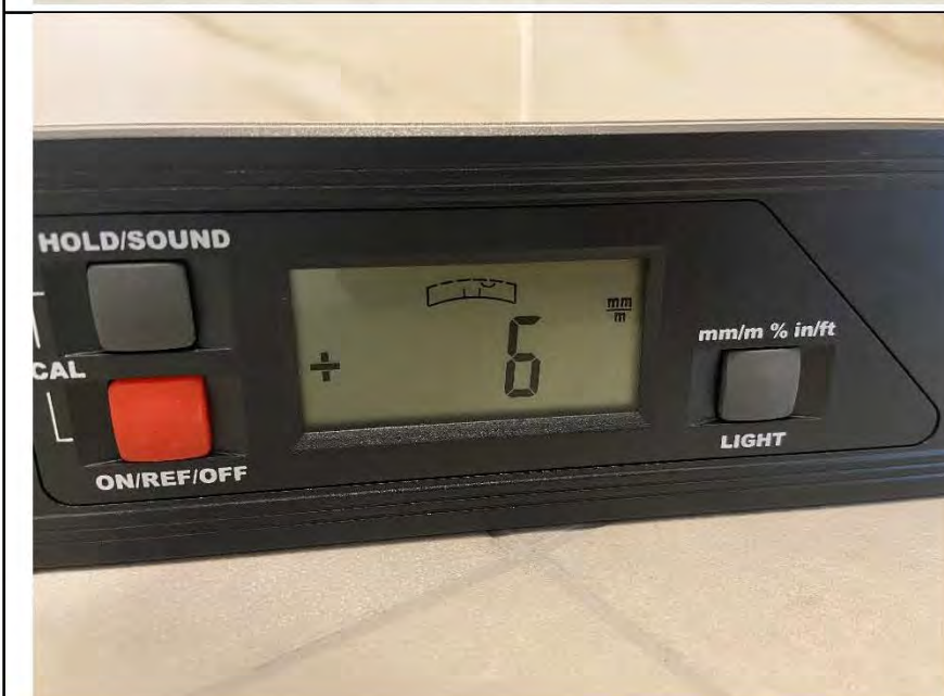
Фото №30. Отклонения напольного покрытия из керамической плитки в ванной комнате.
