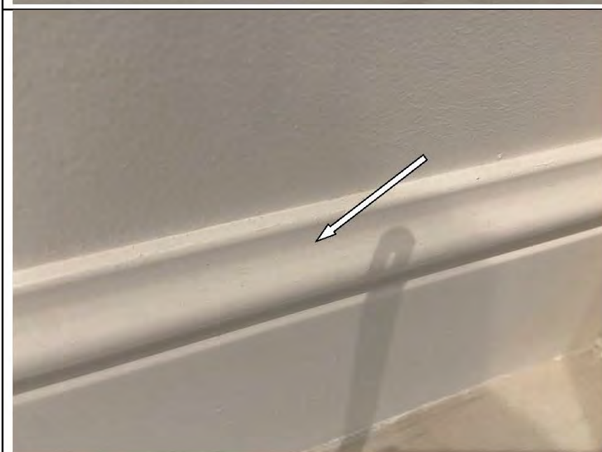
Фото №51. Дефекты на напольном плинтусе ПВХ в прачечной.
