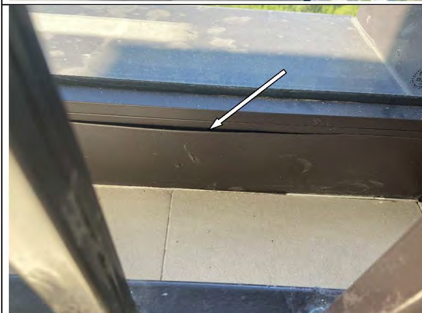
Фото №72. Дефект на алюминиевом профиле оконного блока на лоджии.
