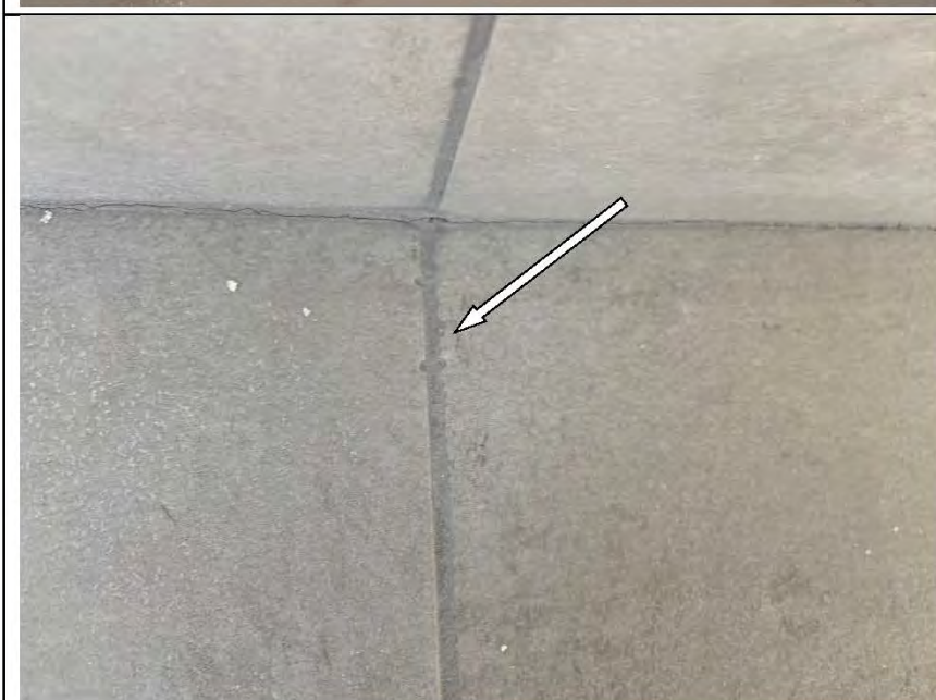
Фото №54. Скол на напольной керамической плитке на лоджии.
