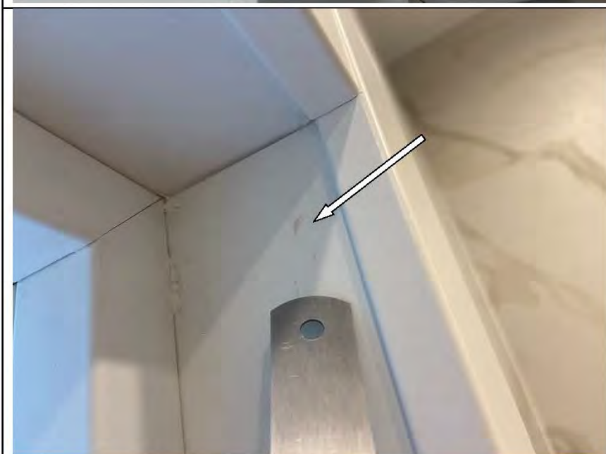
Фото №96. Загрязнения на наличниках деревянного дверного блока в ванной комнате
