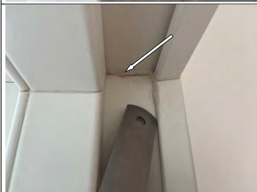
Фото №102. Загрязнения на коробке деревянного дверного блока в кухне.
