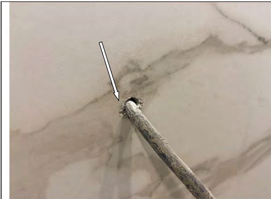
Фото №25. Скол на настенной керамической плитке в ванной комнате.
