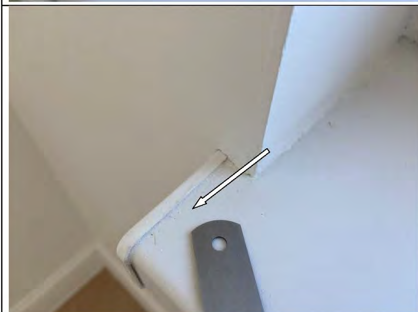
Фото №62. Царапина на лицевой стороне подоконной доски в детской.
