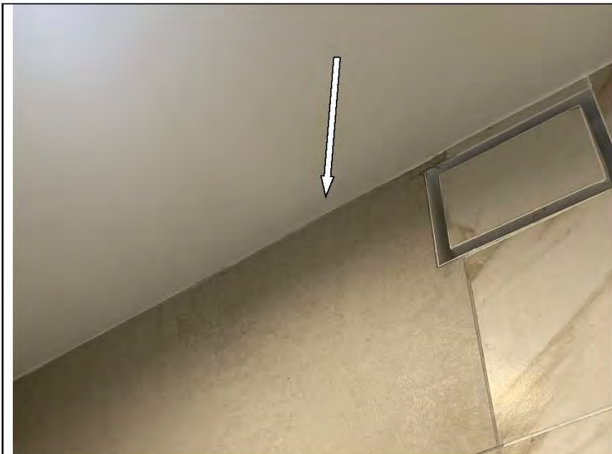
Фото №112. Неровности, подтеки, выбоины на окрашенном потолке в кабинете.
