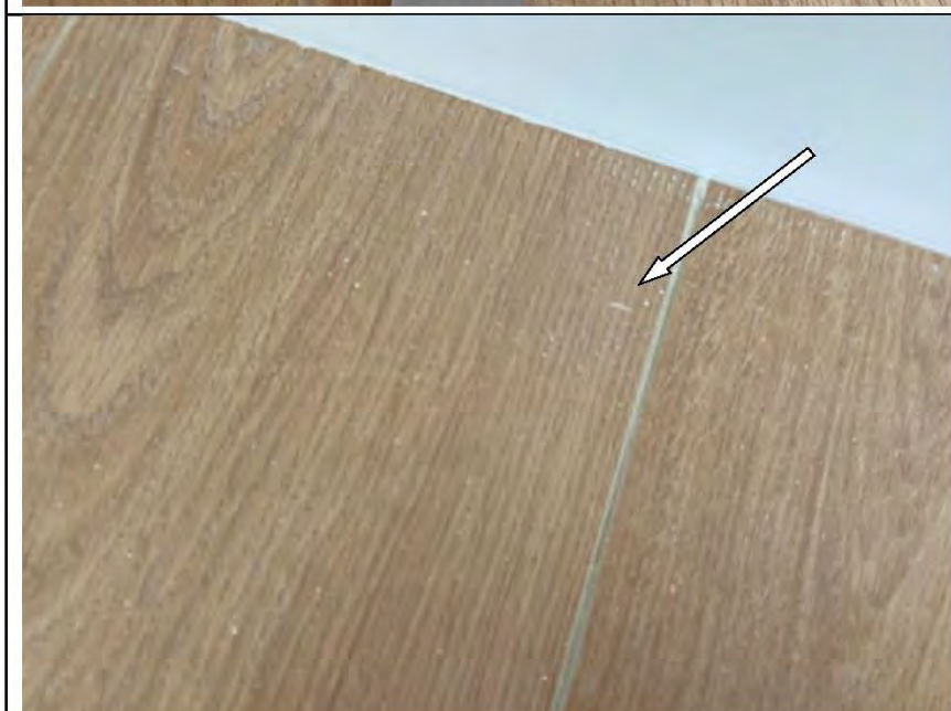
Фото №56. Загрязнения на напольном покрытии из ламината в кабинете.
