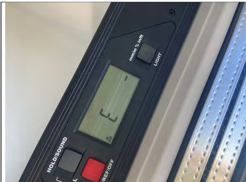
Фото №82. Отклонения по вертикали оконного блока ПВХ в кухне.
