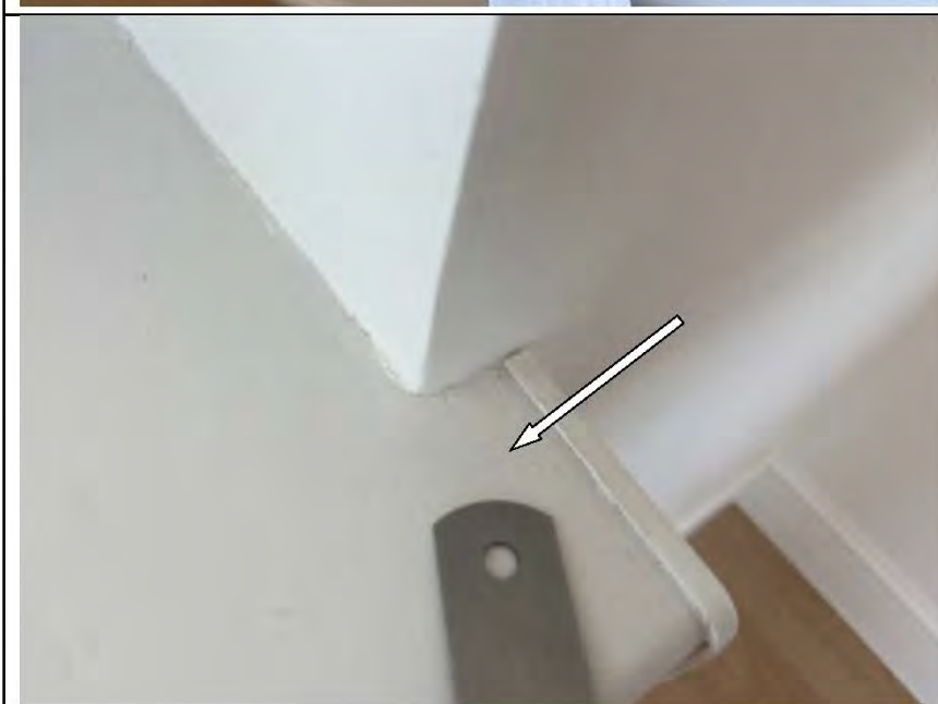
Фото №60. Царапина на лицевой стороне подоконной доски в кабинете.
