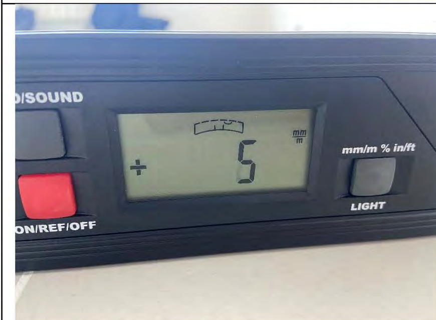
Фото №29. Отклонения напольного покрытия из керамической плитки в кухне.
