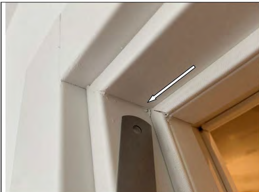
Фото №100. Загрязнения на коробке деревянного дверного блока в санузле.
