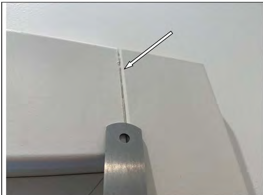
Фото №97. Загрязнения на наличниках деревянного дверного блока в прачечной.
