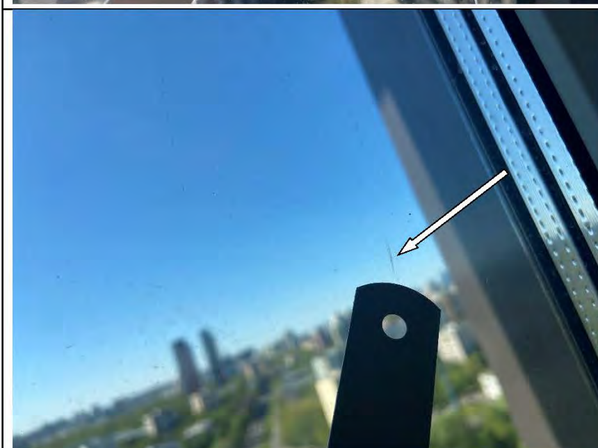
Фото №77. Царапина на стеклопакете оконного блока ПВХ в кухне.
