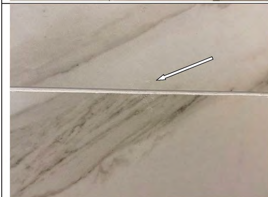
Фото №20. Загрязнения на настенной керамической плитке в ванной комнате.
