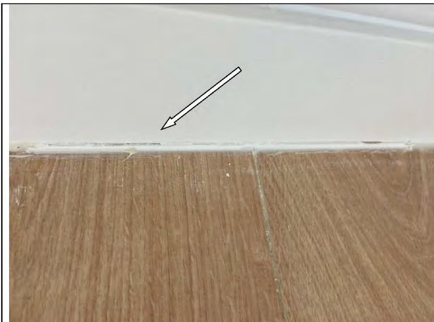
Фото №52. Дефекты на напольном плинтусе ПВХ в детской.
