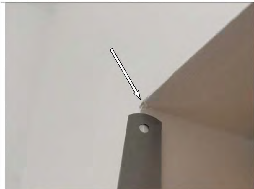
Фото №106. Неровности, сколы, выбоины на окрашенных откосах входного дверного блока в коридоре.
