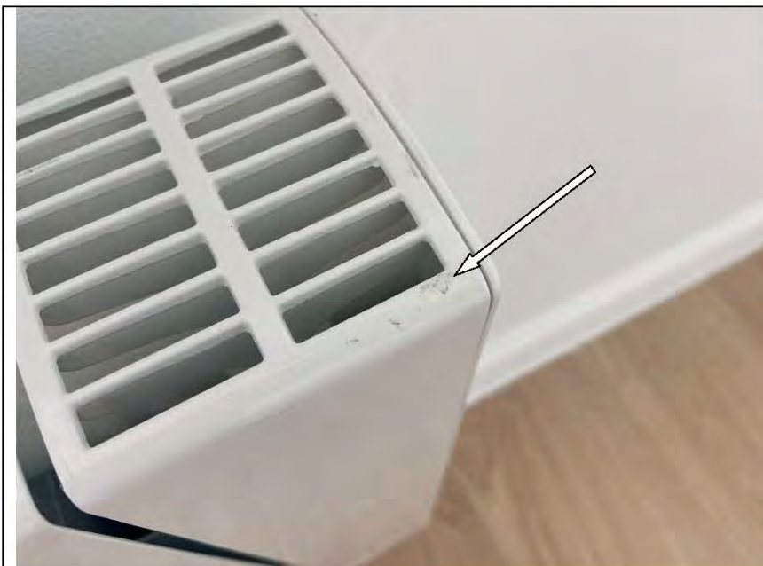
Фото №121. Загрязнения на кожухе отопительного прибора в детской.
