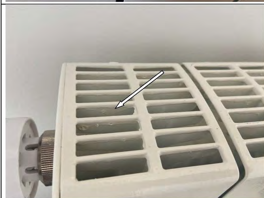
Фото №120. Загрязнения на кожухе отопительного прибора в кухне.
