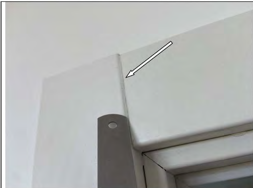
Фото №94. Загрязнения на наличниках деревянного дверного блока в кабинете.
