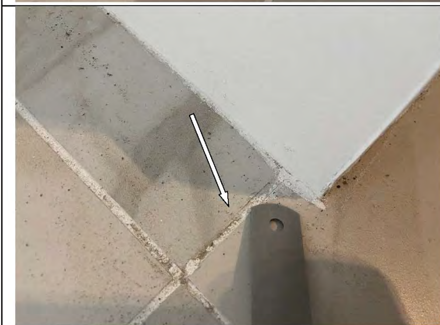
Фото №42. Неровные швы напольной керамической плитки в коридоре.
