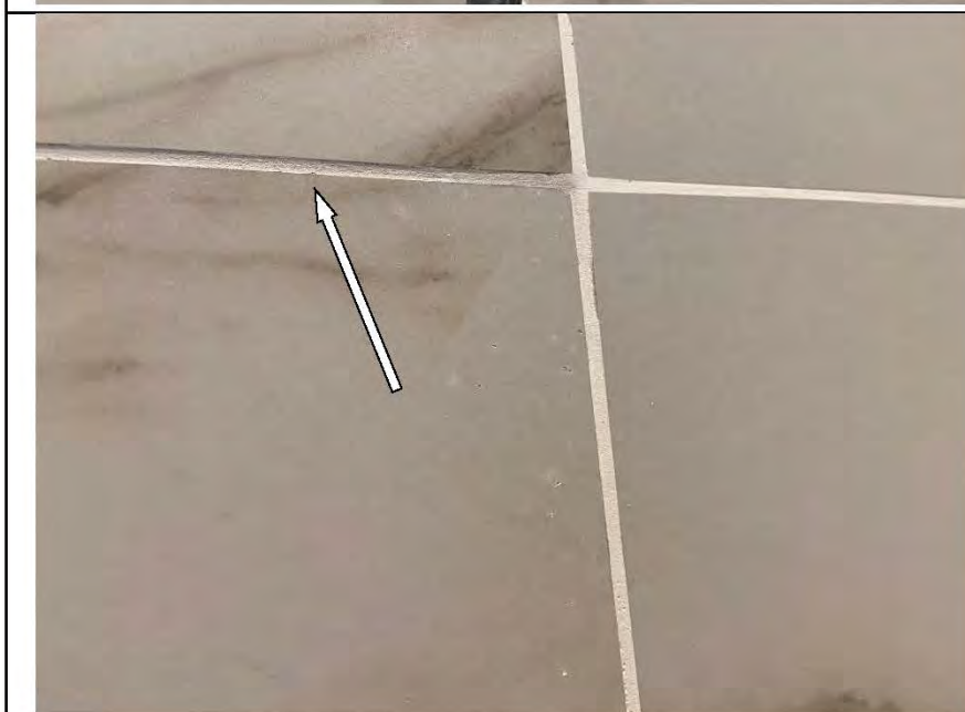
Фото №24. Скол на настенной керамической плитке в санузле.
