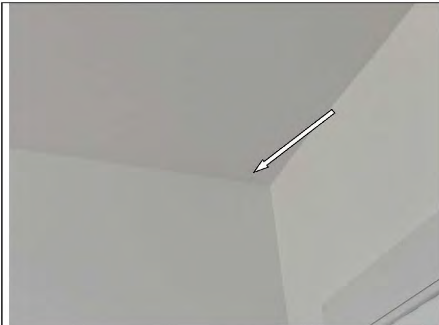
Фото №115. Неровности, подтеки, выбоины на окрашенном потолке в кухне.
