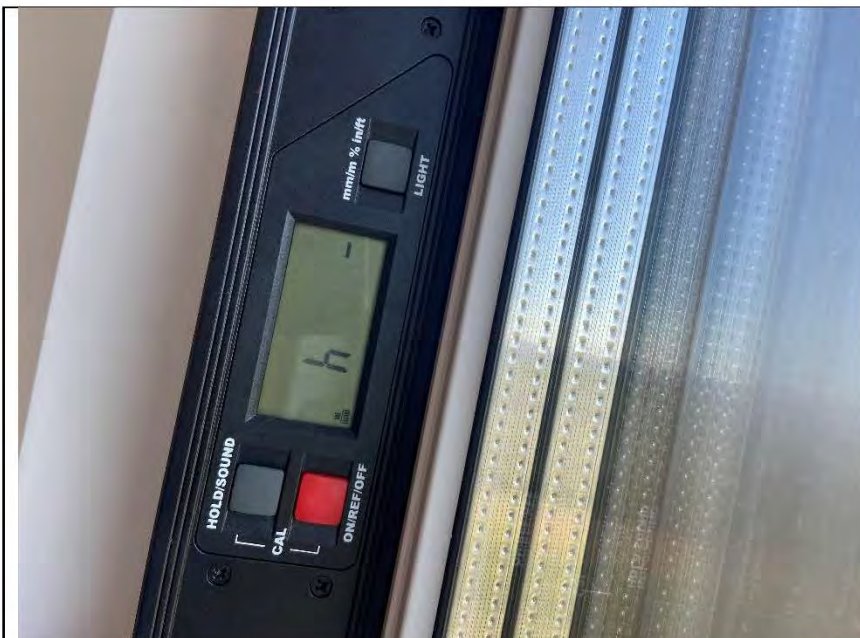
Фото №79. Отклонения по вертикали оконного блока ПВХ в спальне.
