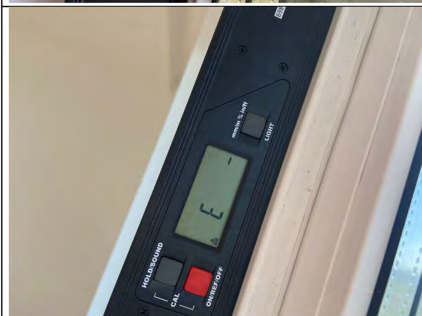
Фото №80. Отклонения по вертикали оконного блока ПВХ в кабинете.
