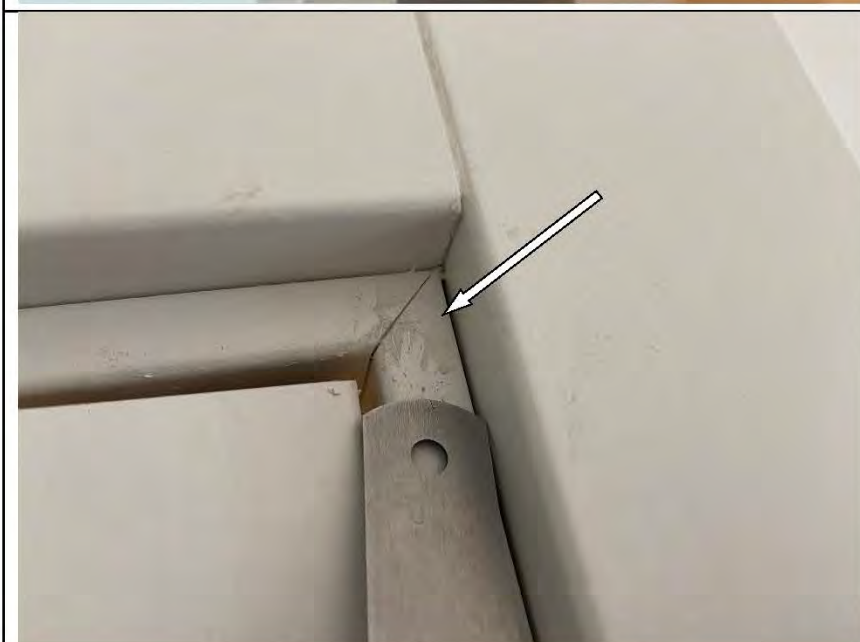
Фото №104. Загрязнения на коробке деревянного дверного блока в прачечной.
