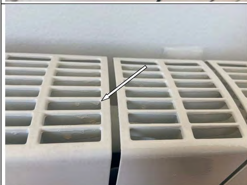
Фото №119. Загрязнения на кожухе отопительного прибора в кабинете.
