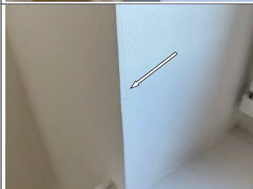
Фото №63. Неровности, подтеки, выбоины на окрашенных откосах оконного блока ПВХ в спальне.
