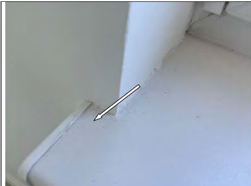
Фото №61. Царапина на лицевой стороне подоконной доски в кухне.
