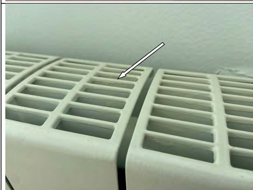
Фото №117. Загрязнения на кожухе отопительного прибора в спальне.
