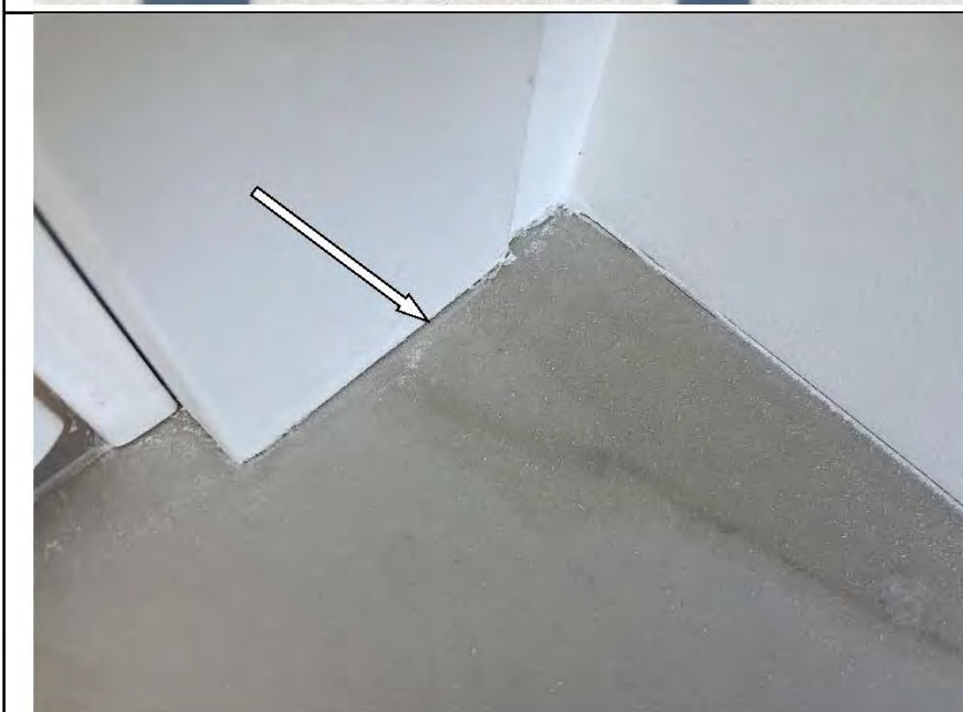
Фото №39. Загрязнения на напольной керамической плитке в кухне.
