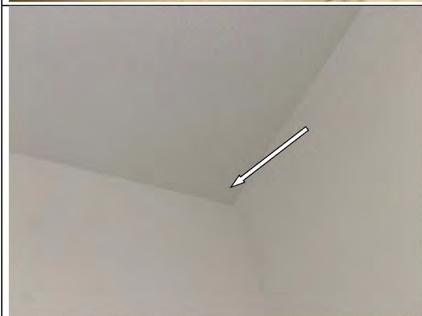
Фото №113. Неровности, подтеки, выбоины на окрашенном потолке на лоджии.
