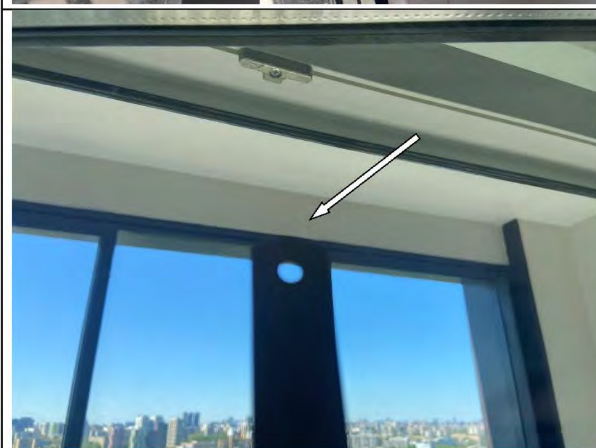
Фото №75. Царапина на стеклопакете оконного блока ПВХ в кабинете.
