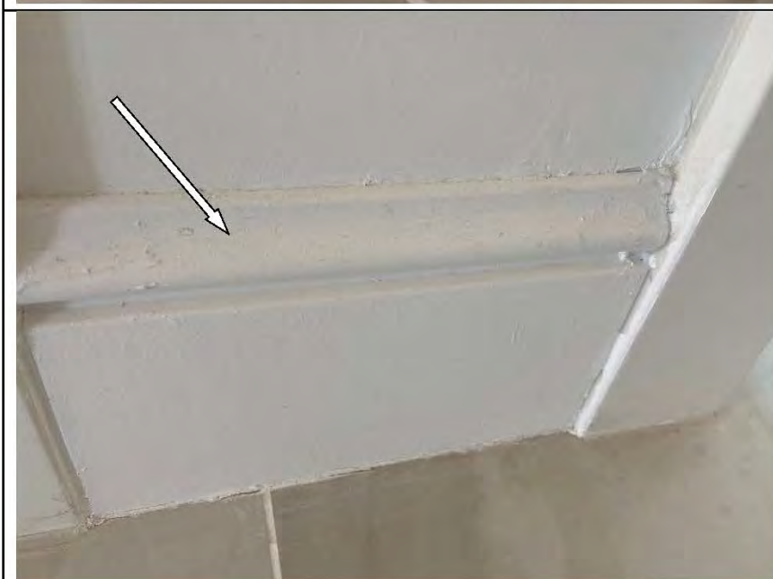
Фото №48. Дефекты на напольном плинтусе ПВХ в коридоре.
