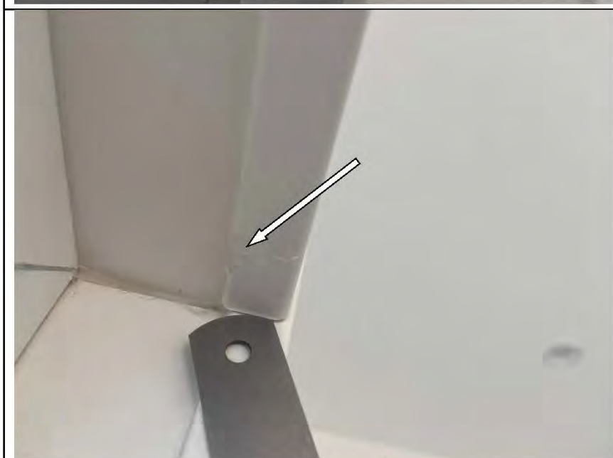
Фото №98. Загрязнения на наличниках деревянного дверного блока в детской.
