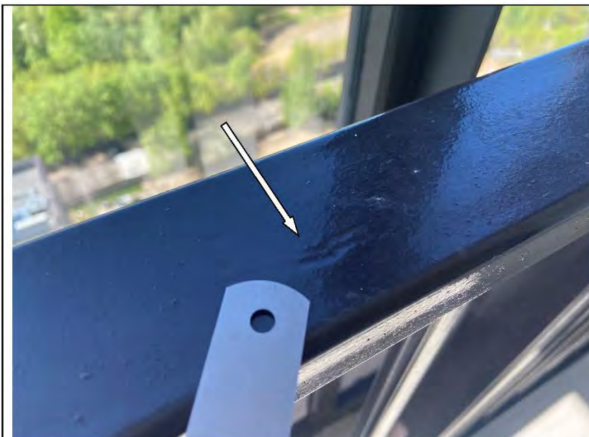
Фото №109. Дефект на металлическом ограждении на лоджии.
