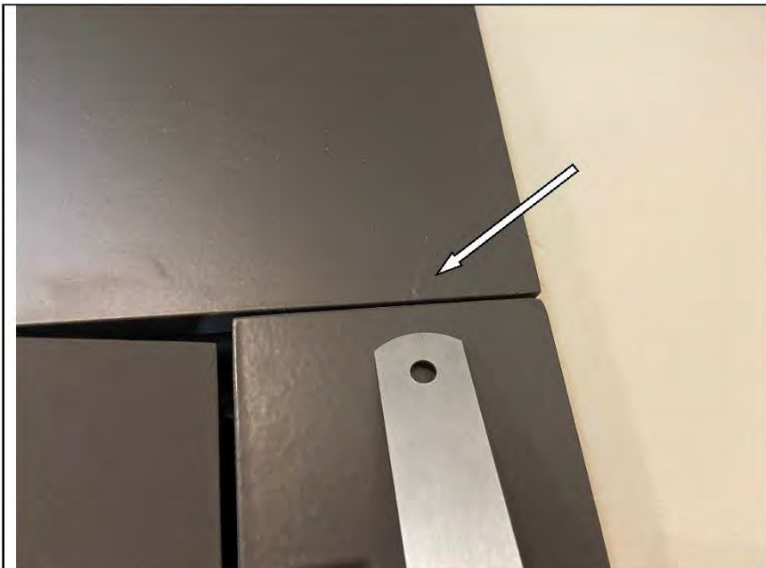
Фото №91. Загиб на наличниках входного дверного блока в коридоре.
