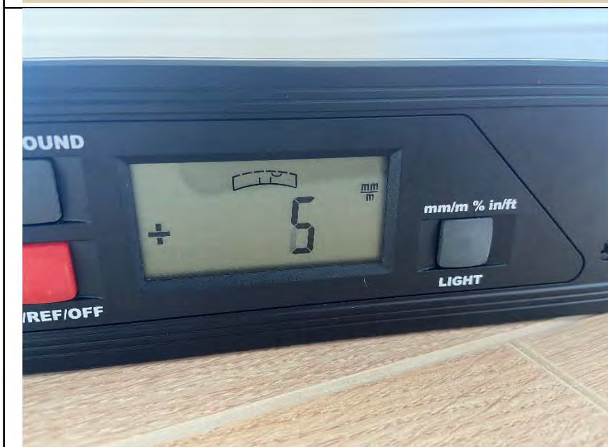
Фото №32. Отклонения напольного покрытия из ламината в спальне.
