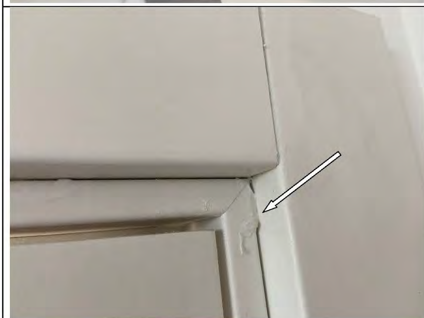
Фото №99. Загрязнения на коробке деревянного дверного блока в спальне.
