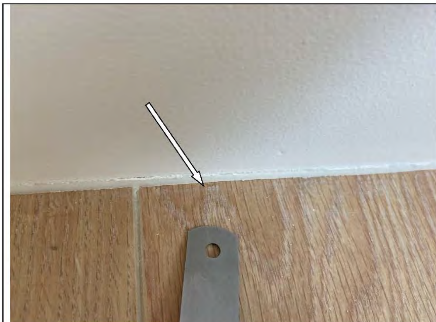
Фото №55. Загрязнения на напольном покрытии из ламината в спальне.
