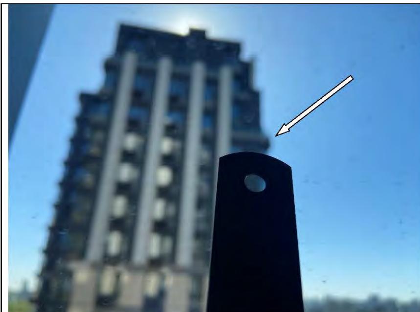
Фото №73. Царапина на стеклопакете оконного блока ПВХ в спальне.
