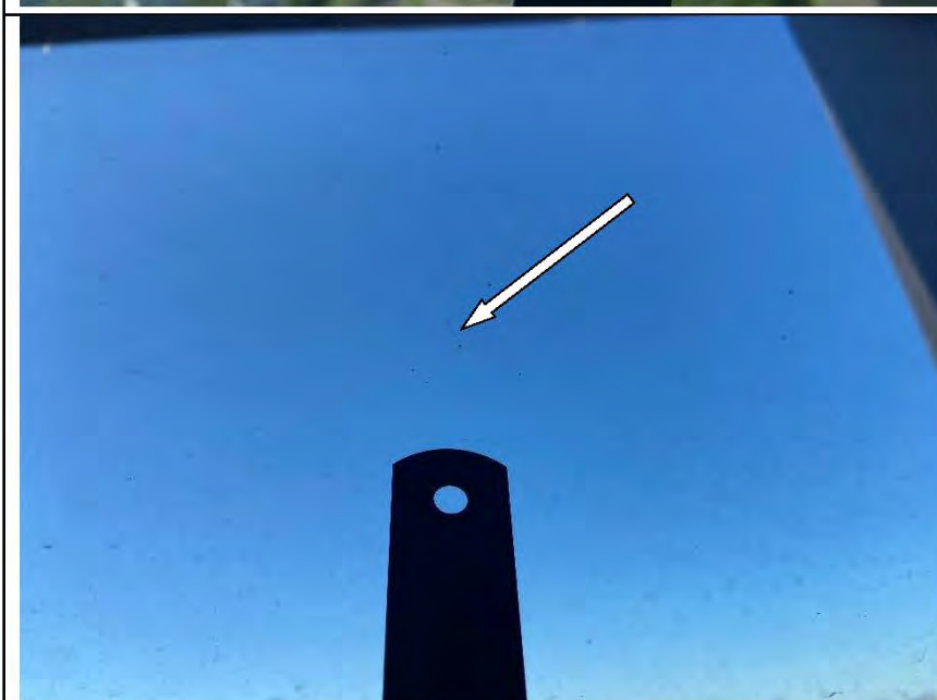
Фото №78. Окарины на стеклопакете оконного блока ПВХ в детской.
