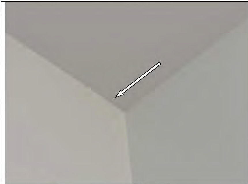
Фото №127. Неровности, подтеки, выбоины на окрашенном потолке в детской.
