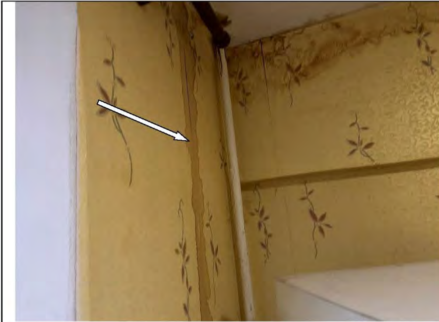
Фото №19. Следы залития на стенах, оклеенных обоями, в кухне.
