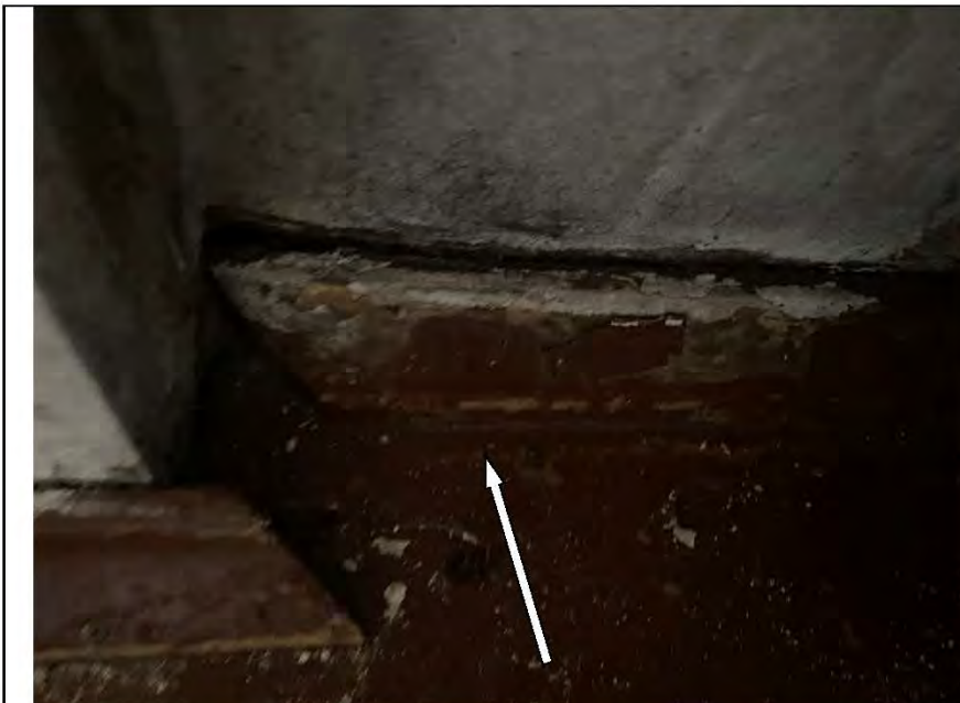
Фото №76. Поднятые кромки ДВП, следы залития в спальне.
