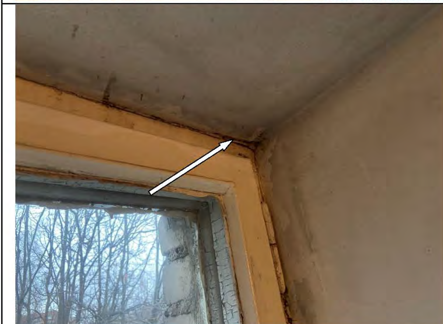
Фото №23. Следы залития на поверхности окрашенных откосов оконного блока в спальне.
