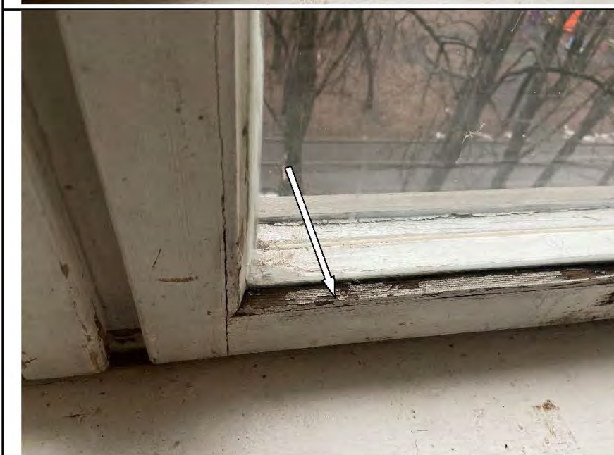
Фото №48. Следы заливки на деревянном профиле оконного блока в кухне.
