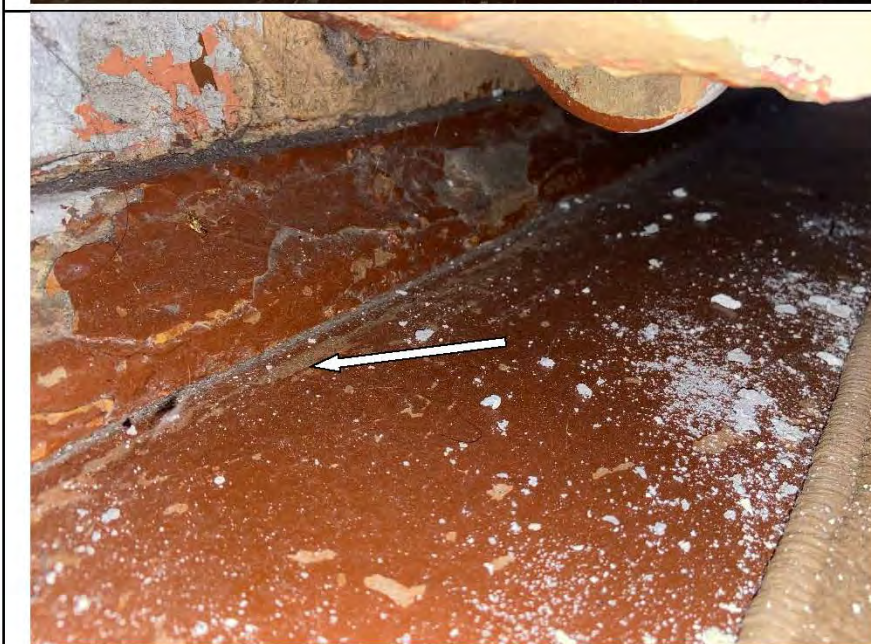
Фото №77. Поднятые кромки ДВП, следы залития в спальне.
