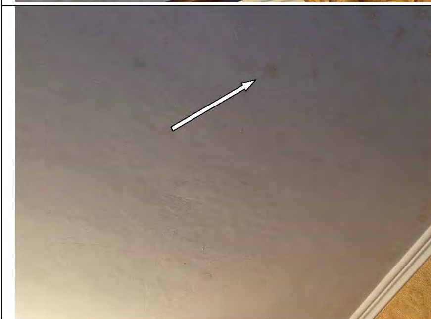
Фото №54. Следы поражения грибком поверхности окрашенного потолка в спальне.
