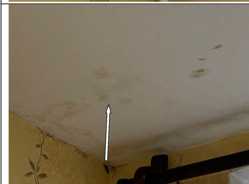
Фото №66. Следы поражения грибком поверхности окрашенного потолка в кухне.
