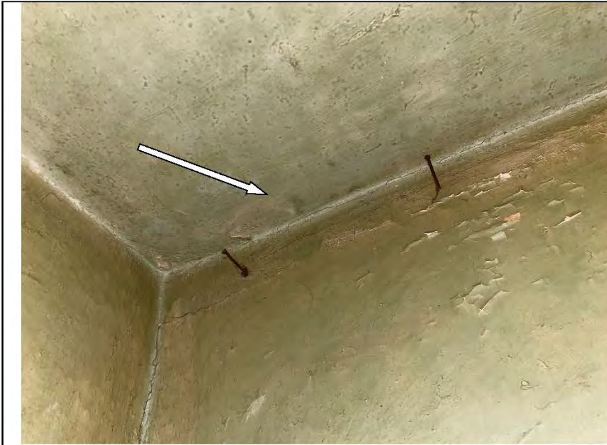
Фото №61. Следы поражения грибком поверхности окрашенного потолка в холле.
