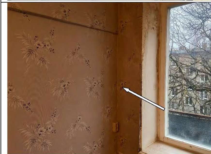
Фото №12. Следы залития на стенах, оклеенных обоями, в гостиной.
