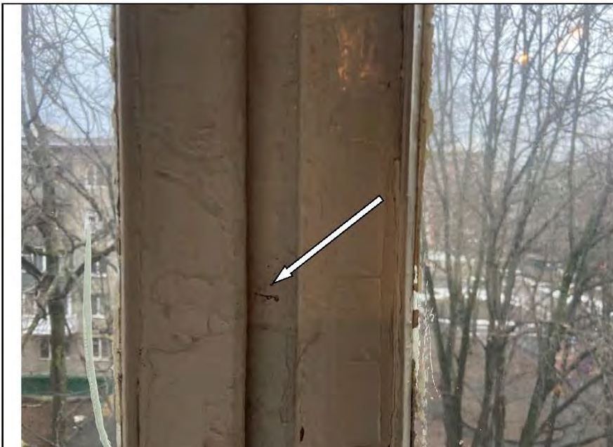
Фото №43. Следы заливки на деревянном профиле оконного блока в спальне.
