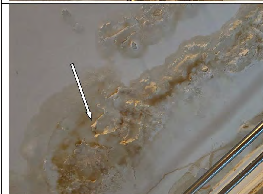
Фото №56. Следы поражения грибком поверхности окрашенного потолка в гостиной.
