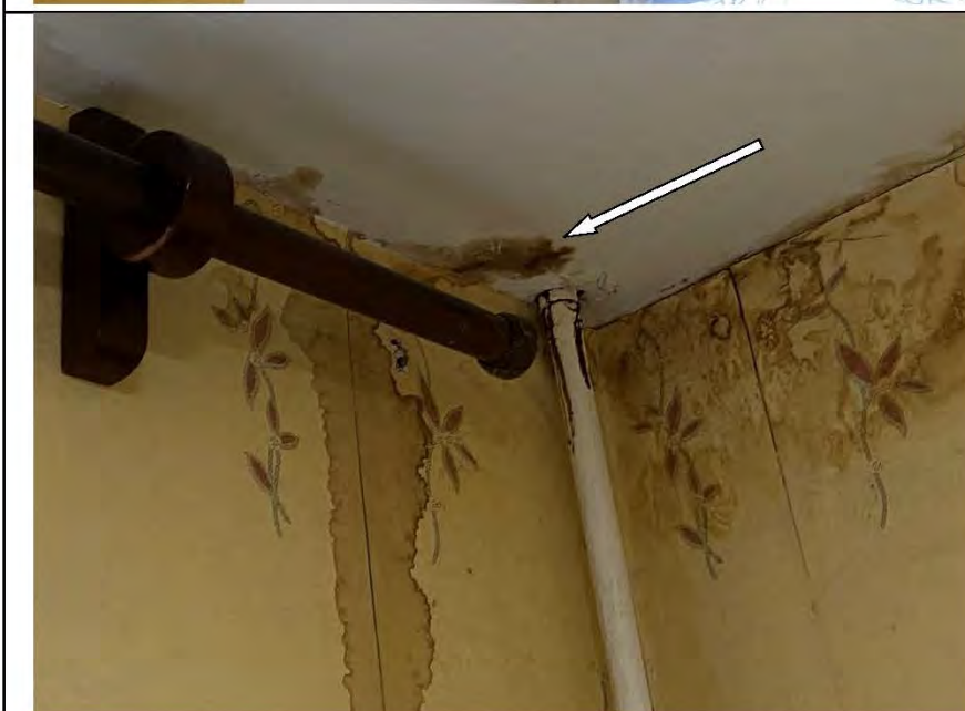
Фото №65. Следы поражения грибком поверхности окрашенного потолка в кухне.
