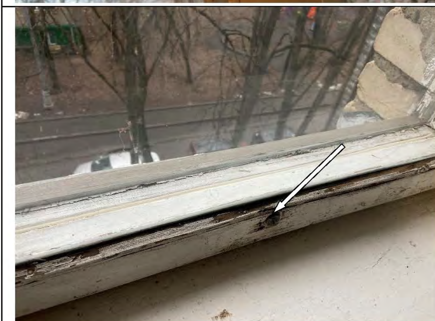
Фото №47. Следы заливки на деревянном профиле оконного блока в кухне.
