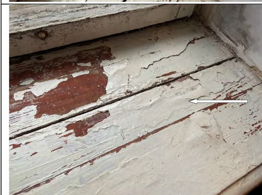
Фото №33. Следы залития на лицевой стороне подоконной доски оконного блока в спальне.
