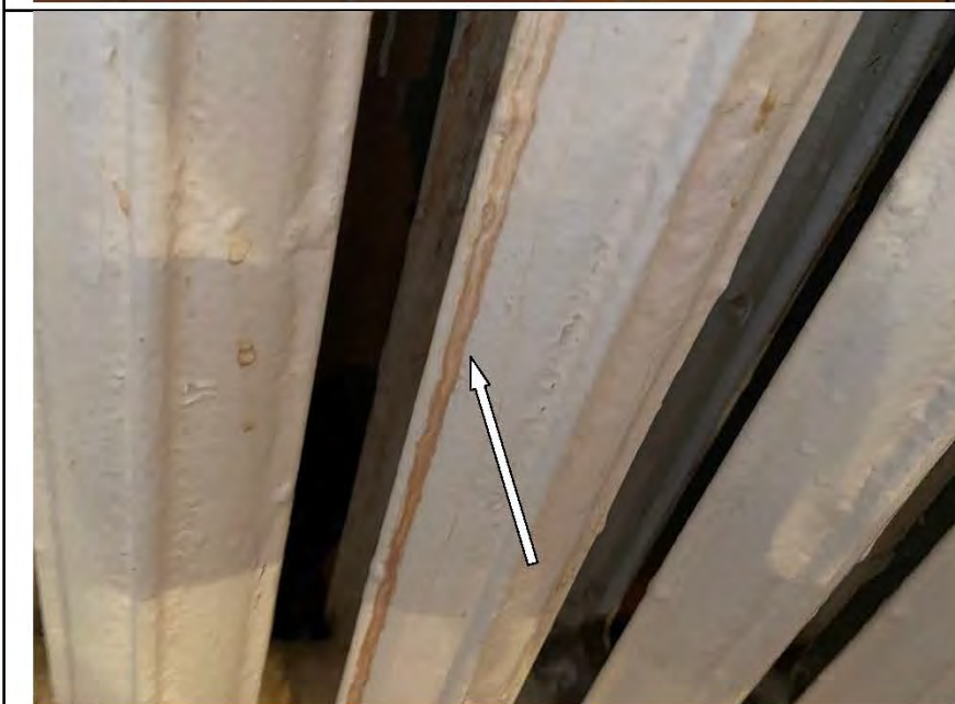
Фото №72. Следы залития на окрашенных трубах отопления в гостиной.
