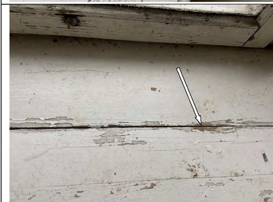
Фото №39. Следы заливия на лицевой стороне подоконной доски оконного блока в кухне.
