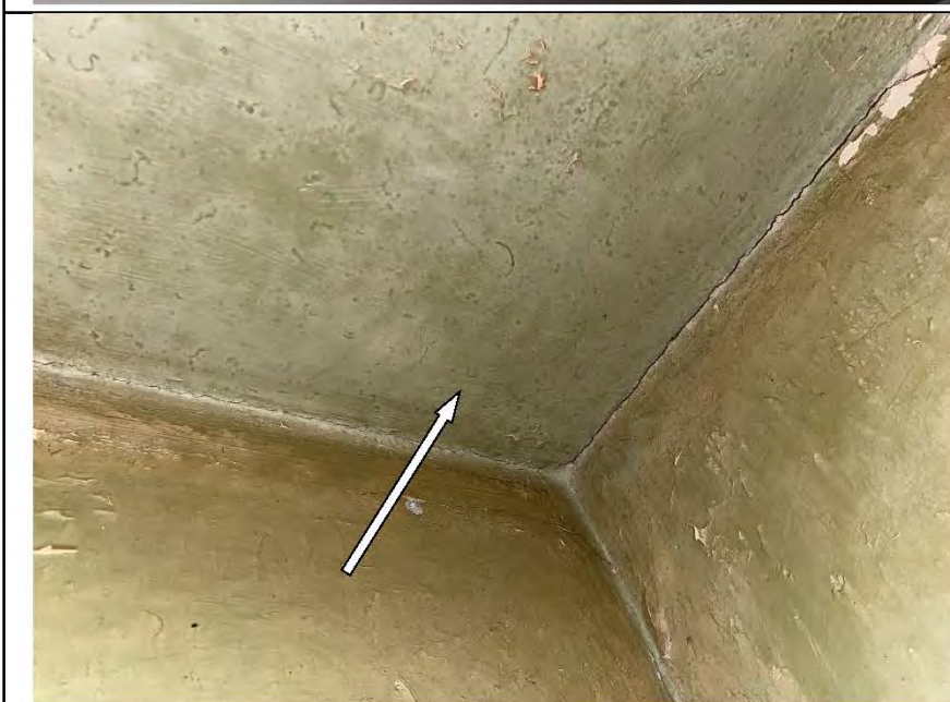
Фото №60. Следы поражения грибком поверхности окрашенного потолка в холле.
