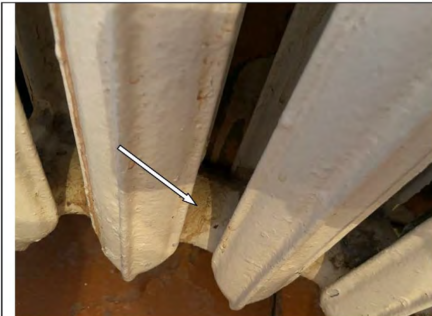
Фото №70. Следы залития на окрашенных трубах отопления в гостиной.
