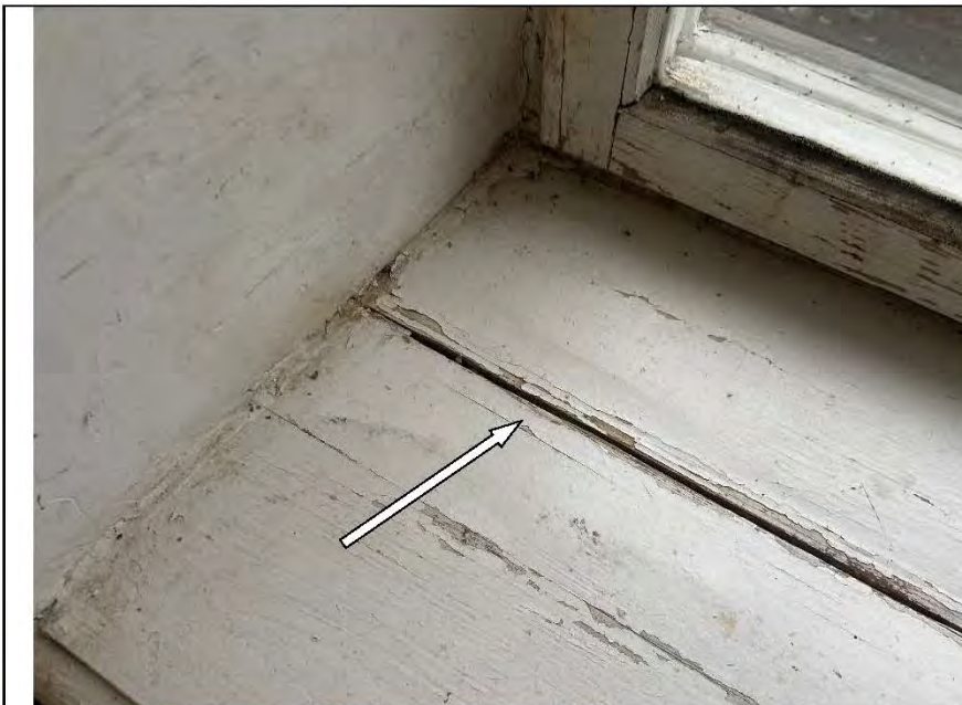
Фото №40. Следы заливки на лицевой стороне подоконной доски оконного блока в кухне.
