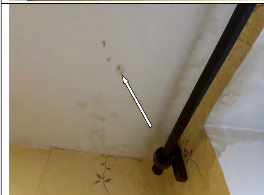
Фото №63. Следы поражения грибком поверхности окрашенного потолка в кухне.
