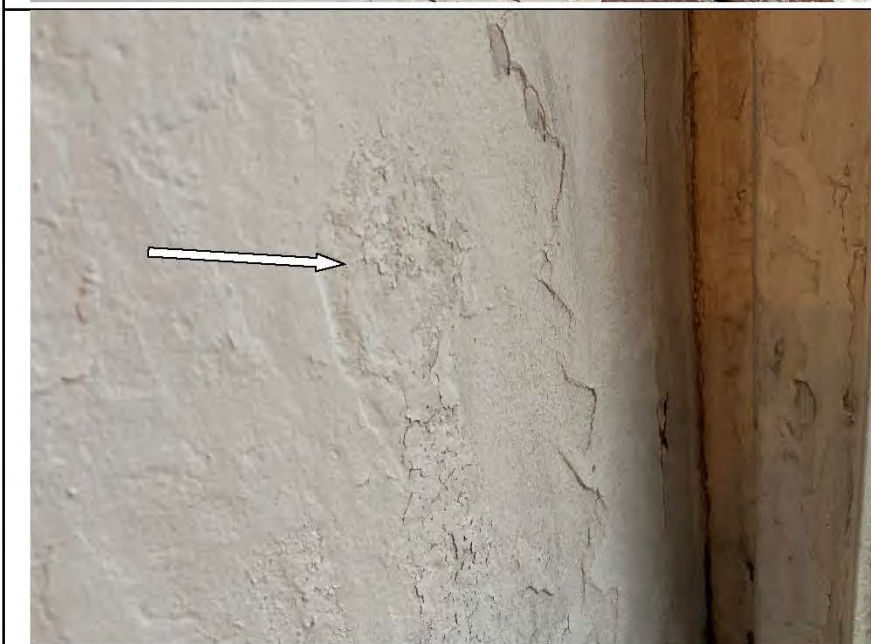
Фото №21. Следы залития на поверхности окрашенных откосов оконного блока в спальне.
