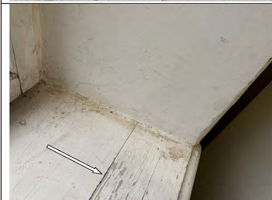
Фото №38. Следы заливия на лицевой стороне подоконной доски оконного блока в кухне.
