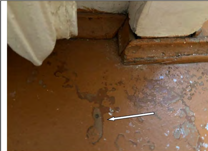
Фото №79. Поднятые кромки ДВП, следы залития в гостиной.
