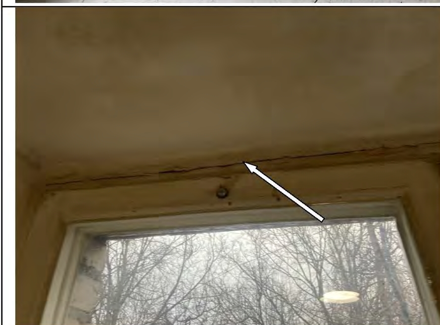
Фото №29. Следы залития на поверхности окрашенных откосов оконного блока в кухне.
