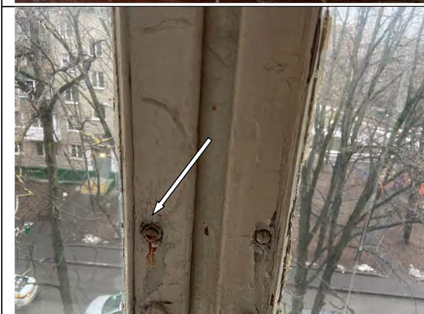
Фото №42. Следы заливки на деревянном профиле оконного блока в спальне.
