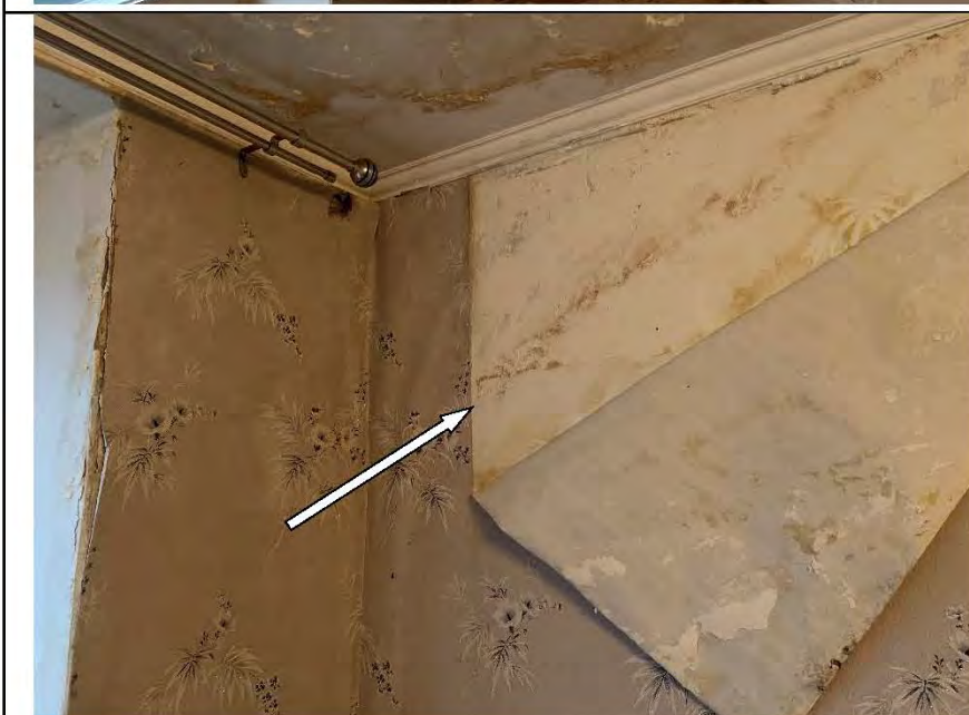
Фото №14. Следы залития на стенах, оклеенных обоями, в гостиной.
