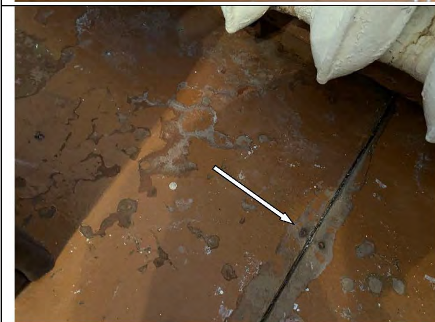
Фото №80. Поднятые кромки ДВП, следы залития в гостиной.
