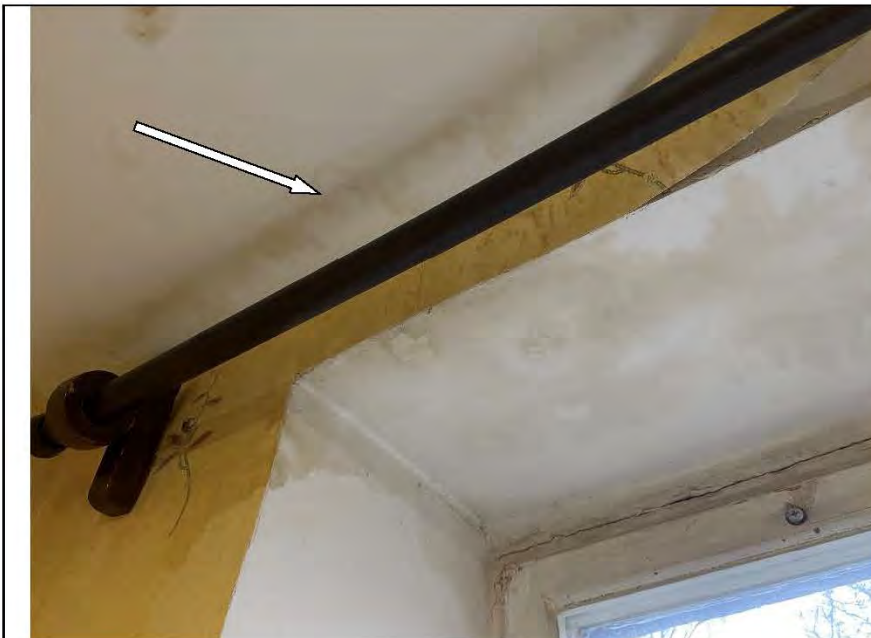
Фото №64. Следы поражения грибком поверхности окрашенного потолка в кухне.
