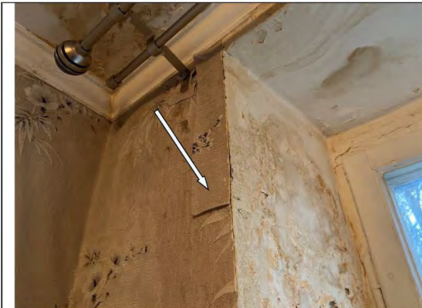
Фото №10. Следы залития на стенах, оклеенных обоями, в гостиной.
