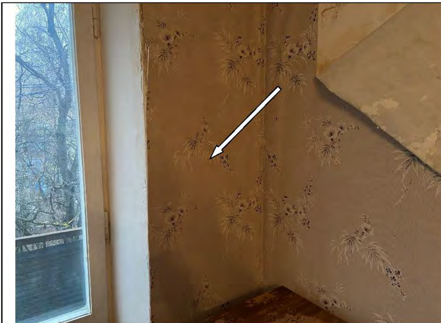
Фото №13. Следы залития на стенах, оклеенных обоями, в гостиной.
