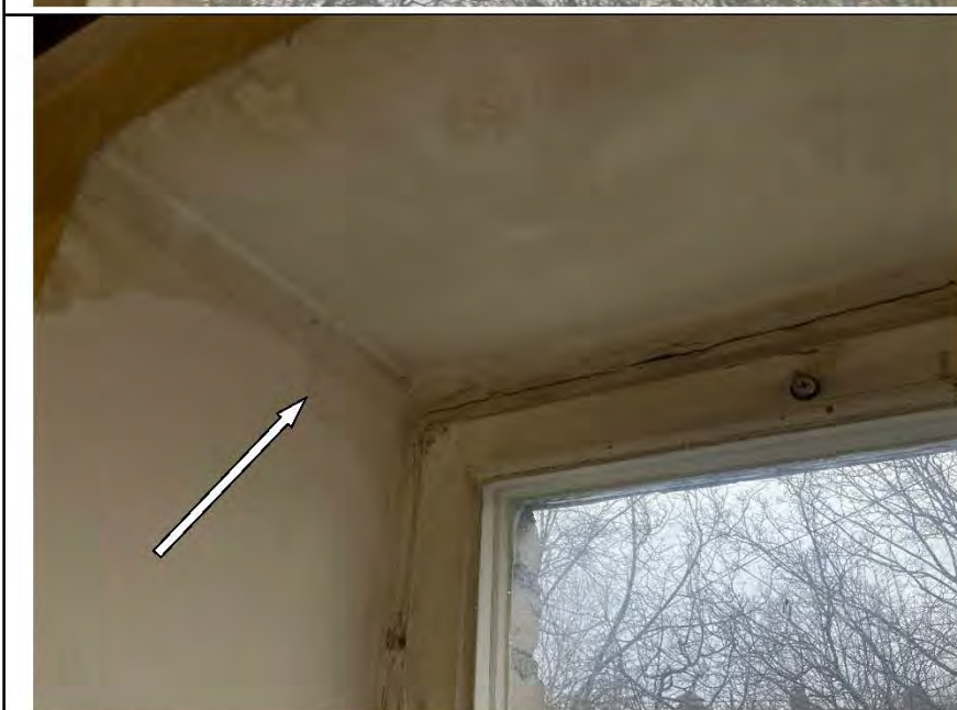
Фото №30. Следы залития на поверхности окрашенных откосов оконного блока в кухне.
