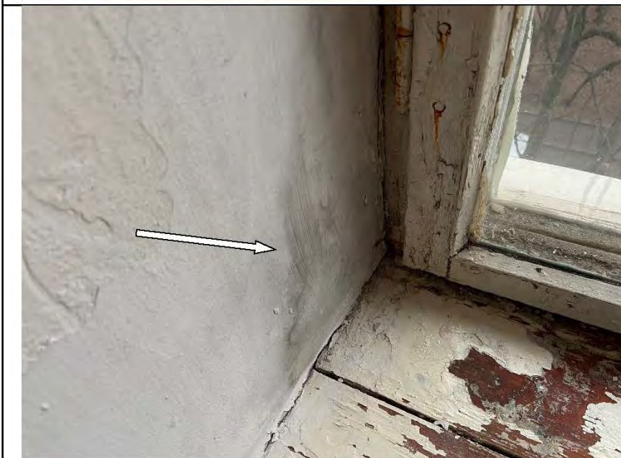
Фото №20. Следы залития на поверхности окрашенных откосов оконного блока в спальне.
