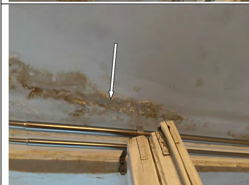
Фото №57. Следы поражения грибком поверхности окрашенного потолка в гостиной.
