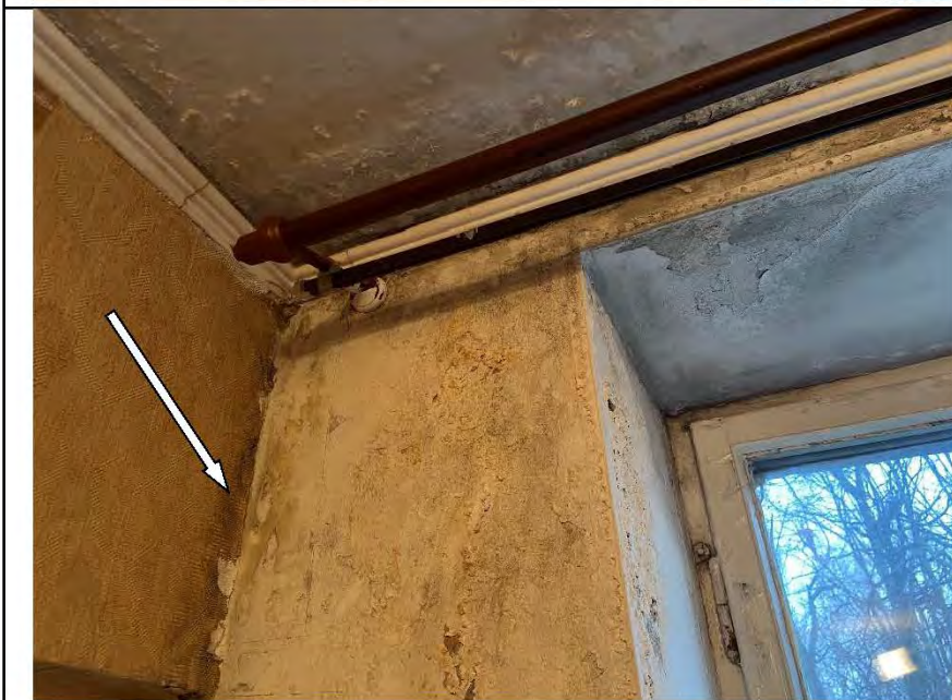
Фото №8. Следы залития на стенах, оклеенных обоями, в спальне.
