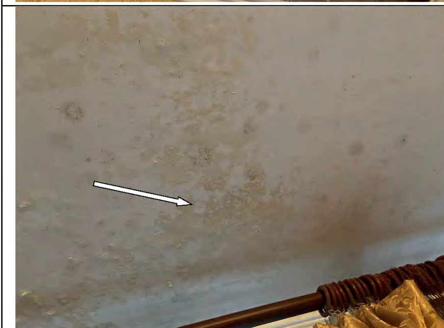
Фото №53. Следы поражения грибком поверхности окрашенного потолка в спальне.
