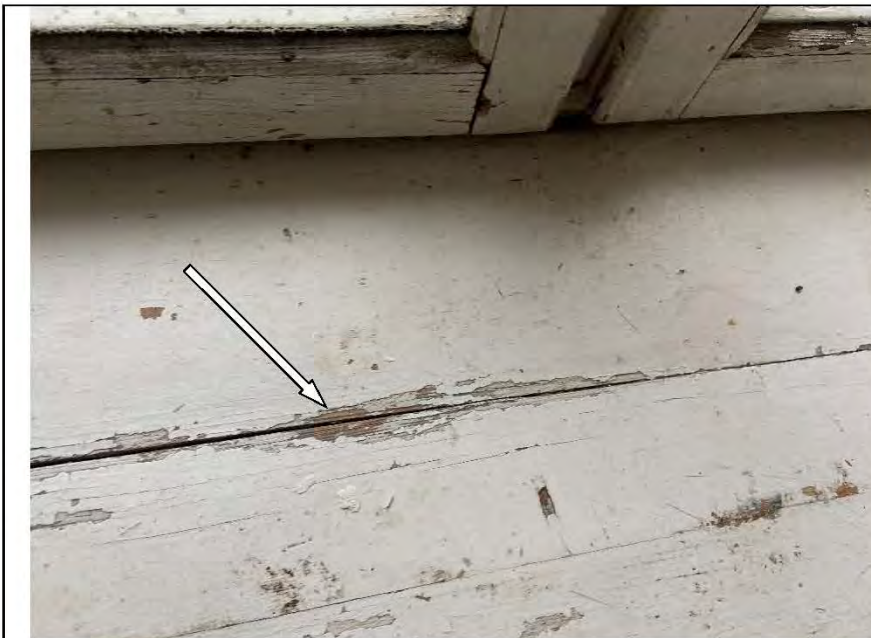
Фото №37. Следы заливия на лицевой стороне подоконной доски оконного блока в гостиной.
