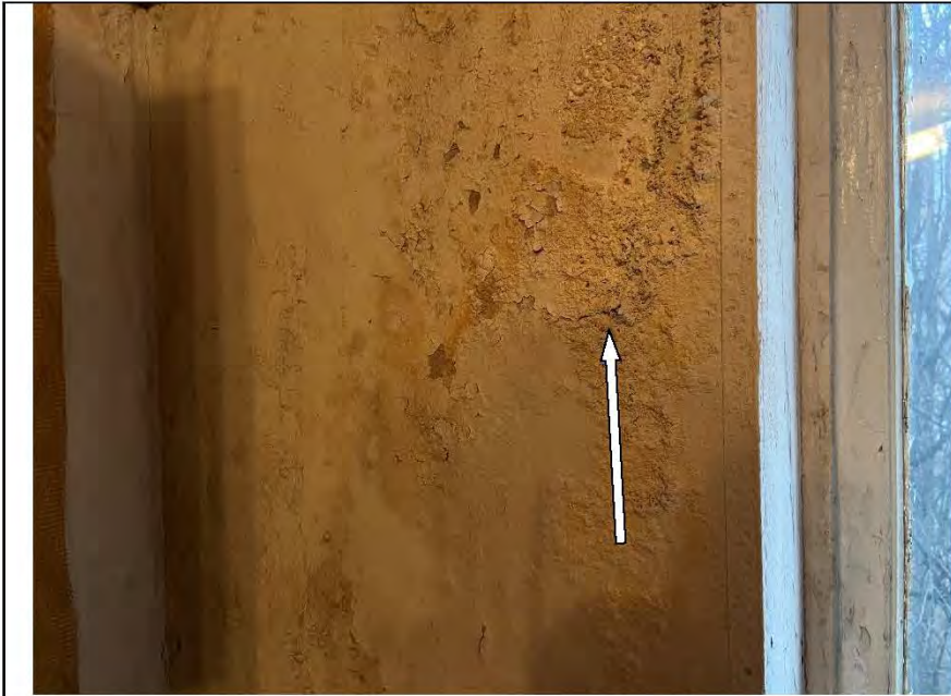
Фото №7. Следы залития на стенах, оклеенных обоями, в спальне.
