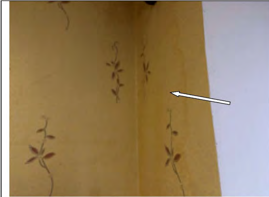
Фото №16. Следы залития на стенах, оклеенных обоями, в кухне.
