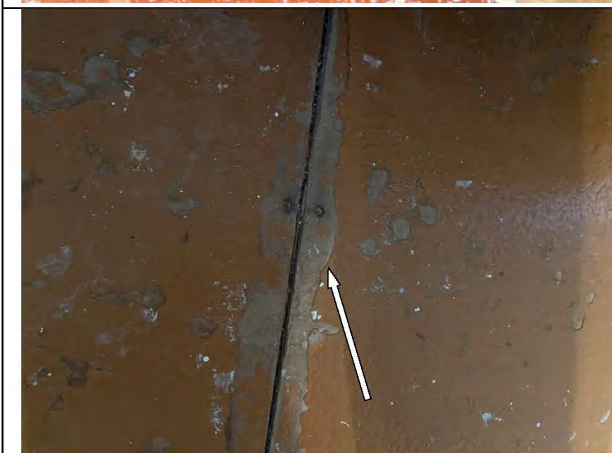
Фото №78. Поднятые кромки ДВП, следы залития в спальне.
