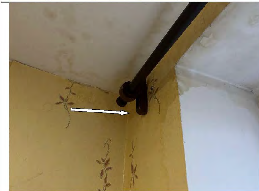
Фото №17. Следы залития на стенах, оклеенных обоями, в кухне.
