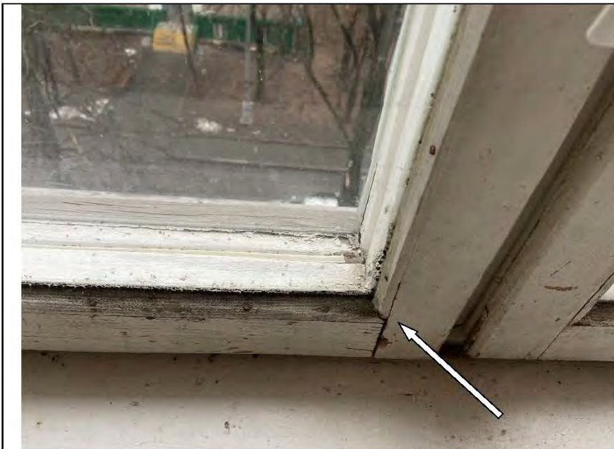
Фото №49. Следы залития на деревянном профиле оконного блока в кухне.
