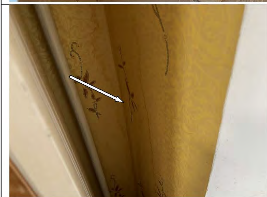
Фото №15. Следы залития на стенах, оклеенных обоями, в кухне.
