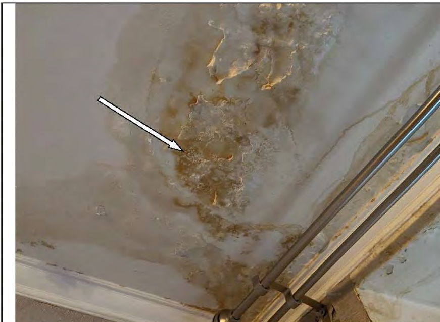
Фото №55. Следы поражения грибком поверхности окрашенного потолка в гостиной.
