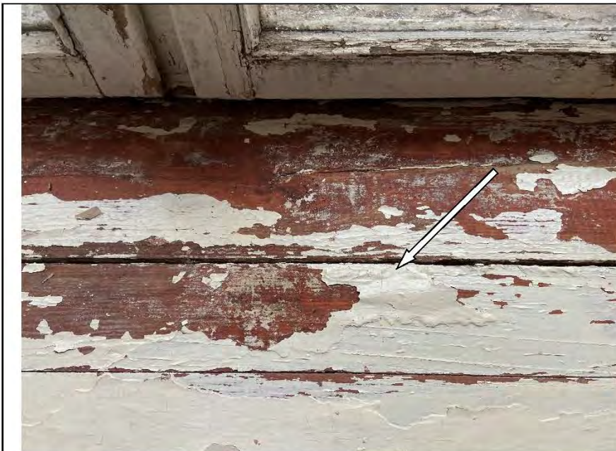
Фото №34. Следы залития на лицевой стороне подоконной доски оконного блока в спальне.
