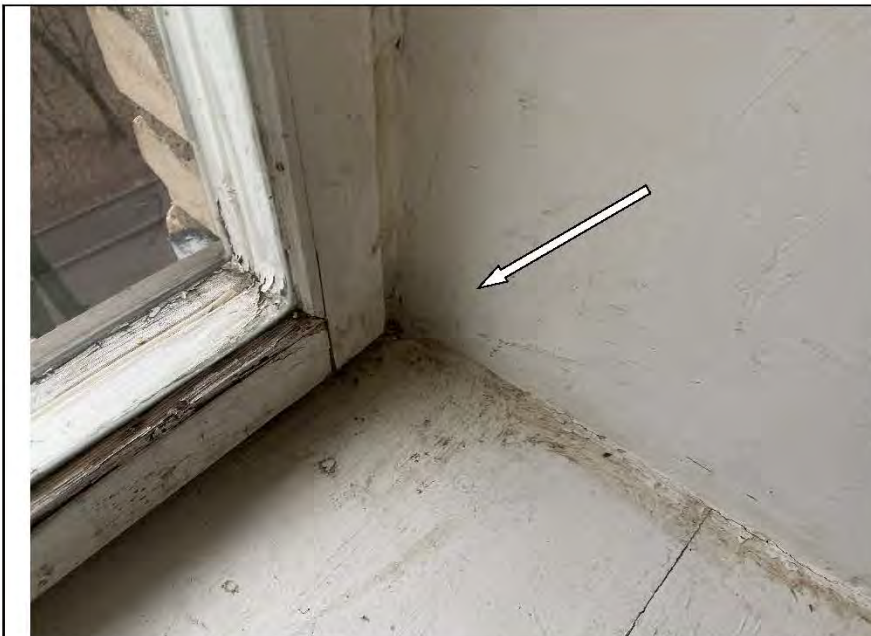
Фото №28. Следы залития на поверхности окрашенных откосов оконного блока в кухне.
