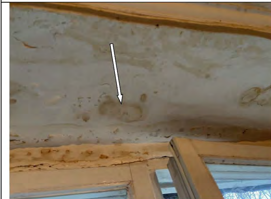
Фото №26. Следы залития на поверхности окрашенных откосов оконного блока в гостиной.
