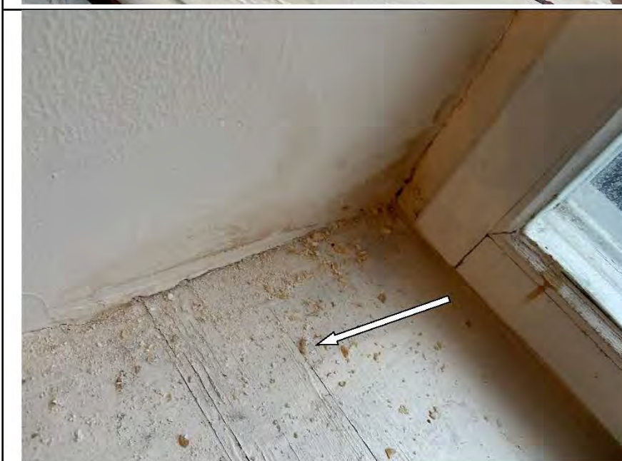
Фото №36. Следы залития на лицевой стороне подоконной доски оконного блока в гостиной.
