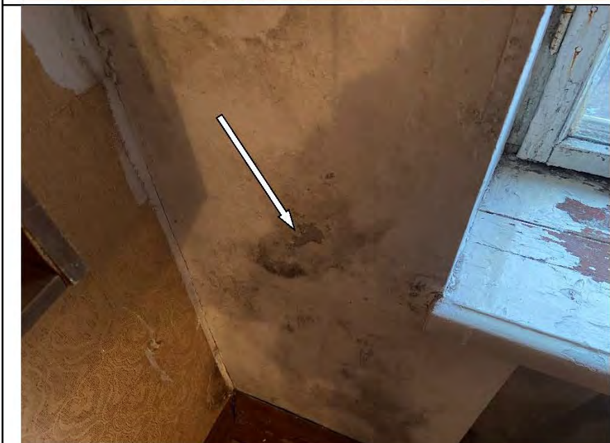
Фото №5. Следы заливания на стенах, оклеенных обоями, в спальне.
