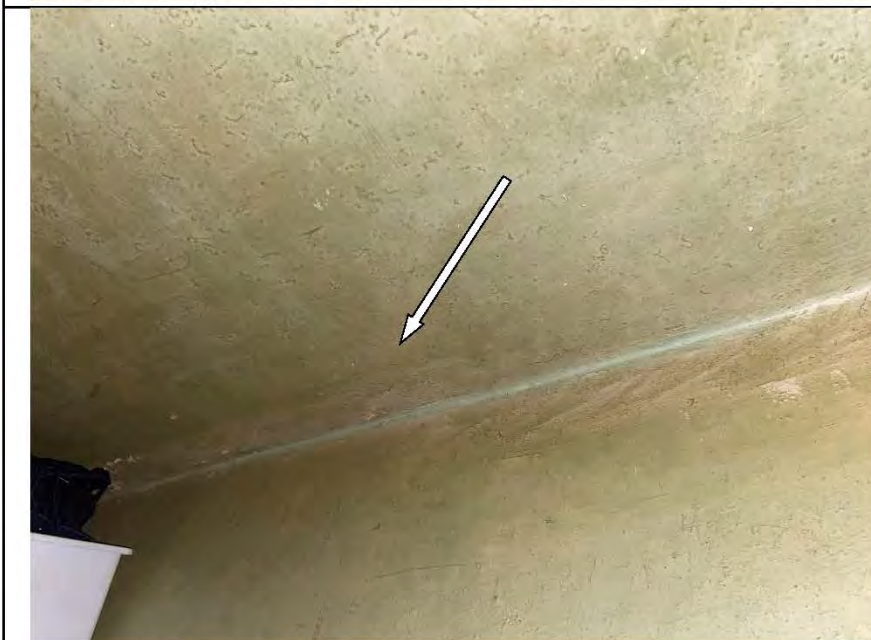
Фото №62. Следы поражения грибком поверхности окрашенного потолка в холле.
