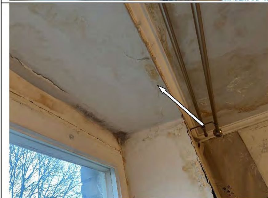
Фото №27. Следы залития на поверхности окрашенных откосов оконного блока в гостиной.
