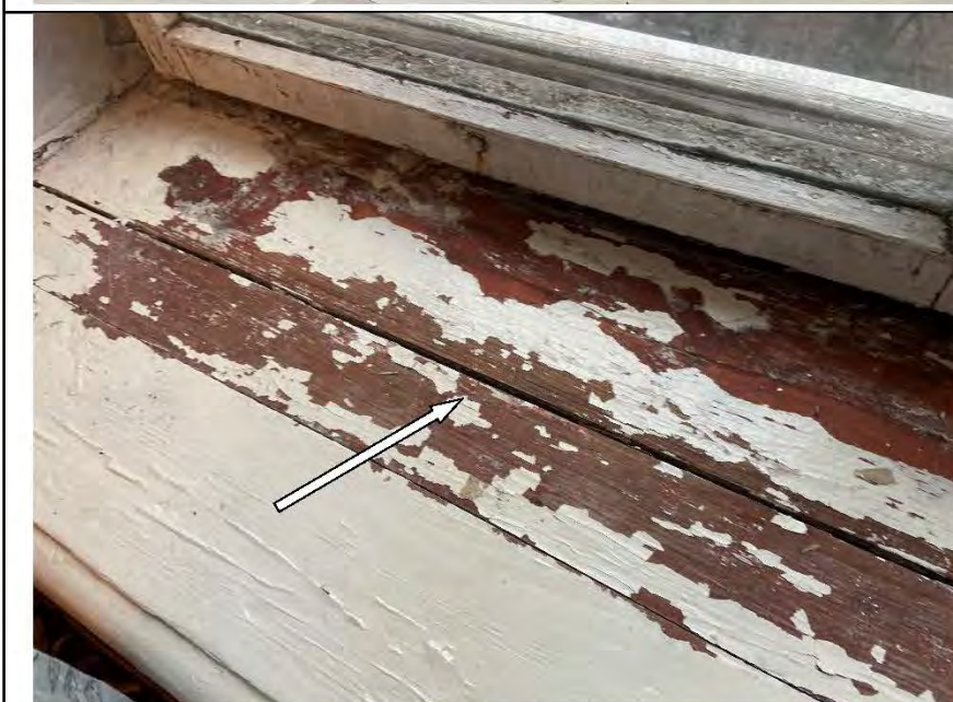
Фото №35. Следы залития на лицевой стороне подоконной доски оконного блока в спальне.
