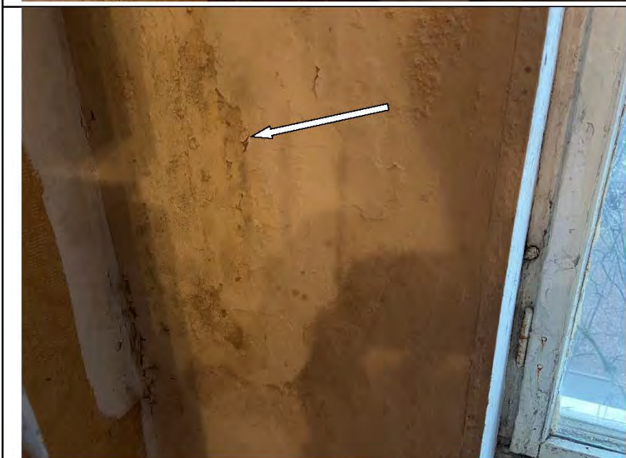
Фото №6. Следы заливания на стенах, оклеенных обоями, в спальне.
