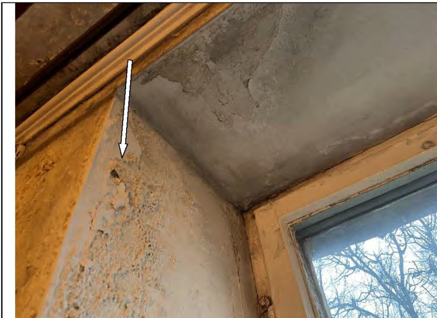
Фото №22. Следы залития на поверхности окрашенных откосов оконного блока в спальне.
