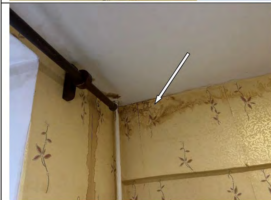
Фото №18. Следы залития на стенах, оклеенных обоями, в кухне.
