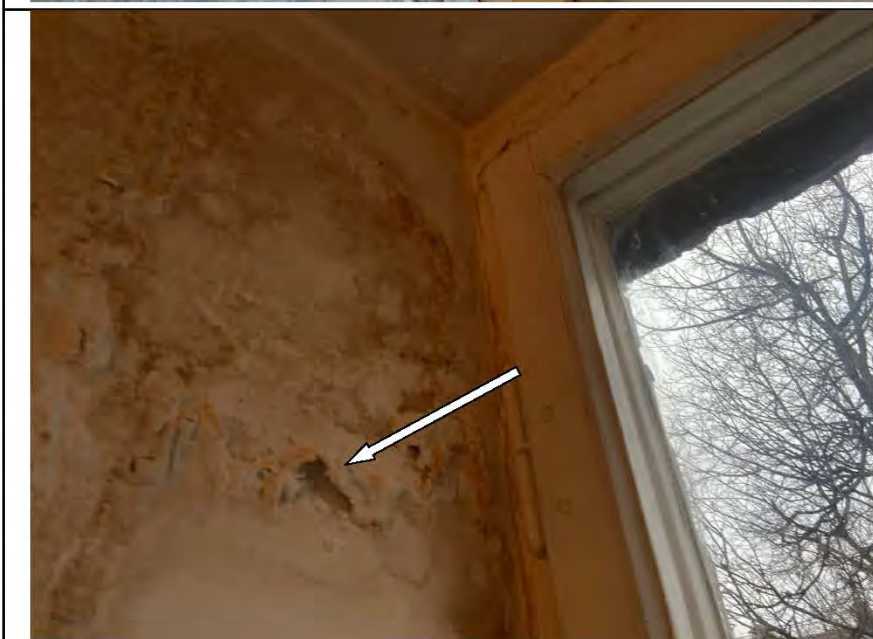
Фото №24. Следы залития на поверхности окрашенных откосов оконного блока в гостиной.
