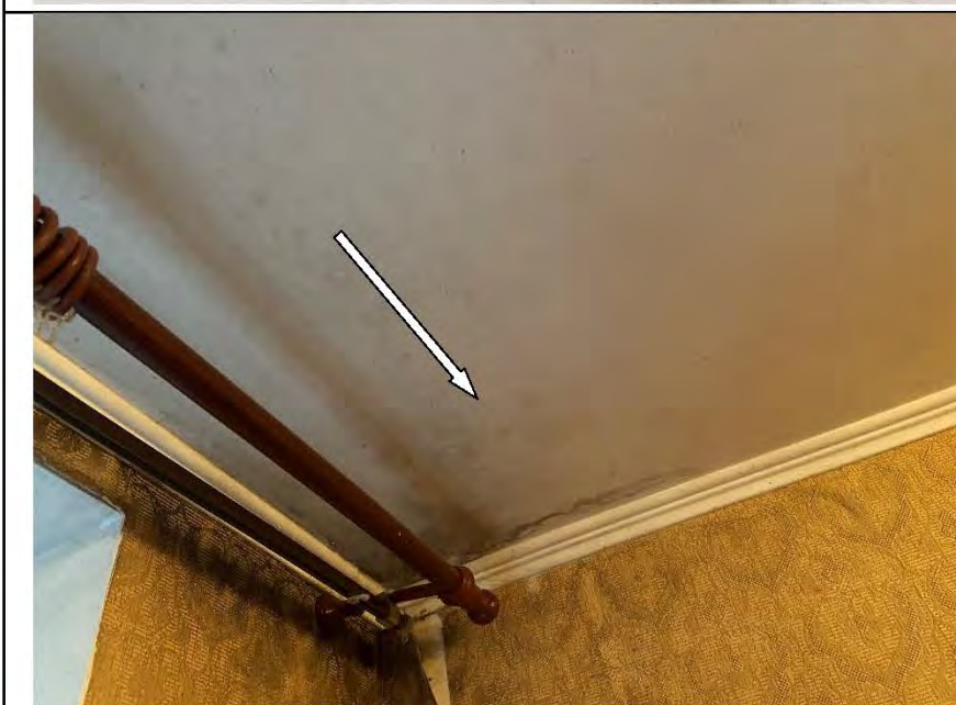
Фото №50. Следы поражения грибком поверхности окрашенного потолка в спальне.
