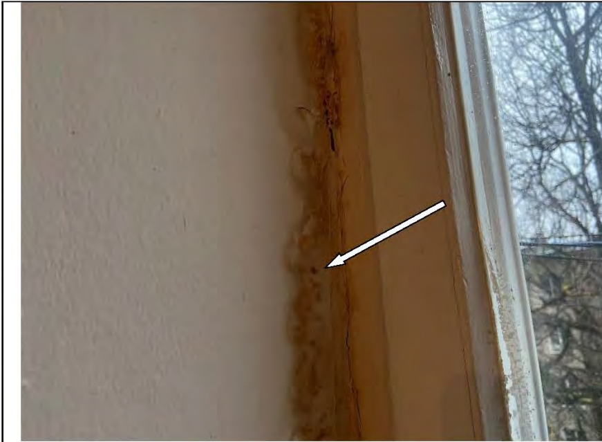
Фото №25. Следы залития на поверхности окрашенных откосов оконного блока в гостиной.
