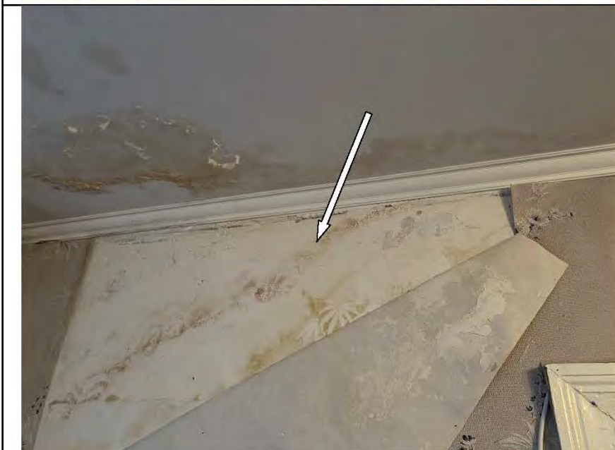
Фото №11. Следы залития на стенах, оклеенных обоями, в гостиной.
