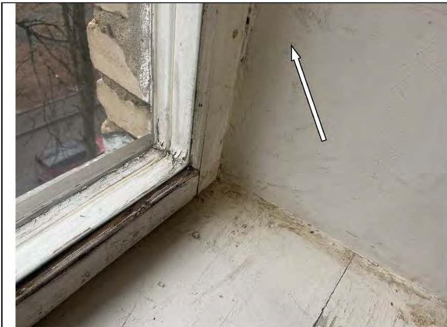
Фото №31. Следы залития на поверхности окрашенных откосов оконного блока в кухне.
