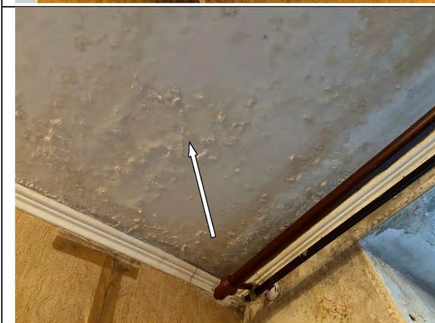
Фото №51. Следы поражения грибком поверхности окрашенного потолка в спальне.
