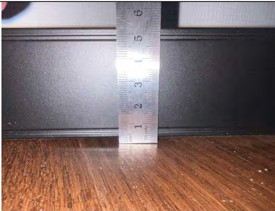
Фото №19. Неровности поверхности пола к коридоре-прихожей.
