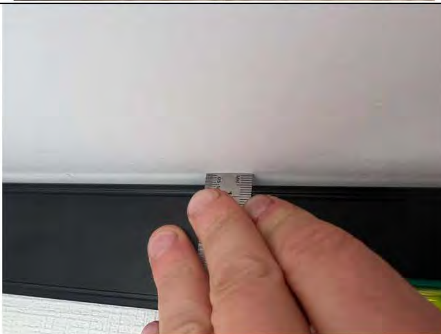
Фото №30. Неровности оштукатуренной поверхности потолка в коридоре- прихожей.
