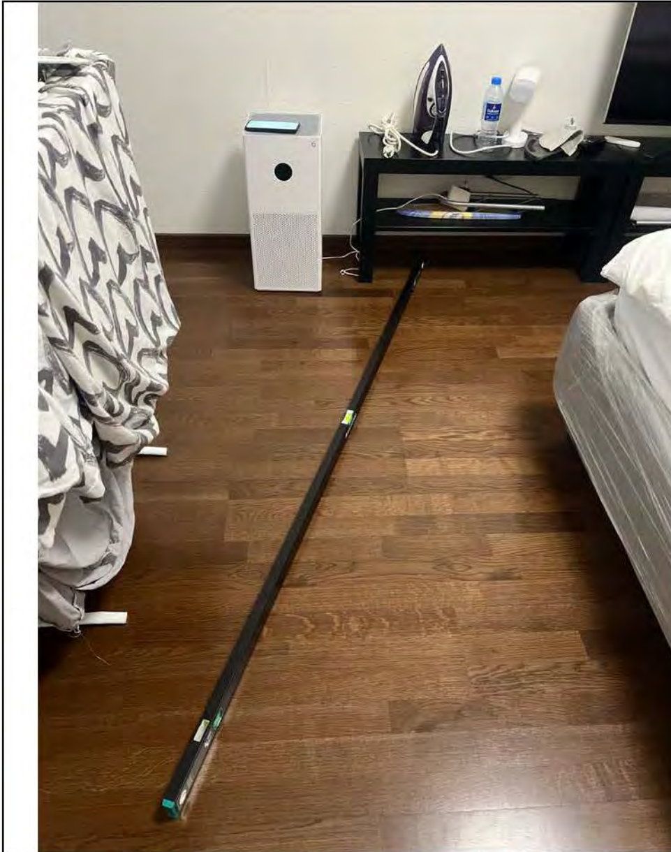
Фото №24. Неровности поверхности пола в спальне
