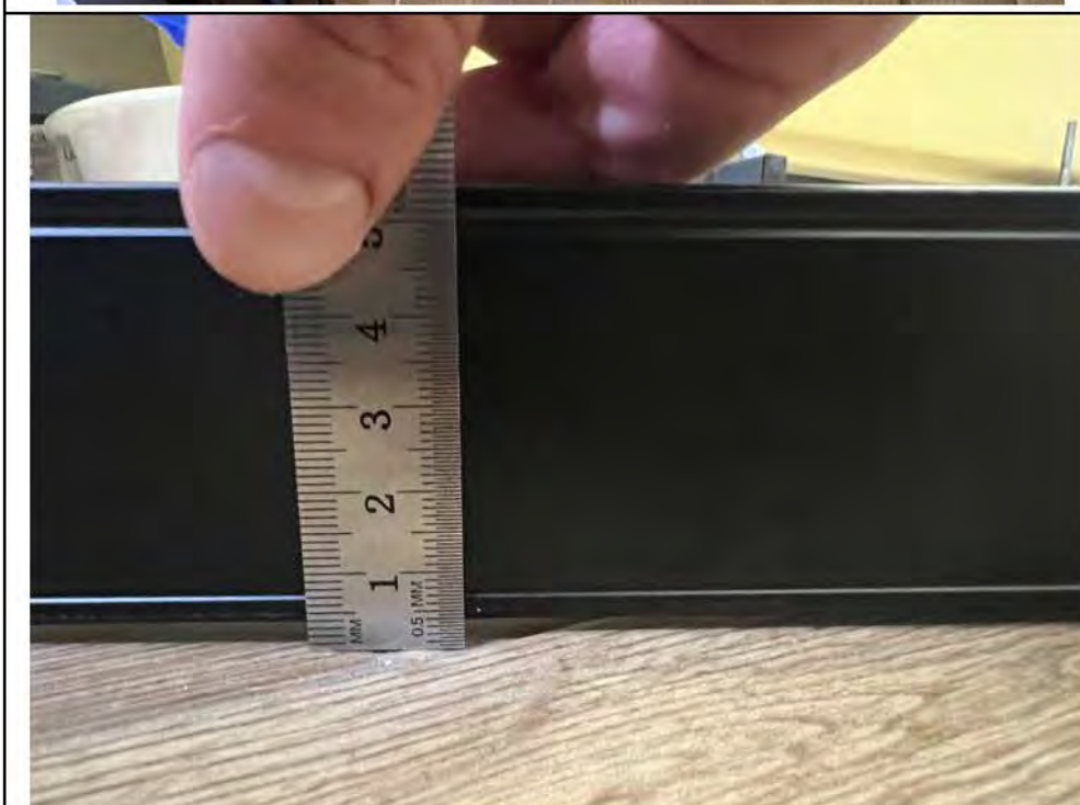
Фото №27. Неровности поверхности пола в ванной комнате
