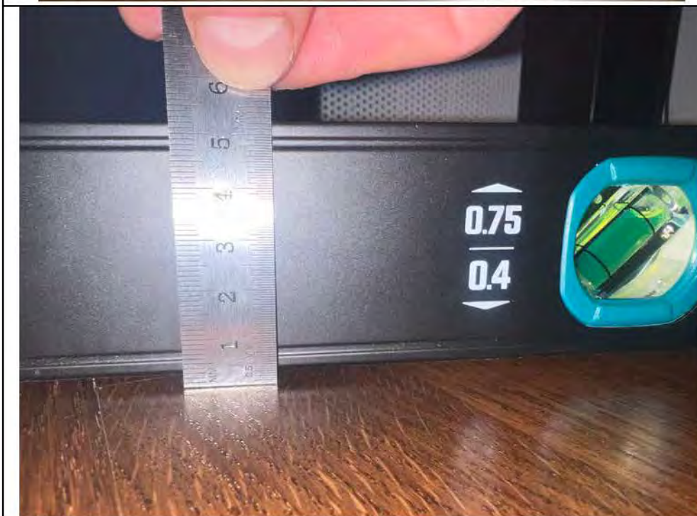
Фото №25. Неровности поверхности пола в спальне
