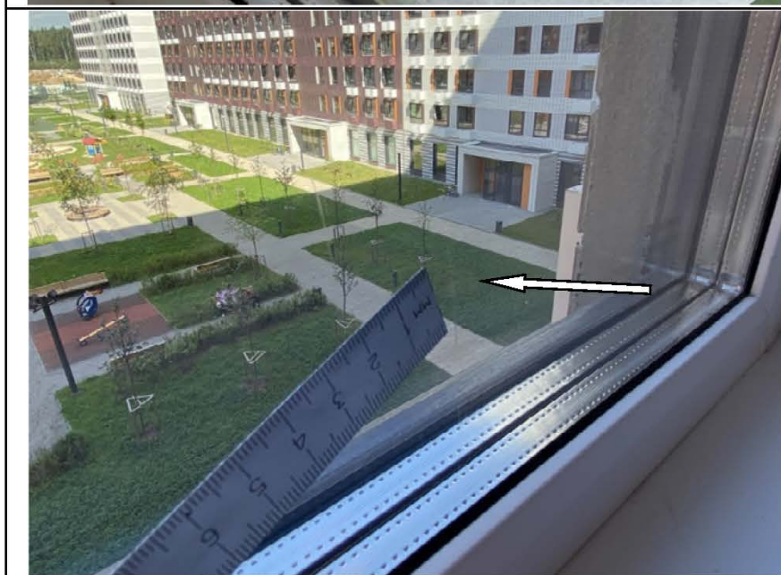
Фото №42. Царапины на стеклопакете оконного блока ПВХ в детской в квартире.
