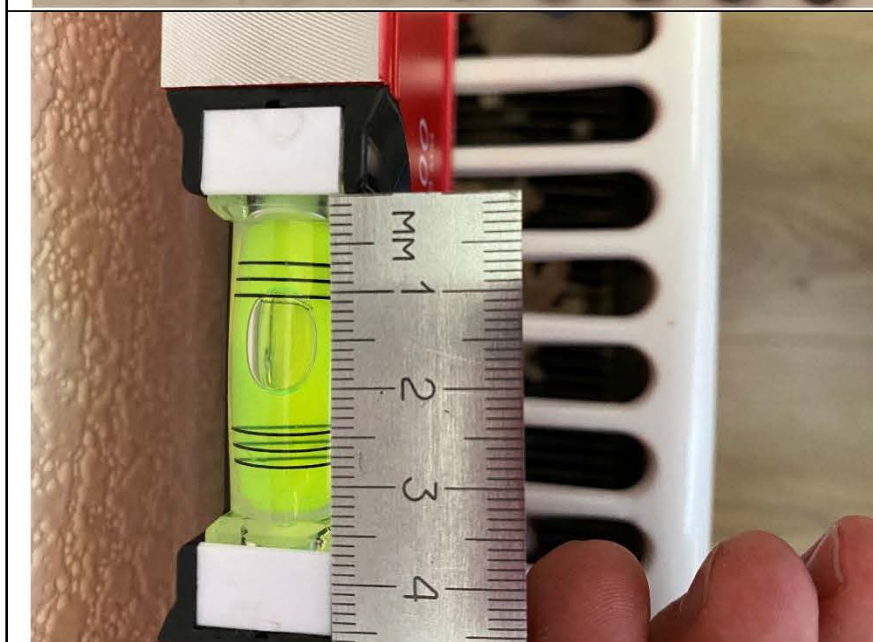
Фото №47. Отопительный прибор в детской в квартире смонтирован неровно.
