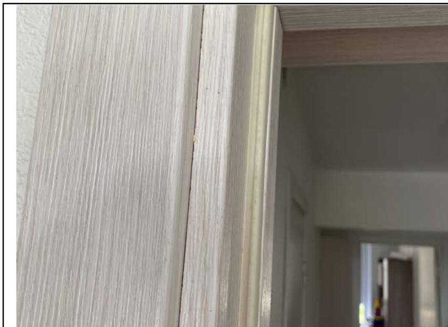
Фото №25. Загрязнение монтажной пеной наличника деревянного дверного блока в спальне.
