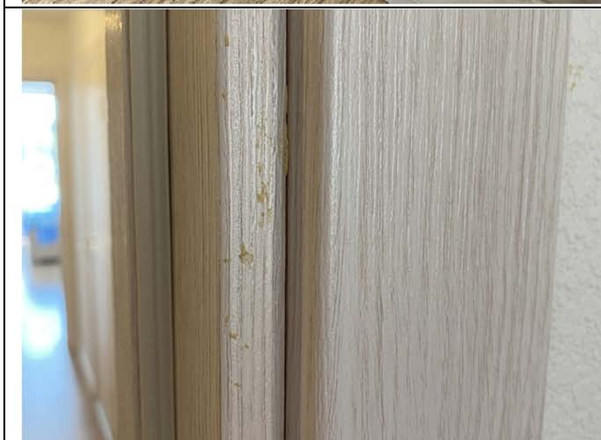
Фото №24. Загрязнение монтажной пеной наличника деревянного дверного блока в детской.
