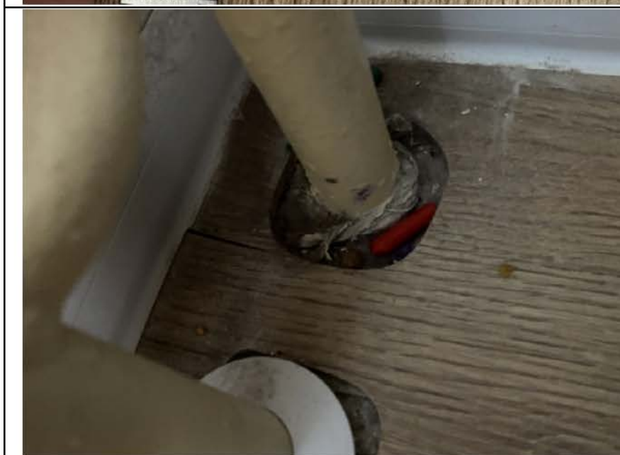
Фото №35. Дефект при заделке отверстия для трубопровода отопления в напольном покрытии из ламината в кухне в квартире.
