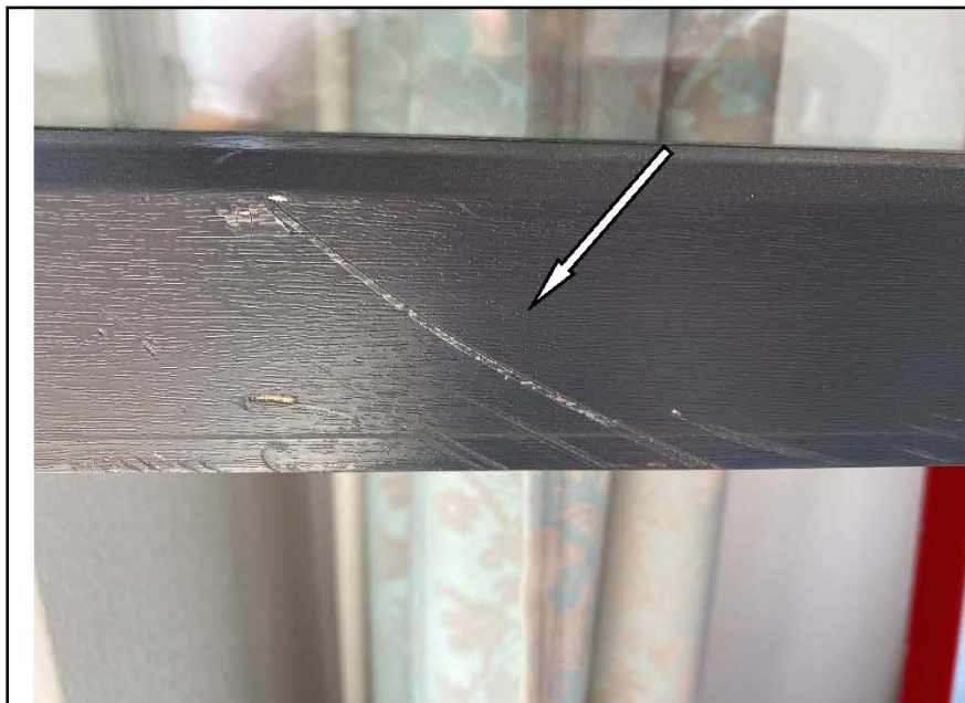
Фото №40. Царапины профиля ПВХ оконного блока в спальне в квартире.
