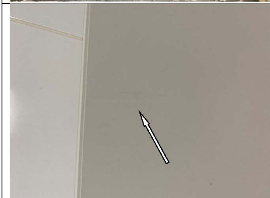
Фото №51. Загрязнение полотна в ванной комнате в квартире.
