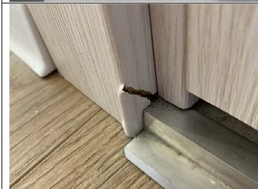
Фото №23. Скол на наличнике деревянного дверного блока в ванной комнате.
