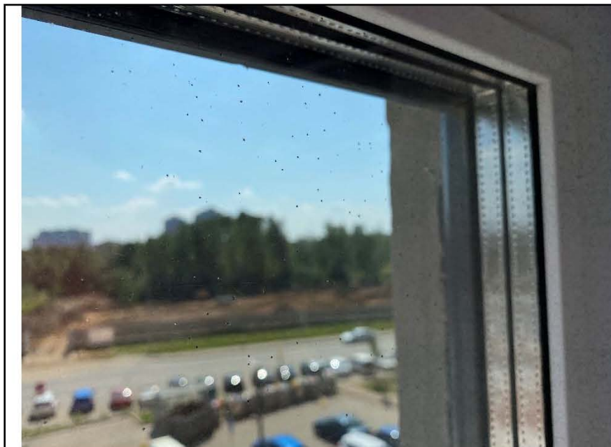
Фото №43. Окарины на стеклопакете оконного блока ПВХ в спальне в квартире.
