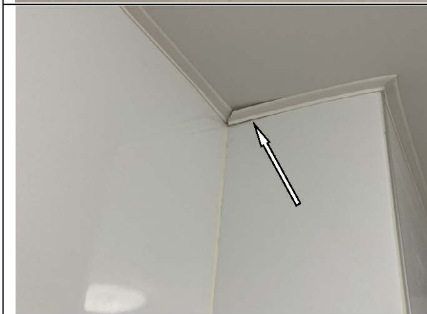
Фото №54. Дефект монтажа гибкой вставки крепления натяжного потолка в ванной комнате в квартире.
