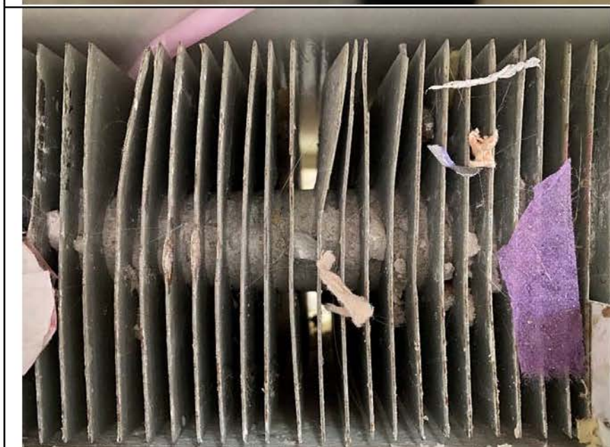
Фото №50. Радиатор в детской в квартире загрязнен и изогнут.
