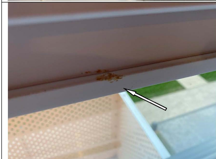
Фото №39. Загрязнение монтажной пеной профиля ПВХ оконного блока в детской в квартире.
