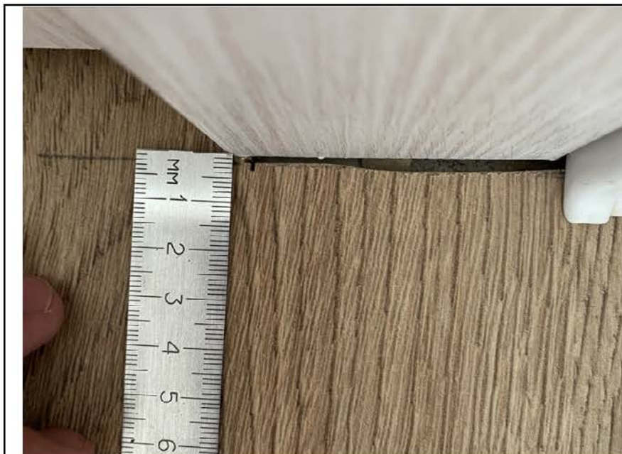
Фото №34. Измерение отсутствующей части ламината в спальне в квартире.
