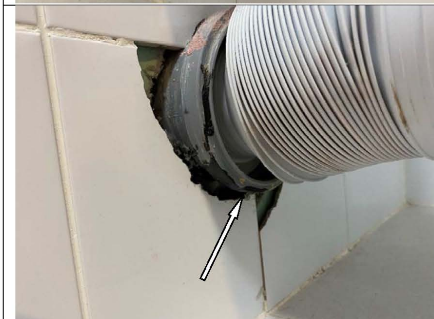
Фото №38. Отбитости настенной керамической плитки стен в ванной комнате в квартире.
