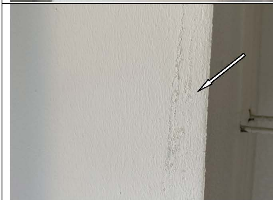
Фото №21. Окрашенные откосы оконного блока ПВХ в кухне выполнены с дефектами.
