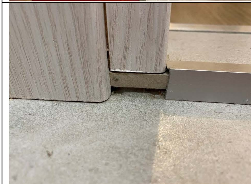
Фото №15. Отсутствие части металлического порожка на шве напольного покрытия в санузле.
