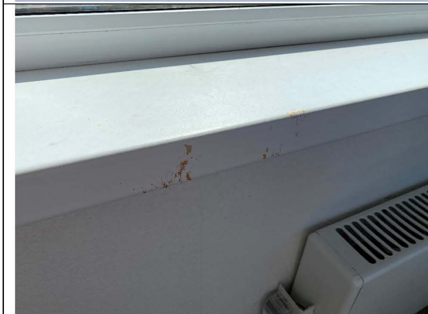
Фото №45. Загрязнение монтажной пеной на лицевой поверхности подоконной доски в спальне.
