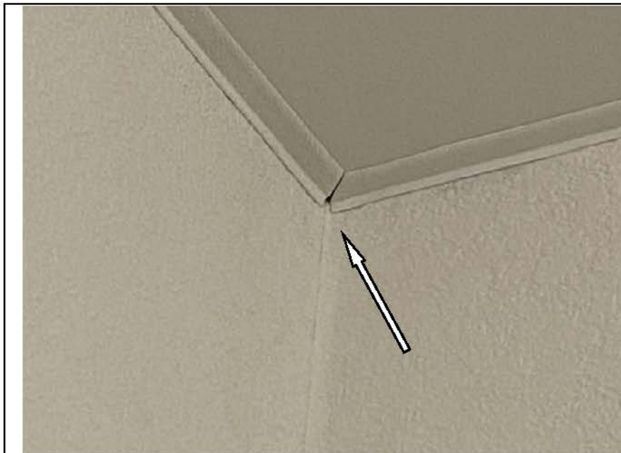
Фото №52. Дефект монтажа гибкой вставки крепления натяжного потолка в прихожей в квартире.
