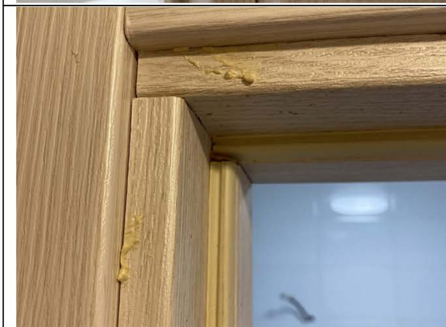
Фото №27. Загрязнение монтажной пеной наличника деревянного дверного блока в ванной комнате.
