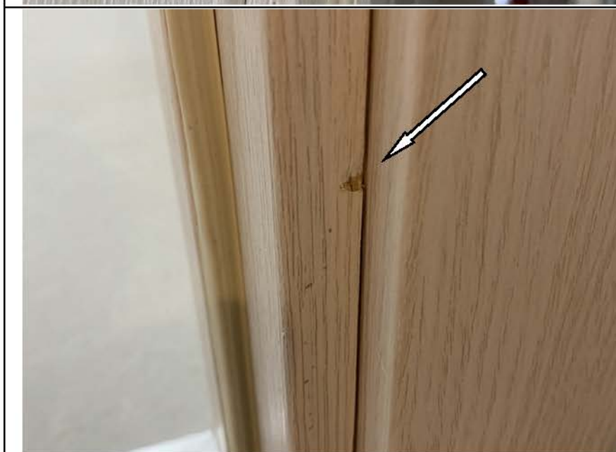
Фото №26 Скол на наличнике деревянного дверного блока в санузле.
