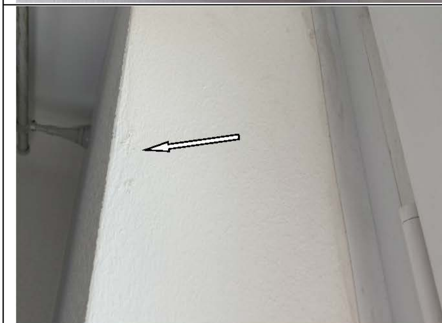
Фото №20. Окрашенные откосы оконного блока ПВХ в спальне выполнены с дефектами.
