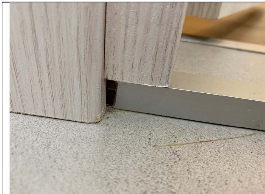
Фото №16. Отсутствие части металлического порошка на шве напольного покрытия в ванной комнате.
