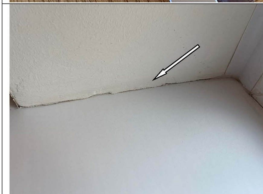
Фото №18. Окрашенные откосы оконного блока ПВХ в гостиной выполнены с дефектами.
