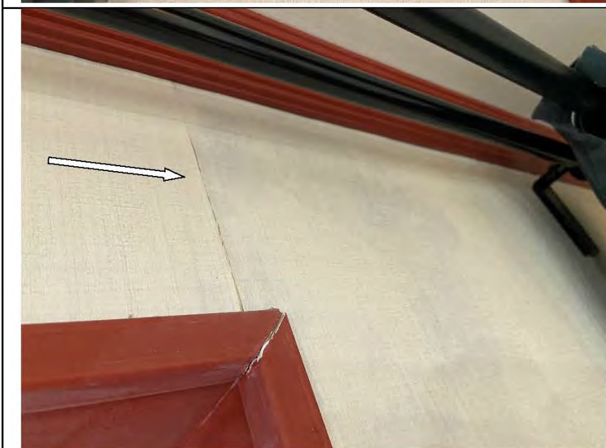
Фото №21. Следы залития на стенах, оклеенных обоями, в спальне.
