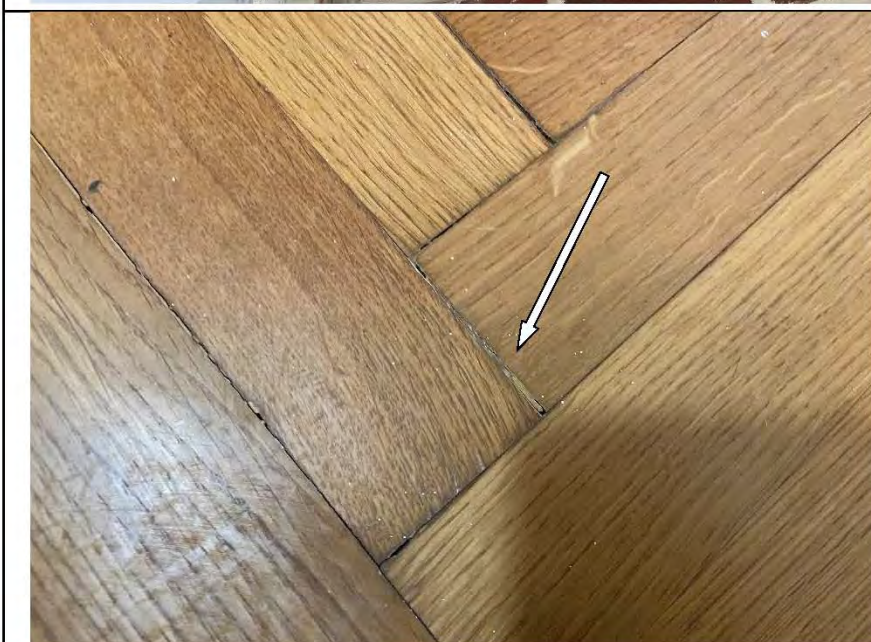
Фото №56. Поднятые кромки досок паркета в спальне.
