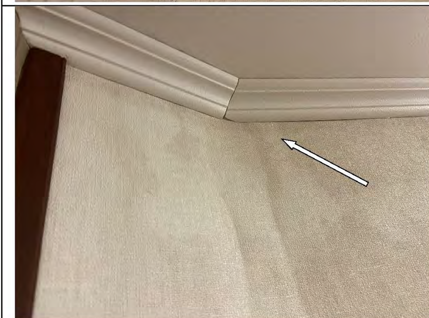
Фото №12. Следы залития на стенах, оклеенных обоями, в коридоре.
