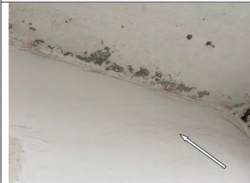
Фото №29. Следы залития на оштукатуренных стенах на балконе.
