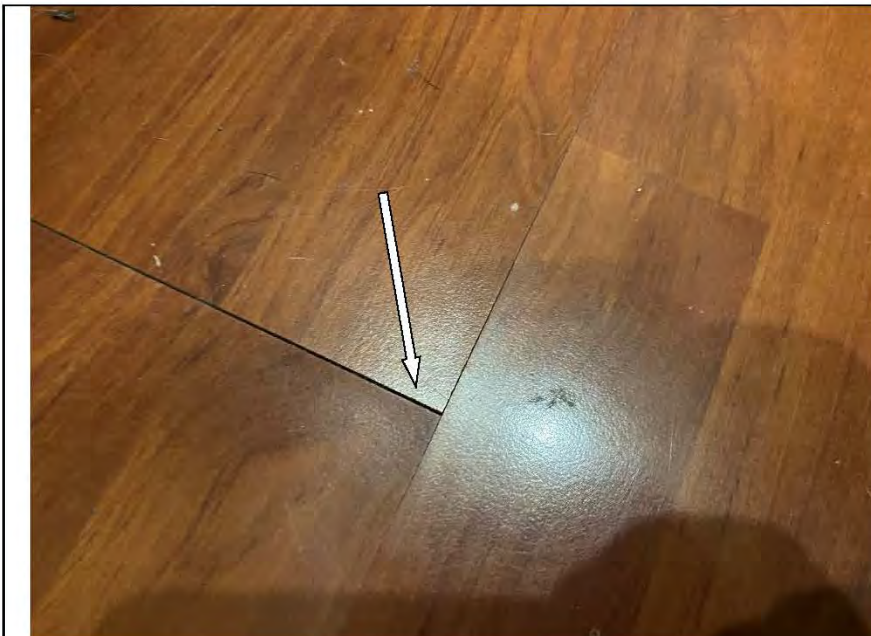
Фото №70. Поднятые кромки досок ламината в кладовой.
