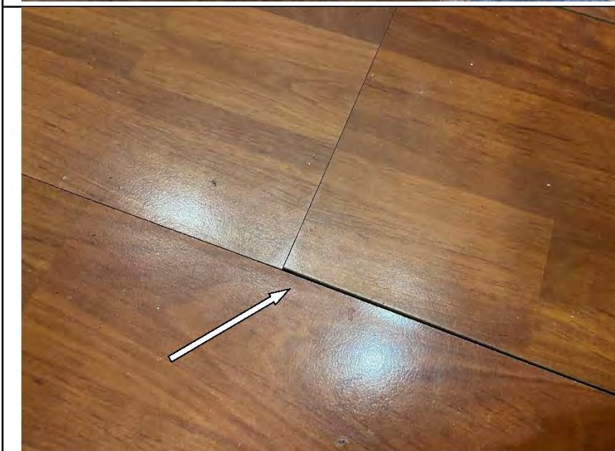
Фото №66. Поднятые кромки досок ламината в кладовой.
