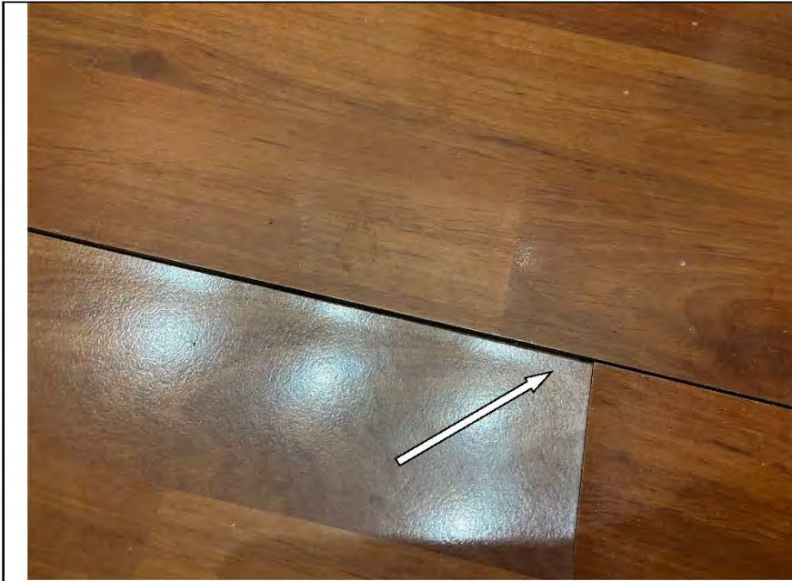
Фото №67. Поднятые кромки досок ламината в кладовой.
