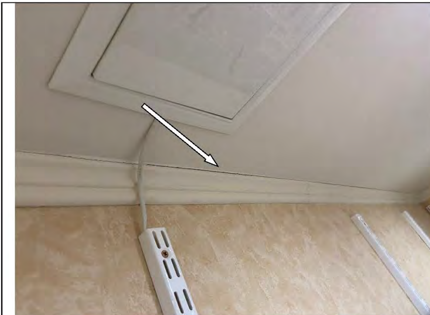
Фото №49. Следы залития на поверхности окрашенного потолка в кладовой.
