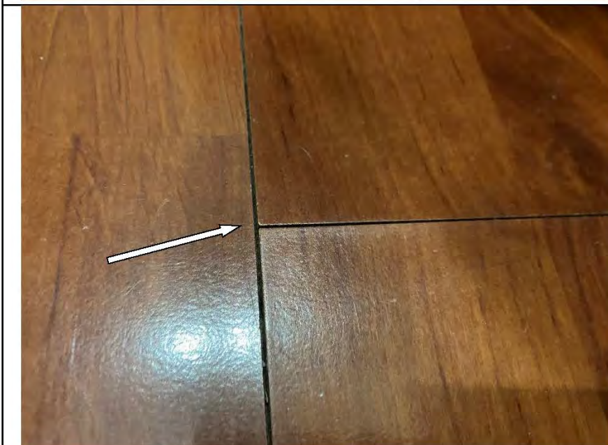
Фото №71. Поднятые кромки досок ламината в кладовой.
