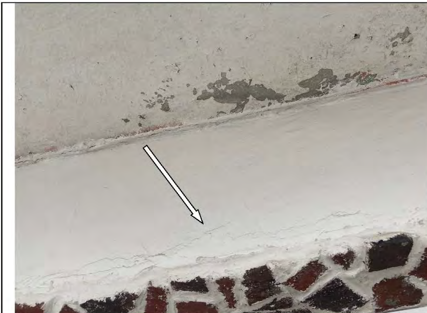
Фото №31. Следы залития на оштукатуренных стенах на балконе.
