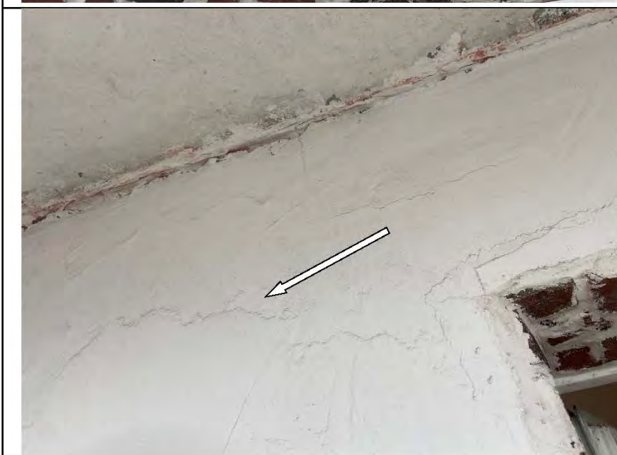
Фото №32. Следы залития на оштукатуренных стенах на балконе.
