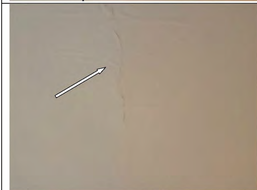
Фото №47. Следы залития на поверхности окрашенного потолка в спальне.
