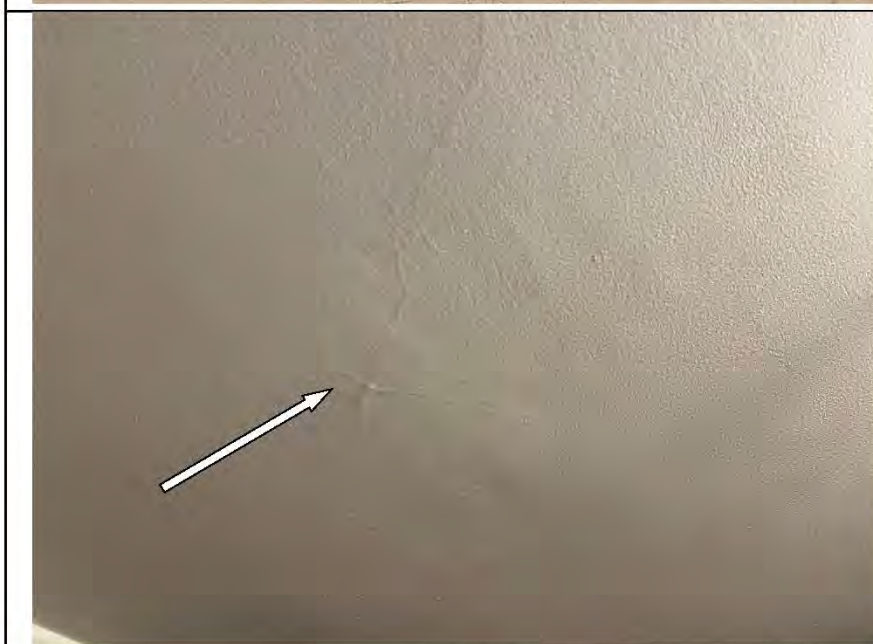
Фото №38. Следы залития на поверхности окрашенного потолка в кухне.
