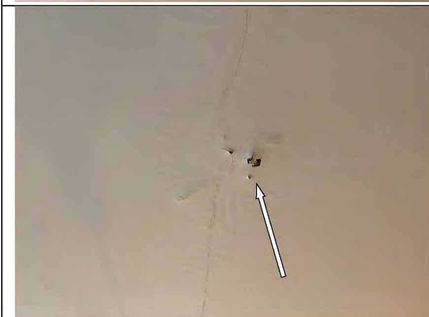
Фото №45. Следы залития на поверхности окрашенного потолка в спальне.
