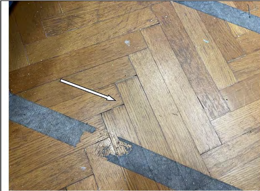
Фото №61. Поднятые кромки досок паркета в спальне.
