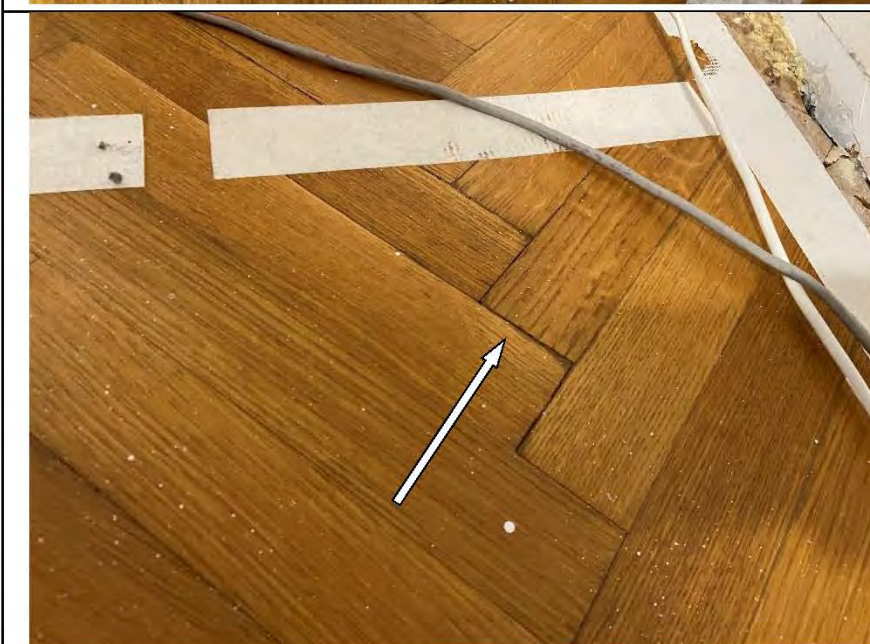
Фото №63. Поднятые кромки досок паркета в спальне.
