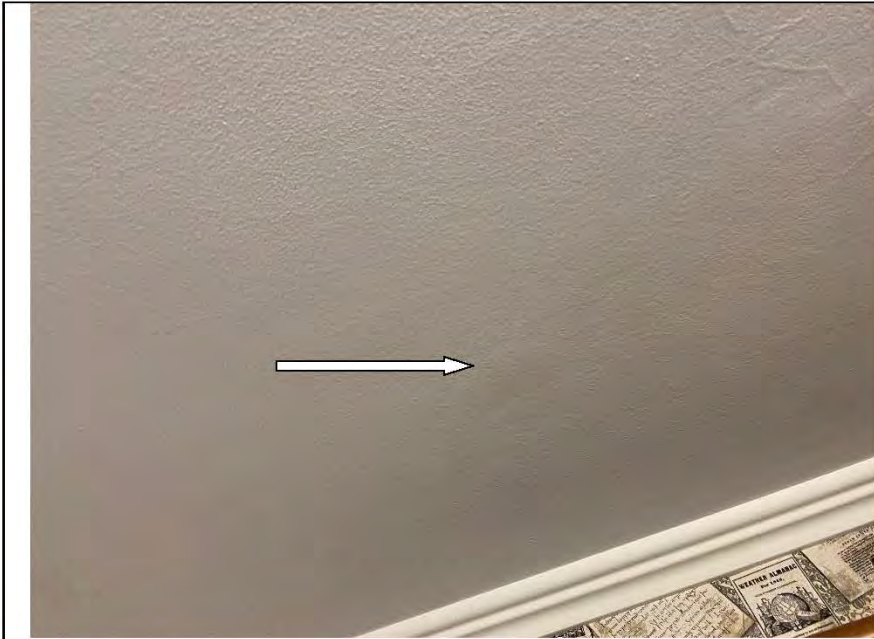
Фото №40. Следы залития на поверхности окрашенного потолка в кухне.
