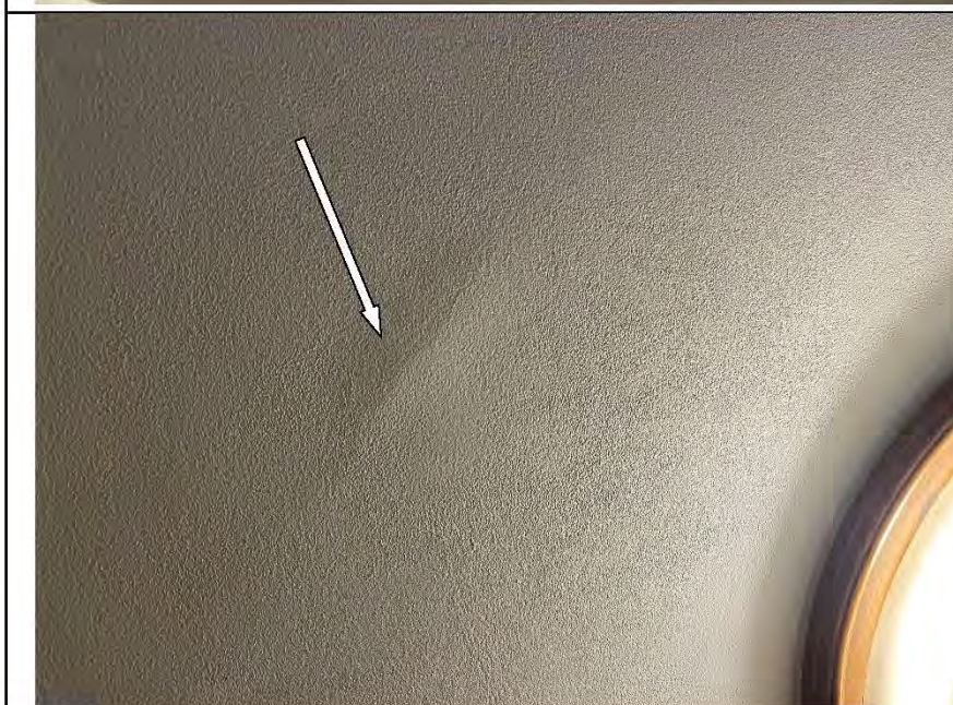
Фото №39. Следы залития на поверхности окрашенного потолка в кухне.
