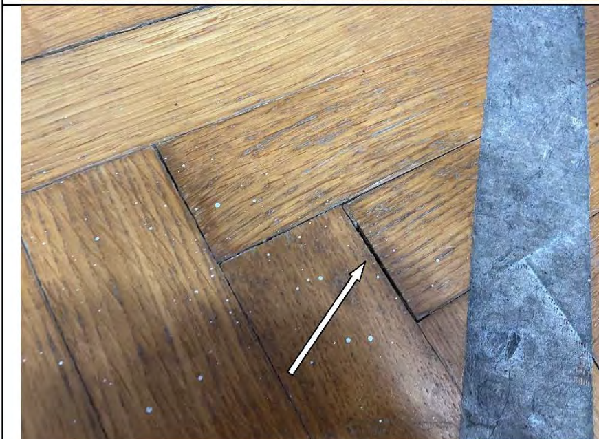
Фото №65. Поднятые кромки досок паркета в спальне.
