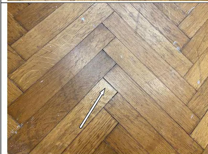
Фото №60. Поднятые кромки досок паркета в спальне.
