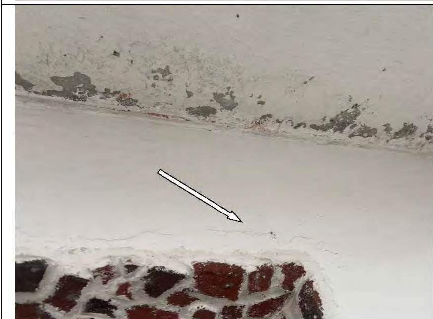
Фото №30. Следы залития на оштукатуренных стенах на балконе.
