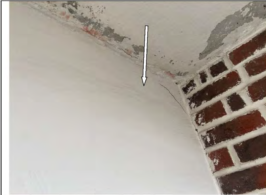
Фото №28. Следы залития на оштукатуренных стенах на балконе.
