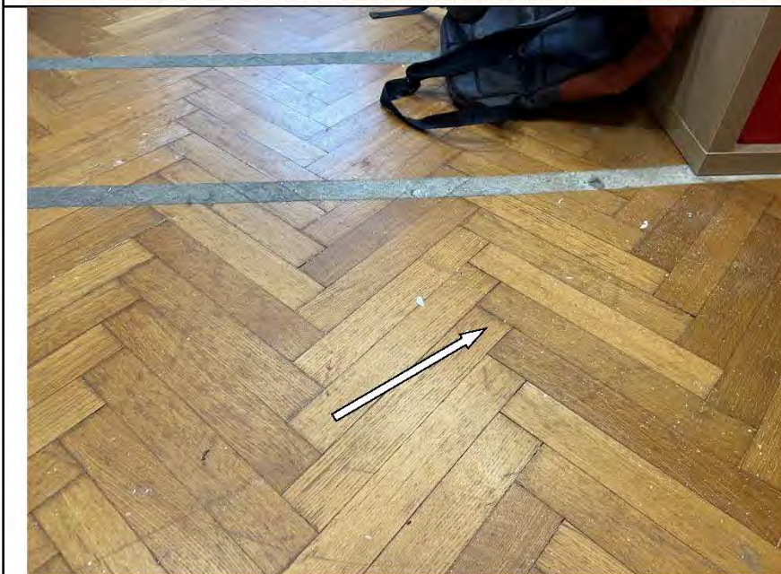
Фото №59. Поднятые кромки досок паркета в спальне.
