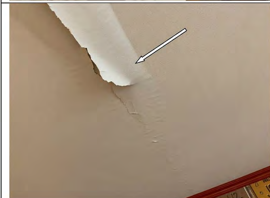
Фото №42. Следы залития на поверхности окрашенного потолка в спальне.
