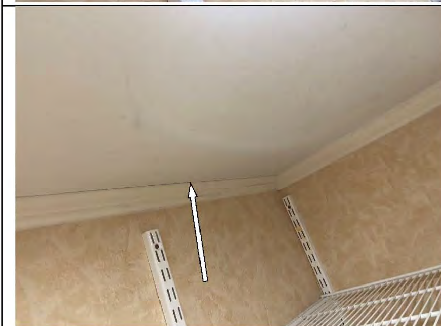
Фото №50. Следы залития на поверхности окрашенного потолка в кладовой.
