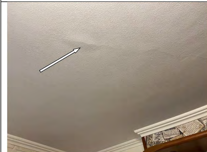
Фото №41. Следы залития на поверхности окрашенного потолка в кухне.
