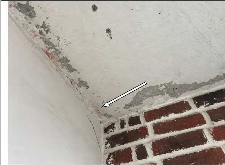
Фото №52. Следы залития на поверхности оштукатуренного потолка на балконе.
