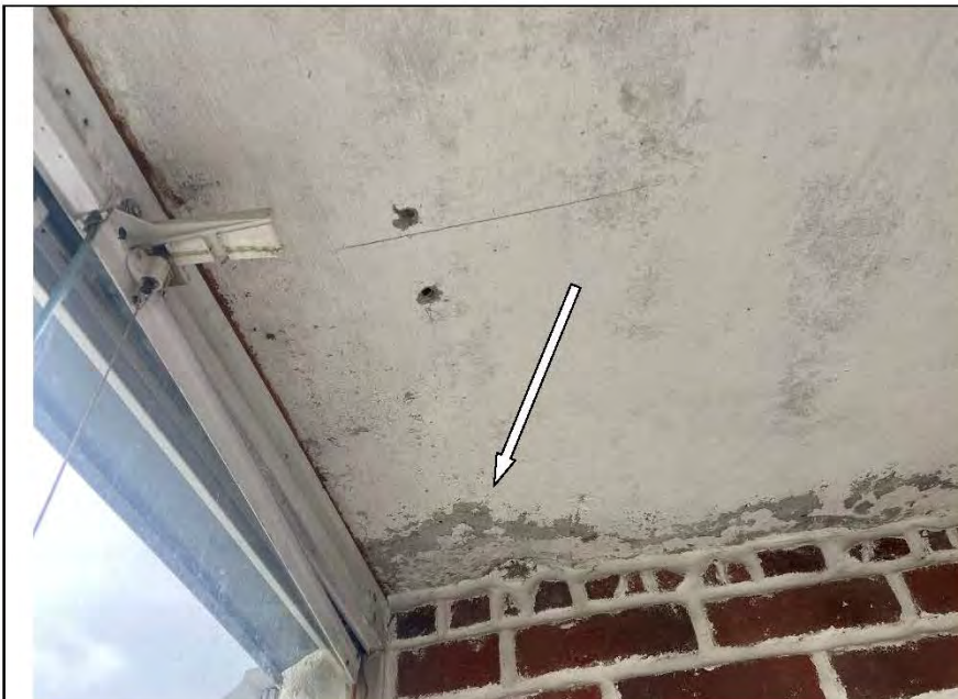
Фото №55. Следы заливки на поверхности оштукатуренного потолка на балконе.
