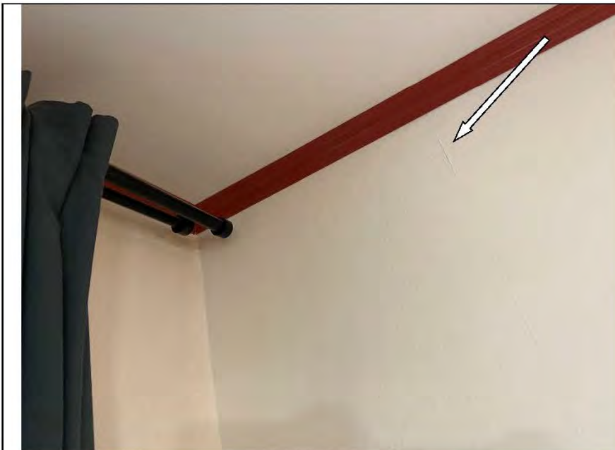
Фото №22. Следы заливания на стенах, оклеенных обоями, в спальне.
