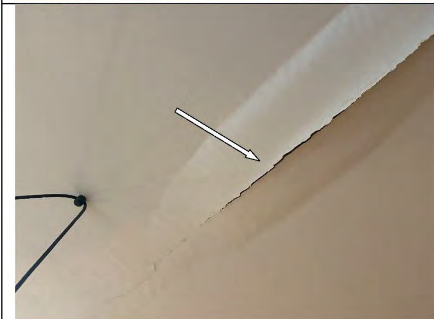
Фото №44. Следы залития на поверхности окрашенного потолка в спальне.
