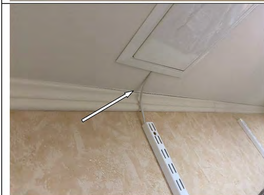
Фото №48. Следы залития на поверхности окрашенного потолка в кладовой.
