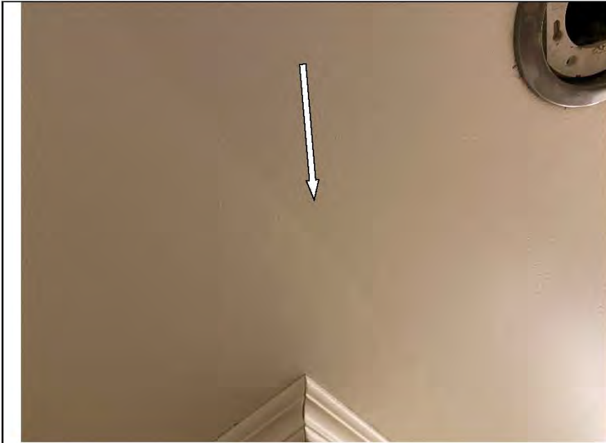
Фото №34. Следы залития на поверхности окрашенного потолка в коридоре.
