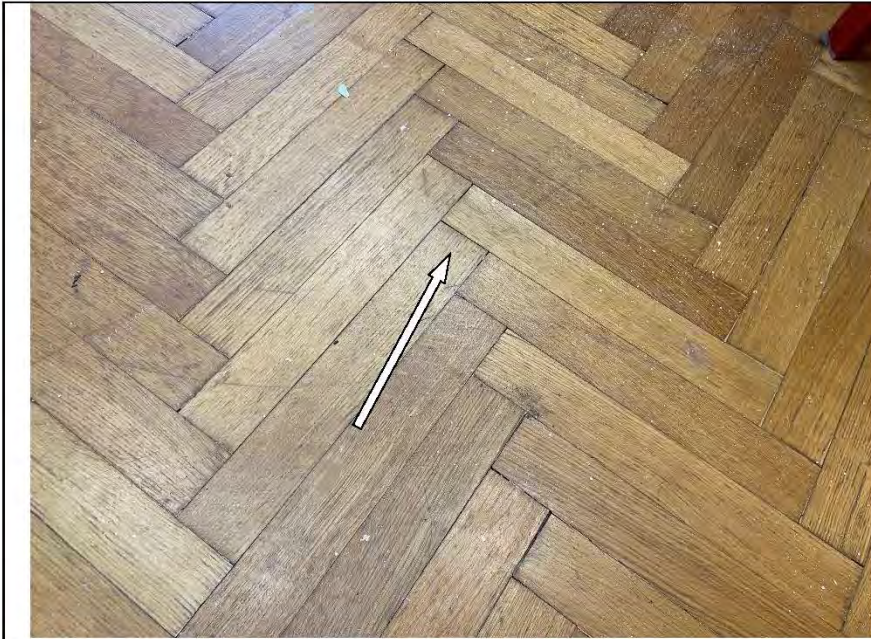
Фото №58. Поднятые кромки досок паркета в спальне.
