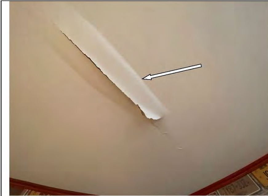
Фото №43. Следы залития на поверхности окрашенного потолка в спальне.
