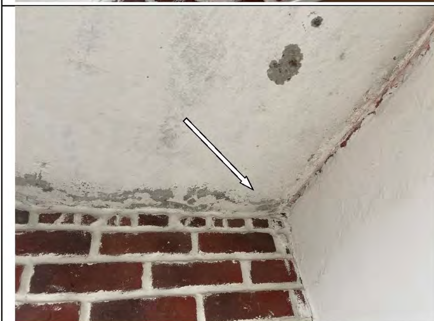
Фото №54. Следы залития на поверхности оштукатуренного потолка на балконе.
