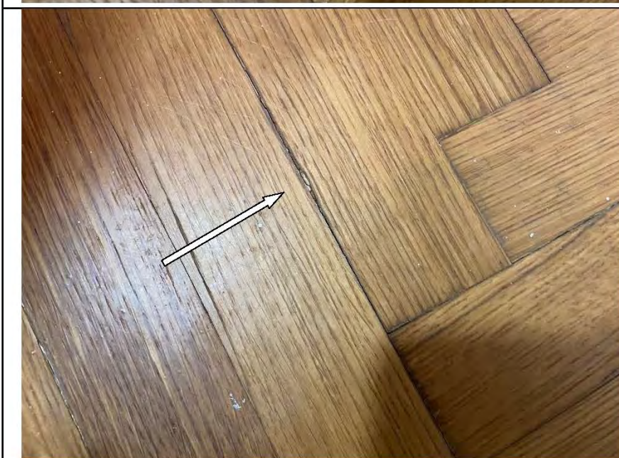
Фото №57. Поднятые кромки досок паркета в спальне.
