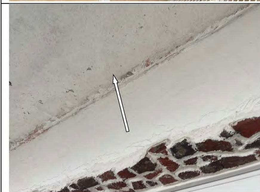
Фото №51. Следы залития на поверхности оштукатуренного потолка на балконе.
