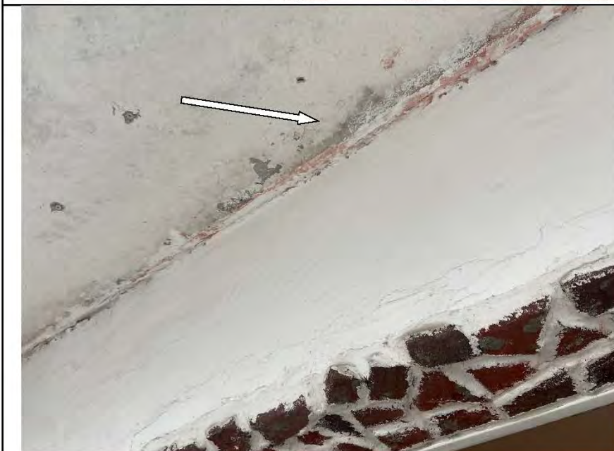
Фото №53. Следы залития на поверхности оштукатуренного потолка на балконе.
