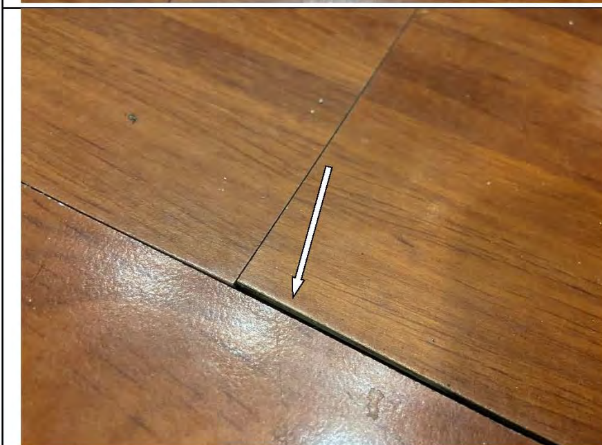
Фото №69. Поднятые кромки досок ламината в кладовой.
