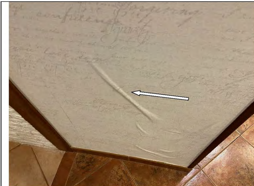
Фото №13. Следы залития на стенах, оклеенных обоями, в коридоре.
