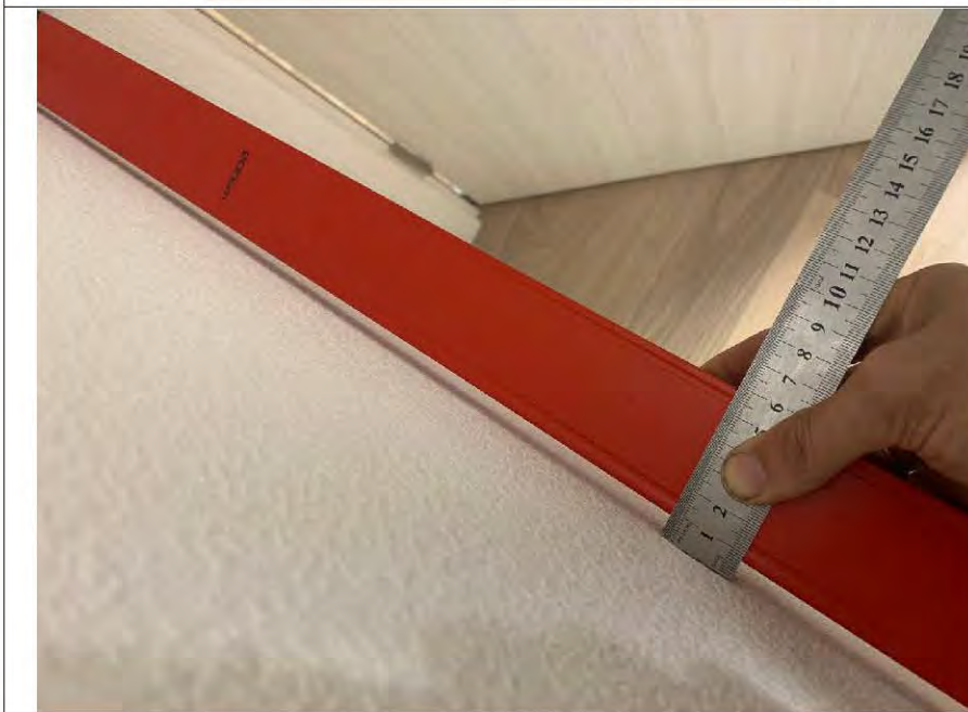
Фото №20. Отклонение поверхности стены в комнате от горизонтали
