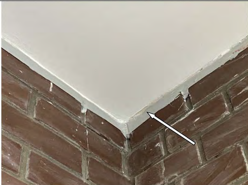
Фото №103. Дефект на поверхности окрашенного потолка на лоджии.
