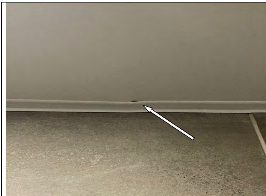
Фото №100. Дефект на поверхности натяжного потолка в санузле.
