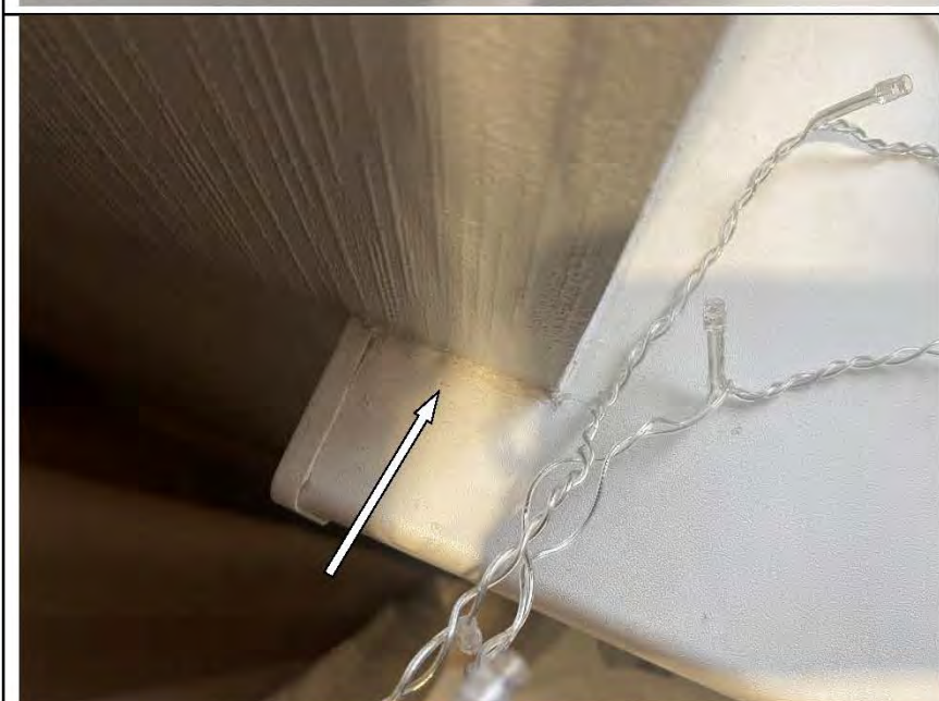
Фото №53. Дефект на лицевой стороне подоконной доски оконного блока ПВХ в кухне.
