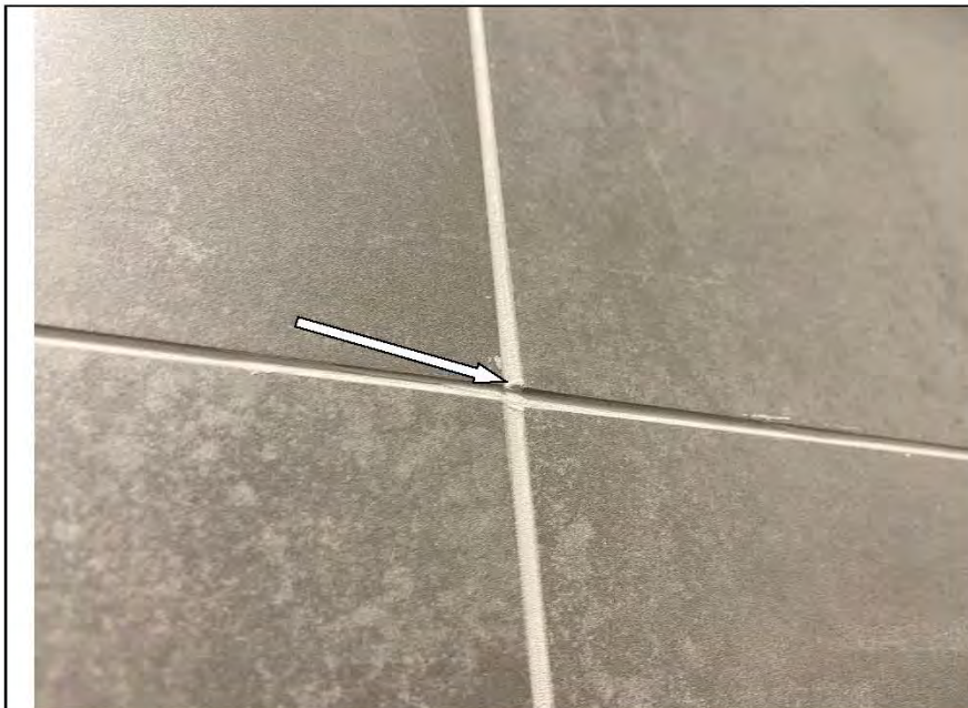
Фото №22. Уступы на настенной керамической плитке в санузле.
