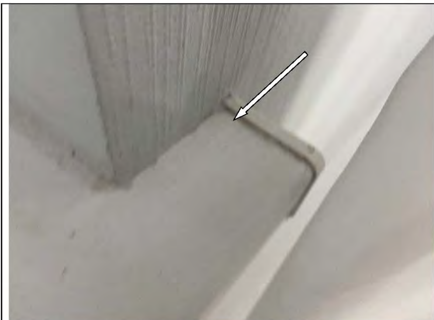
Фото №52. Дефект на лицевой стороне подоконной доски оконного блока ПВХ в гостиной.
