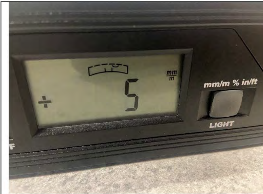
Фото №31. Отклонение поверхности напольного покрытия из керамической плитки в кухне.
