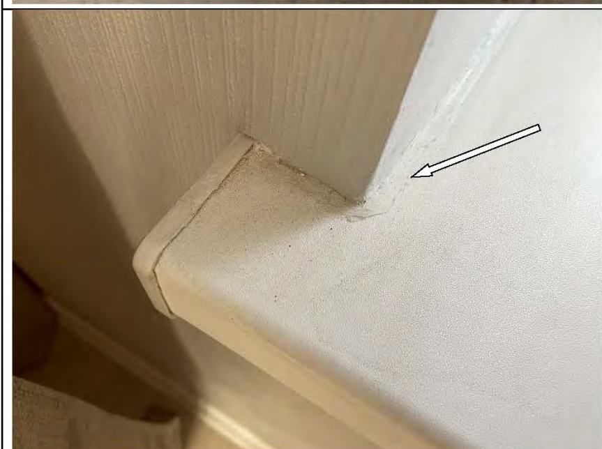
Фото №50. Дефект на лицевой стороне подоконной доски оконного блока ПВХ в спальне.
