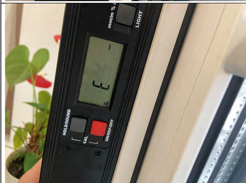
Фото №68. Отклонение от вертикали оконного блока ПВХ в спальне.
