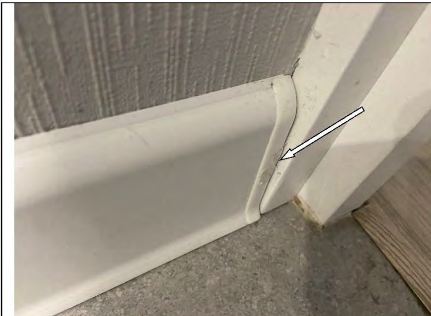
Фото №40. Дефект на напольном плинтусе ПВХ в коридоре.
