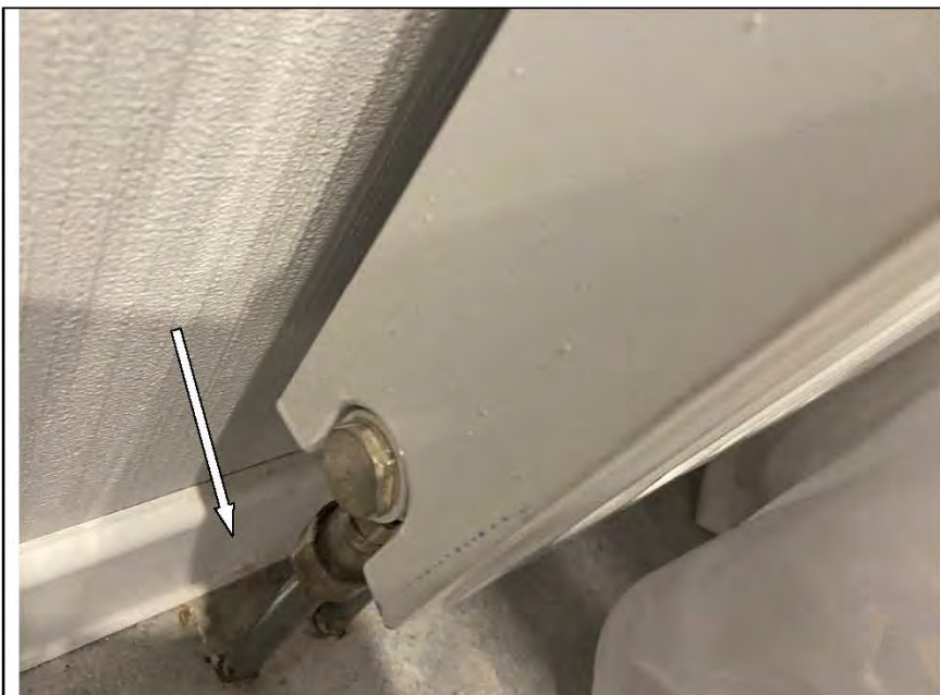
Фото №43. Дефект на напольном плинтусе ПВХ в кухне.
