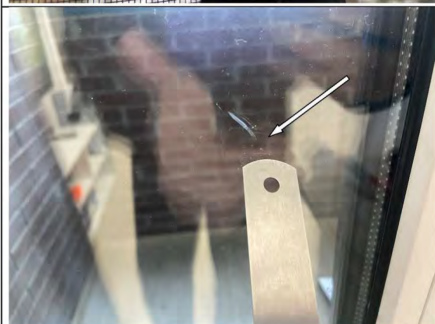
Фото №60. Царапина на стеклопакете оконного блока ПВХ в гостиной.
