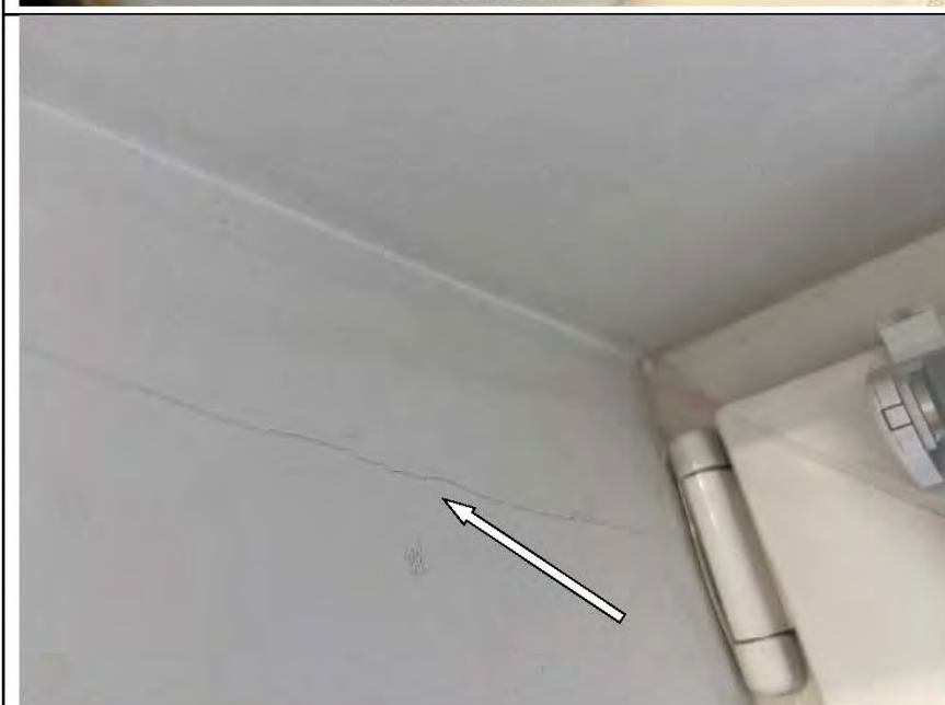
Фото №65. Трещина на окрашенных откосах оконного блока ПВХ в кухне.
