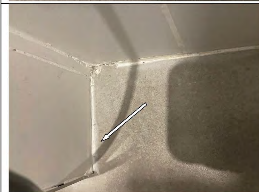
Фото №33. Загрязнения на напольной керамической плитке в ванной комнате.
