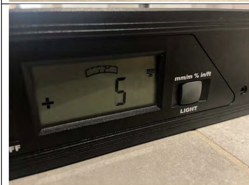
Фото №30. Отклонение поверхности напольного покрытия из керамической плитки в санузле.
