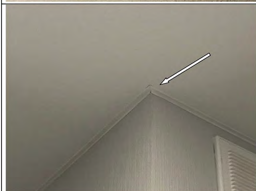
Фото №101. Дефект на поверхности натяжного потолка в кухне.
