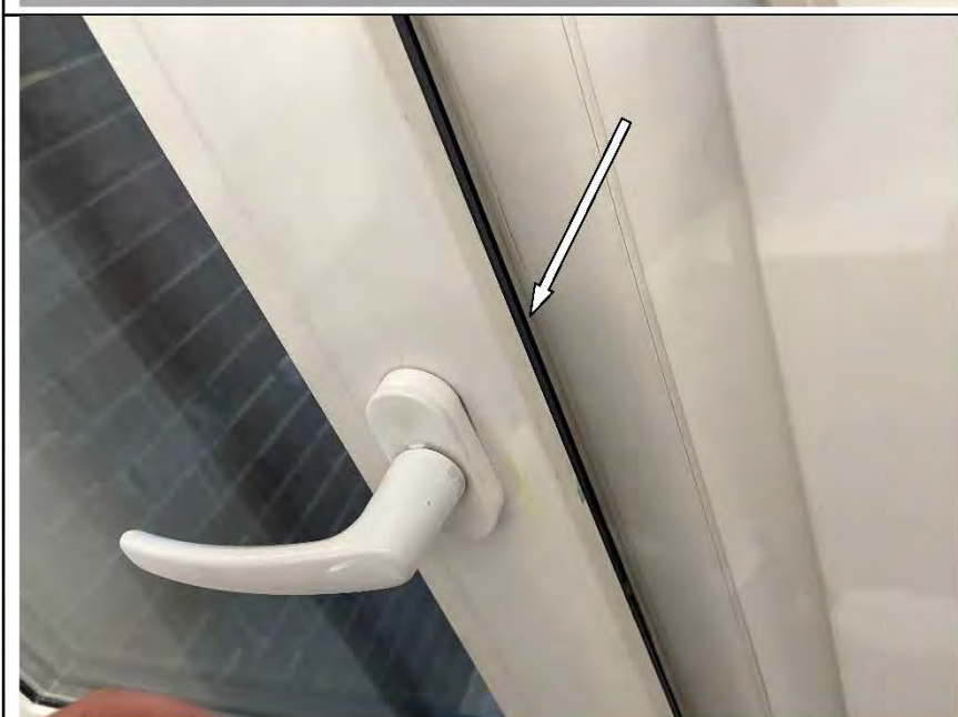
Фото №66. Не отрегулирована створка балконного блока ПВХ в гостиной.
