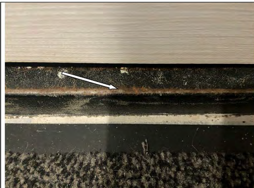
Фото №76. Дефект на коробке входного дверного блока в коридоре.
