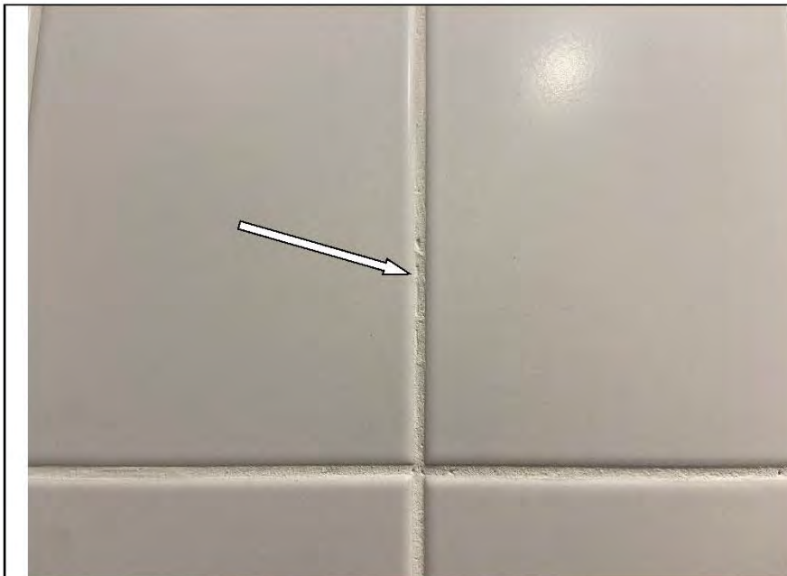
Фото №19. Неровные швы настенной керамической плитки в ванной комнате.
