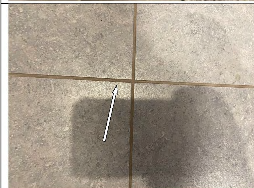
Фото №39. Неровные швы напольной керамической плитки в кухне.
