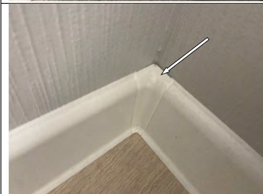
Фото №41. Дефект на напольном плинтусе ПВХ в спальне.
