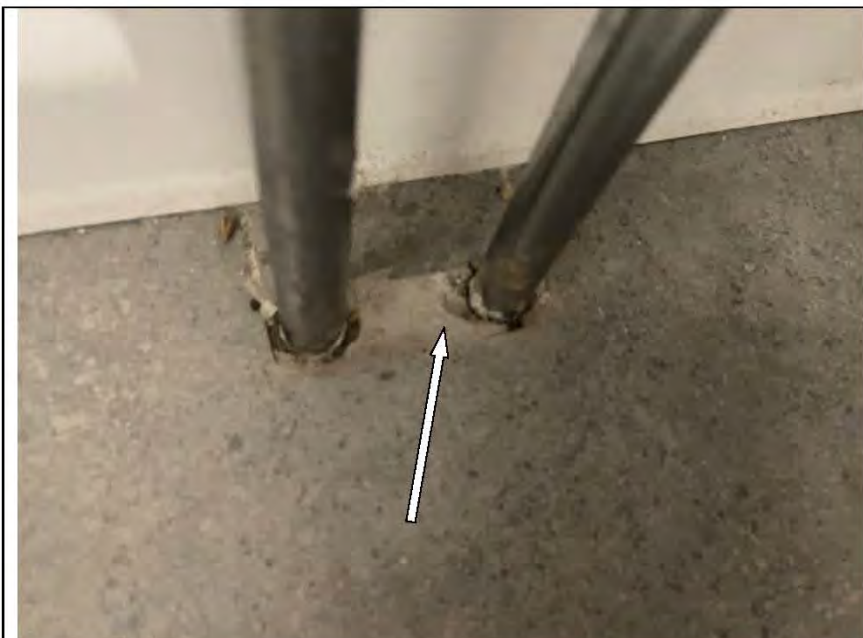
Фото №49. Дефект вставки труб отопления в напольное покрытие из керамической плитки в кухне.
