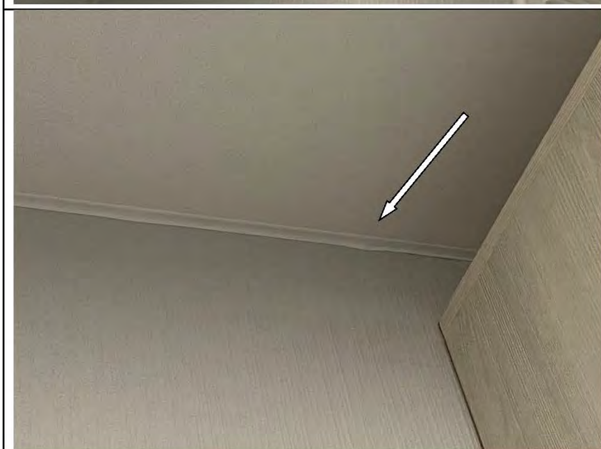
Фото №102. Дефект на поверхности натяжного потолка в гостиной.
