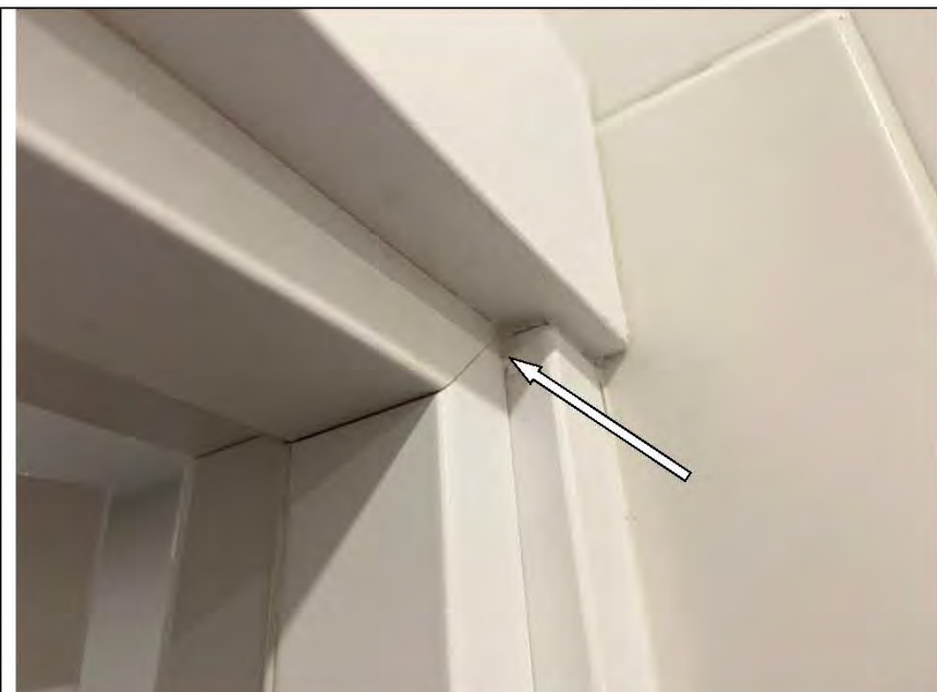
Фото №94. Дефект на коробке деревянного дверного блока в ванной комнате.
