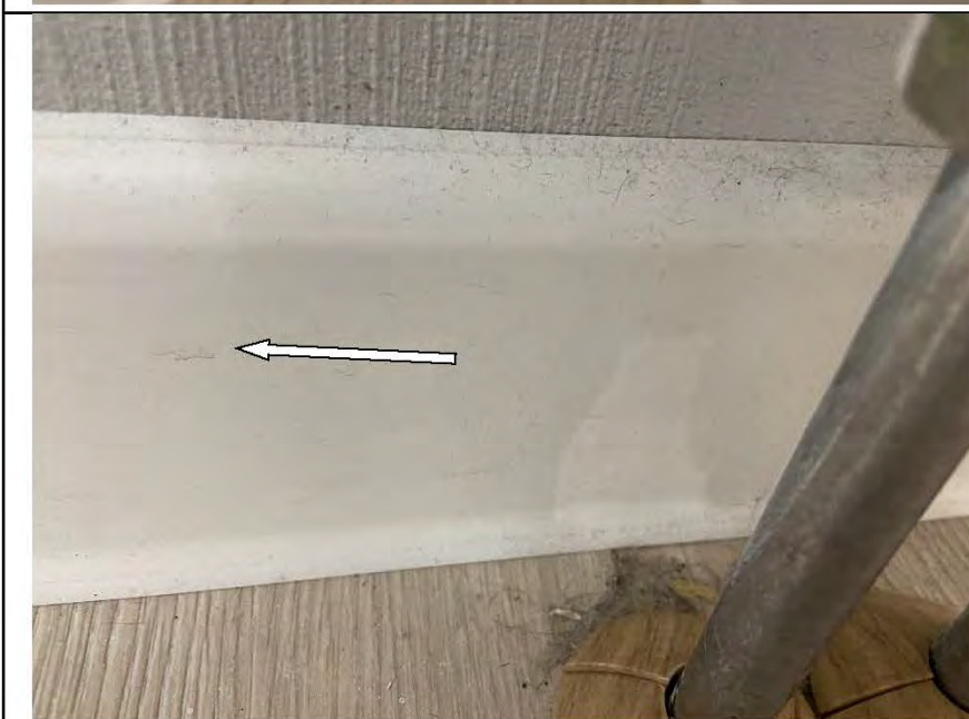
Фото №42. Дефект на напольном плинтусе ПВХ в гостиной.
