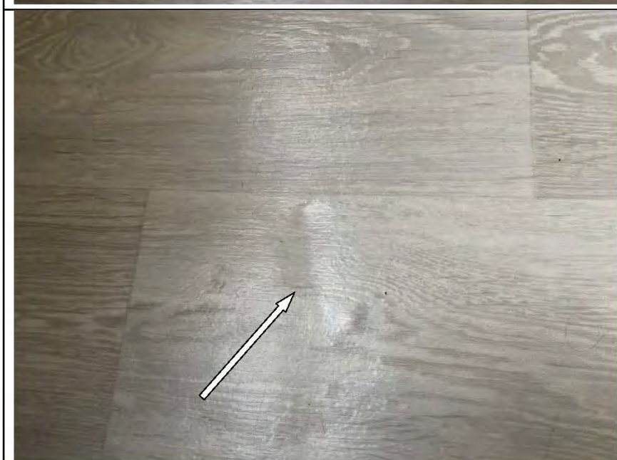
Фото №48. Впадины на поверхности напольного покрытия из линолеума на лоджии.
