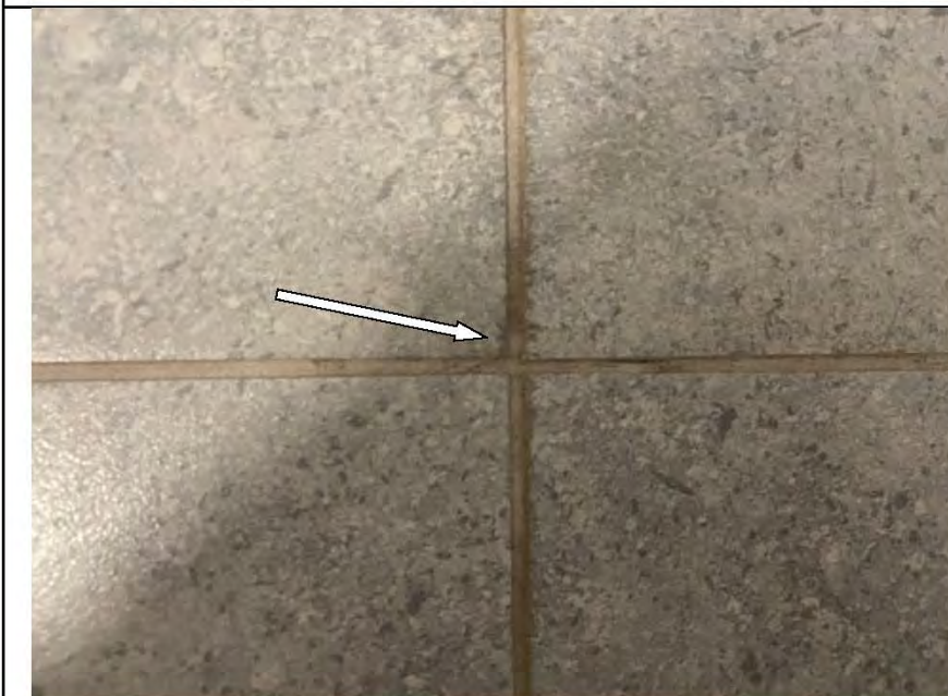
Фото №36. Неровные швы напольной керамической плитки в коридоре.
