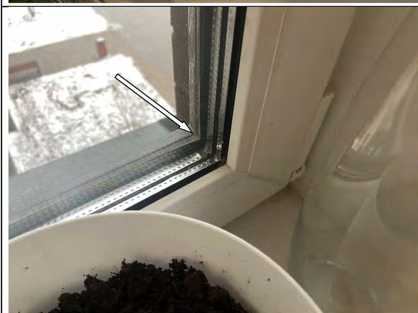
Фото №72. Дефект на уплотнительной ленте оконного блока ПВХ в кухне.
