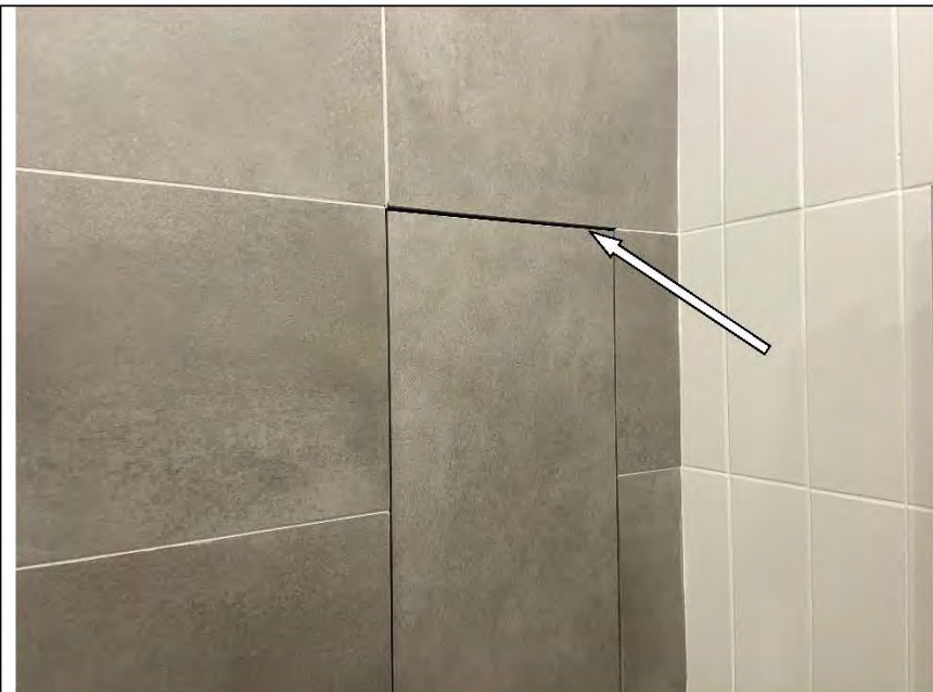
Фото №106. Свободно не открывается/закрывается сантехнический люк в ванной комнате.
