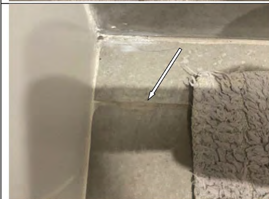
Фото №38. Неровные швы напольной керамической плитки в санузле.
