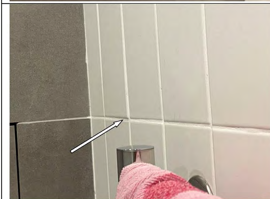
Фото №21. Уступы на настенной керамической плитке в ванной комнате.
