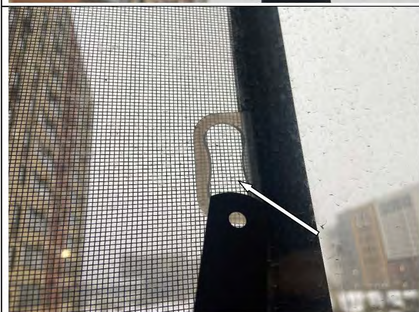
Фото №59. Царапина на стеклопакете оконного блока ПВХ на лоджии.
