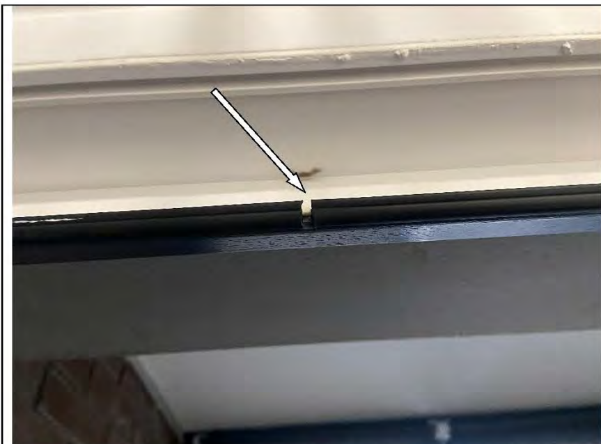
Фото №70. Дефект на уплотнительной ленте оконного блока ПВХ в гостиной.
