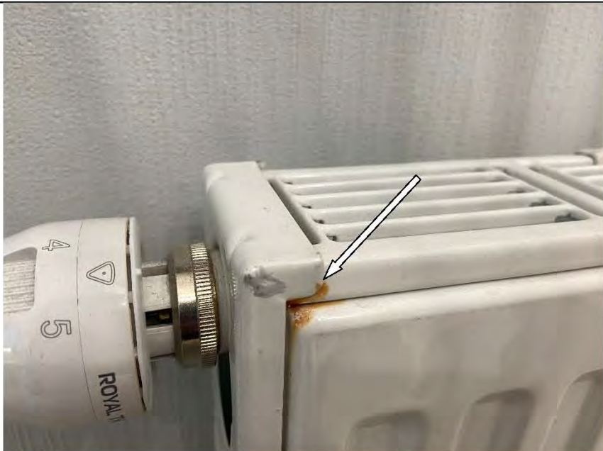
Фото №104. Дефекты на поверхности металлического кожуха отопительного прибора в гостиной.
