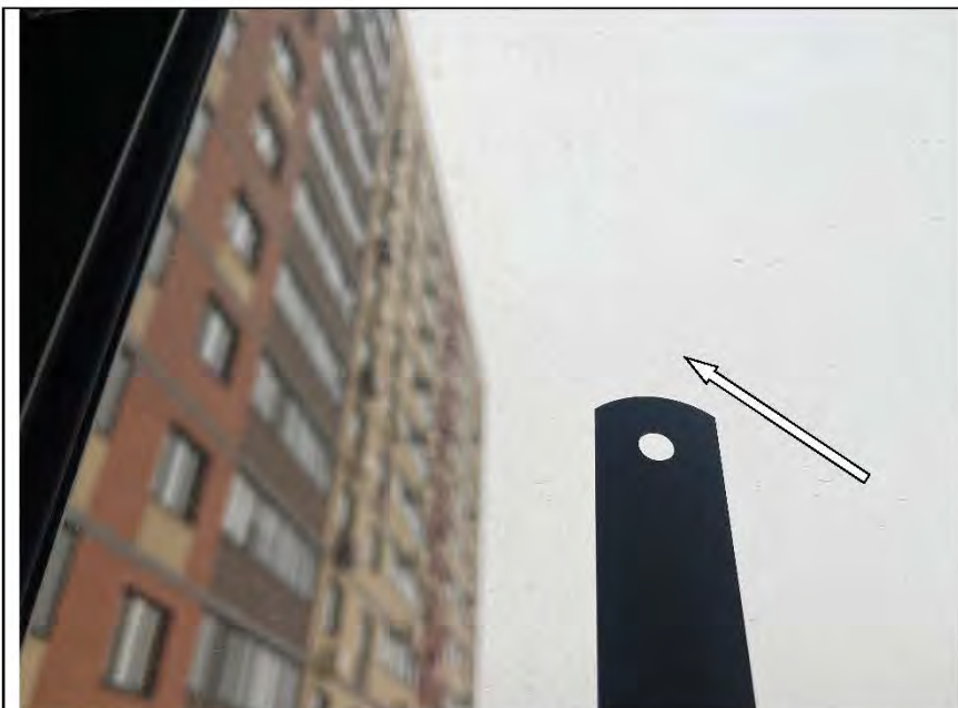
Фото №58. Царапина на стеклопакете оконного блока ПВХ на лоджии.
