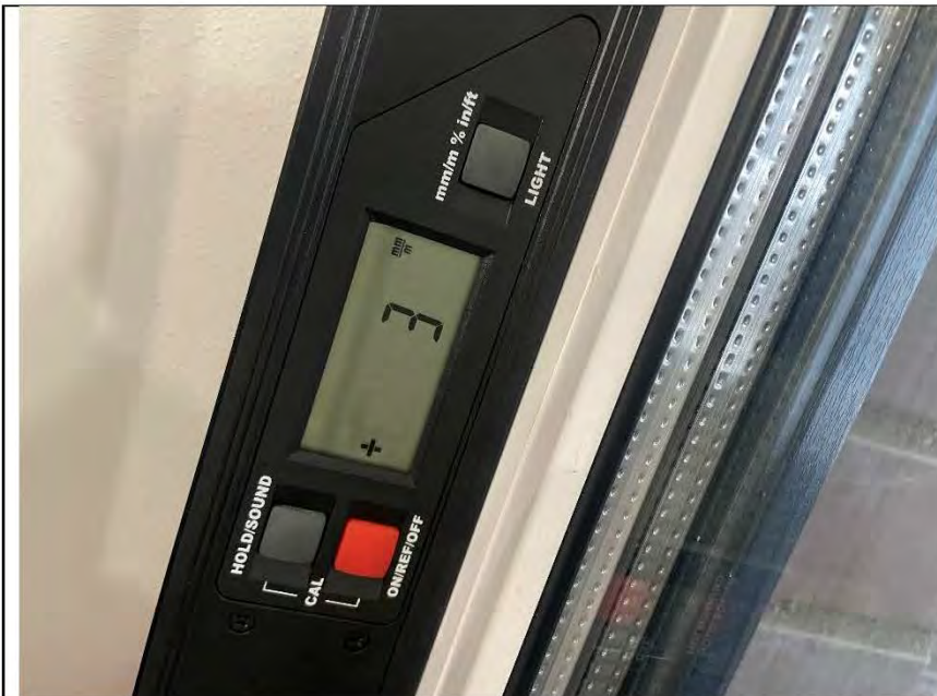
Фото №67. Отклонение от вертикали оконного блока ПВХ в гостиной.
