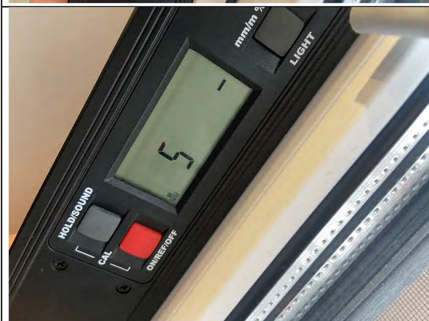
Фото №69. Отклонение от вертикали оконного блока ПВХ в кухне.
