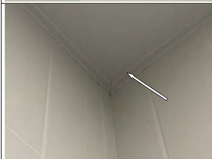
Фото №99. Дефект на поверхности натяжного потолка в ванной комнате.
