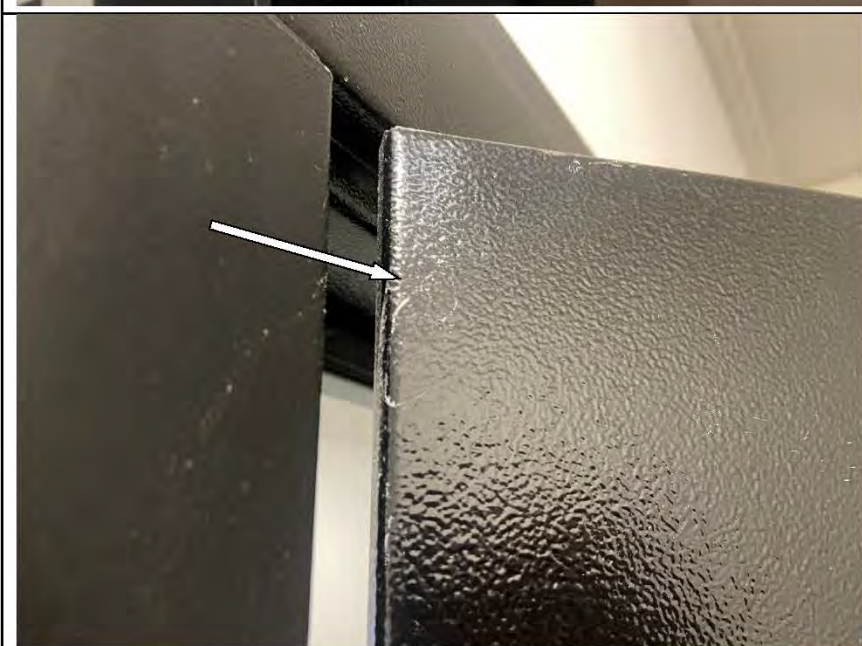
Фото №78. Дефект на полотне входного дверного блока в коридоре.
