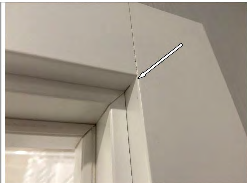
Фото №88. Дефект на наличниках деревянного дверного блока в ванной комнате.
