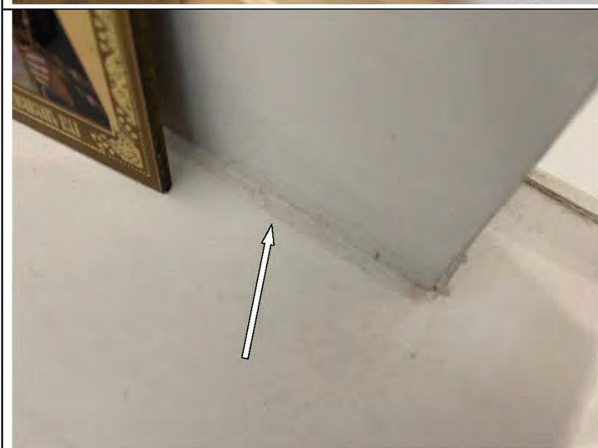
Фото №51. Дефект на лицевой стороне подоконной доски оконного блока ПВХ в гостиной.
