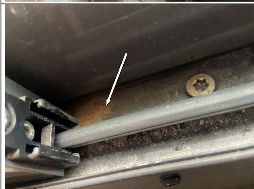
Фото №74. Коррозия на алюминиевом профиле оконного блока на лоджии.
