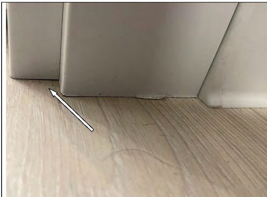
Фото №46. Дефект на напольном покрытии из ламината в кладовой.
