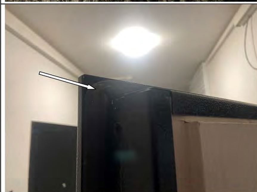
Фото №77. Дефект на уплотнительной противопожарной ленте входного дверного блока в коридоре.
