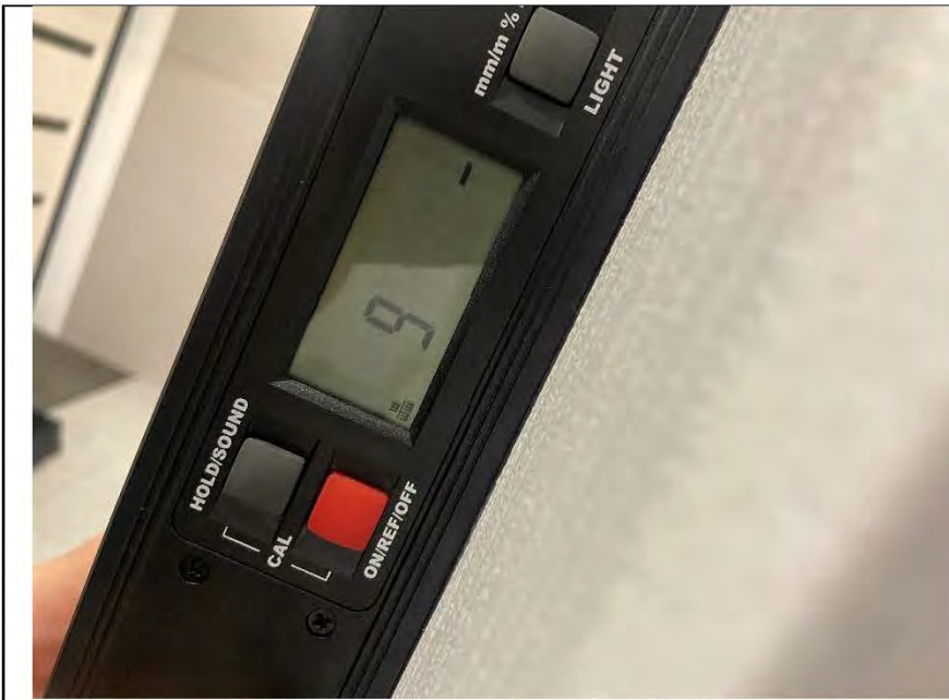
Фото №10. Отклонение поверхности стен от вертикали в коридоре.
