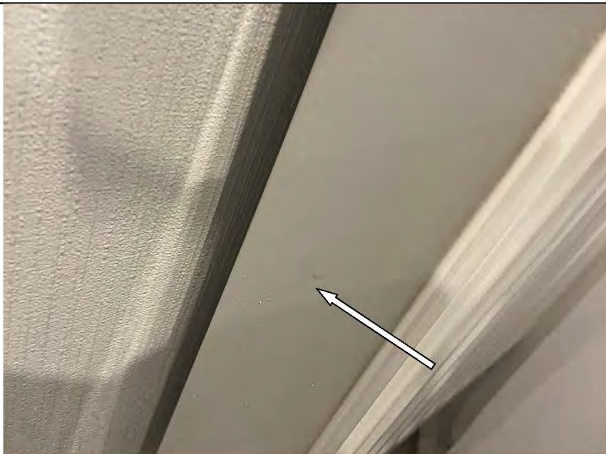
Фото №105. Дефекты на поверхности металлического кожуха отопительного прибора в кухне.
