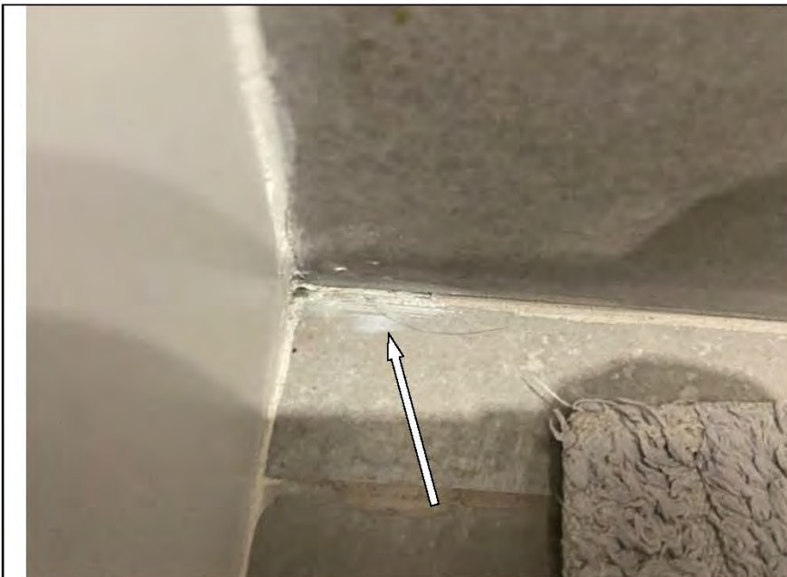
Фото №34. Загрязнения на напольной керамической плитке в санузле.
