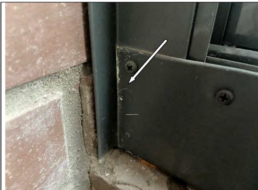
Фото №73. Дефект на алюминиевом профиле оконного блока на лоджии.
