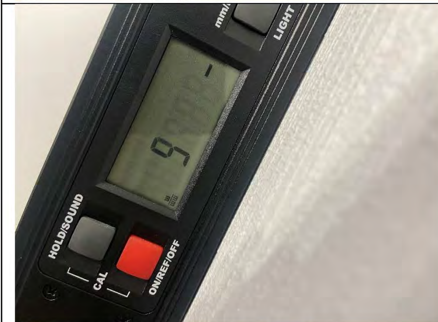
Фото №11. Отклонение поверхности стен от вертикали в гостиной.
