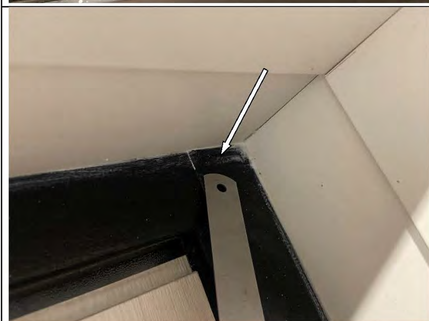
Фото №75. Дефект на коробке входного дверного блока в коридоре.
