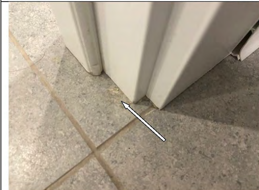
Фото №35. Загрязнения на напольной керамической плитке в кухне.
