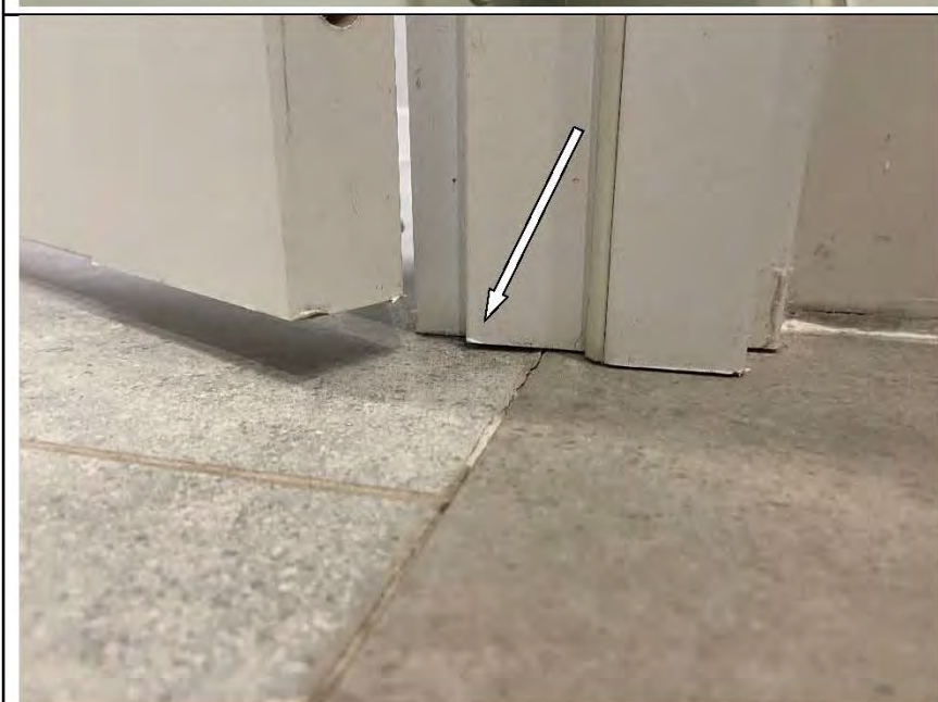
Фото №81. Дефект на полотне деревянного дверного блока в ванной комнате.
