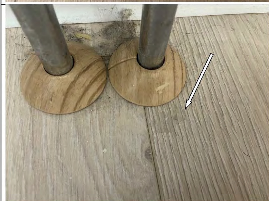
Фото №45. Дефект на напольном покрытии из ламината в гостиной.
