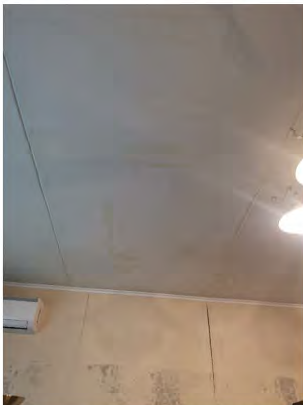
Фото 7. Комната. Потолок, следы протечки (темно-коричневые следы) на окрасочном слое
