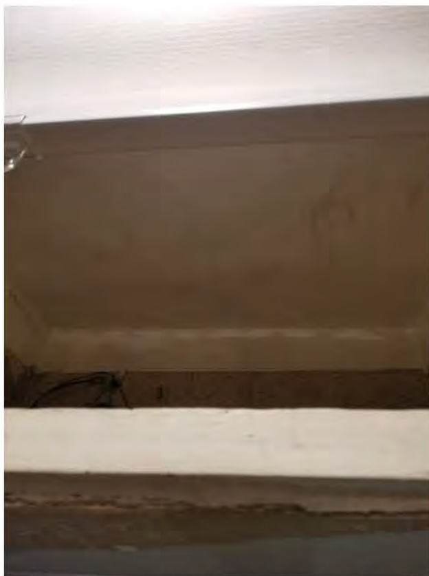
Фото 4. Коридор. Потолок, следы протечки (темно-коричневые следы) на окрасочном слое.
