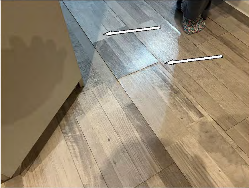
Фото №13. Вздутие лицевой поверхности досок ламината в коридоре.
