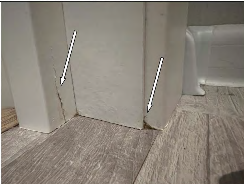
Фото №29. Расслоение коробки и наличников дверного блока в спальне.
