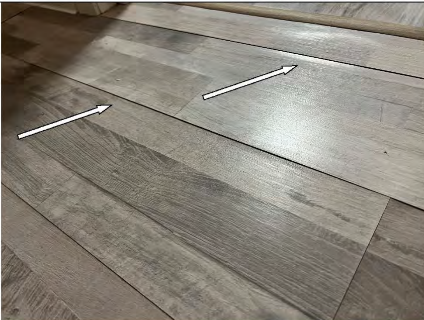
Фото №15. Вздутие лицевой поверхности досок ламината в коридоре.
