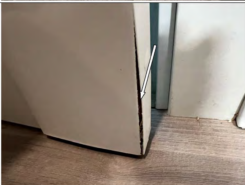
Фото №30. Расслоение полотна дверного блока в ванной комнате.
