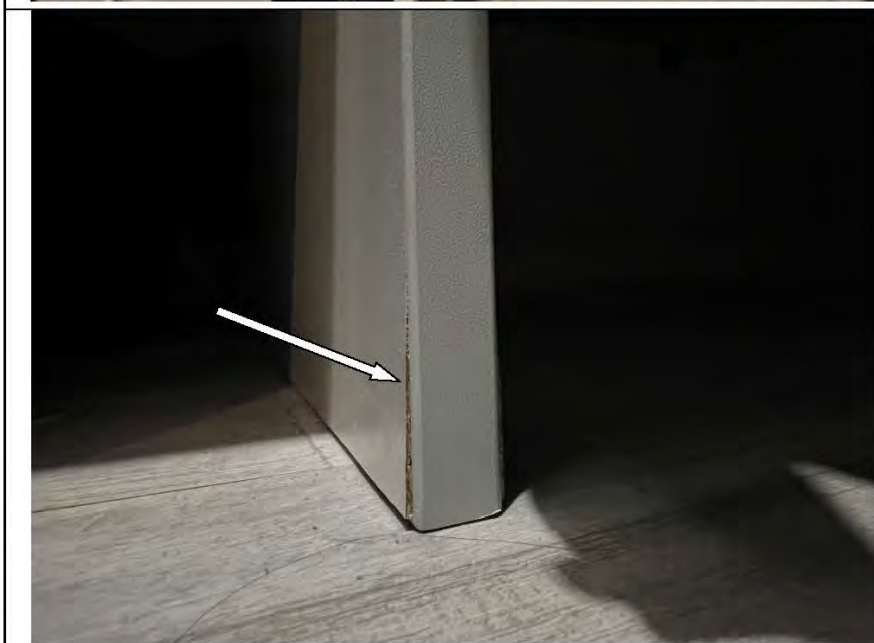
Фото №38. Вздутие стенок шкафа в гардеробной.
