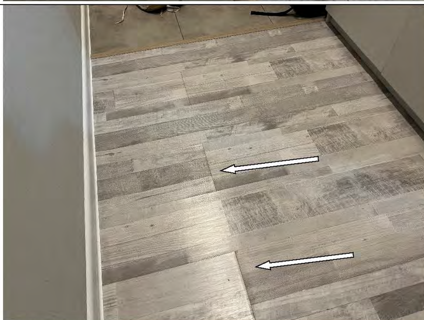
Фото №12. Вздутие лицевой поверхности досок ламината в коридоре.
