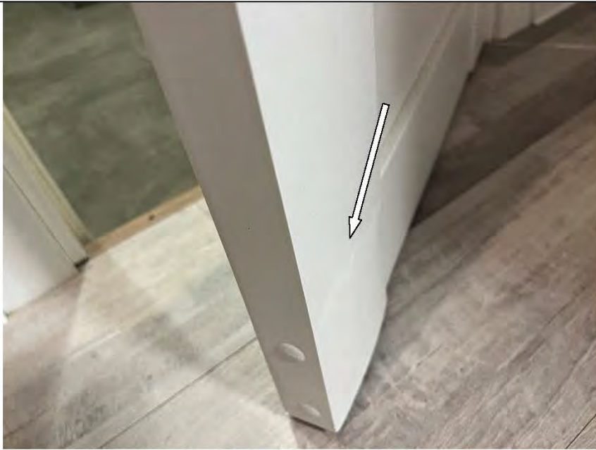
Фото №31. Расслоение полотна дверного блока в санузле.
