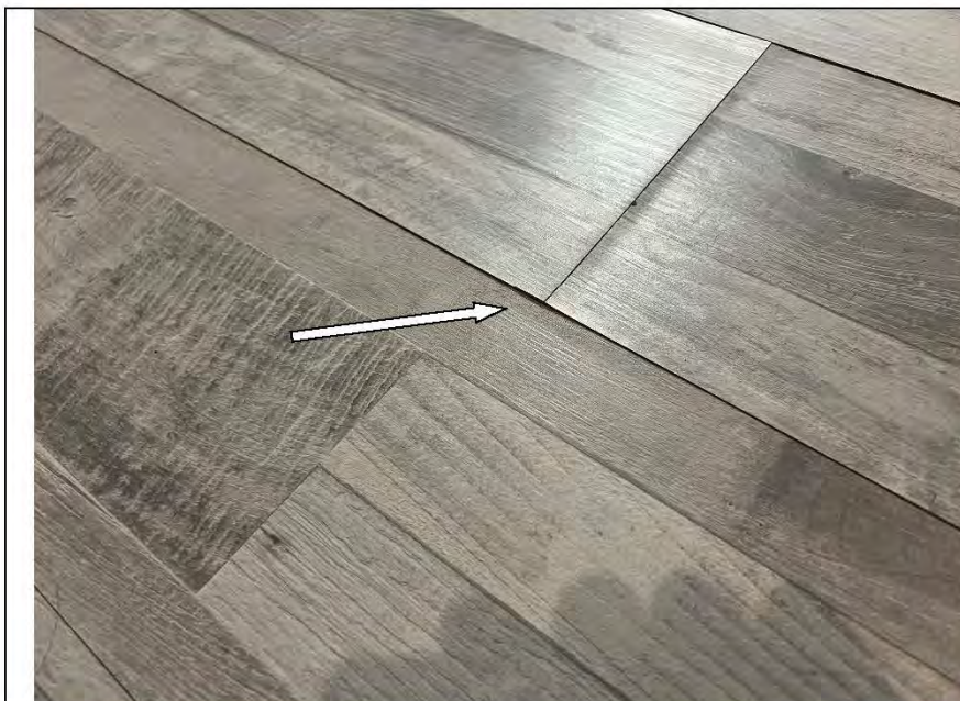
Фото №16. Вздутие лицевой поверхности досок ламината в коридоре.
