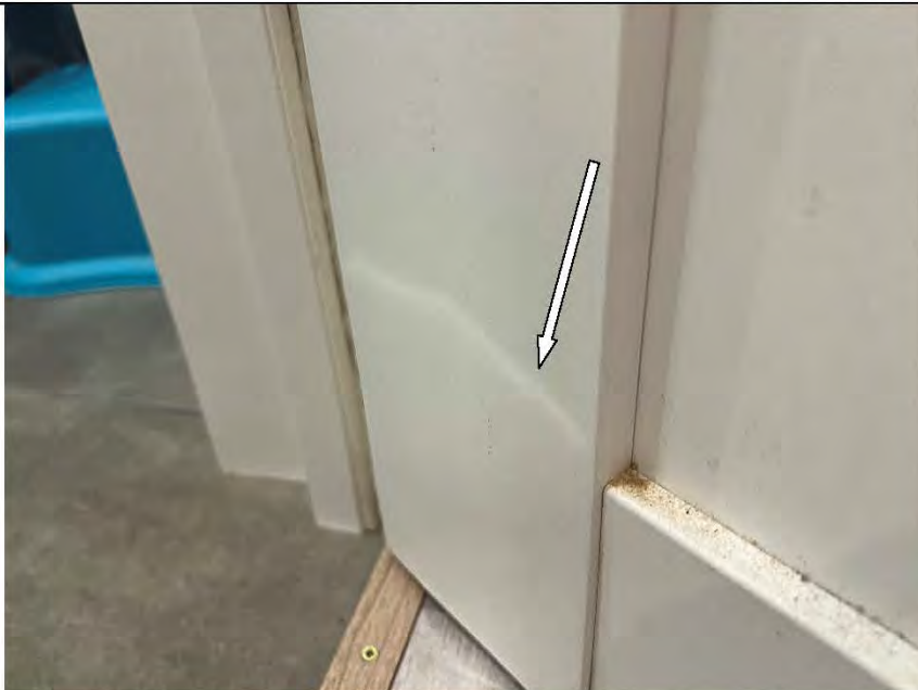
Фото №32. Расслоение полотна дверного блока в санузле.
