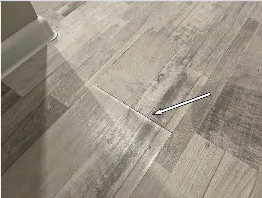
Фото №14. Вздутие лицевой поверхности досок ламината в коридоре.
