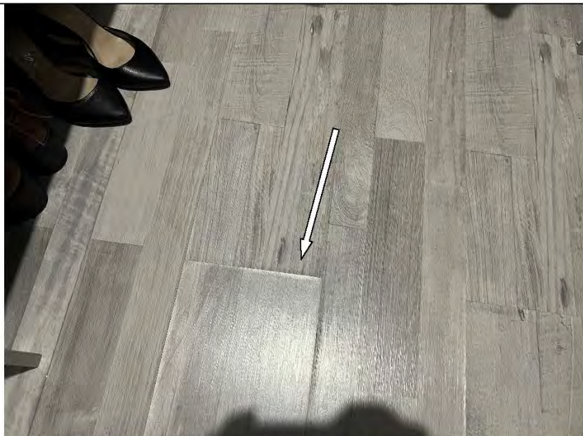
Фото №25. Вздутие лицевой поверхности досок ламината в гардеробной.
