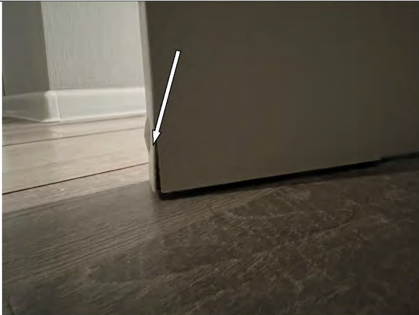
Фото №28. Расслоение полотна дверного блока в спальне.
