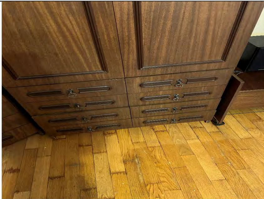
Фото №26. Общий вид шкафа, который пострадал при заливе.
