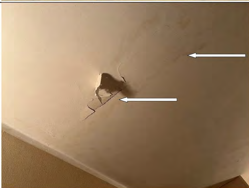
Фото №21. Отслоение краски и следы подтеков на поверхности потолка в коридоре.
