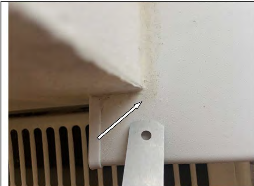
Фото №25. Дефект на лицевой стороне подоконной доски оконного блока ПВХ в общей комнате.
