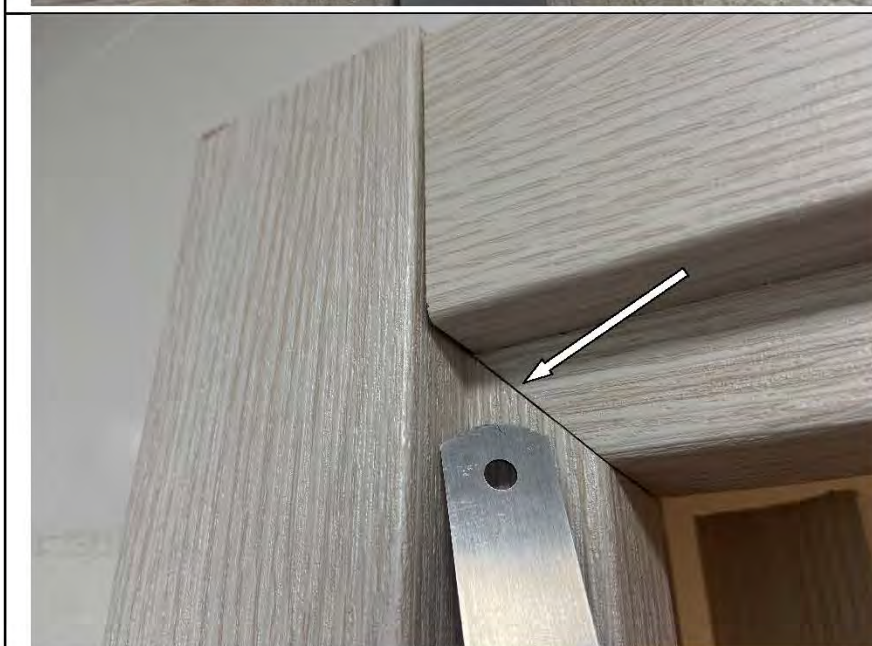
Фото №42. Дефект на коробке деревянного дверного блока в ванной комнате.
