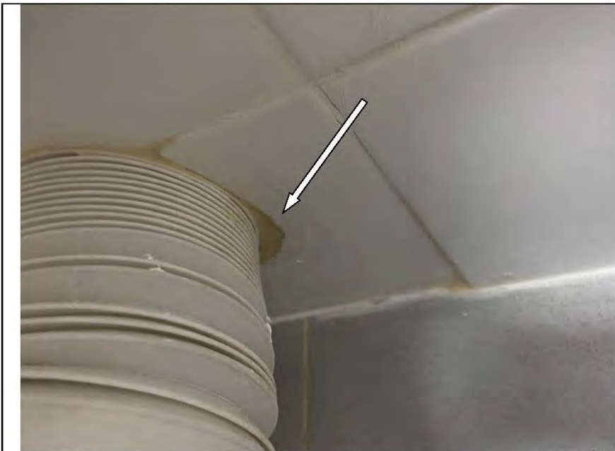
Фото №13. Отбитости настенной керамической плитки в ванной комнате.
