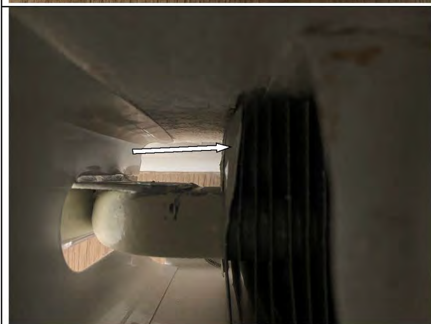
Фото №47. Загиб и загрязнения на радиаторе в общей комнате.
