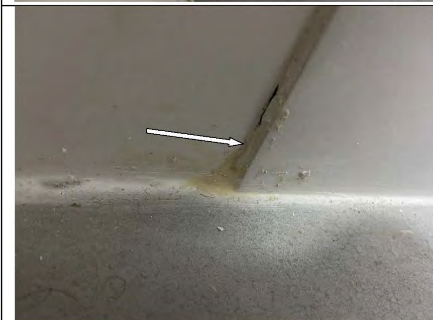
Фото №14. Уступы настенной керамической плитки в ванной комнате.
