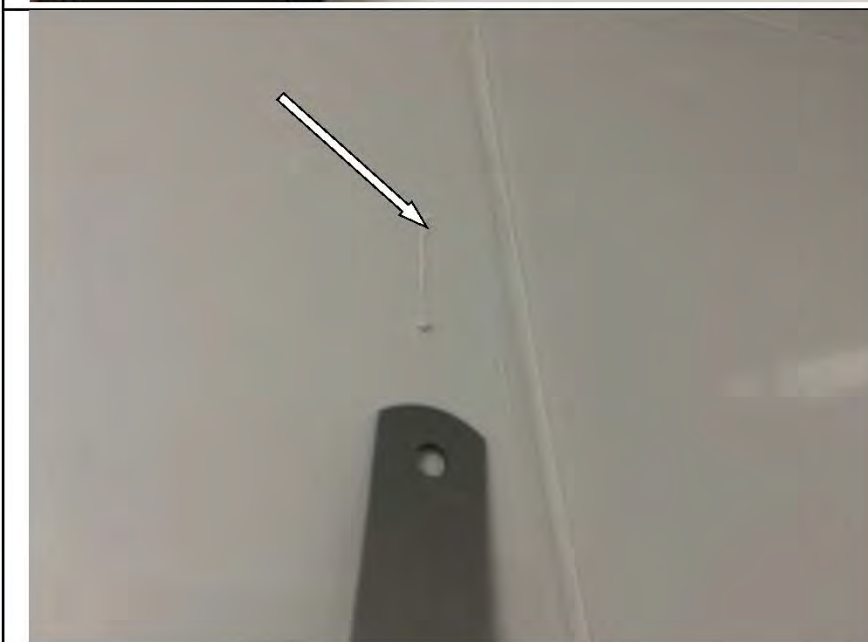
Фото №9. Загрязнение на настенной керамической плитке в ванной комнате.
