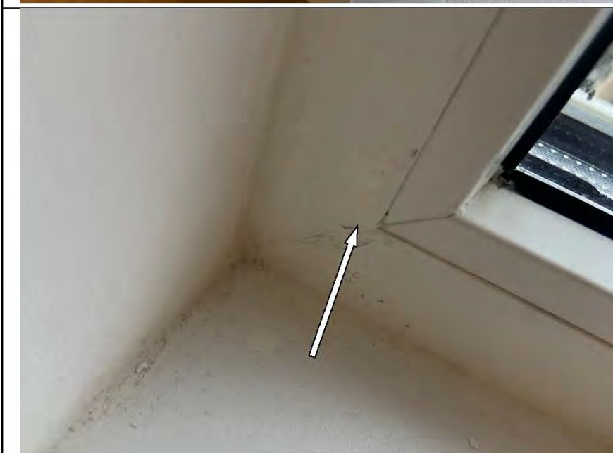
Фото №27. Загрязнения на профиле оконного блока ПВХ в общей комнате.
