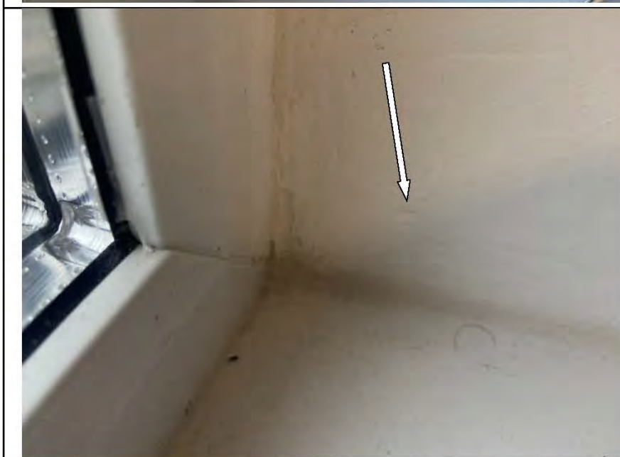
Фото №32. Неровности, выбоины, раковины на окрашенных откосах оконного блока ПВХ в общей комнате.
