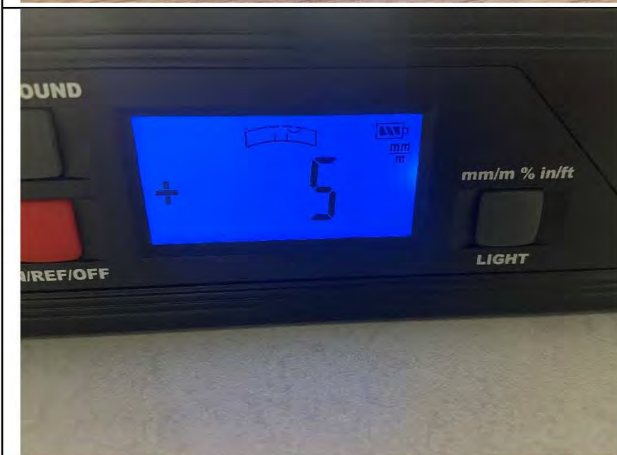
Фото №17. Отклонение поверхности напольного покрытия от плоскости в ванной комнате.
