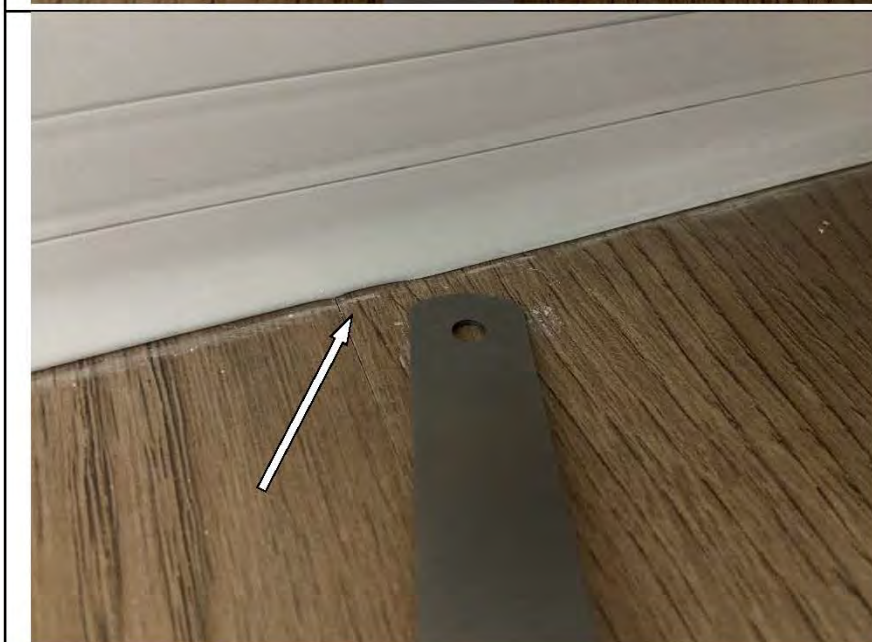
Фото №23. Дефект на напольном покрытии из ламината в общей комнате.
