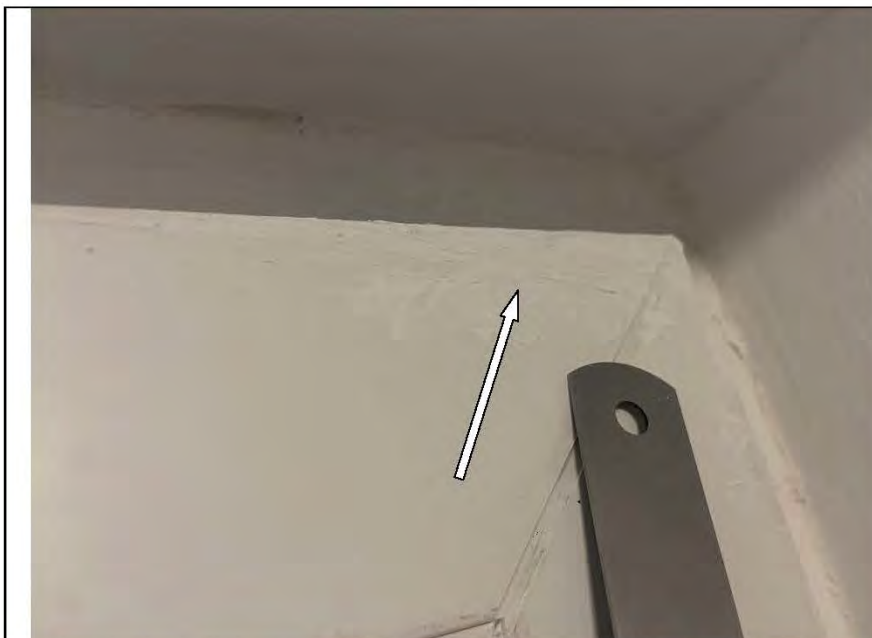
Фото №28. Загрязнения на профиле оконного блока ПВХ в общей комнате.
