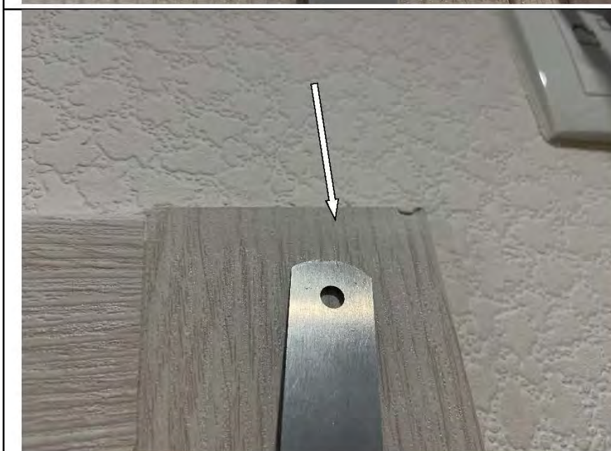
Фото №41. Дефект на наличниках деревянного дверного блока в ванной комнате.
