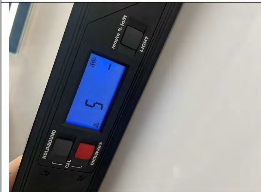
Фото №8. Отклонение по уровню вертикальности поверхности стен в ванной комнате.
