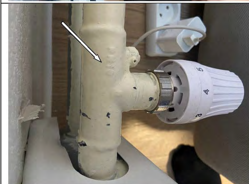
Фото №35. Неровности, подтеки, пятна на окрашенных трубах отопления в общей комнате.
