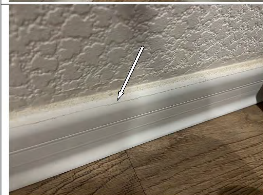
Фото №21. Дефект на напольном плинтусе ПВХ в общей комнате.
