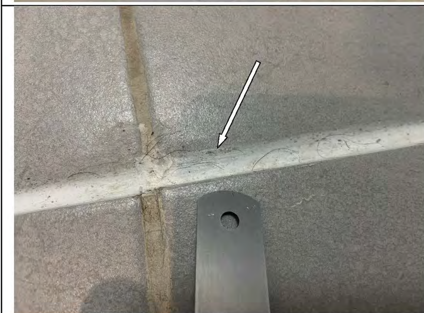
Фото №18. Загрязнения на напольной керамической плитке в ванной комнате.
