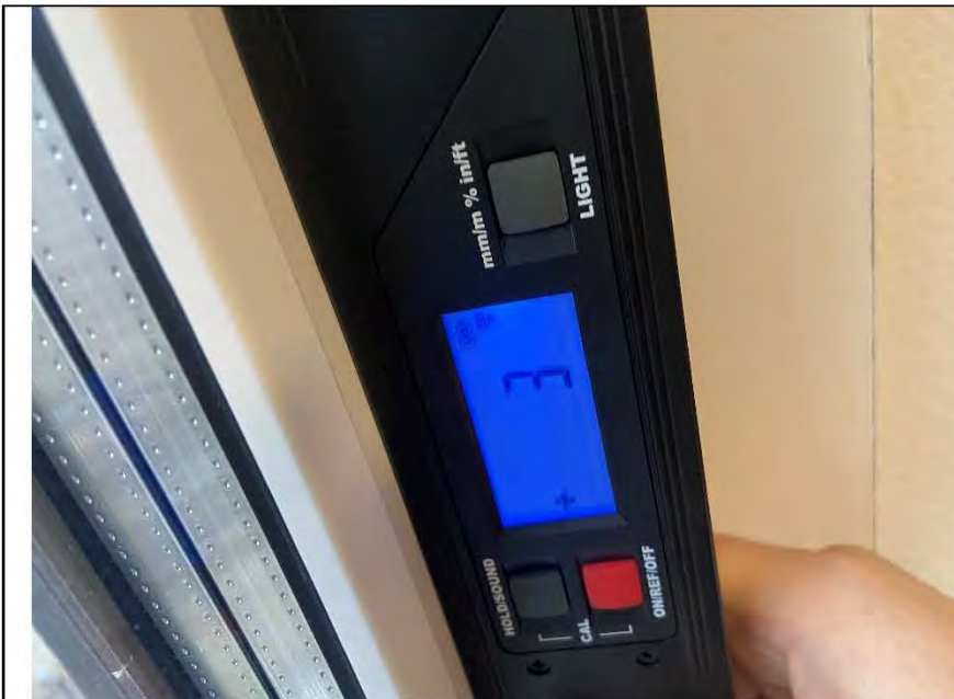
Фото №34. Отклонение от вертикали оконного блока ПВХ в общей комнате.
