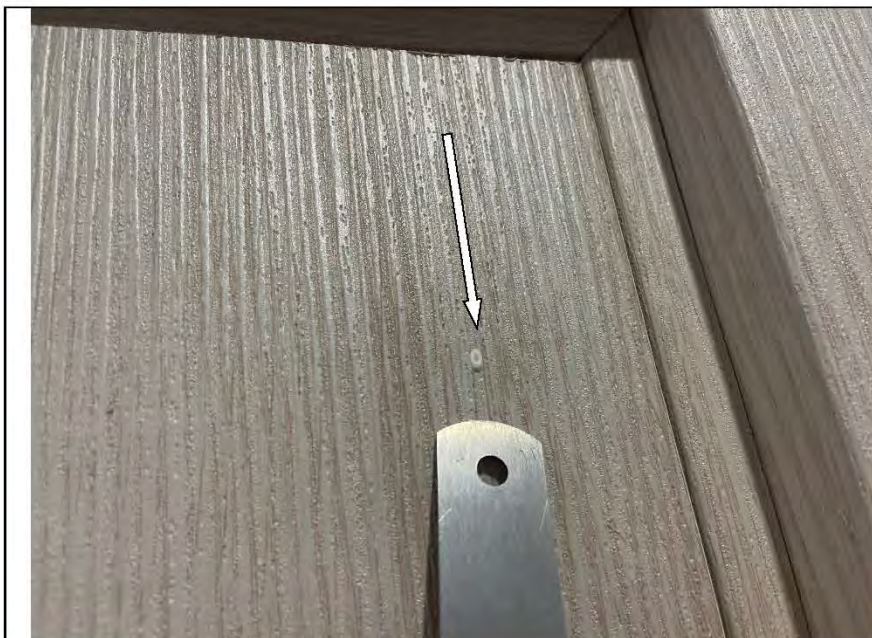
Фото №40. Дефект на полотне деревянного дверного блока в ванной комнате.
