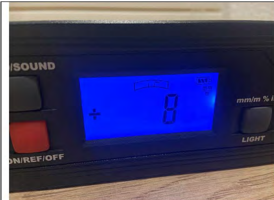
Фото №16. Отклонение поверхности напольного покрытия от плоскости в общей комнате.
