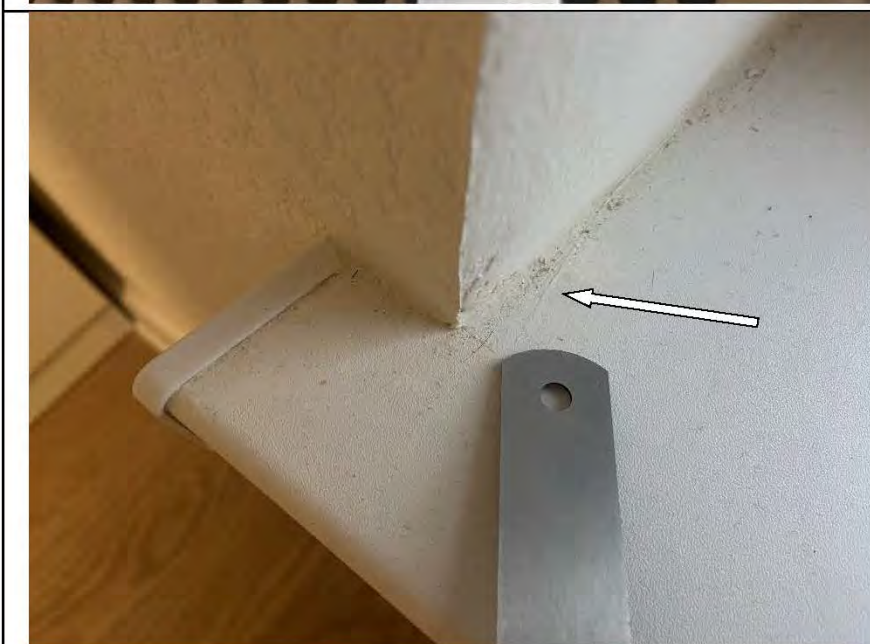
Фото №26. Дефект на лицевой стороне подоконной доски оконного блока ПВХ в общей комнате.
