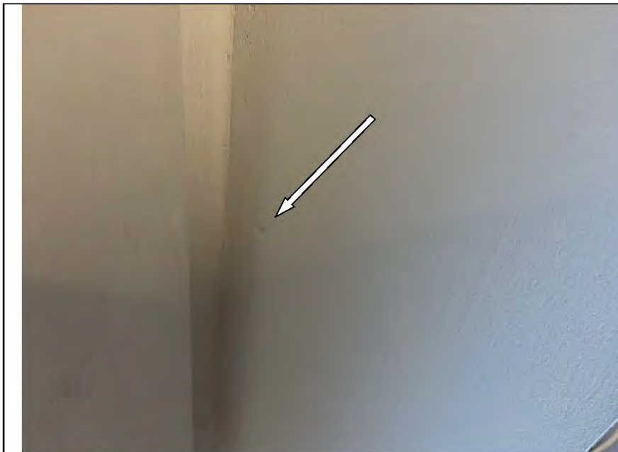
Фото №31. Неровности, выбоины, раковины на окрашенных откосах оконного блока ПВХ в общей комнате.
