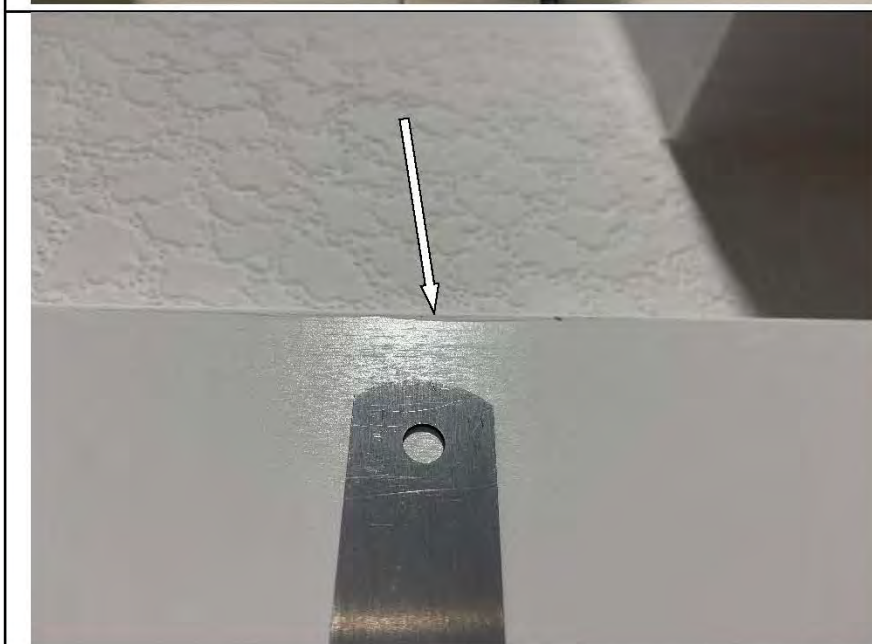
Фото №39. Дефект на полотне входного дверного блока в коридоре.
