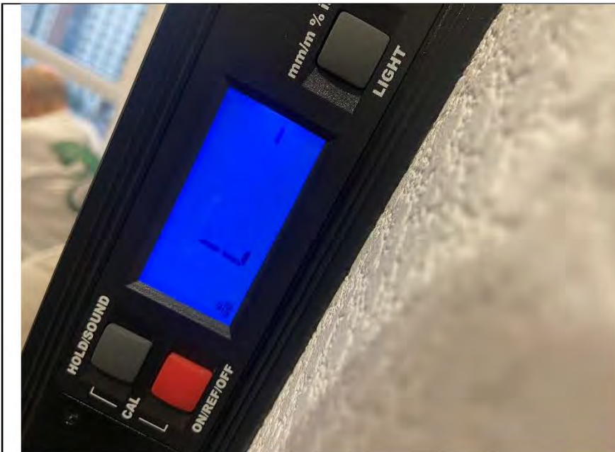
Фото №7. Отклонение по уровню вертикальности поверхности стен в общей комнате.
