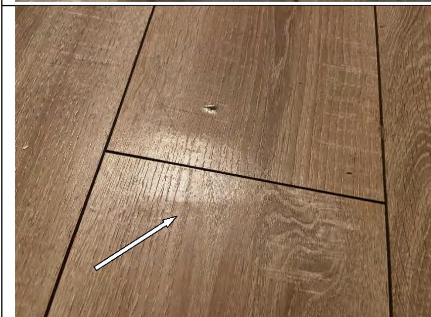
Фото №23. Следы поражения грибком и поднятые кромки ламината в коридоре.
