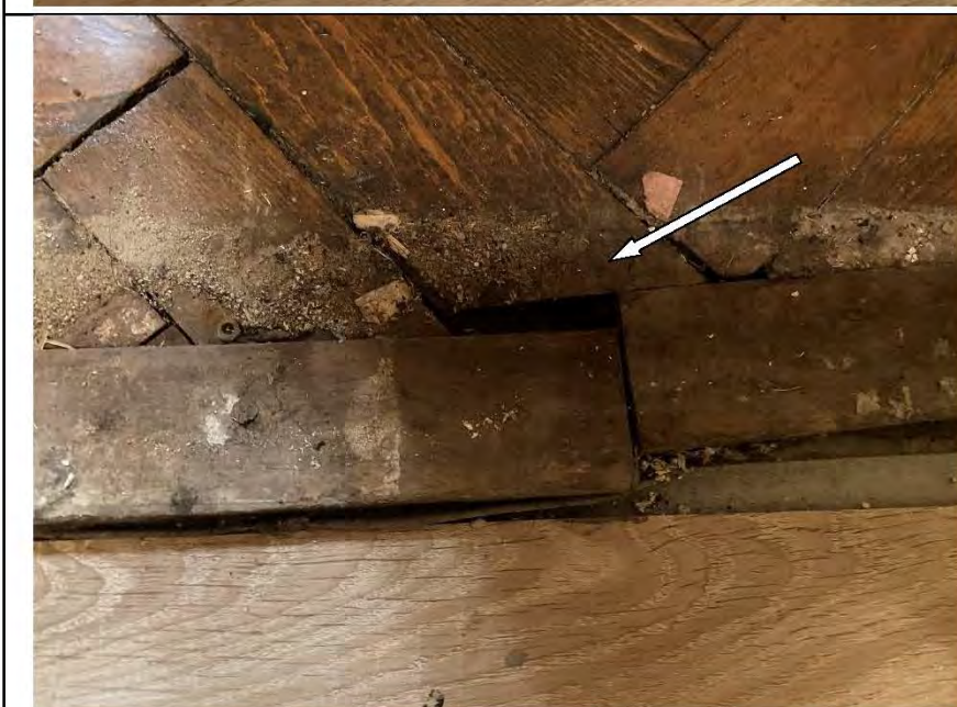
Фото №32. Следы поражения грибком и поднятые кромки паркета в кабинете.
