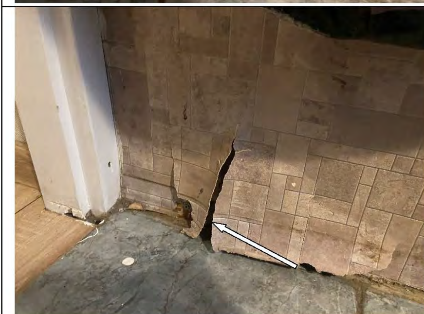
Фото №12. Следы залития на стенах и поражение грибком, оклеенных обоями, в кухне в квартире.
