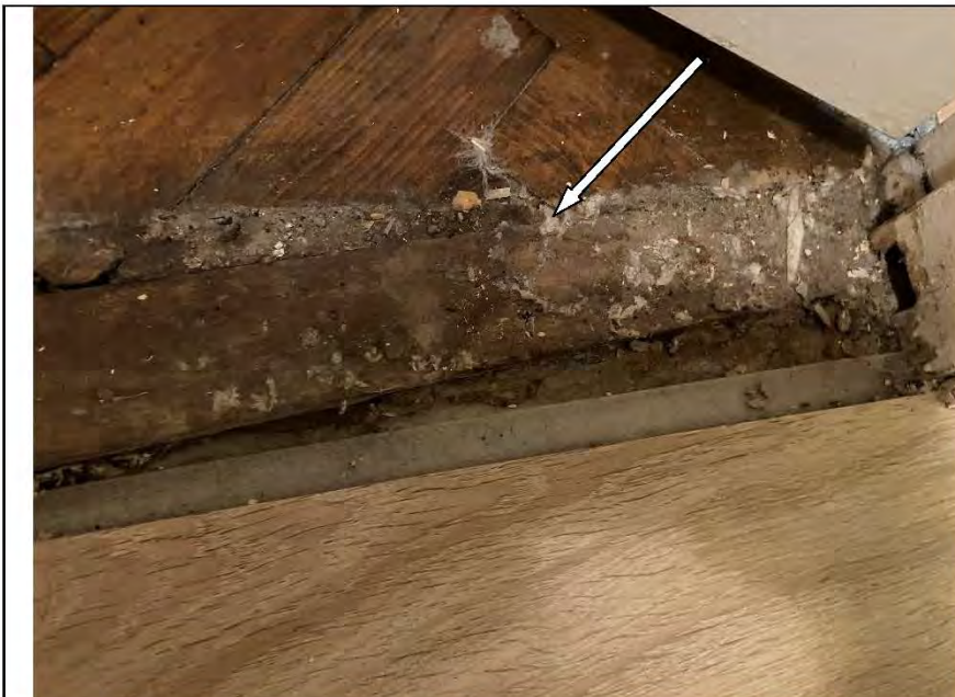
Фото №31. Следы поражения грибком и поднятые кромки паркета в кабинете.
