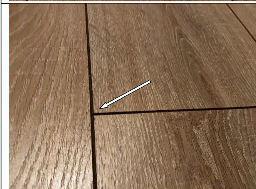
Фото №24. Следы поражения грибком и поднятые кромки ламината в коридоре.
