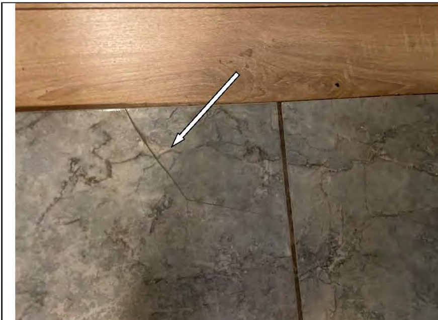
Фото №22. Трещина на напольной керамической плитке в кухне в результате залива в квартире.
