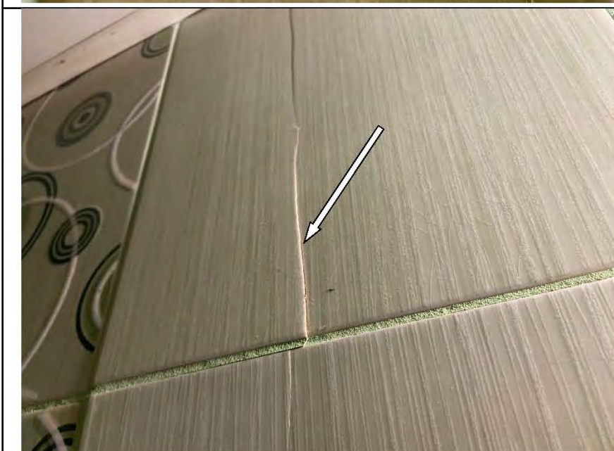
Фото №18. Трещина на настенной керамической плитке в ванной комнате в результате залива в квартире.
