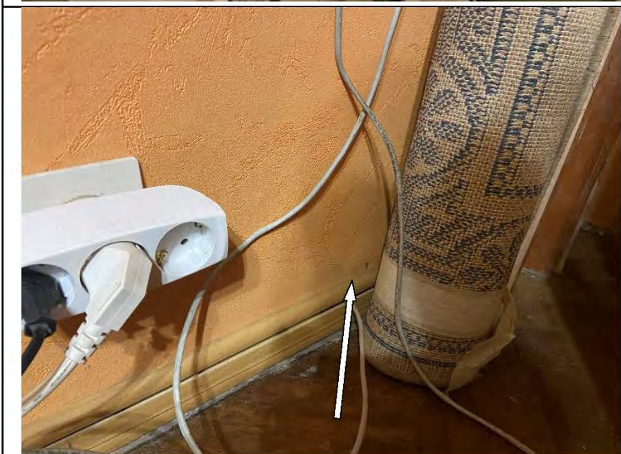
Фото №6. Следы заливания на стенах и поражение грибком, оклеенных обоями, в кабинете в квартире.
