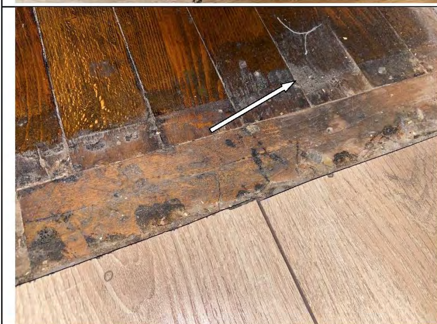
Фото №33. Следы поражения грибком и поднятые кромки паркета в гостиной.
