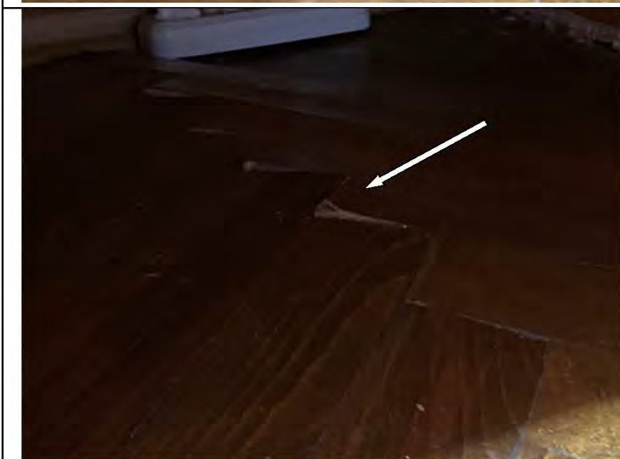
Фото №29. Следы поражения грибком и поднятые кромки паркета в кабинете.
