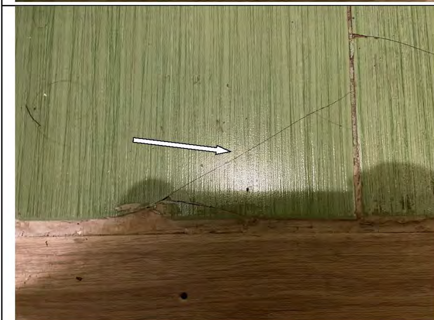
Фото №20. Трещина на напольной керамической плитке в ванной комнате в результате залива в квартире.
