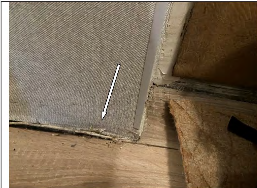
Фото №10. Следы залития на стенах и поражение грибком, оклеенных обоями, в коридоре в квартире.
