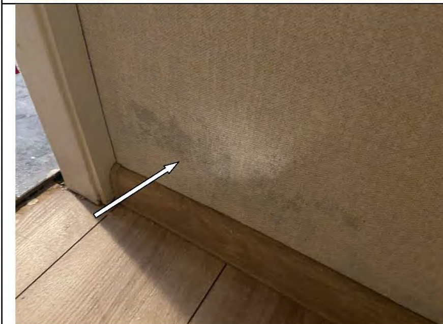
Фото №8. Следы залития на стенах и поражение грибком, оклеенных обоями, в коридоре в квартире.
