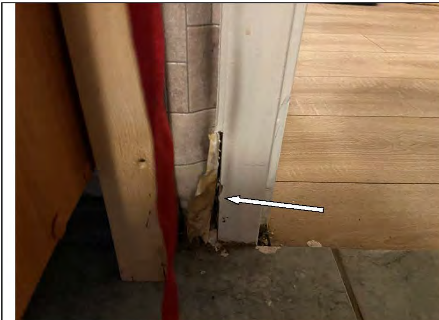
Фото №13. Следы залива на стенах и поражение грибком, оклеенных обоями, в кухне в квартире.
