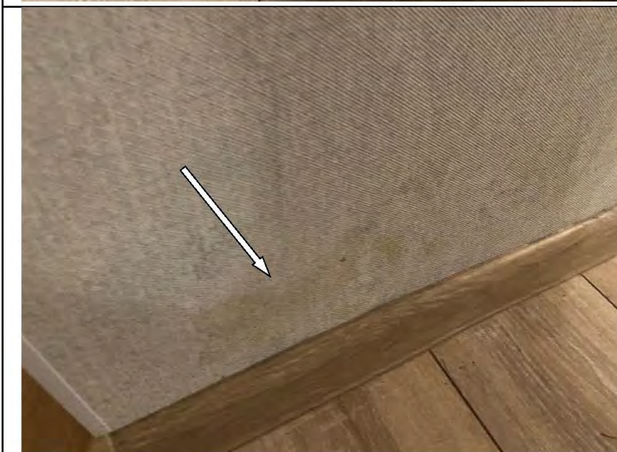
Фото №9. Следы залития на стенах и поражение грибком, оклеенных обоями, в коридоре в квартире.
