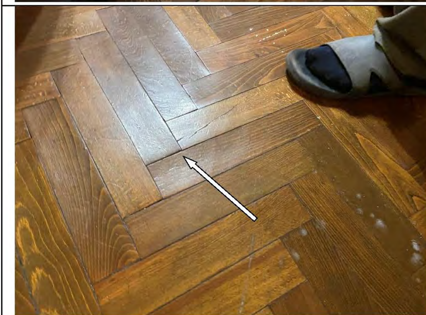
Фото №27. Следы поражения грибком и поднятые кромки паркета в кабинете.
