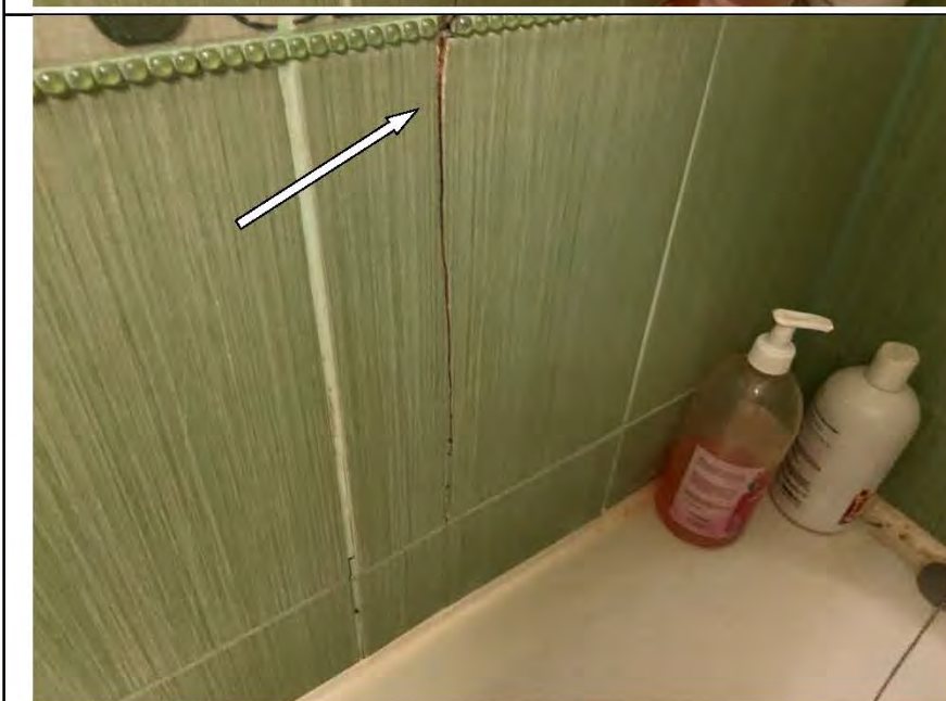
Фото №15. Трещина на настенной керамической плитке в ванной комнате в результате залива в квартире.
