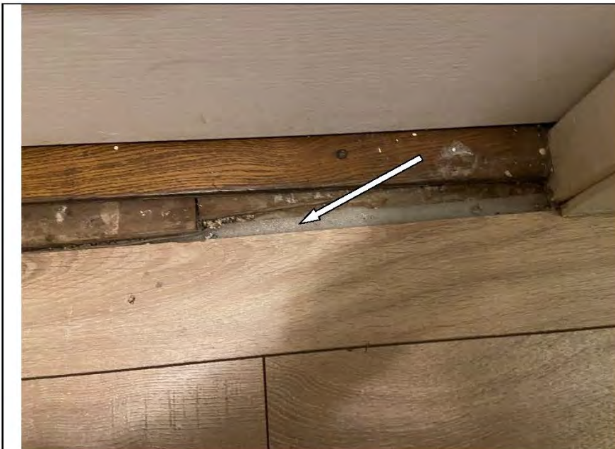
Фото №25. Следы поражения грибком и поднятые кромки ламината в коридоре.
