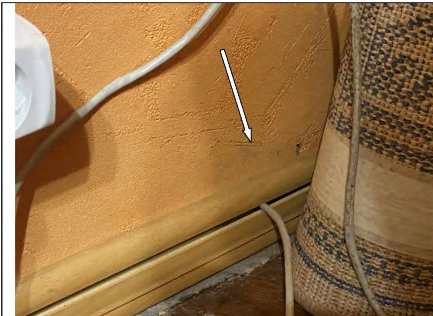
Фото №7. Следы залития на стенах и поражение грибком, оклеенных обоями, в кабинете в квартире.
