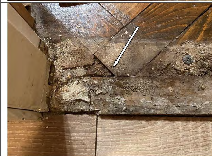
Фото №30. Следы поражения грибком и поднятые кромки паркета в кабинете.
