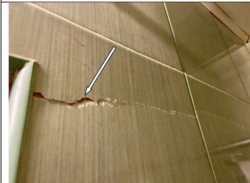
Фото №17. Трещина на настенной керамической плитке в ванной комнате в результате залива в квартире.
