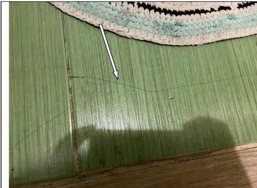
Фото №19. Трещина на напольной керамической плитке в ванной комнате в результате залива в квартире.
