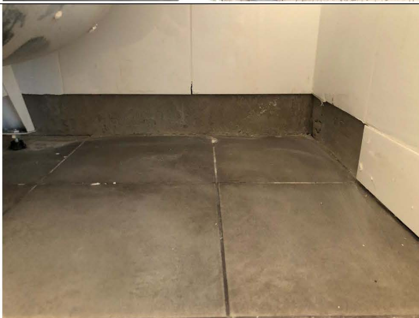
Фото №54. Часть настенной плитки отсутствует в ванной комнате.
