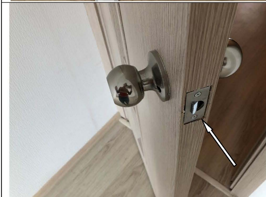
Фото №35. Дефект дверной ручки в кухне.
