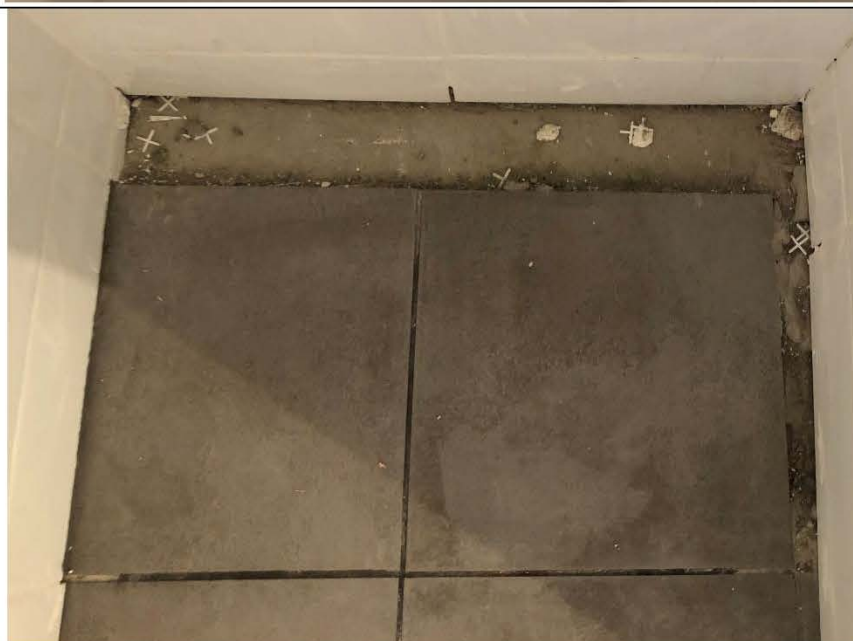
Фото №57. Часть напольной плитки отсутствует в ванной комнате.
