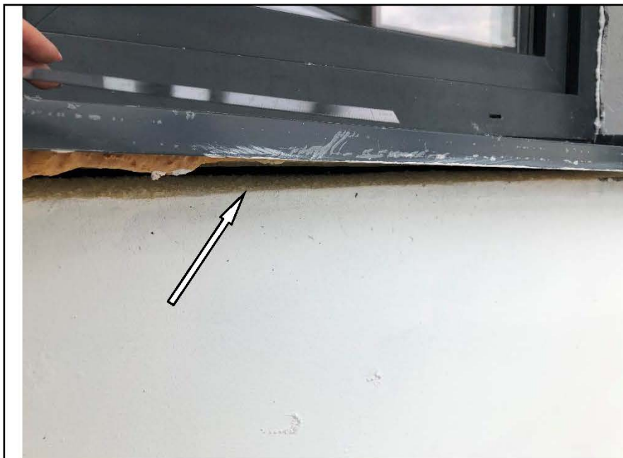
Фото №49. Утепление оконного блока ПВХ в комнате выполнено неверно.
