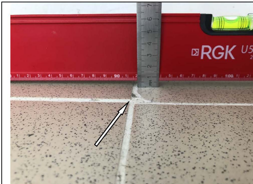
Фото №19. Измерение напольного покрытия на лоджии в квартире. Дефект затирки шва.
