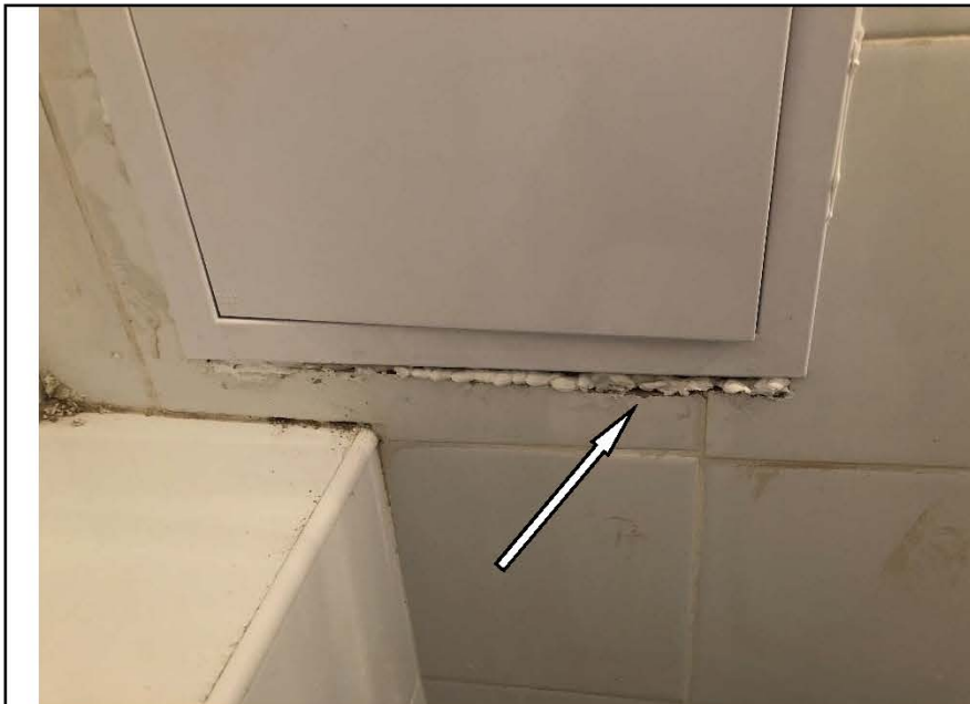
Фото №61. Дефект монтажа сантехнического люка в туалете.
