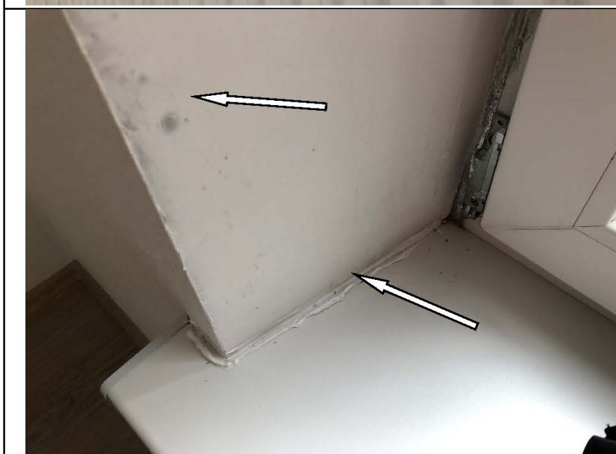
Фото №30. Дефект заделки шва подоконной доски и откоса. Дефект на откосе.
