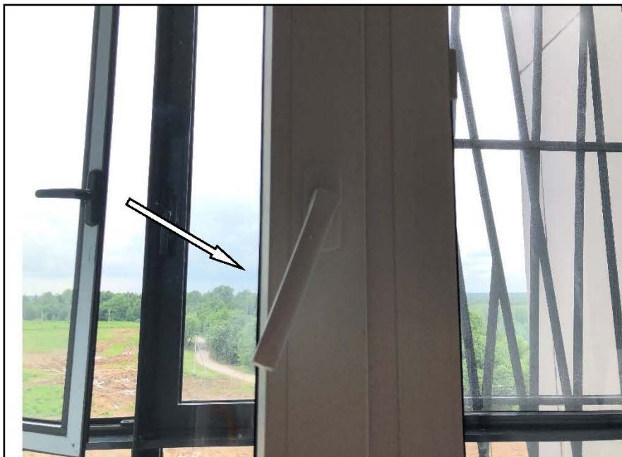
Фото №46. Фурнитура оконного блока в спальне не отрегулирована.
