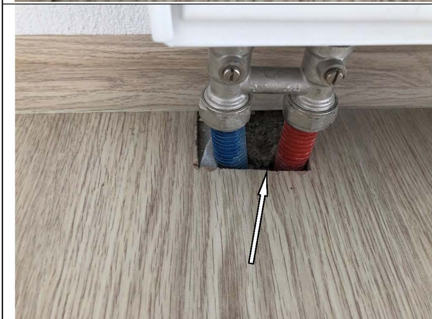
Фото №38. Дефект ламината при заделке отверстия для труб отопления в общей комнате.
