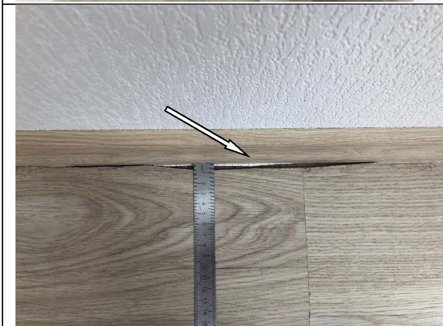
Фото №36. Отсутствует часть ламината в общей комнате.
