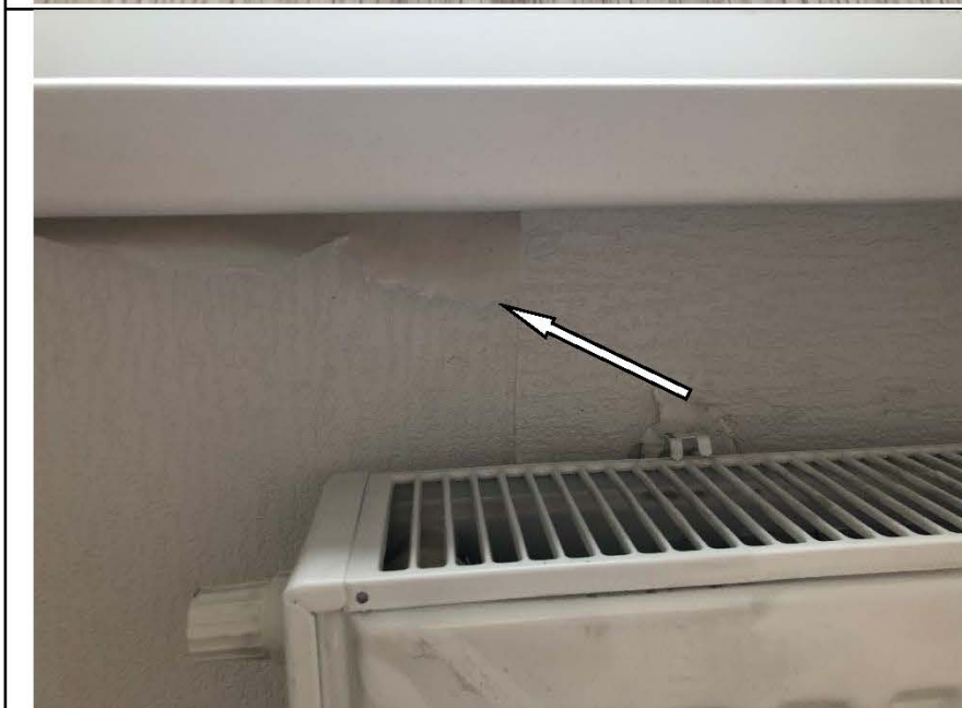
Фото №39. Дефект оклейки обоями в общей комнате.
