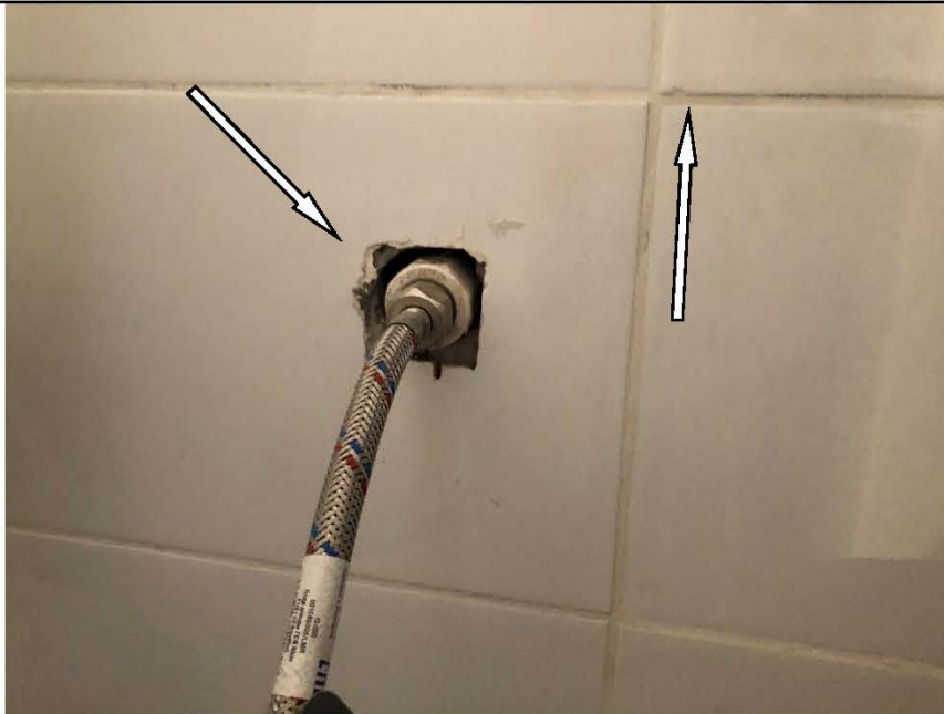
Фото №55. Отбитости настенной плитки в ванной комнате.
