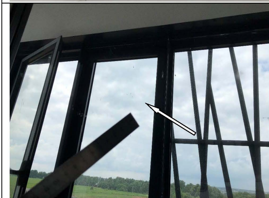
Фото №48. Царапины на стекле оконного блока в спальне в квартире.
