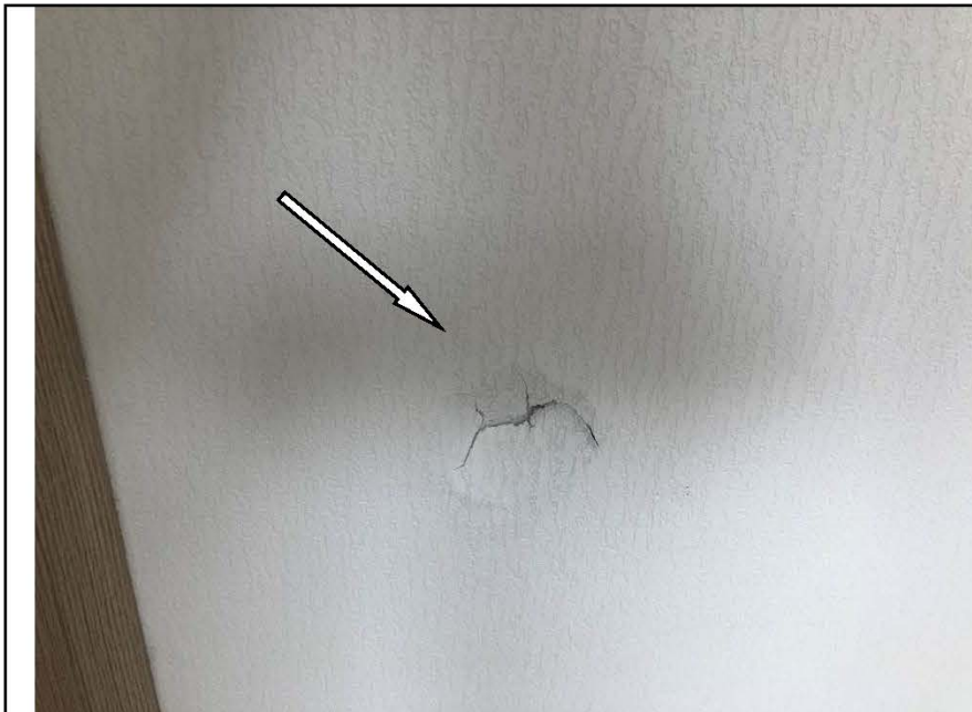
Фото №25. Дефект оштукатуривания и оклеивания обоями стен в кухне.
