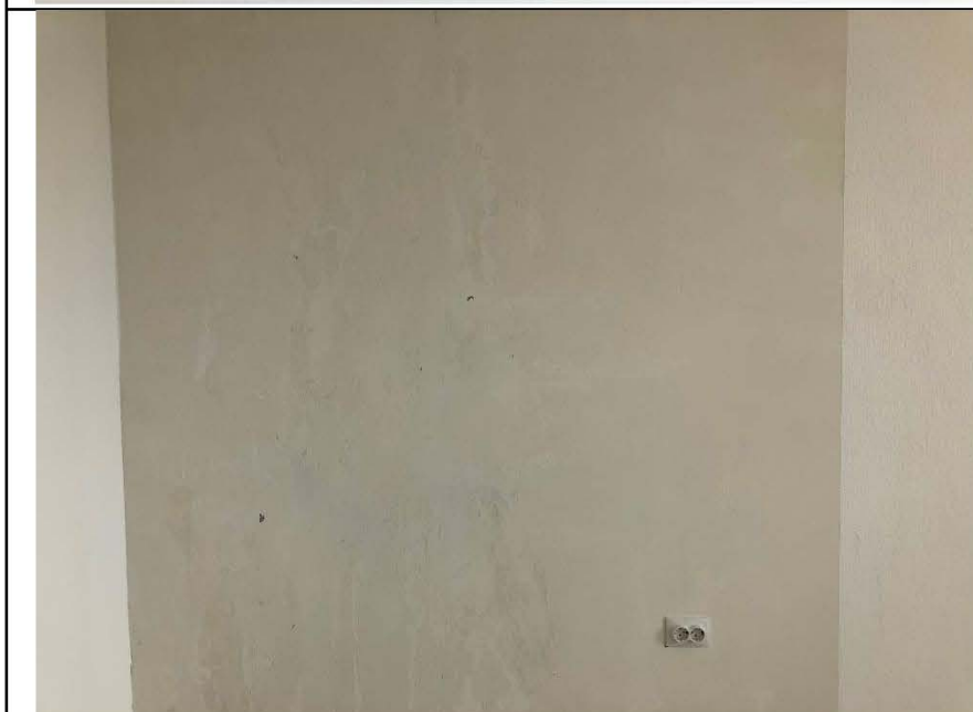
Фото №50. Отсутствует часть обоевого полотна в спальне.
