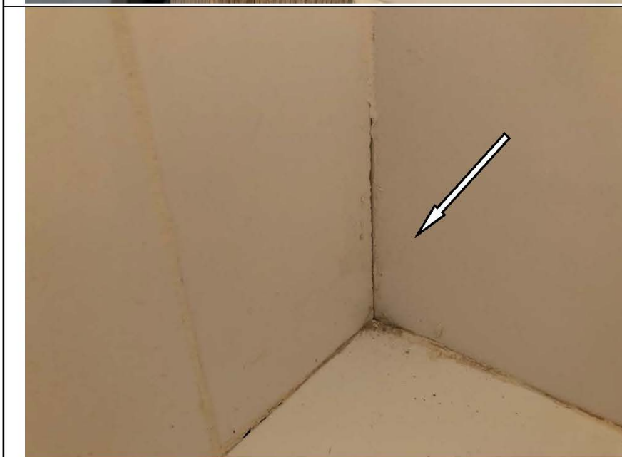
Фото №60. Отбитости настенной плитки в туалете. Отсутствие затирки шва.
