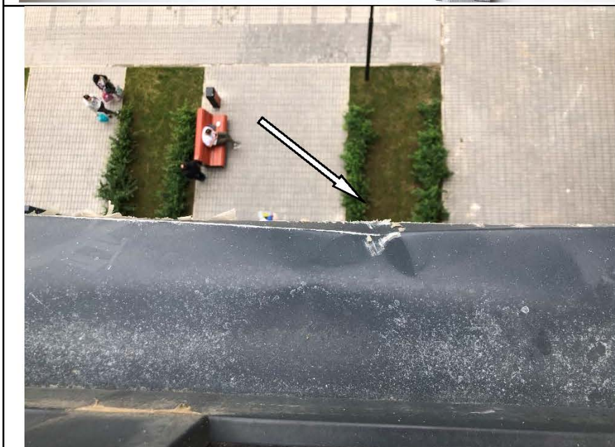
Фото №42. Дефект отлива оконного блока в общей комнате.
