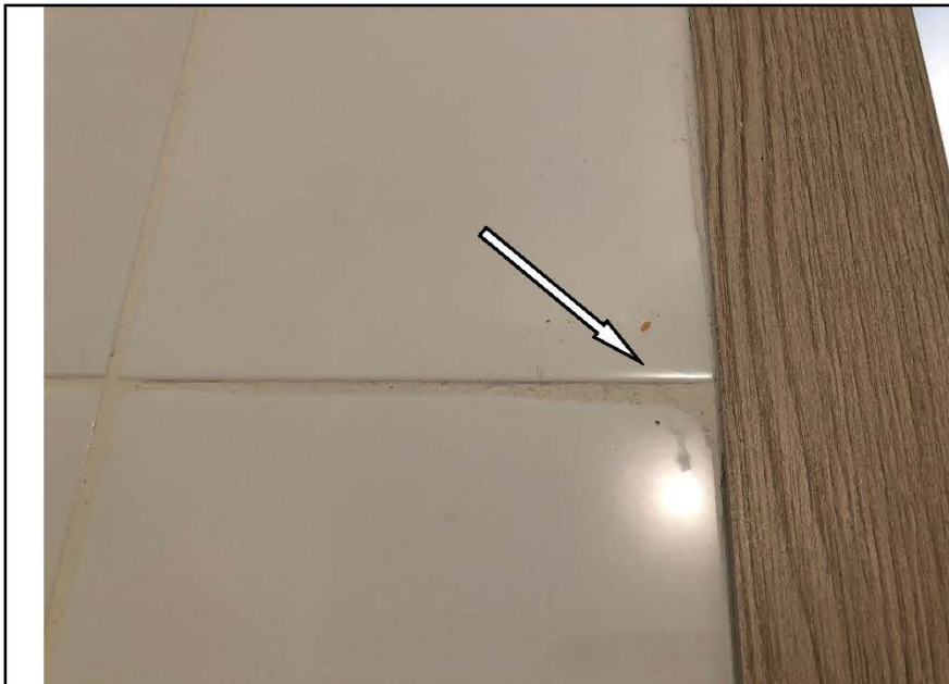
Фото №58. Дефект шва настенной плитки в ванной комнате.
