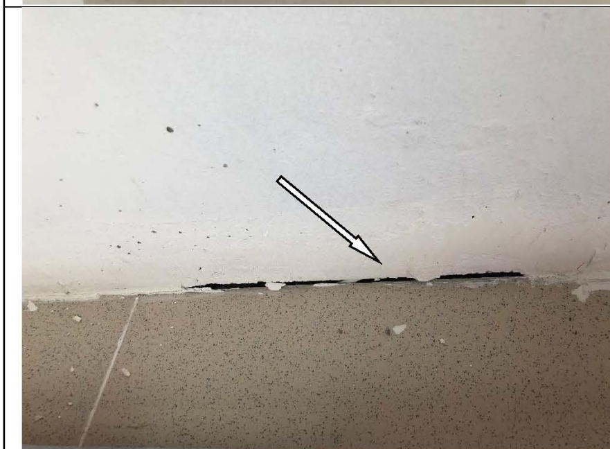
Фото №51. Щель между стеной и напольным покрытием на лоджии.
