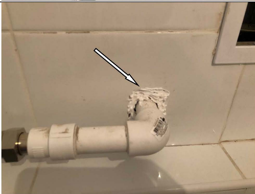
Фото №56. Дефект монтажа трубы водоснабжения в ванной комнате.
