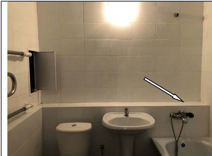
Фото №7. Общий вид ванной комнаты в квартире. Дефект шва настенной плитки.
