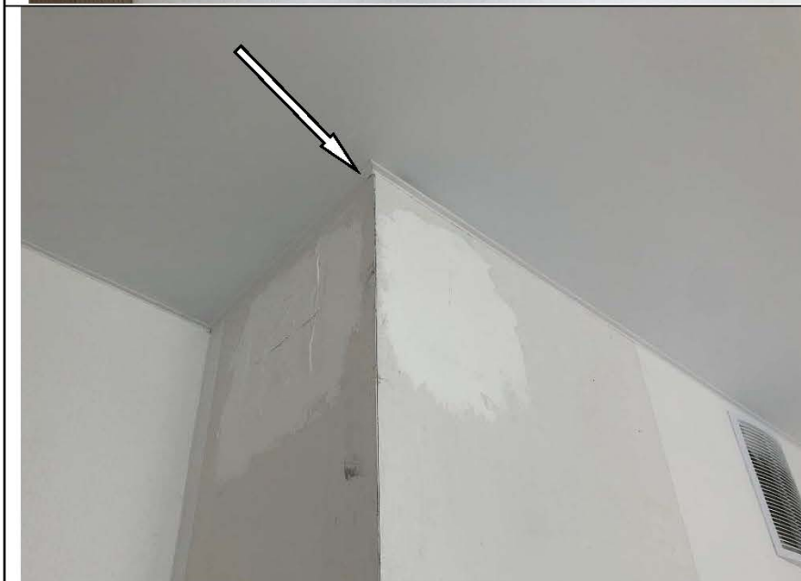
Фото №26. Дефект оштукатуривания стен в кухне. Отсутствует часть обоевого полотна.
