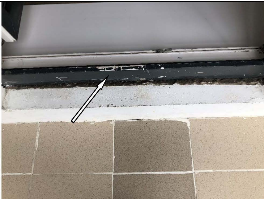
Фото №52. Дефект на коробке дверного балконного блока на лоджии.
