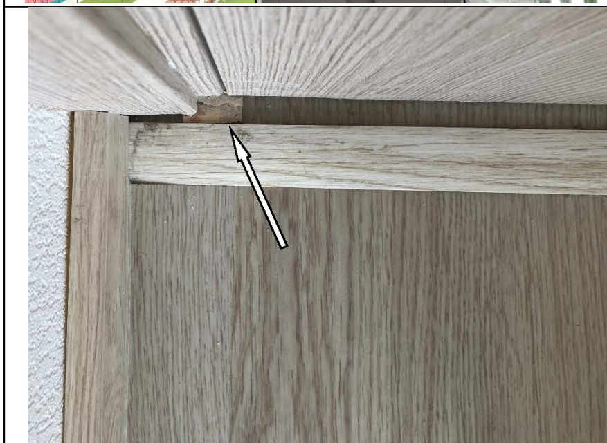
Фото №33. Отсутствует часть ламината в кухне.
