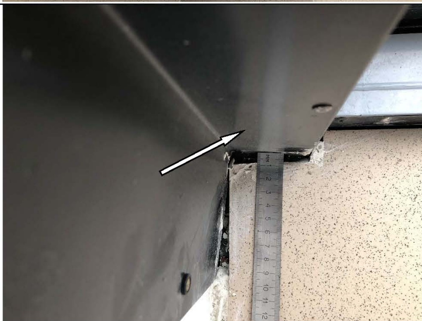
Фото №53. Отсутствует затирка в швах напольной керамической плитке на лоджии.
