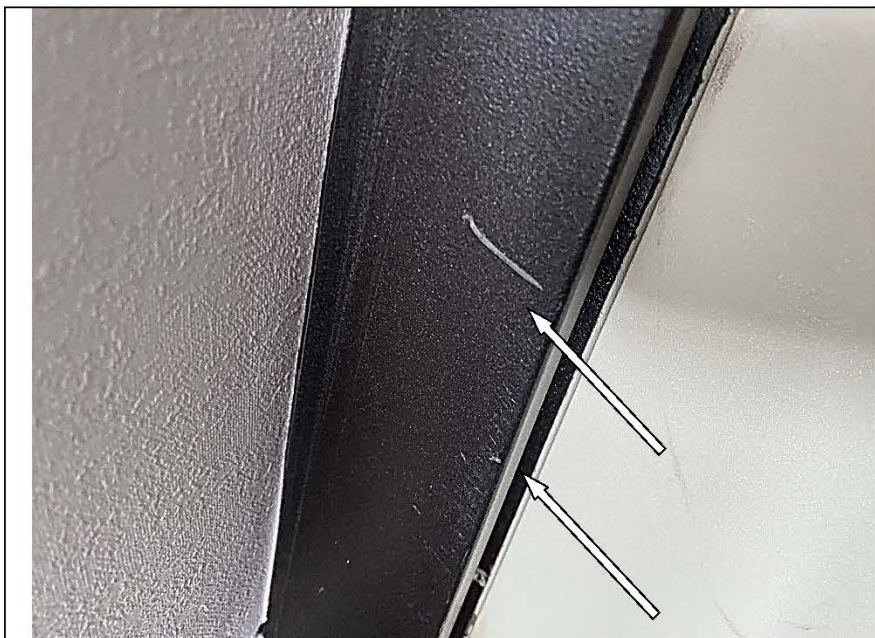
Фото №16. Коробка входной металлической двери имеет дефекты.
