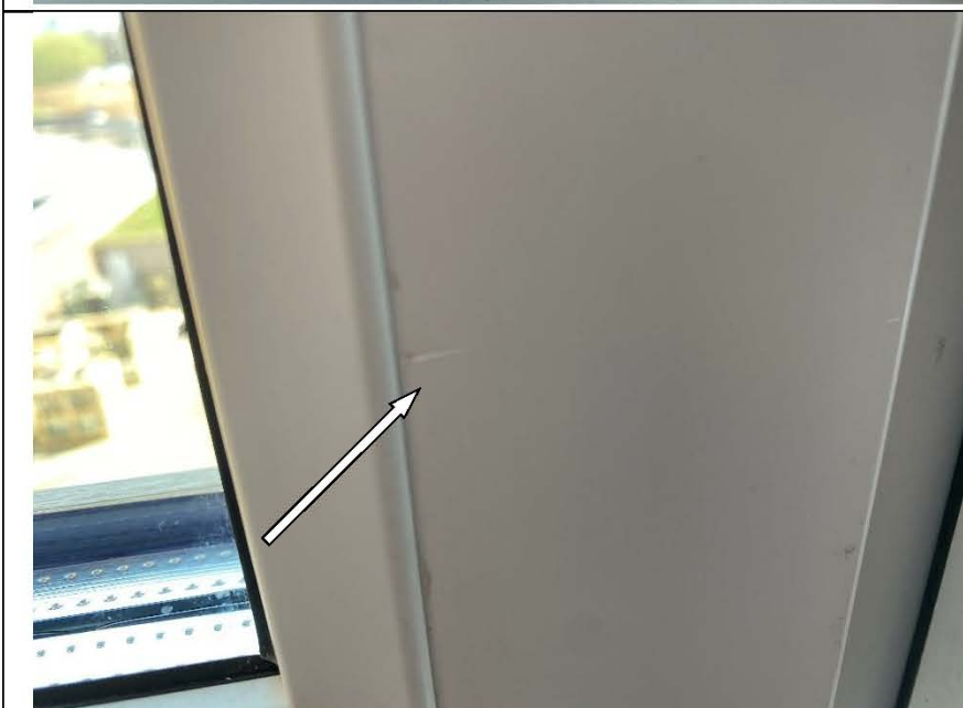
Фото №32. Профиль ПВХ оконного блока в спальне имеет дефекты.
