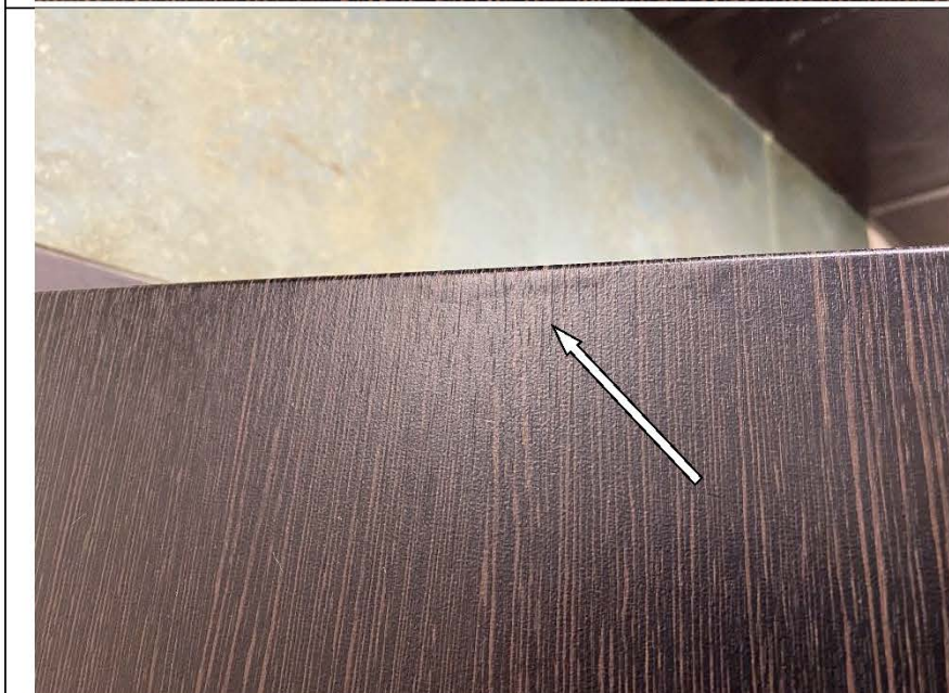
Фото №18. Полотно входной металлической двери имеет дефекты.
