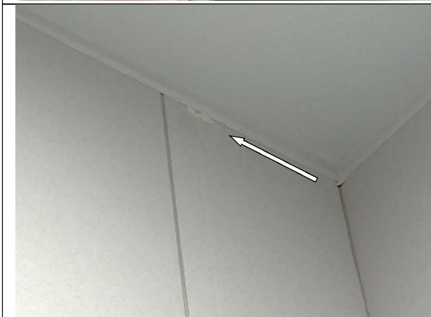
Фото №35. Дефект монтажа декоративного молдинга в ванной комнате.
