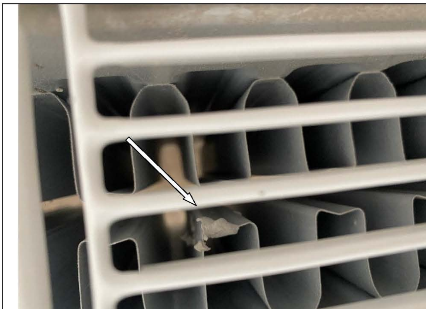
Фото №37. Радиатор в спальне имеет дефекты.
