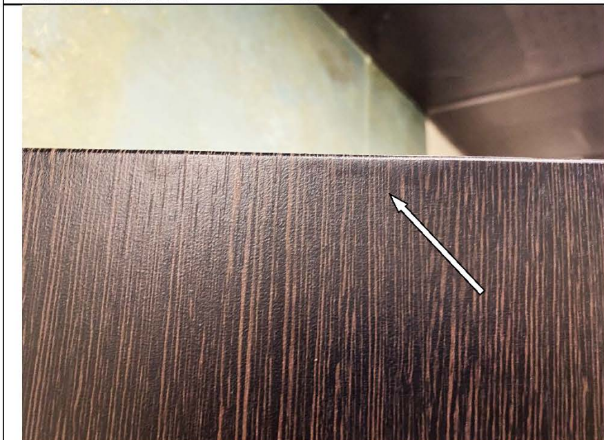
Фото №17. Полотно входной металлической двери имеет дефекты.
