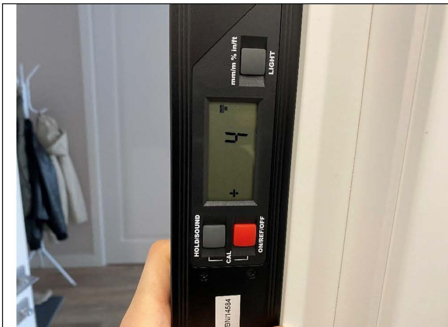
Фото №19. Отклонение коробки дверного блока от плоскостности и прямолинейности в ванной комнате.
