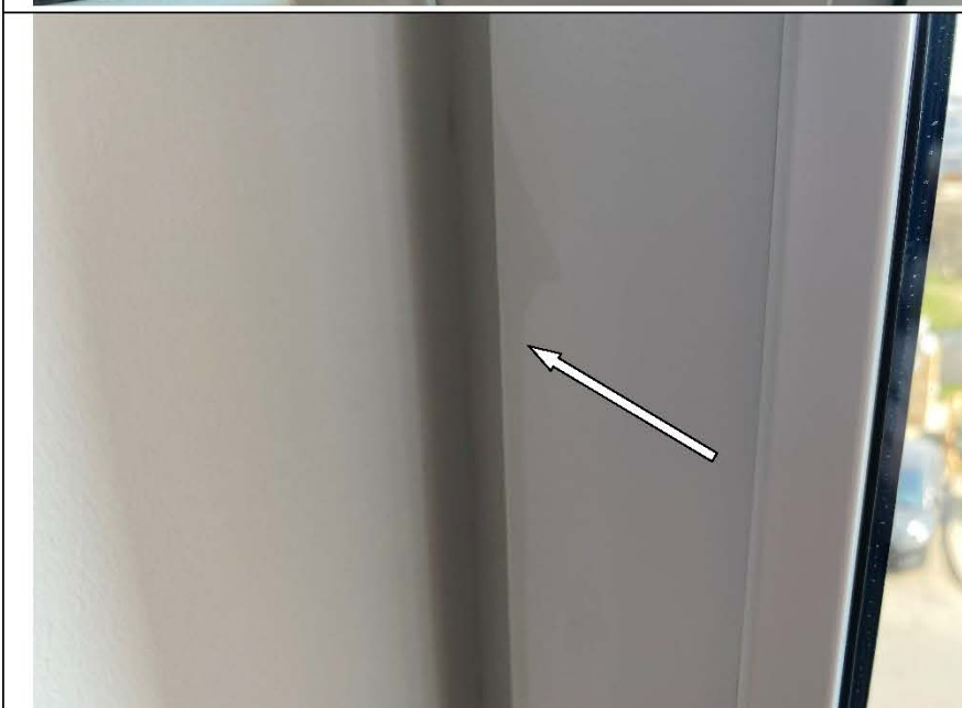
Фото №33. Профиль ПВХ оконного блока в спальне имеет дефекты.
