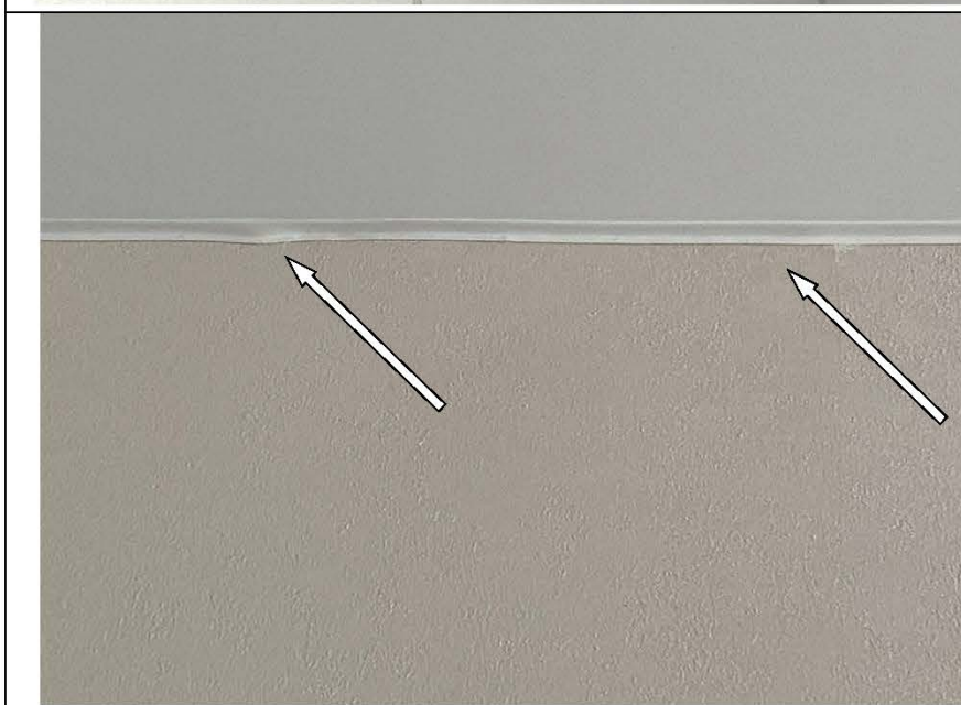
Фото №36. Дефект монтажа декоративного молдинга в кухне.
