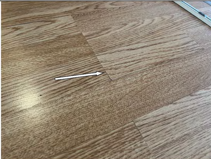
Фото №16. Отслоение и вздутие досок ламината в коридоре №2.
