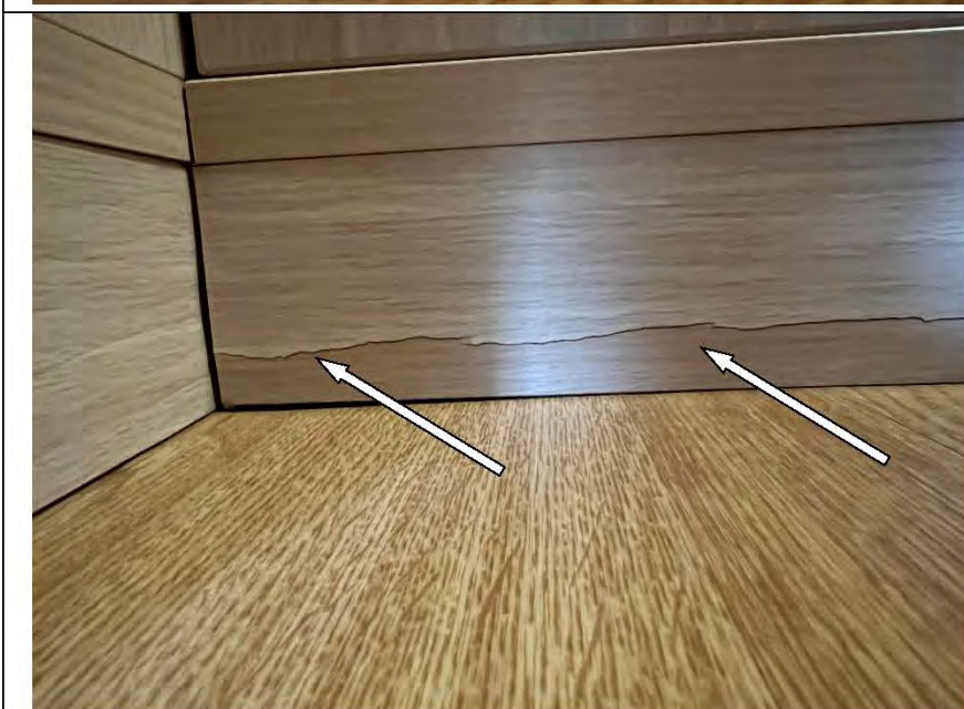
Фото №12. Расслоение нижней конструктивной части шкафа-купе в коридоре №2.
