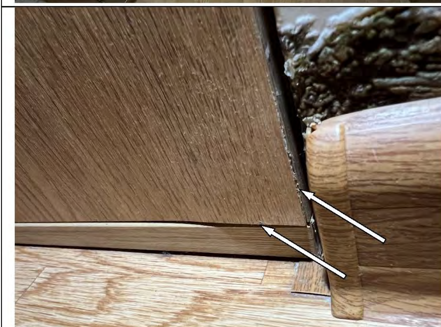
Фото №14. Расслоение боковой стенки тумбы для обуви в коридоре №1.
