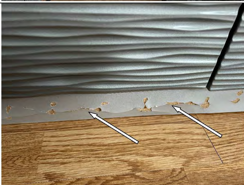
Фото №2. Расслоение нижней конструктивной части шкафа-стенки в гостиной.
