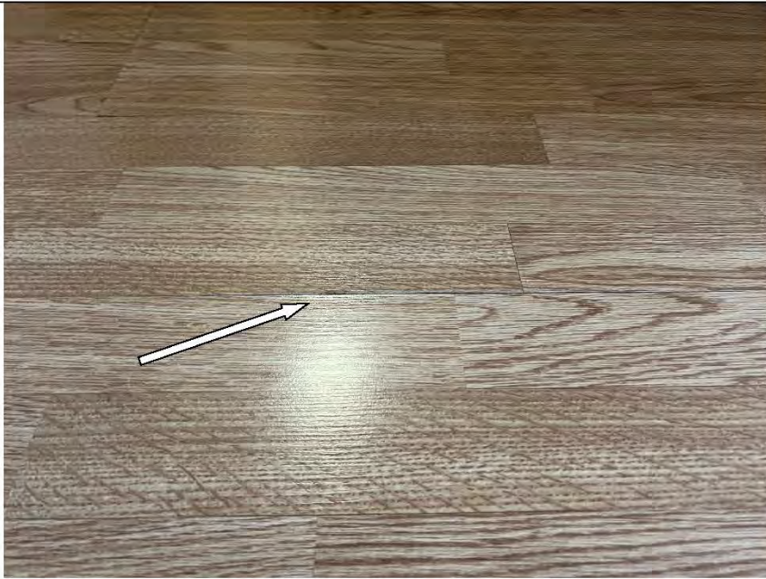
Фото №15. Отслоение и вздутие досок ламината в коридоре №2.
