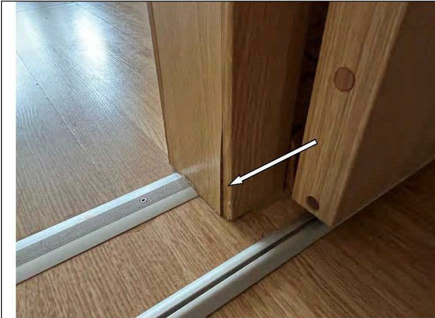
Фото №27. Расслоение наличников дверного блока в гостиную.
