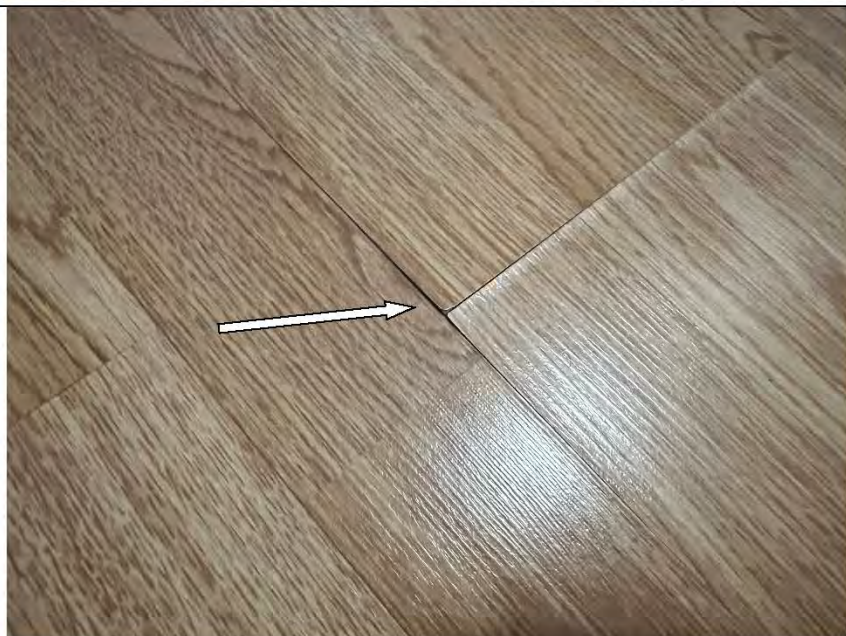
Фото №17. Отслоение и вздутие досок ламината в коридоре №2.
