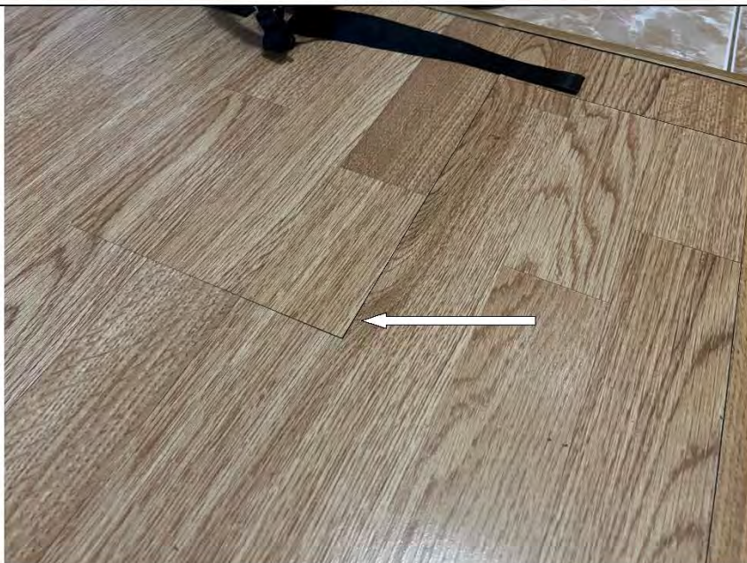
Фото №20. Отслоение и вздутие досок ламината в коридоре №1.
