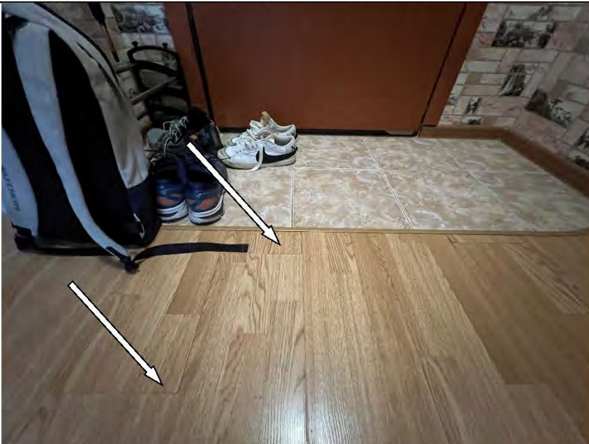
Фото №19. Отслоение и вздутие досок ламината в коридоре №1.
