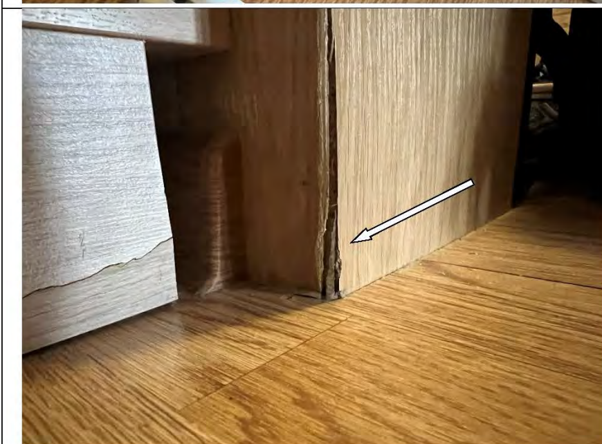
Фото №29. Расслоение наличников дверного блока в коридор №2.
