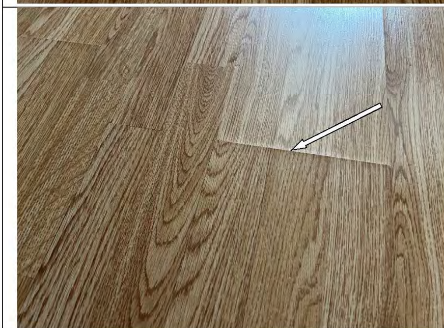
Фото №23. Отслоение и вздутие досок ламината в кухне.
