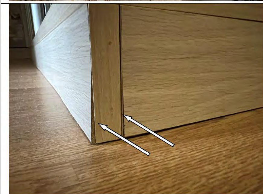
Фото №11. Расслоение нижней конструктивной части шкафа-купе в коридоре №2.
