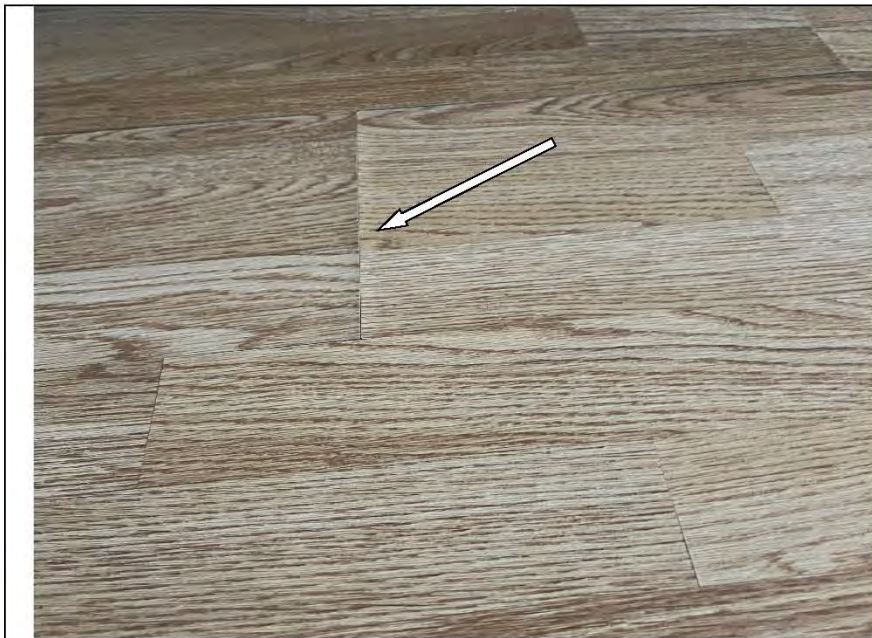
Фото №24. Отслоение и вздутие досок ламината в кухне.
