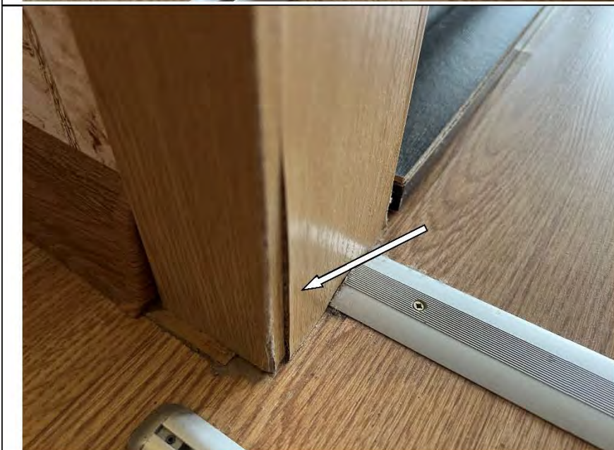
Фото №28. Расслоение наличников дверного блока в гостиную.
