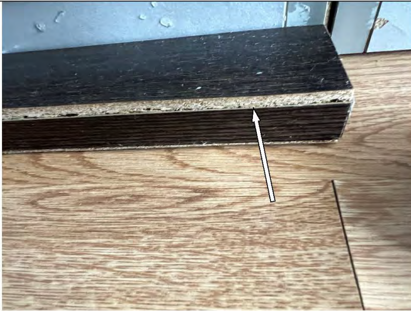
Фото №7. Расслоение нижней конструктивной части шкафа-стенки в гостиной.
