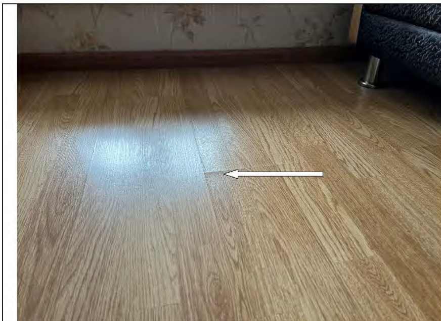
Фото №21. Отслоение и вздутие досок ламината в кухне.
