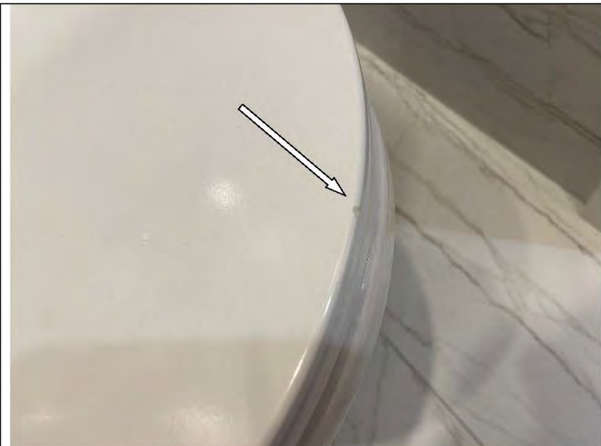
Фото №112. Скол на унитазе в ванной комнате.
