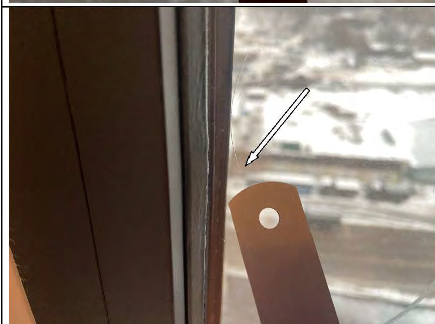
Фото №68. Царапины на стеклопакете оконного блока в гостиной.
