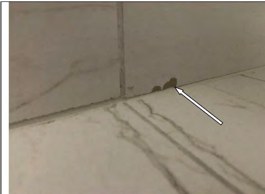
Фото №28. Сколы на настенной керамогранитной плитке в санузле.
