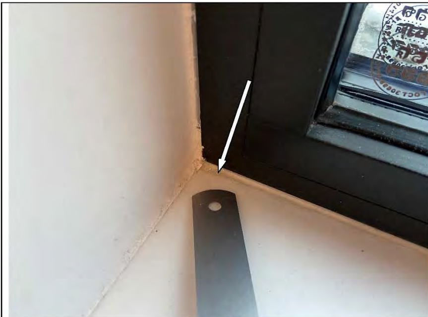
Фото №64. Дефект на лицевой стороне подоконной доски оконного блока в спальне.
