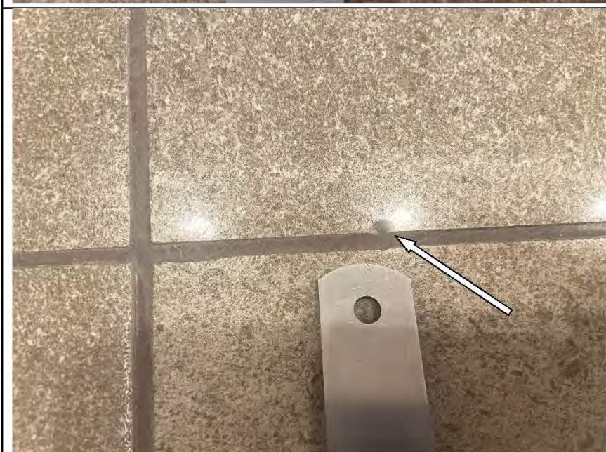
Фото №57. Скол на напольной керамогранитной плитке в гостиной.
