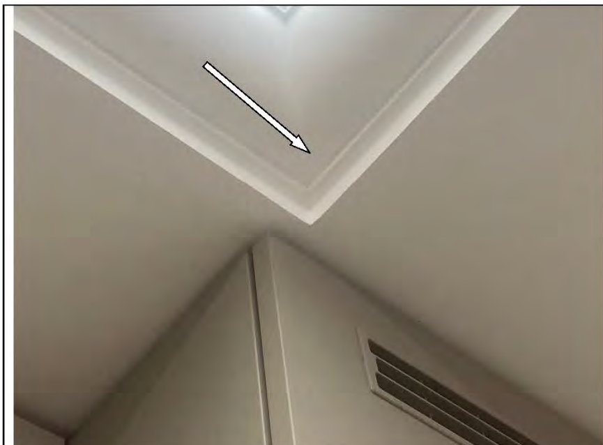
Фото №106. Неровности, выбоины, подтеки на поверхности окрашенного потолка в гостиной.
