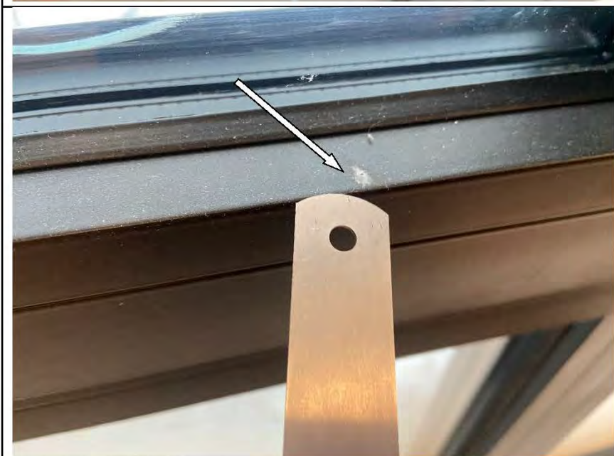
Фото №81. Дефект на алюминиевом профиле оконного блока в гостиной.
