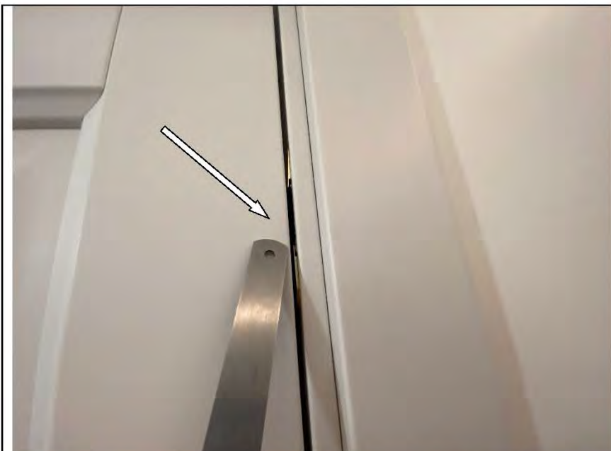
Фото №91. Дефект на полотне деревянного дверного блока в ванной комнате.
