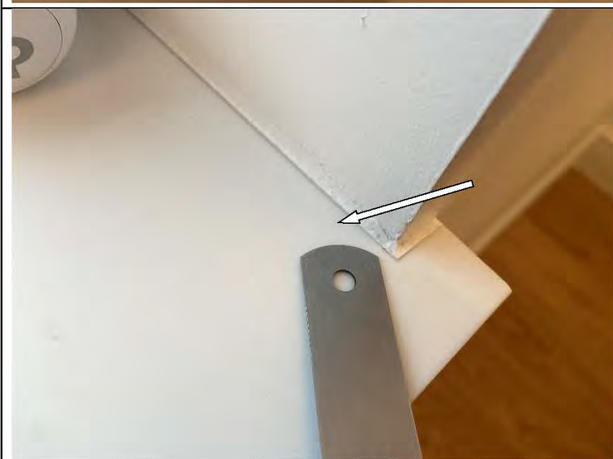
Фото №63. Дефект на лицевой стороне подоконной доски оконного блока в гостиной.
