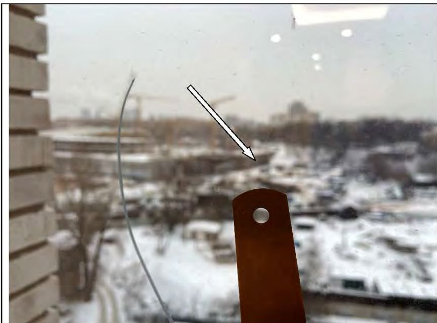
Фото №70. Царапины на стеклопакете оконного блока в спальне.
