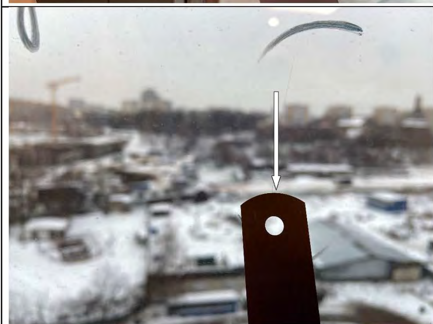
Фото №69. Царапины на стеклопакете оконного блока в спальне.
