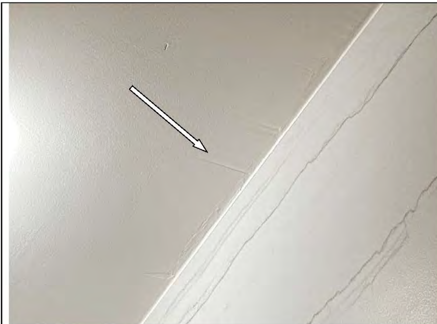
Фото №103. Неровности, выбоины, подтеки на поверхности окрашенного потолка в ванной комнате.
