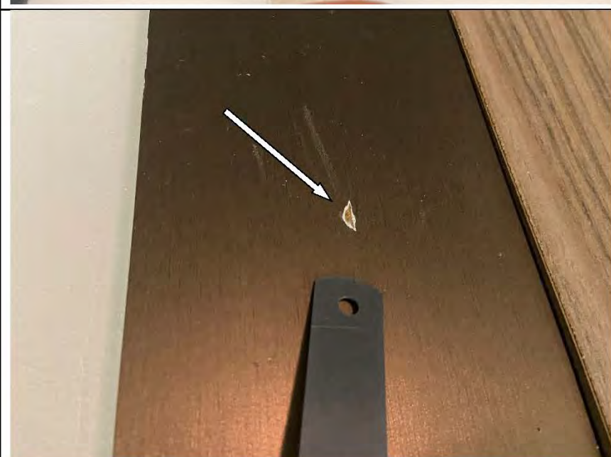
Фото №87. Дефект на коробке входного дверного блока в коридоре.
