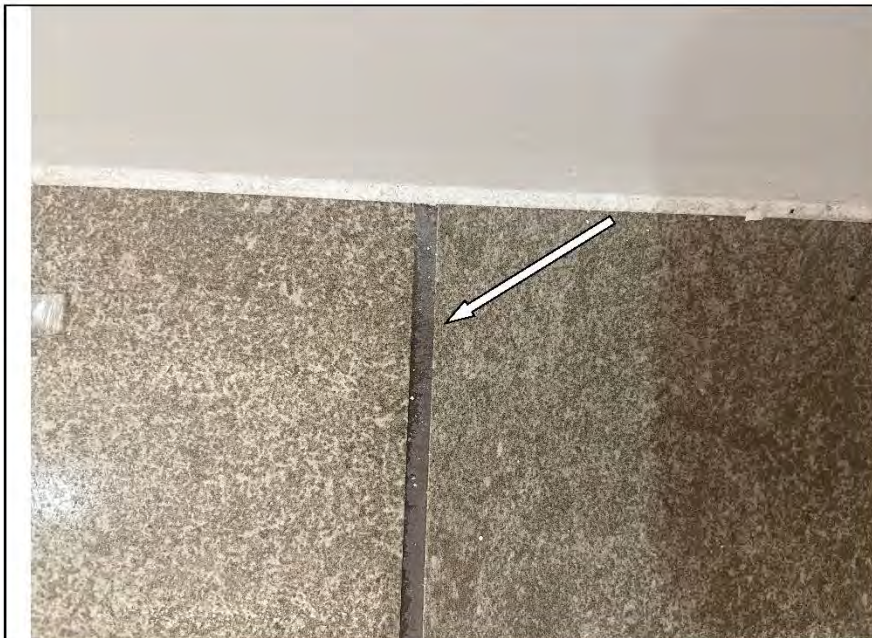
Фото №40. Неровные швы напольной керамогранитной плитки в коридоре.
