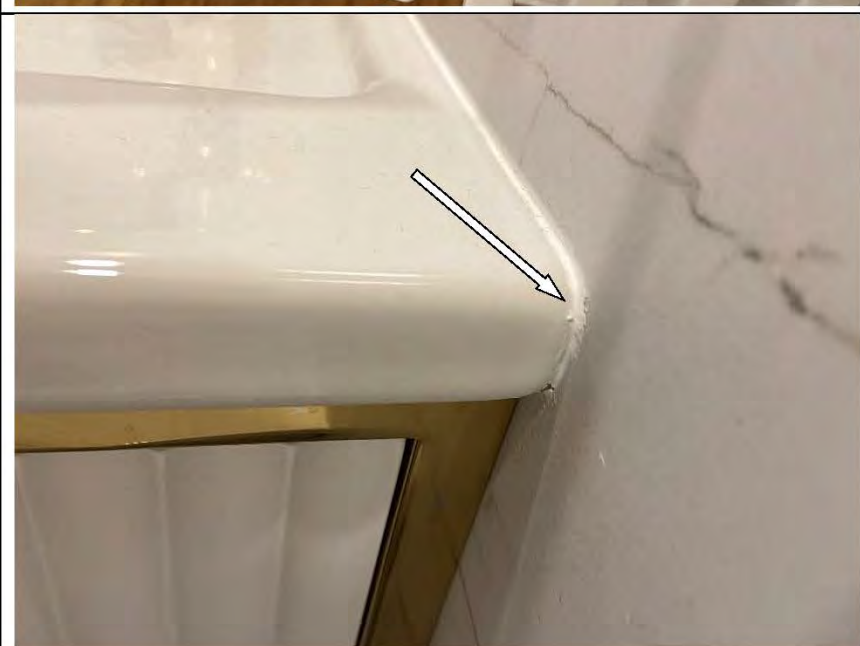
Фото №111. Загрязнения на раковине в ванной комнате.
