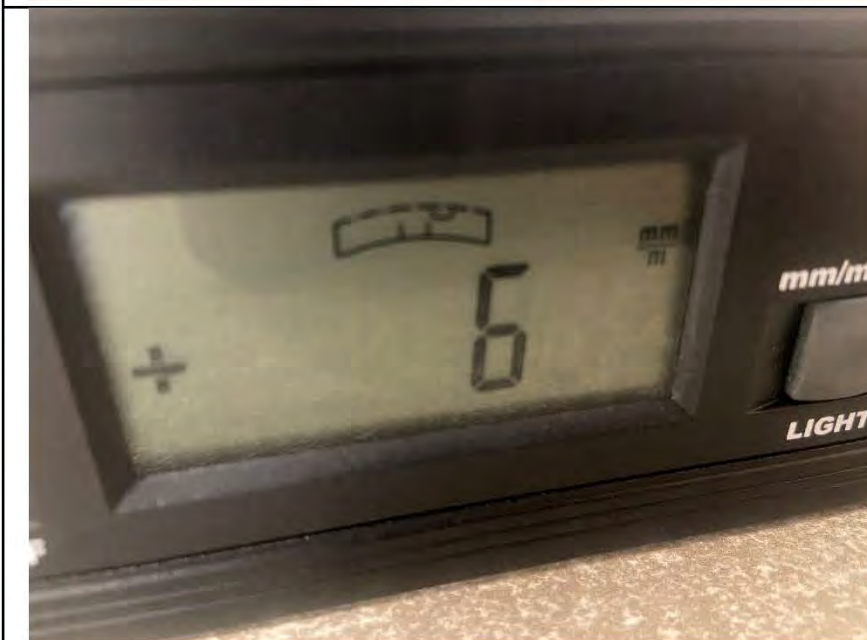
Фото №35. Отклонение поверхности напольного покрытия от плоскости в гостиной.
