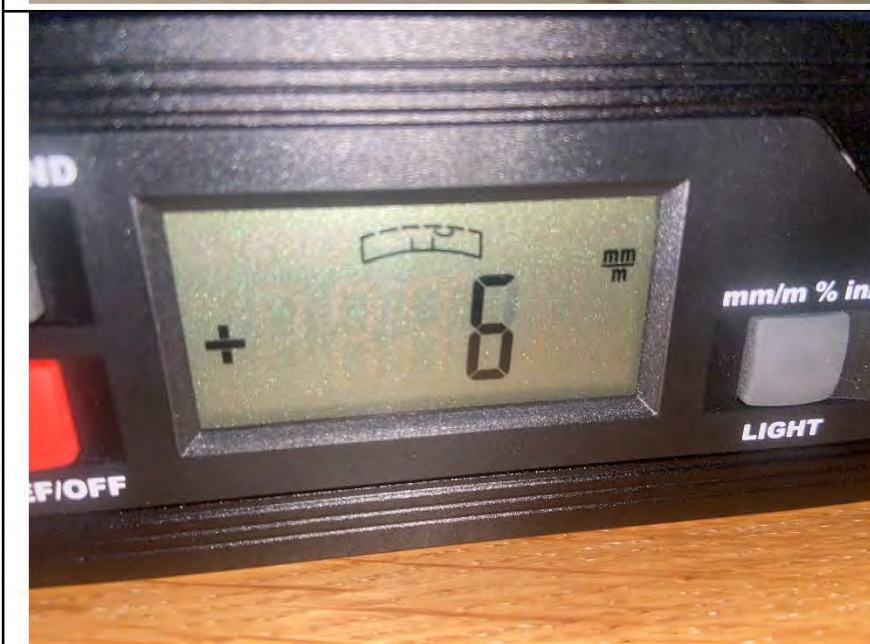
Фото №29. Отклонение поверхности напольного покрытия от плоскости в кабинете.
