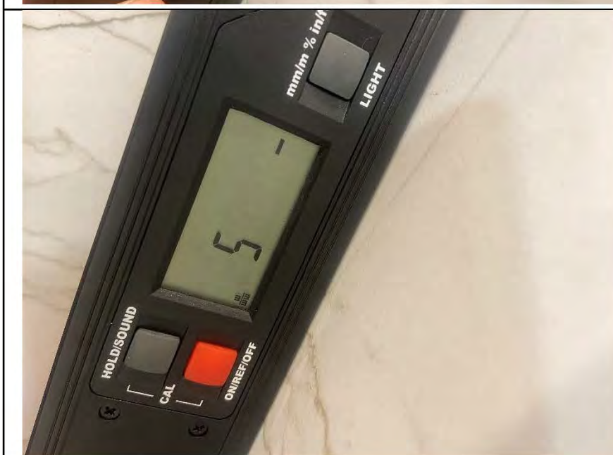
Фото №15. Отклонение поверхности стен от вертикали в санузле.
