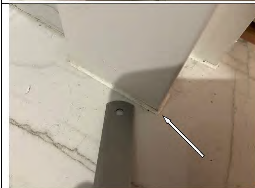
Фото №42. Неровные швы напольной керамогранитной плитки в санузле.
