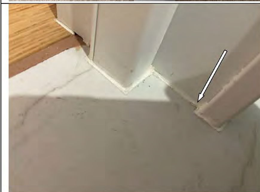
Фото №39. Загрязнения на напольной керамогранитной плитке в санузле.
