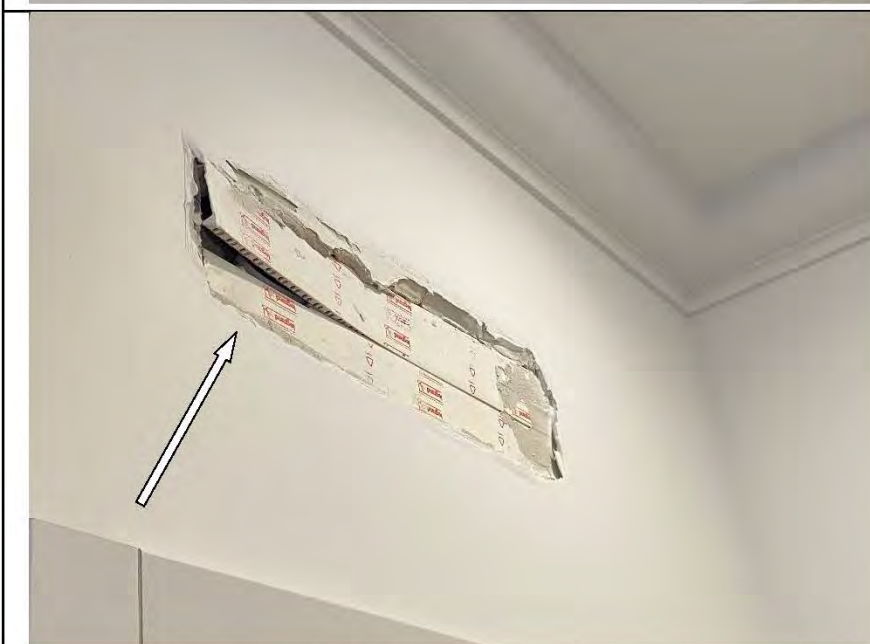
Фото №23. Механическое повреждение на поверхности окрашенных стен в спальне.
