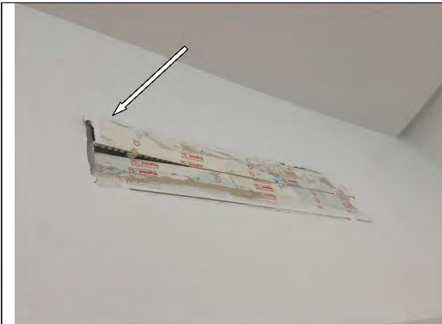
Фото №22. Механическое повреждение на поверхности окрашенных стен в кабинете.
