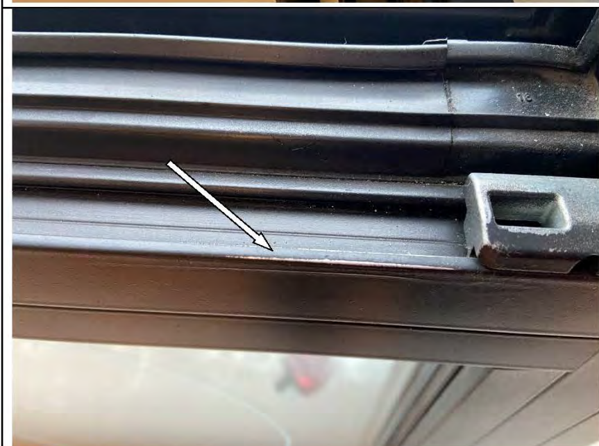
Фото №80. Дефект на алюминиевом профиле оконного блока в кабинете.
