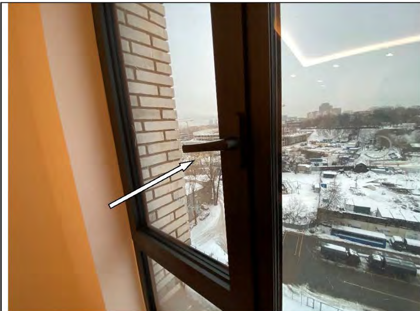
Фото №61. Не отрегулирована фурнитура оконного блока в спальне.
