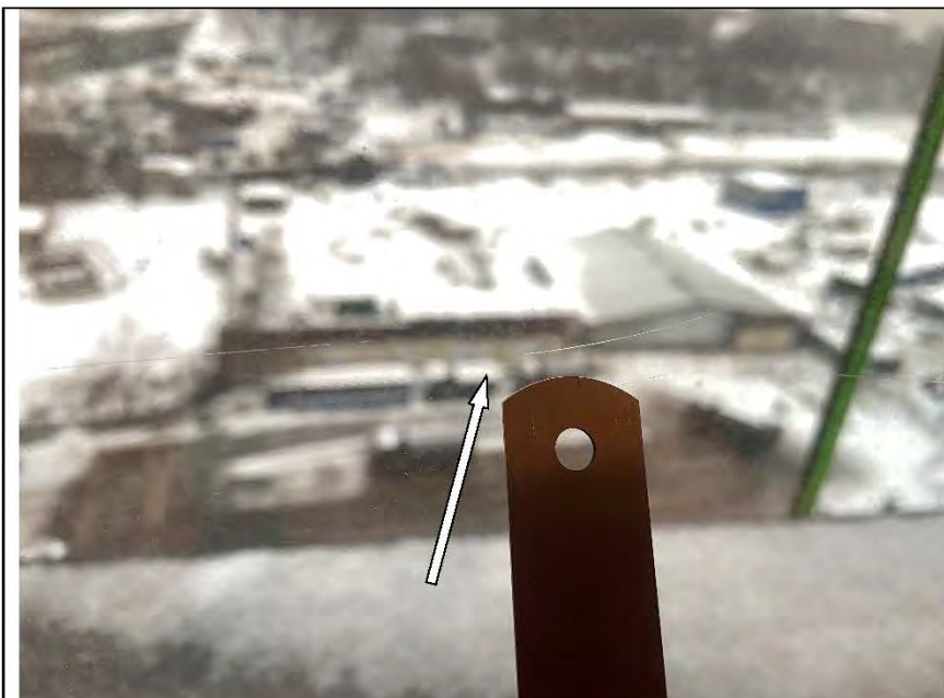
Фото №67. Царапины на стеклопакете оконного блока в гостиной.
