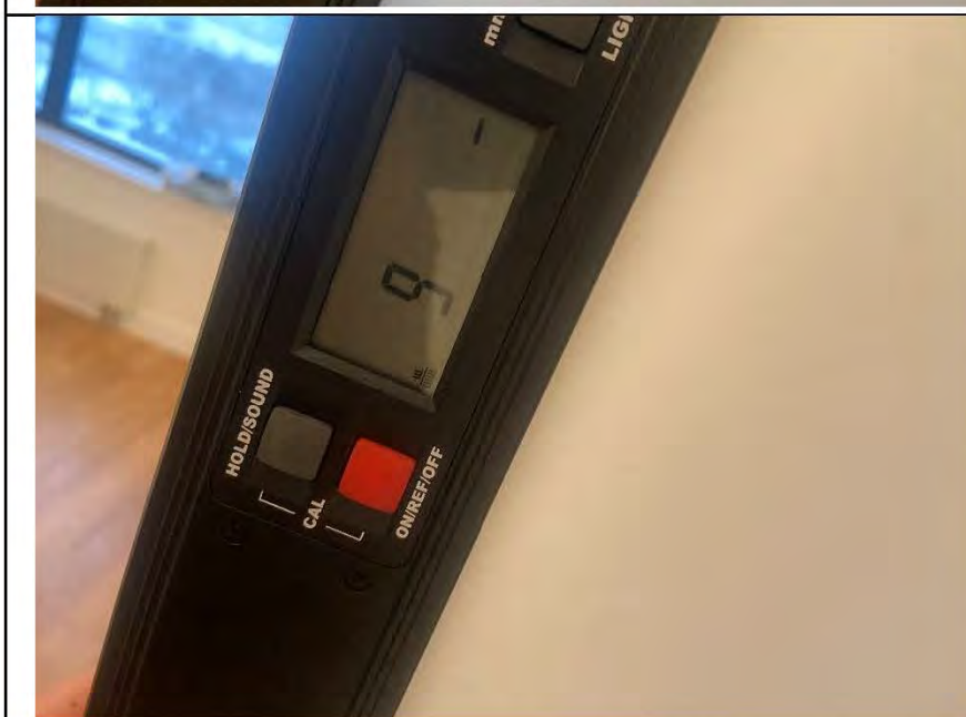
Фото №12. Отклонение поверхности стен от вертикали в спальне.
