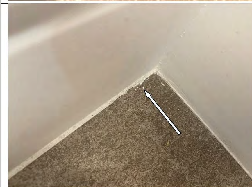
Фото №36. Загрязнения на напольной керамогранитной плитке в коридоре.
