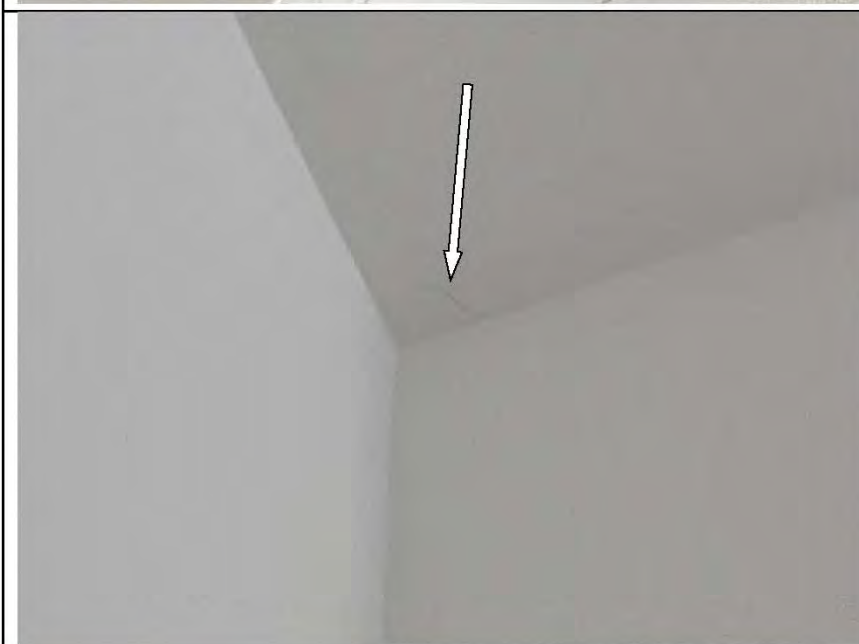
Фото №104. Неровности, выбоины, подтеки на поверхности окрашенного потолка в кабинете.
