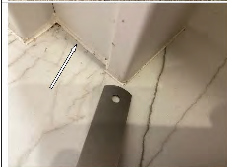
Фото №41. Неровные швы напольной керамогранитной плитки в ванной комнате.
