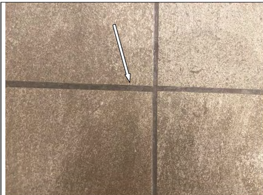
Фото №43. Неровные швы напольной керамогранитной плитки в гостиной.
