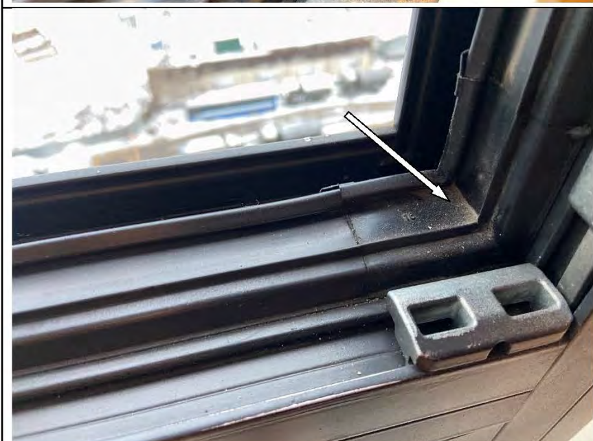
Фото №83. Дефект на алюминиевом профиле оконного блока в спальне.
