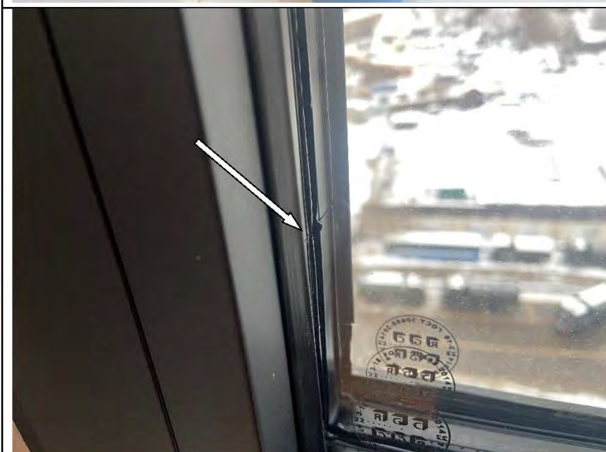
Фото №74. Дефект на уплотнительной ленте оконного блока в кабинете.
