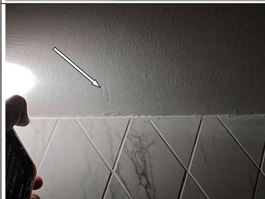
Фото №105. Неровности, выбоины, подтеки на поверхности окрашенного потолка в санузле.
