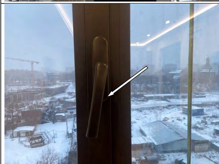
Фото №60. Не отрегулирована фурнитура оконного блока в гостиной.
