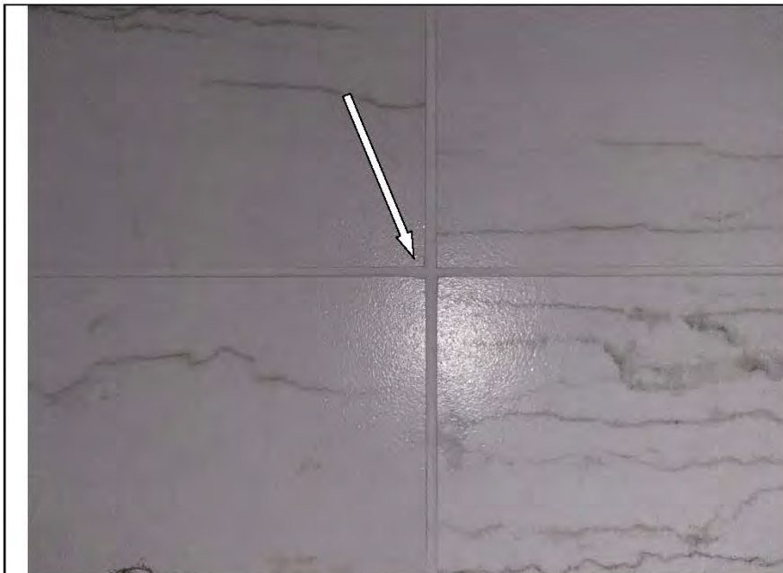
Фото №19. Неровные швы настенной керамогранитной плитки в санузле.
