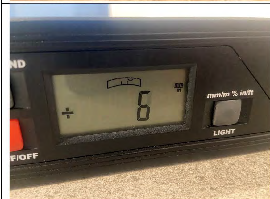
Фото №32. Отклонение поверхности напольного покрытия от плоскости в коридоре.
