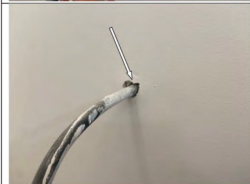
Фото №21. Механическое повреждение на поверхности окрашенных стен в коридоре.
