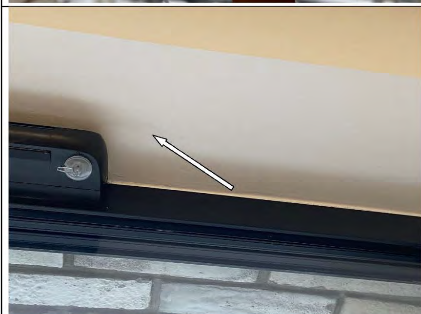
Фото №71. Неровности, выбоины, раковины на окрашенных откосах оконного блока в кабинете.
