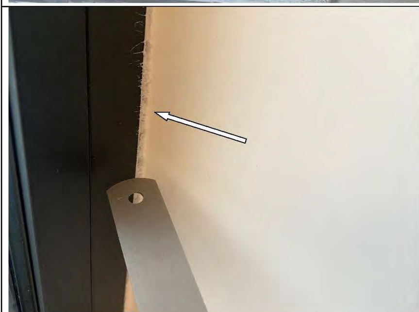
Фото №72. Неровности, выбоины, раковины на окрашенных откосах оконного блока в гостиной.
