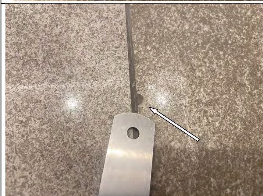
Фото №56. Скол на напольной керамогранитной плитке в гостиной.
