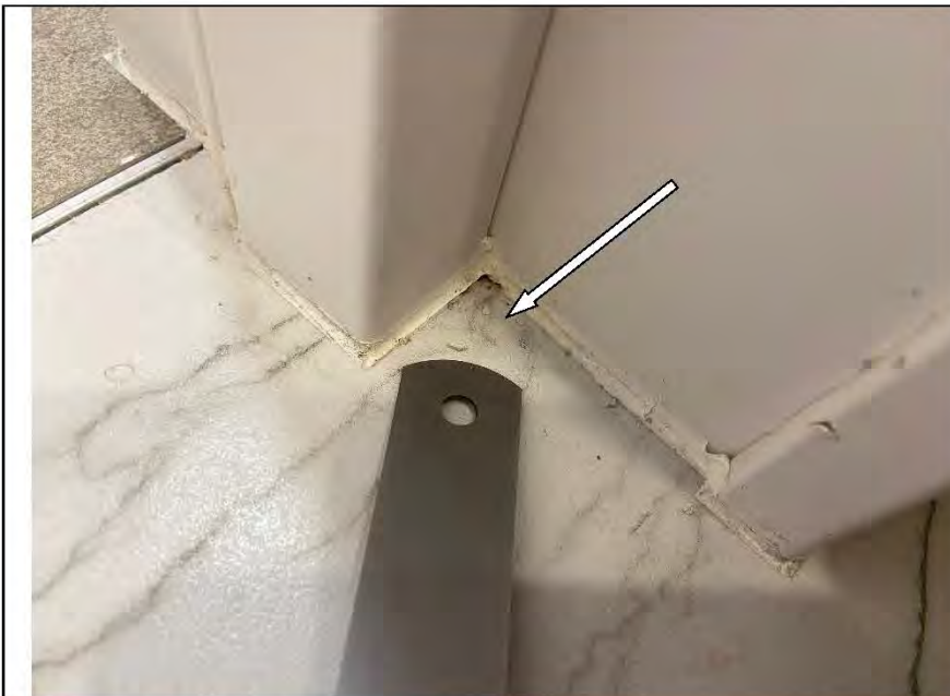
Фото №37. Загрязнения на напольной керамогранитной плитке в ванной комнате.
