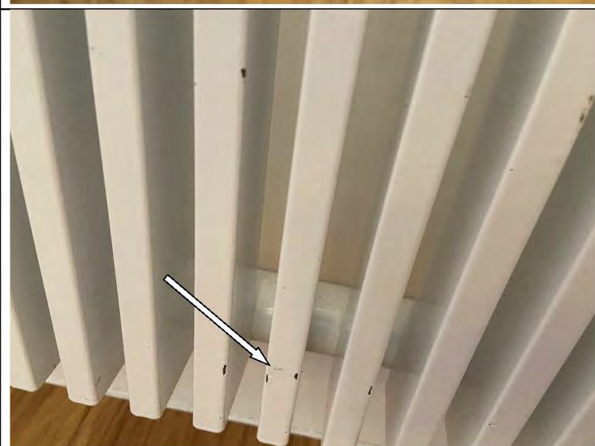
Фото №110. Дефект на отопительном приборе в спальне.
