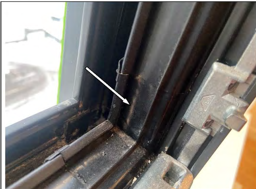
Фото №82. Дефект на алюминиевом профиле оконного блока в гостиной.
