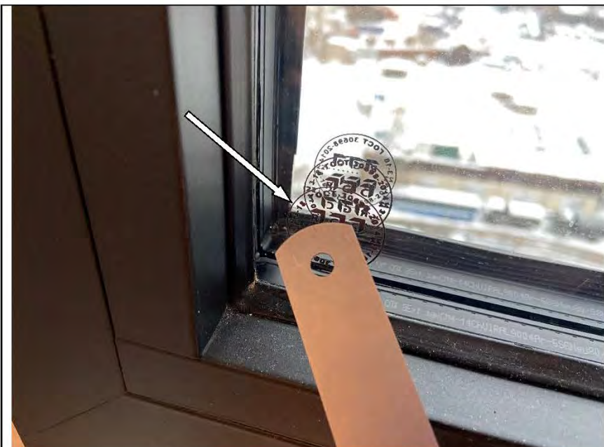
Фото №76. Дефект на уплотнительной ленте оконного блока в спальне.
