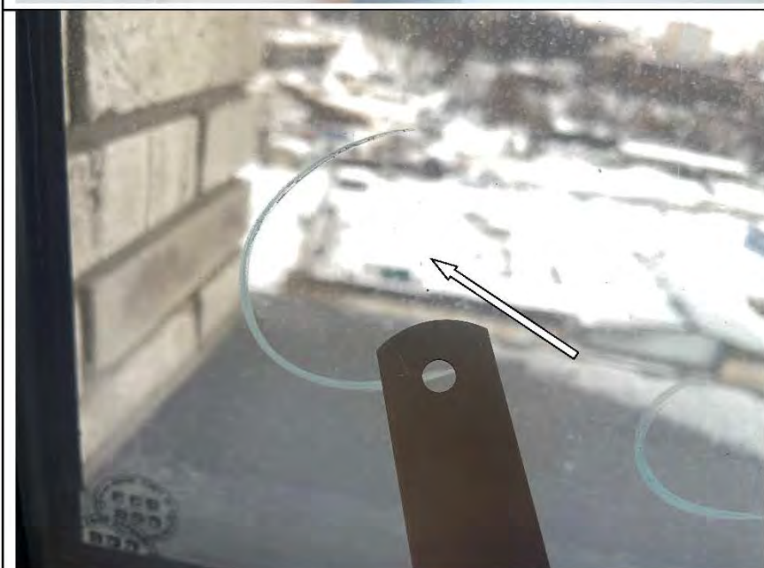
Фото №65. Окалины на стеклопакете оконного блока в кабинете.
