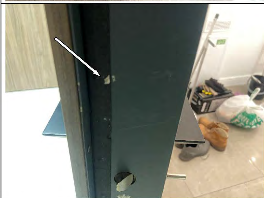
Фото №90. Дефект на полотне входного дверного блока в коридоре.
