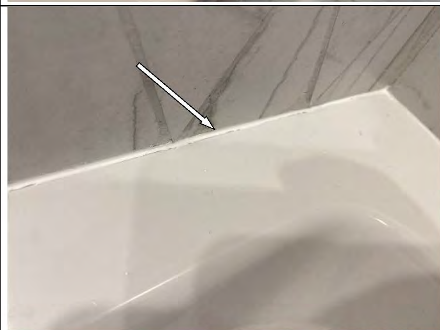
Фото №113. Загрязнения и царапины на ванне в ванной комнате.
