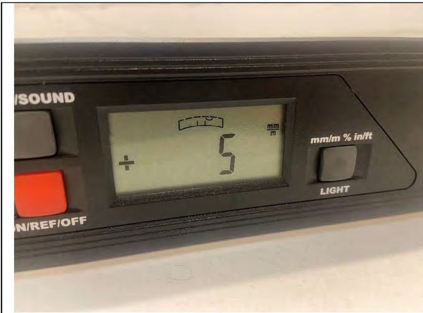
Фото №34. Отклонение поверхности напольного покрытия от плоскости в санузле.
