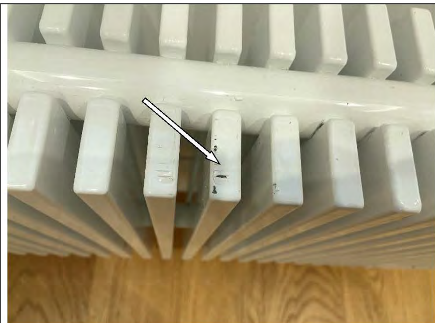
Фото №109. Дефект на отопительном приборе в гостиной.
