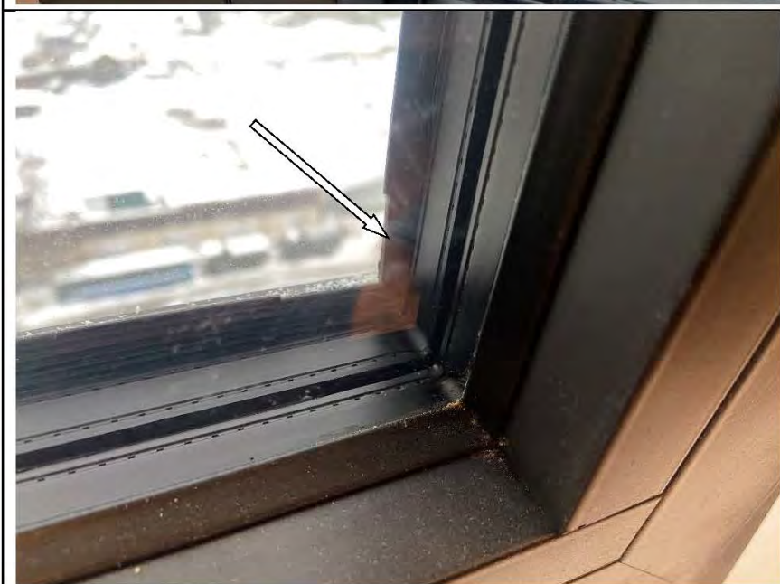
Фото №75. Дефект на уплотнительной ленте оконного блока в гостиной.
