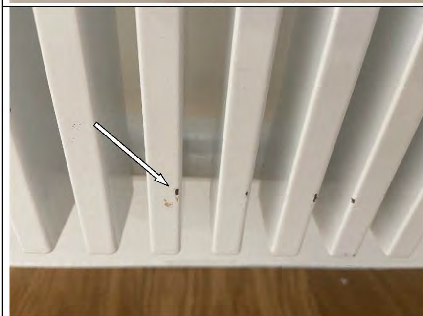
Фото №108. Дефект на отопительном приборе в кабинете.
