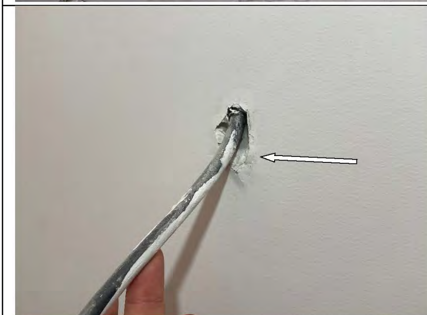
Фото №20. Механическое повреждение на поверхности окрашенных стен в коридоре.
