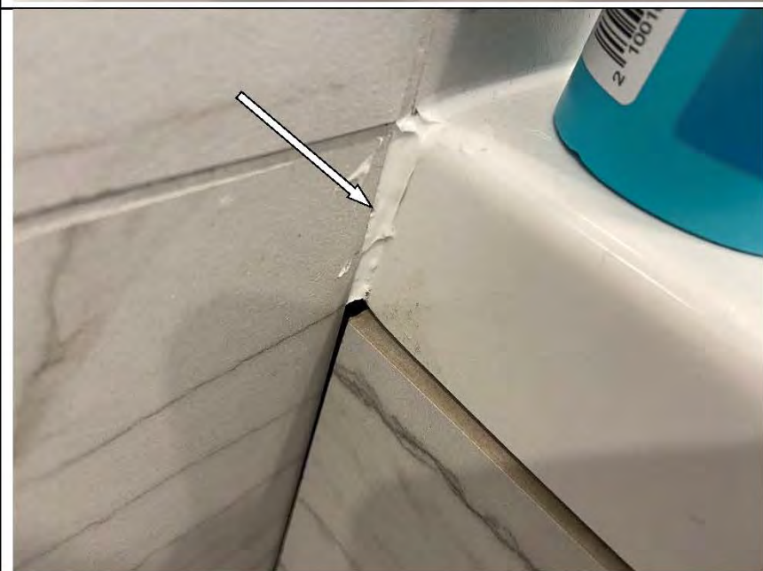
Фото №114. Загрязнения на ванне в санузле.
