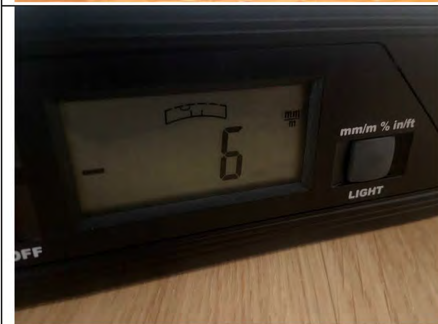
Фото №30. Отклонение поверхности напольного покрытия от плоскости в спальне.
