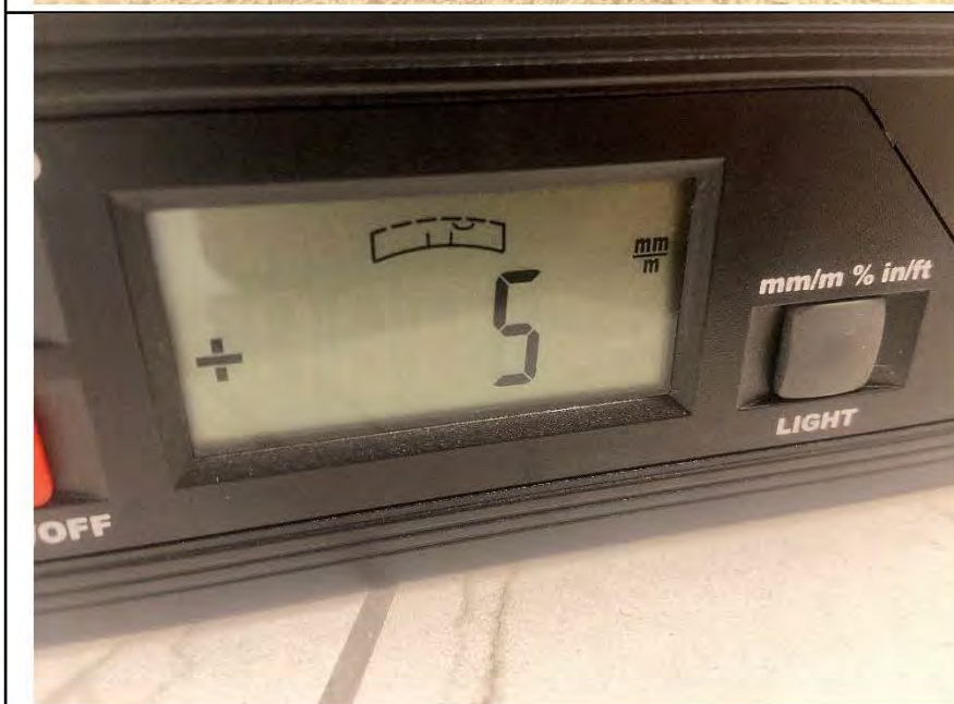
Фото №33. Отклонение поверхности напольного покрытия от плоскости в ванной комнате.
