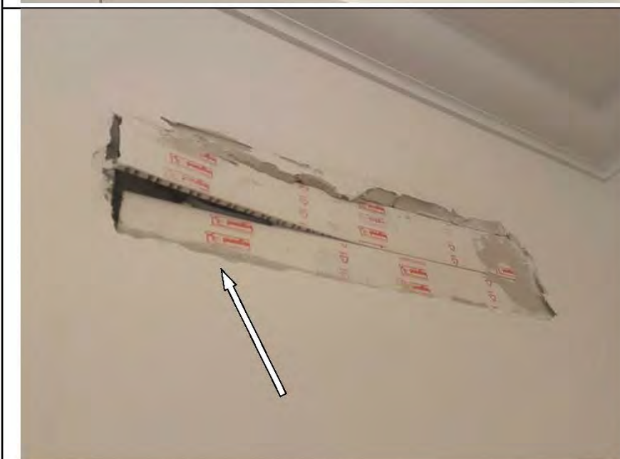
Фото №24. Механическое повреждение на поверхности окрашенных стен в гостиной.
