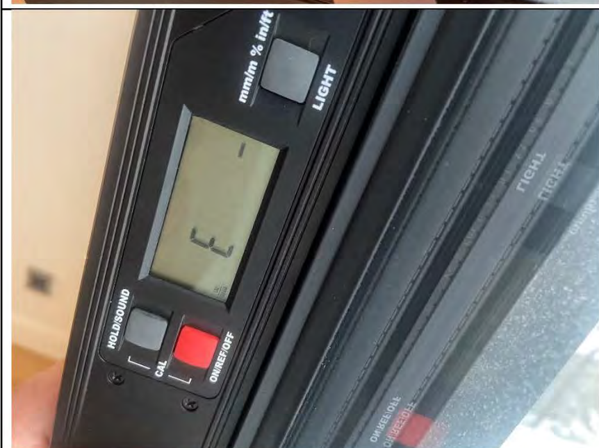
Фото №77. Отклонение от вертикали оконного блока в кабинете.
