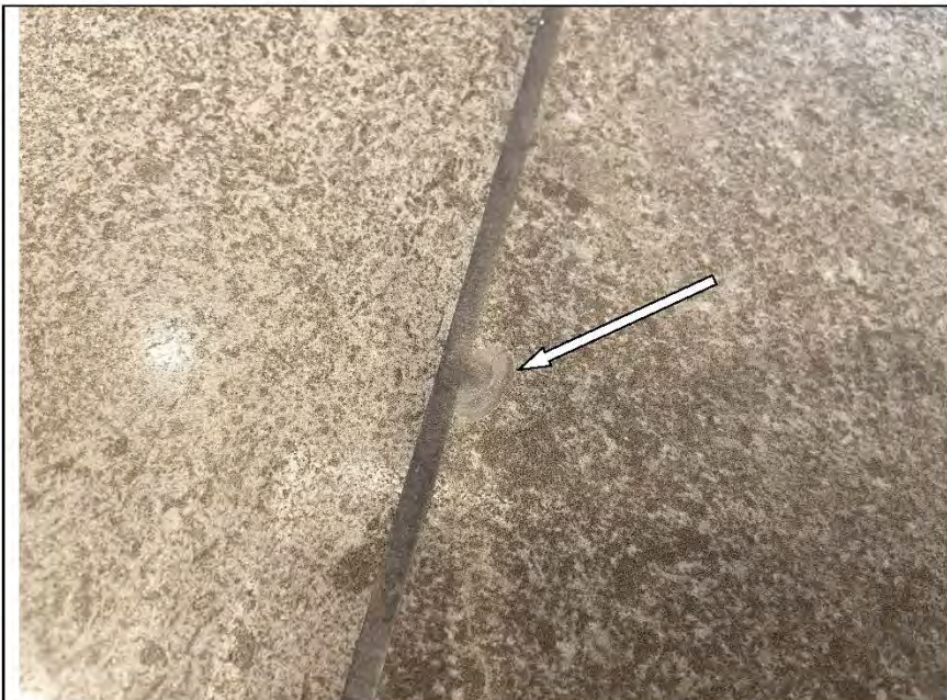
Фото №55. Скол на напольной керамогранитной плитке в коридоре.
