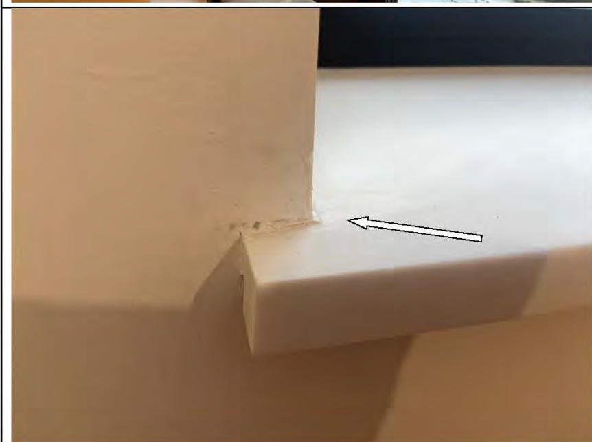
Фото №62. Дефект на лицевой стороне подоконной доски оконного блока в кабинете.
