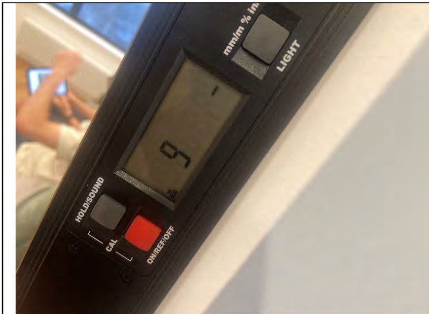
Фото №13. Отклонение поверхности стен от вертикали в гостиной.
