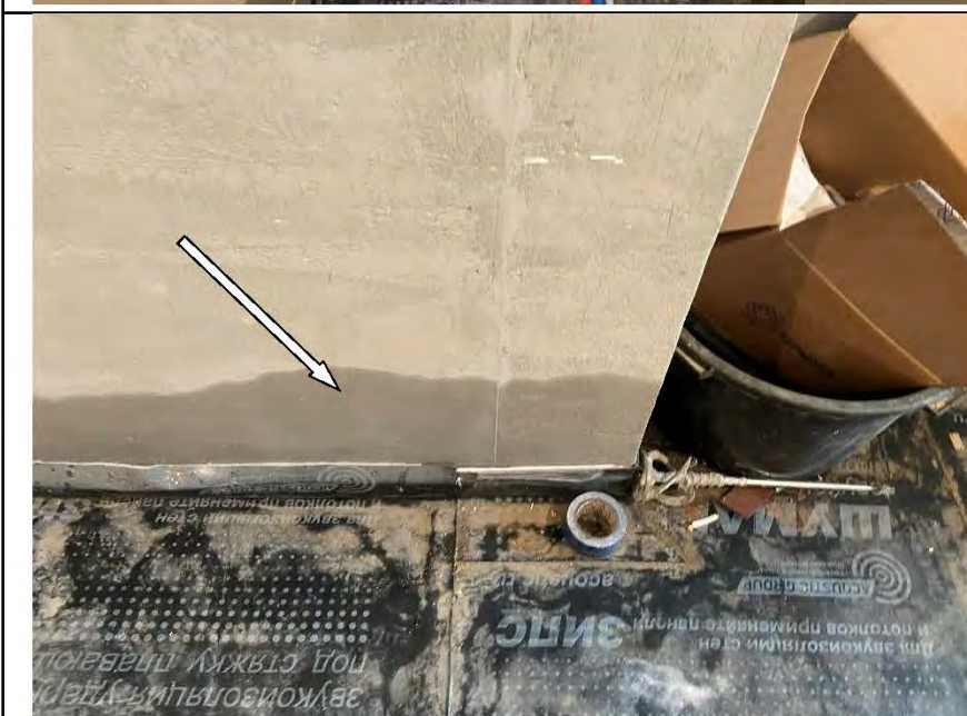
Фото №21. Следы заливки на стенах и напольном покрытии в квартире.
