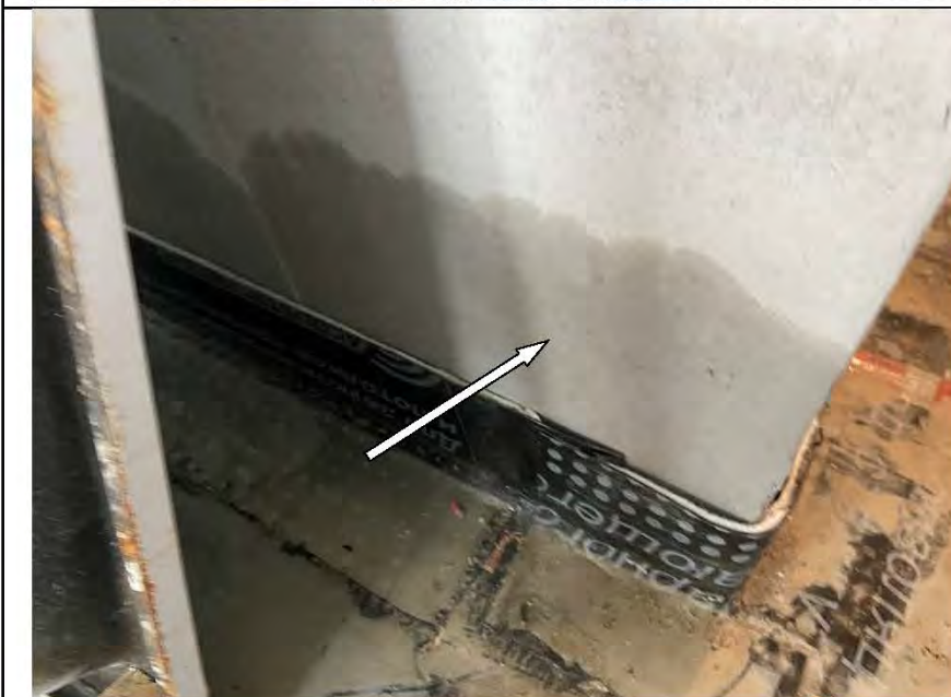
Фото №23. Следы залития на стенах и напольном покрытии в квартире.
