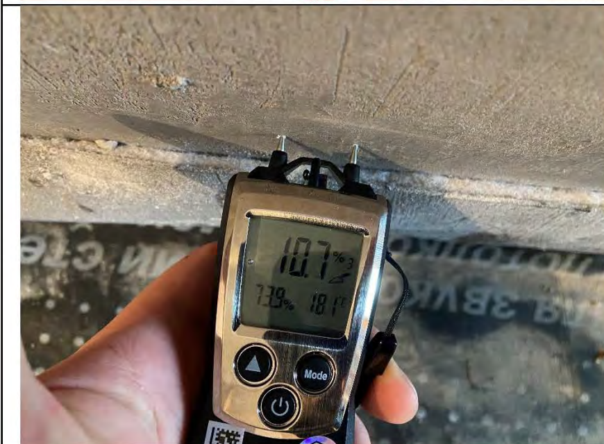
Фото №11. Следы заливки на стенах и напольном покрытии в квартире.
