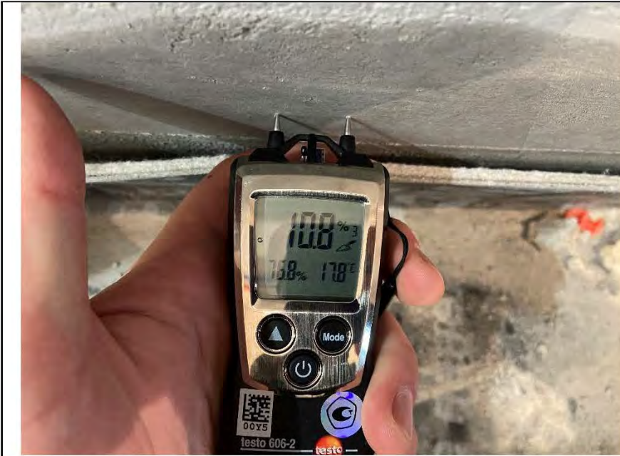
Фото №10. Следы заливки на стенах и напольном покрытии в квартире.
