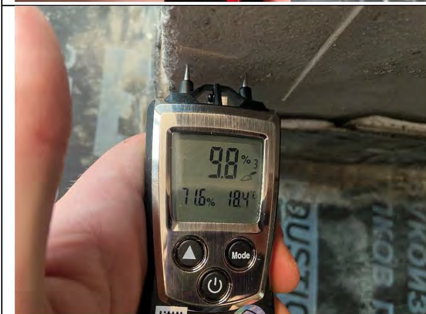
Фото №17. Следы залития на стенах и напольном покрытии в квартире.
