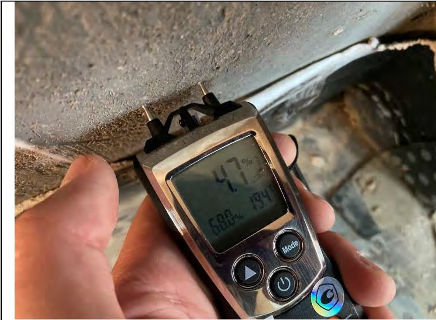
Фото №19. Следы заливки на стенах и напольном покрытии в квартире.
