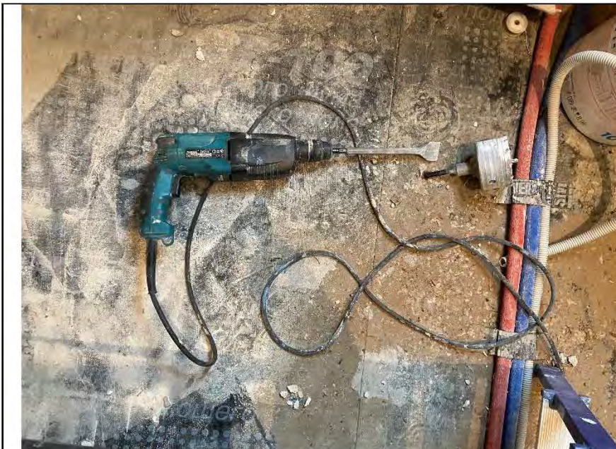
Фото №25. Поврежденные строительные инструменты в результате залива в квартире.
