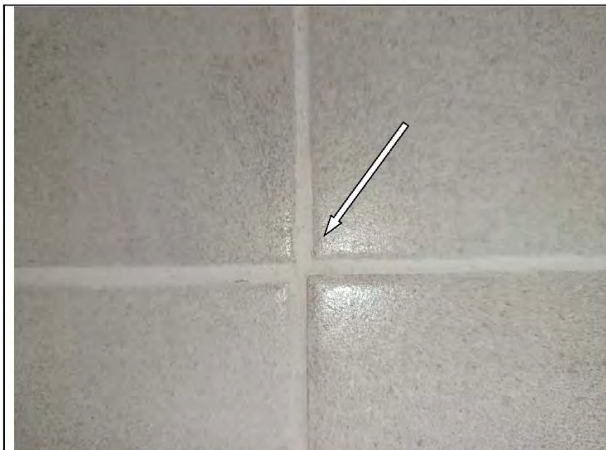
Фото №58. Затирка напольной плитки выполнена с нарушениями в кухне.
