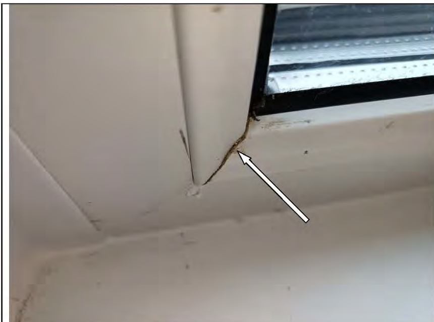
Фото №79. Зазоры в месте стыка профилей ПВХ оконного блока в спальне.
