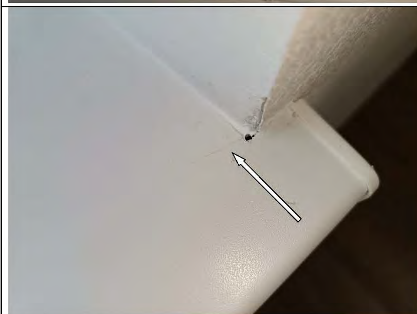
Фото №99. Царапины на лицевой поверхности подоконной доски в кухне.
