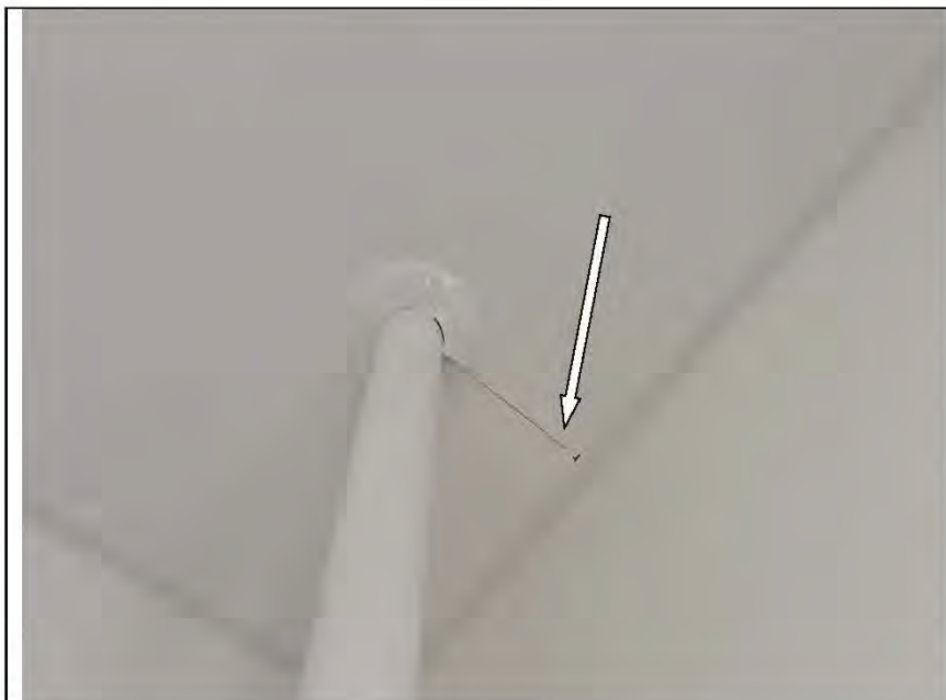
Фото №139. Отсутствие декоративных пластиковых обводов в проходе труб отопления в спальне.
