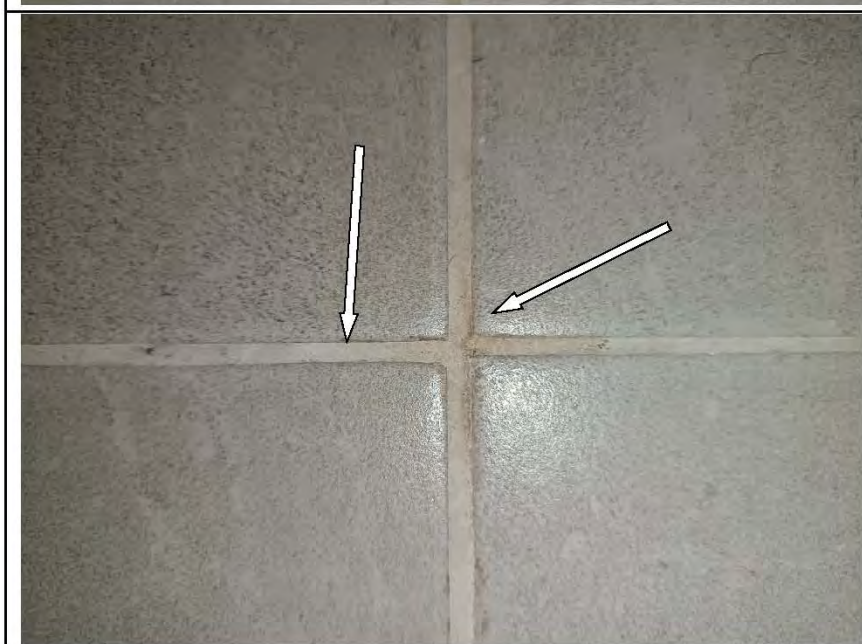
Фото №60. Затирка напольной плитки выполнена с нарушениями в ванной комнате.
