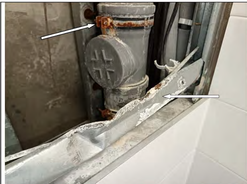
Фото №142. Повреждение металлических элементов крепёжной системы панелей вентиляционной шахты, коррозия на металлических профилях в санузле.
