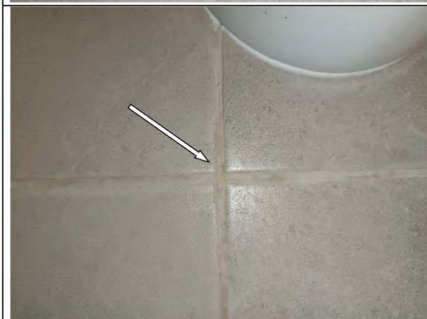
Фото №59. Затирка напольной плитки выполнена с нарушениями в санузле.
