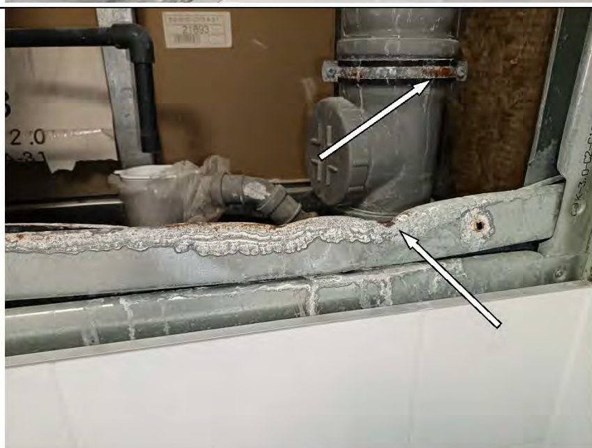
Фото №143. Повреждение металлических элементов крепёжной системы панелей вентиляционной шахты, коррозия на металлических профилях в ванной комнате.
