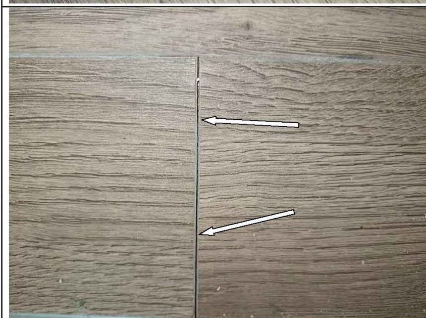
Фото №63. Зазор между соседними досками ламината в коридоре.
