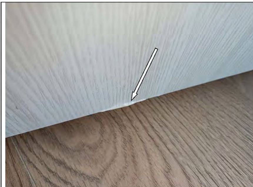
Фото №118. Повреждение ламинации короба деревянного дверного блока в спальне.
