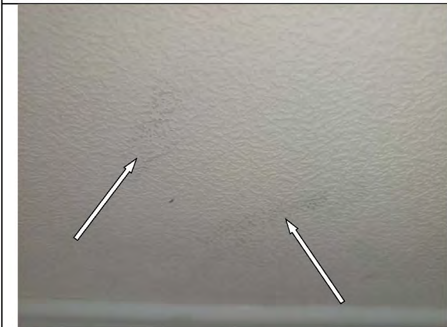
Фото №35. Загрязнение обойного полотна в кухне.
