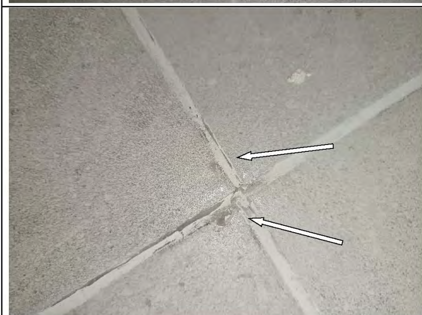
Фото №57. Затирка напольной плитки выполнена с нарушениями в кухне.
