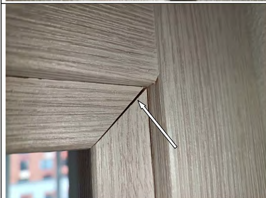
Фото №113. Элементы короба дверного блока соединены не надежно в детской.
