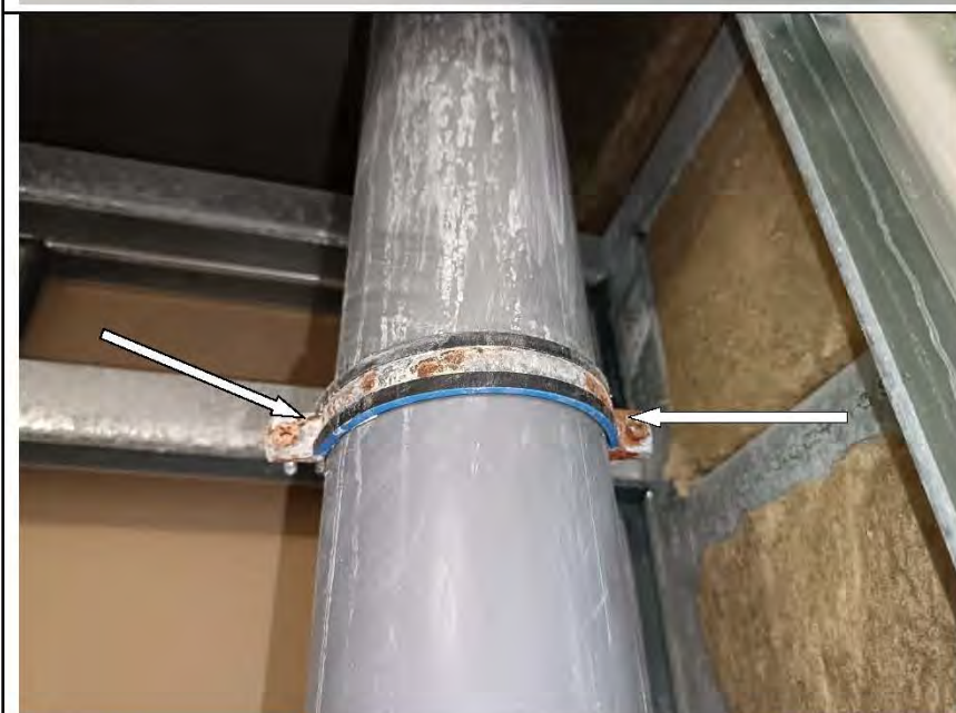
Фото №144. Коррозия на крепёжном элементе канализационной трубы в ванной комнате.
