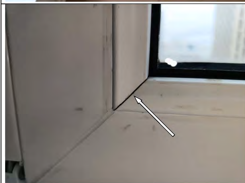
Фото №78. Зазоры в месте стыка профилей ПВХ оконного блока в гостиной.
