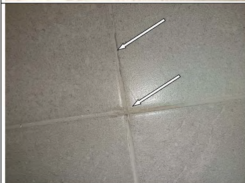
Фото №56. Затирка напольной плитки выполнена с нарушениями в прихожей.
