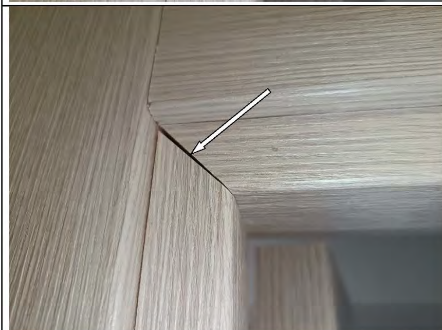
Фото №110. Элементы короба дверного блока соединены не надежно в ванной комнате.
