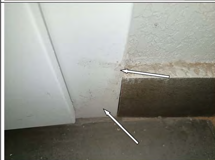
Фото №108. Загрязнение короба входного дверного блока.
