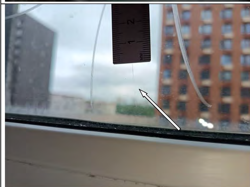
Фото №98. Царапины на стеклопакете оконного блока ПВХ в детской.
