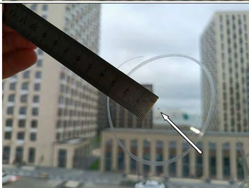
Фото №92. Окалины на стеклопакете оконного блока ПВХ в спальне.
