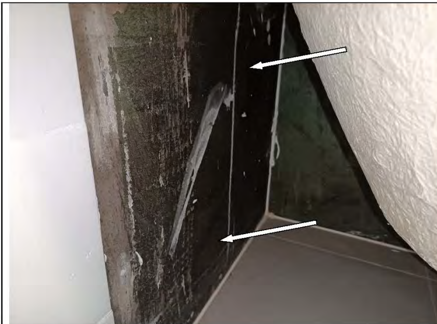
Фото №133. Частично отсутствует настенная керамическая плитка за ванной.
