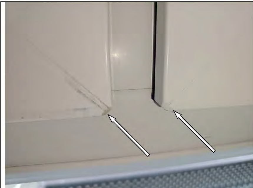
Фото №82. Повреждение профиля ПВХ оконного блока в спальне.
