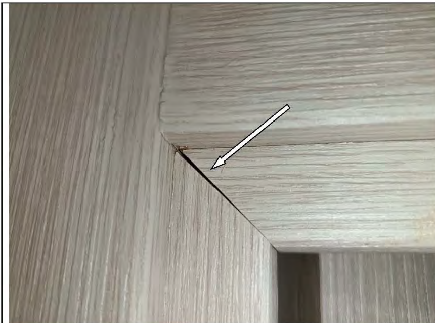
Фото №112. Элементы короба дверного блока соединены не надежно в спальне.
