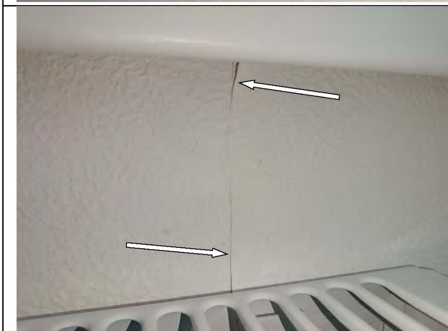
Фото №41. Читаемые обойные стыки, отслоение обойного полотна в спальне.
