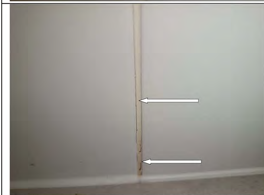
Фото №45. Затирка настенной плитки в санузле выполнена с нарушениями.
