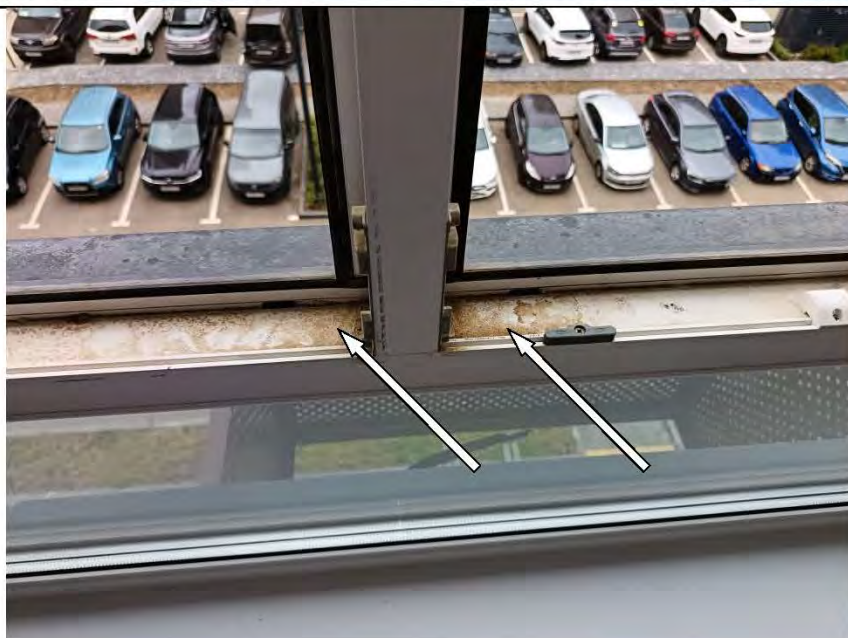
Фото №83. Загрязнение профиля ПВХ оконного блока в спальне.
