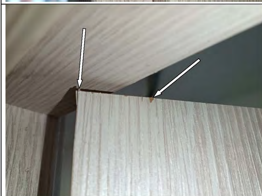
Фото №114. Повреждение ламинации полотна деревянного дверного блока в ванной комнате.
