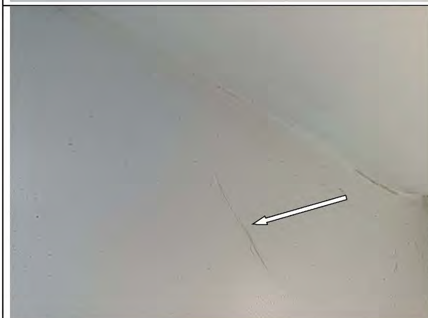
Фото №104. Царапины на лицевой поверхности подоконной доски в спальне.
