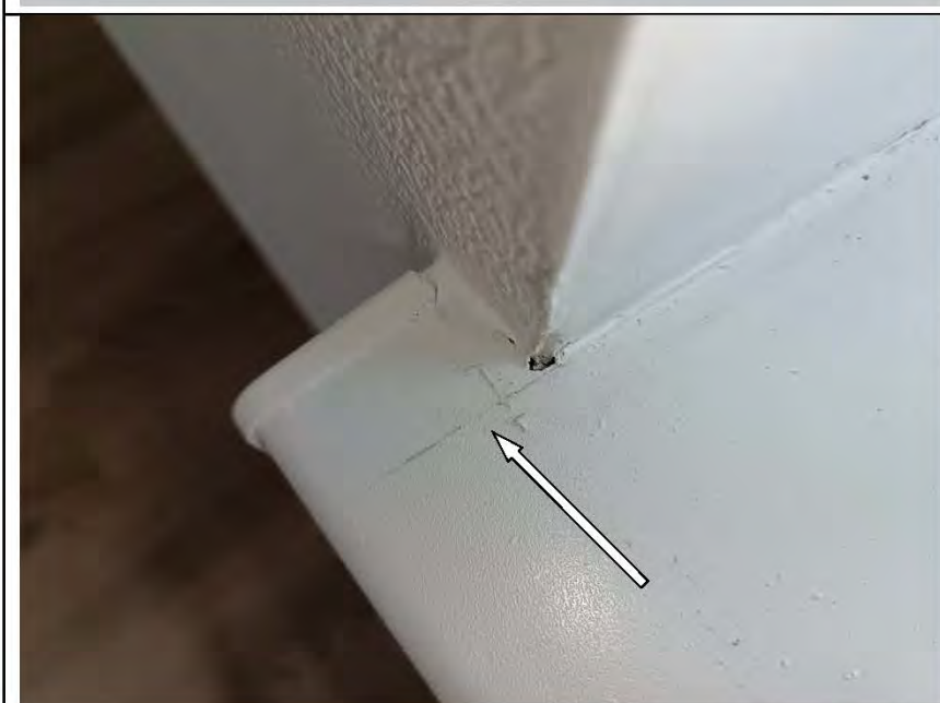
Фото №101. Царапины на лицевой поверхности подоконной доски в гостиной.
