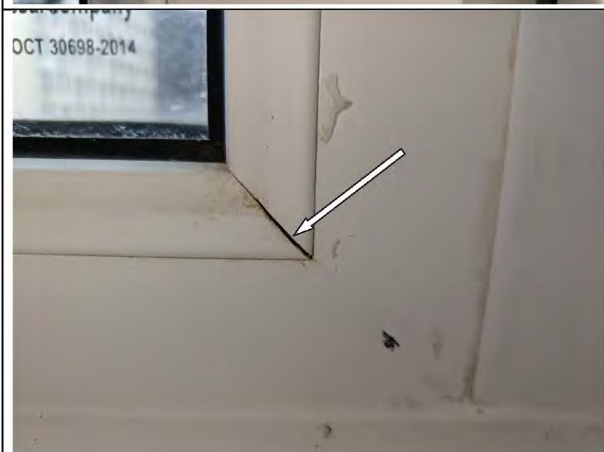
Фото №81. Зазоры в месте стыка профилей ПВХ оконного блока в спальне.
