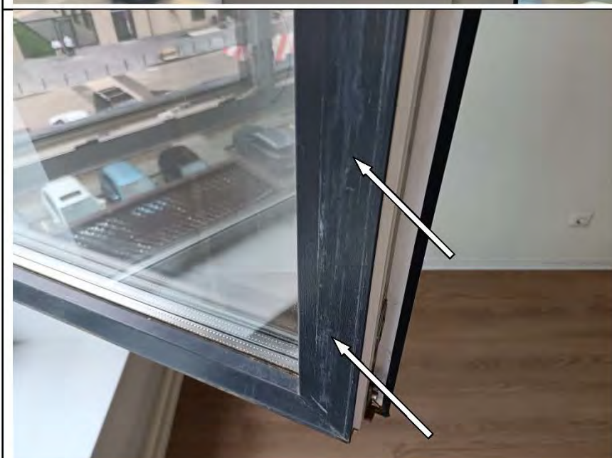
Фото №77. Загрязнение профиля ПВХ оконного блока в гостиной.
