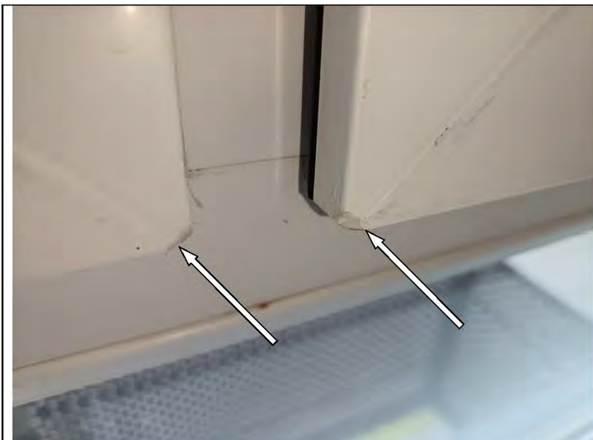
Фото №73. Повреждение профиля ПВХ оконного блока в кухне.
