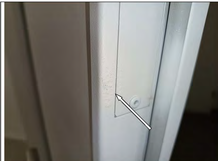
Фото №106. Загрязнение полотна входного дверного блока.
