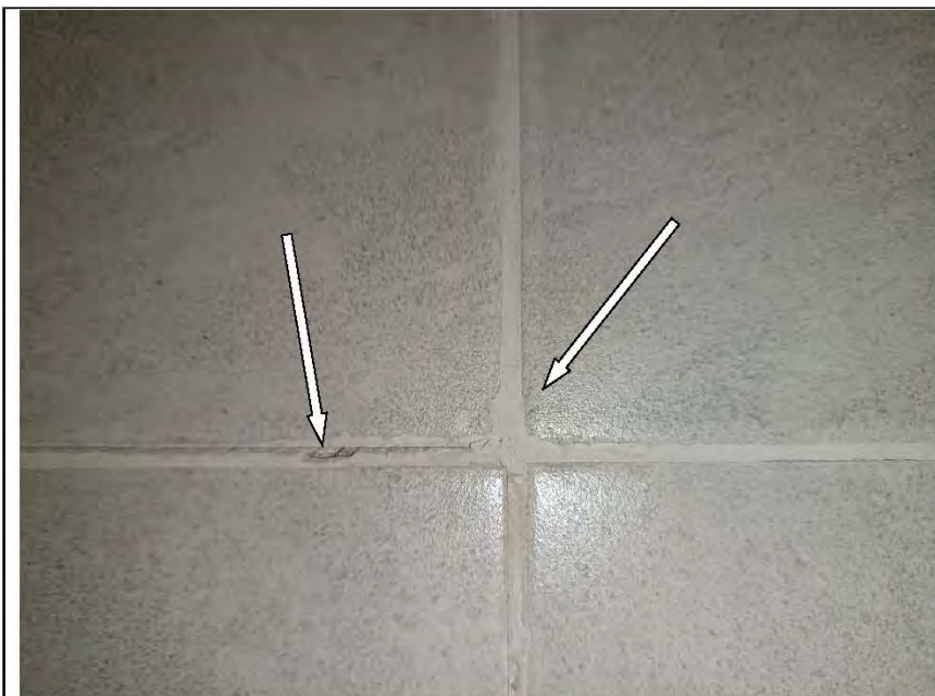
Фото №61. Затирка напольной плитки выполнена с нарушениями в ванной комнате.
