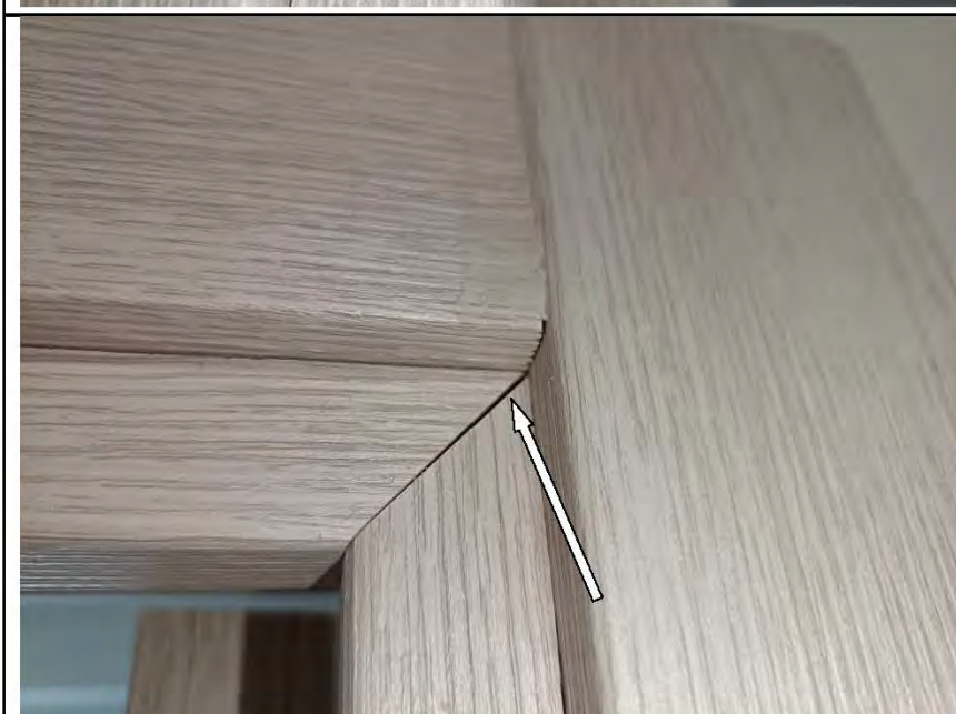
Фото №111. Элементы короба дверного блока соединены не надежно в гостиной.
