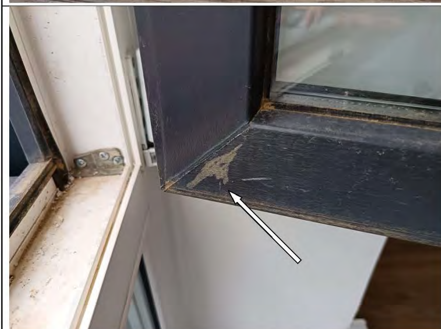
Фото №71. Загрязнение профиля ПВХ оконного блока в кухне.
