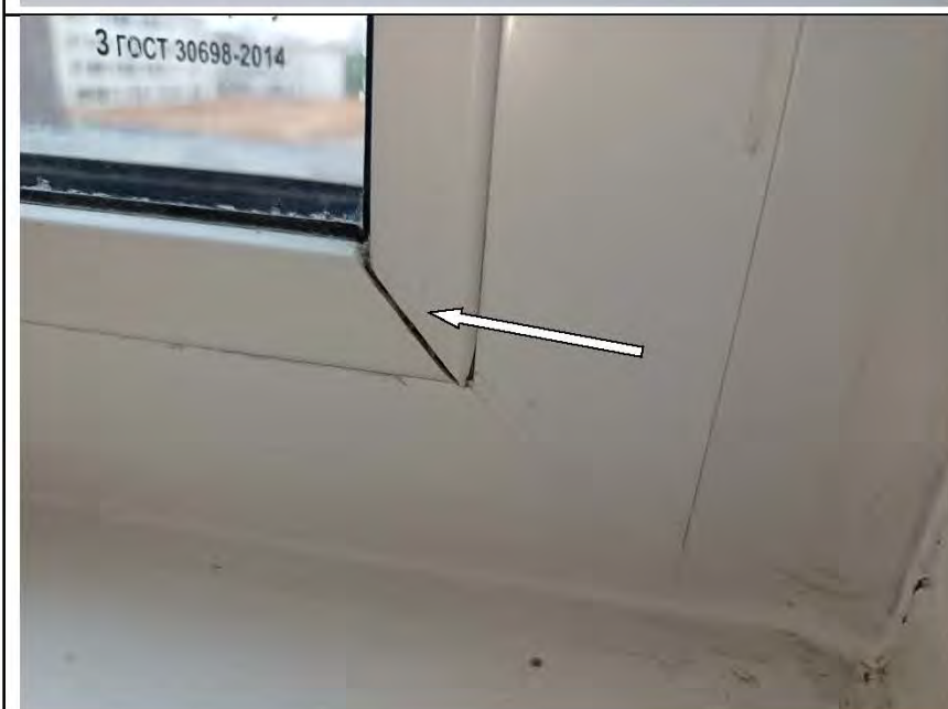
Фото №87. Зазоры в месте стыка профилей ПВХ оконного блока в детской.
