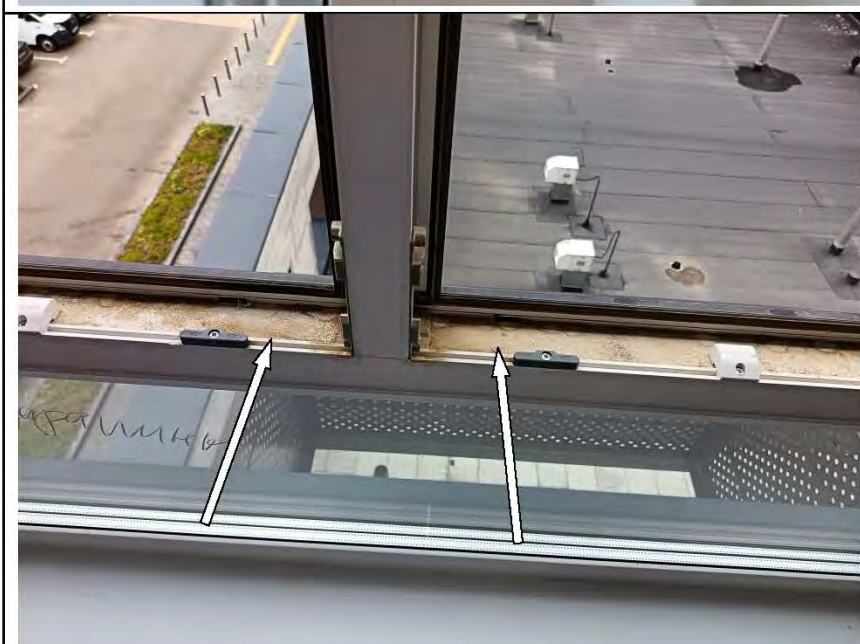
Фото №86. Загрязнение профиля ПВХ оконного блока в спальне.
