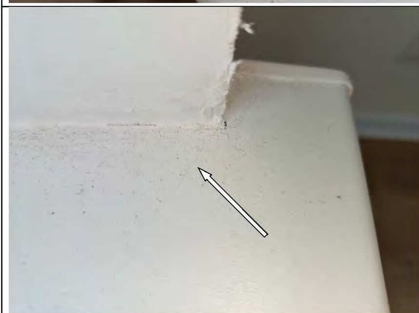
Фото №102. Царапины на лицевой поверхности подоконной доски в спальне.
