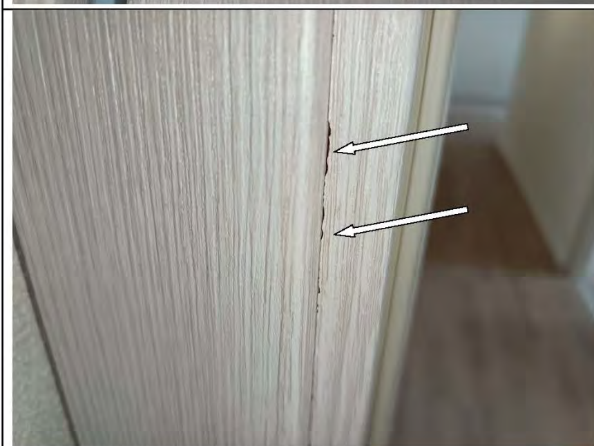
Фото №120. Повреждение ламинации короба деревянного дверного блока в детской.
