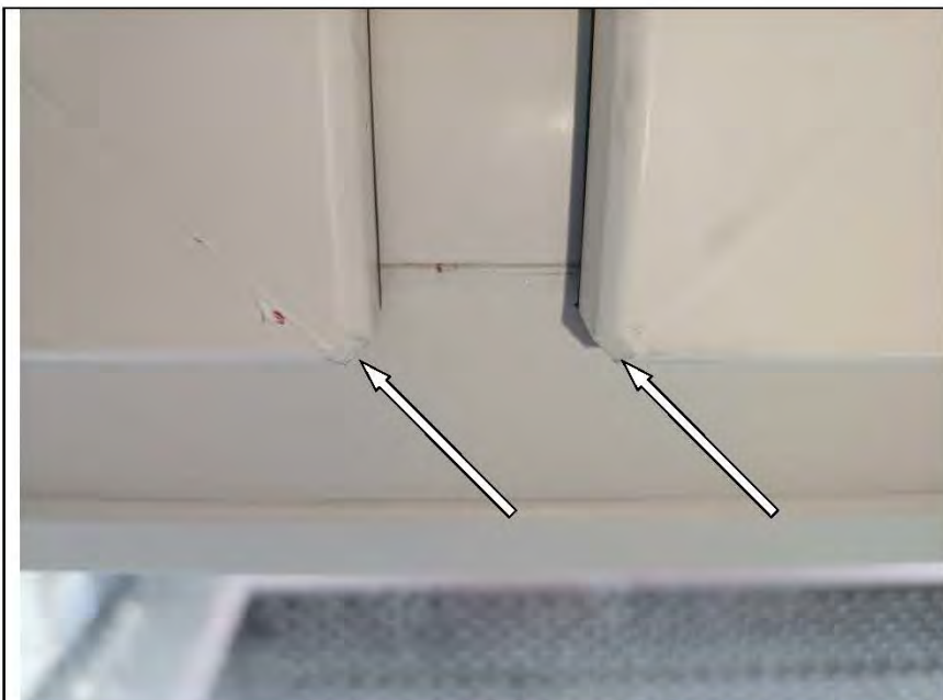
Фото №88. Повреждение профиля ПВХ оконного блока в детской.
