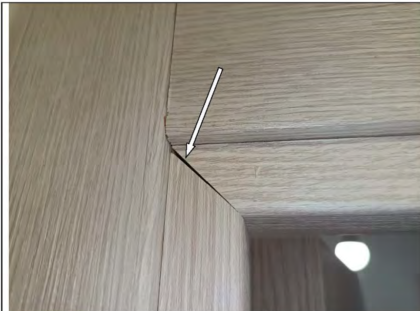
Фото №109. Элементы короба дверного блока соединены не надежно в санузле.
