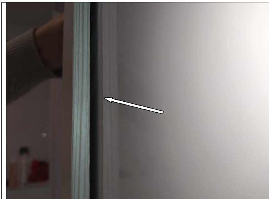
Фото №61. Неплотное прилегание дверного наличника к стене в ванной комнате.
