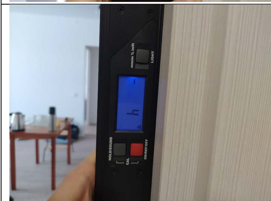
Фото №48. Отклонение коробки дверного блока в санузле.
