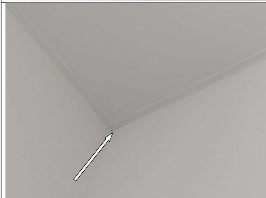
Фото №77. Дефект монтажа декоративного молдинга натяжного потолка в кухне.
