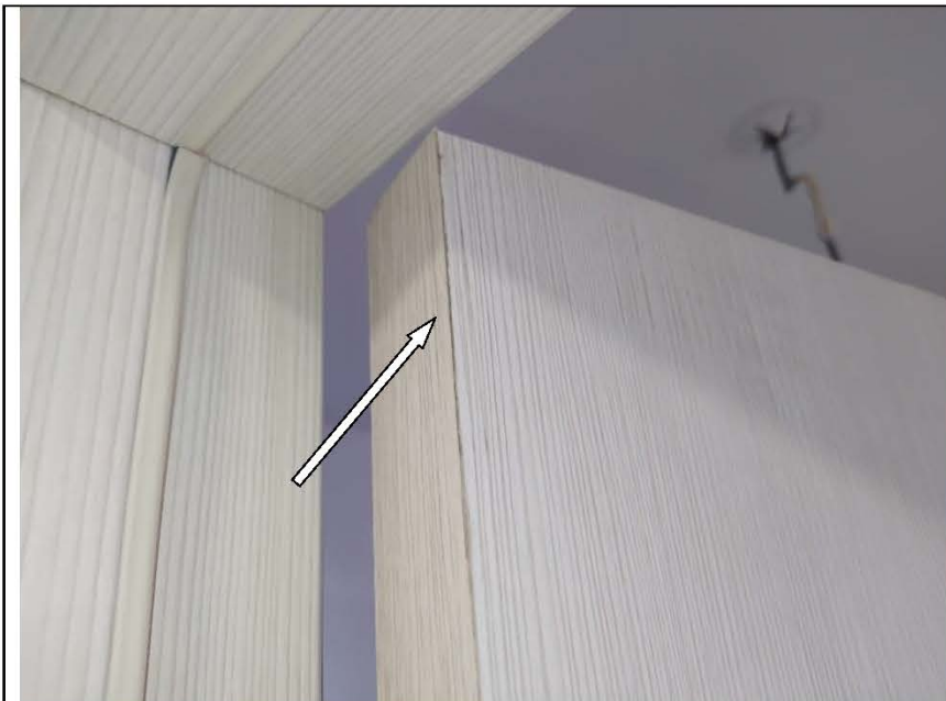
Фото №58. Дефекты (отслоение ламинации) на лицевой поверхности полотна деревянного дверного блока в ванной комнате.
