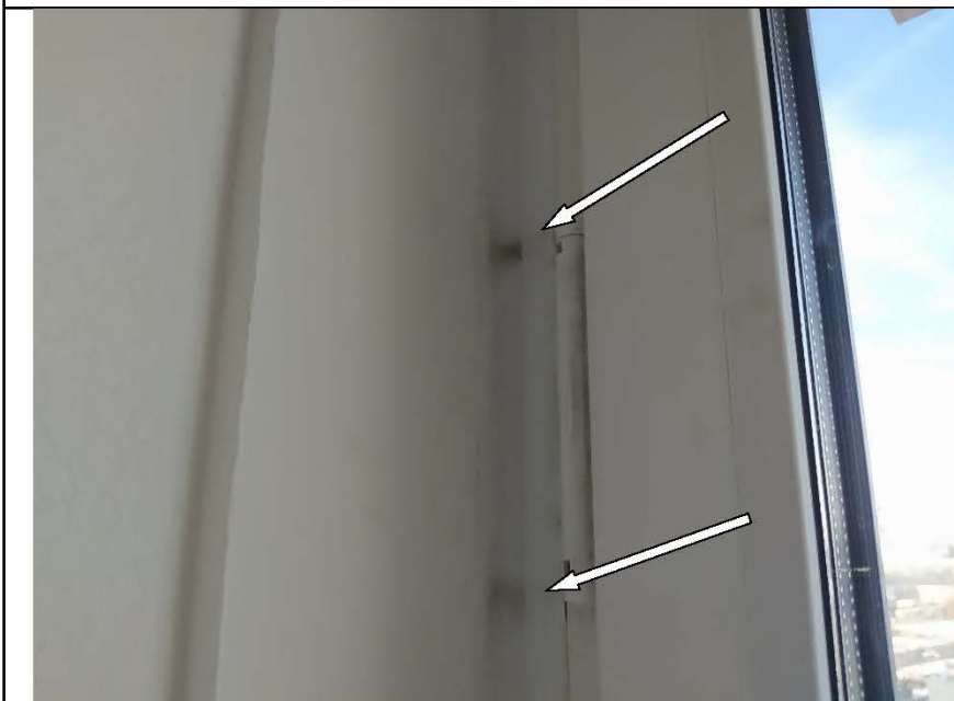
Фото №35. Следы скопления пыли, свидетельствующие об инфильтрации воздуха через петли оконного блока в спальне.
