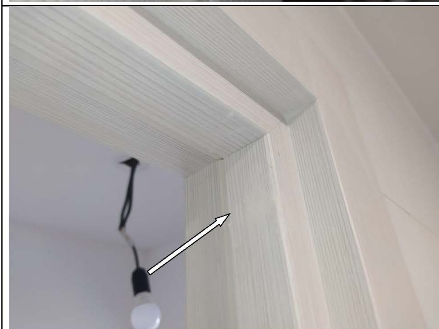
Фото №53. Коробка деревянного дверного блока в ванной комнате имеет дефекты (загрязнение малярными составами).
