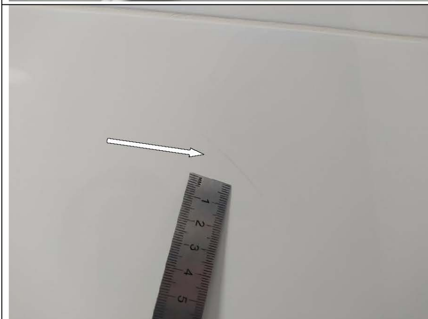
Фото №68. Царапина на настенной керамической плитке в санузле.
