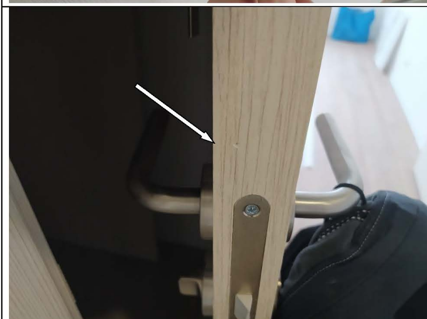
Фото №57. Дефекты (скол) на лицевой поверхности полотна деревянного дверного блока в санузле.
