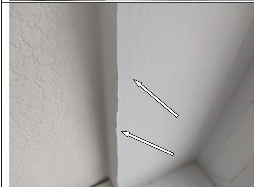
Фото №21. Окрашенные откосы оконного блока в гостиной выполнены с дефектами (раковины, неровность очертания углов).
