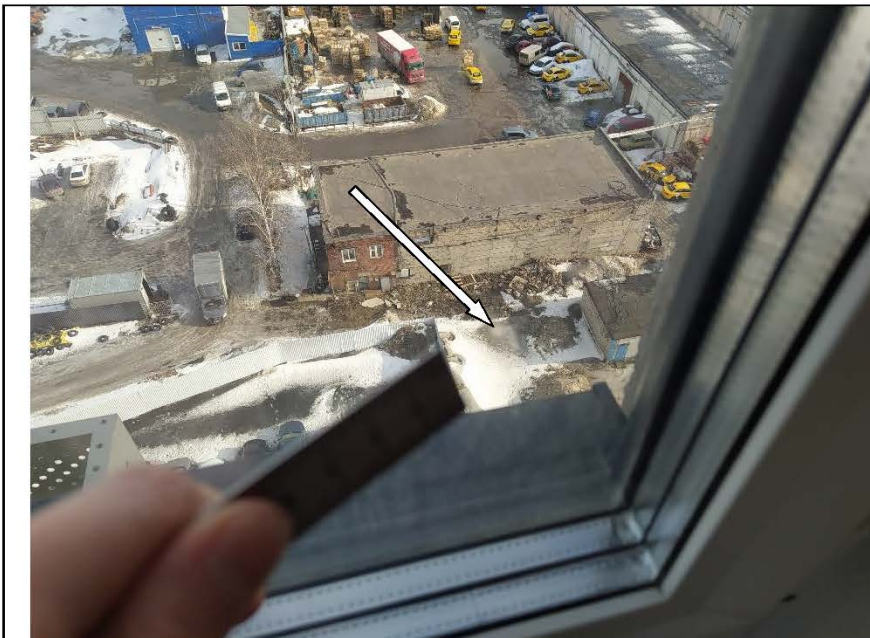
Фото №31. На стеклопакете оконного блока в гостиной имеется дефект (царапина).
