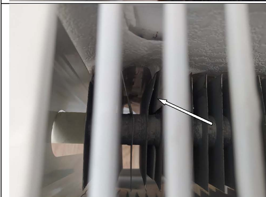
Фото №42. Радиатор в гостиной имеет дефекты (замытие)
