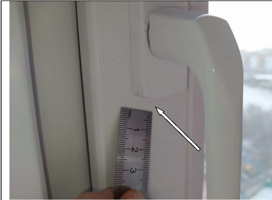
Фото №28. Профиль ПВХ оконного блока в гостиной имеет дефекты (царапина).
