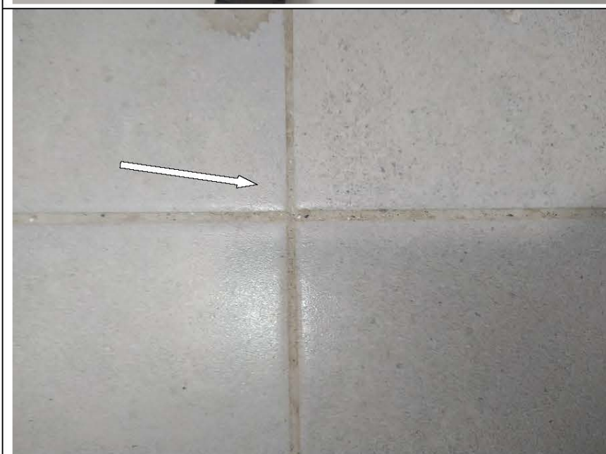
Фото №69. Затирка напольной плитки выполнена с нарушениями в санузле: разность ширины шва
