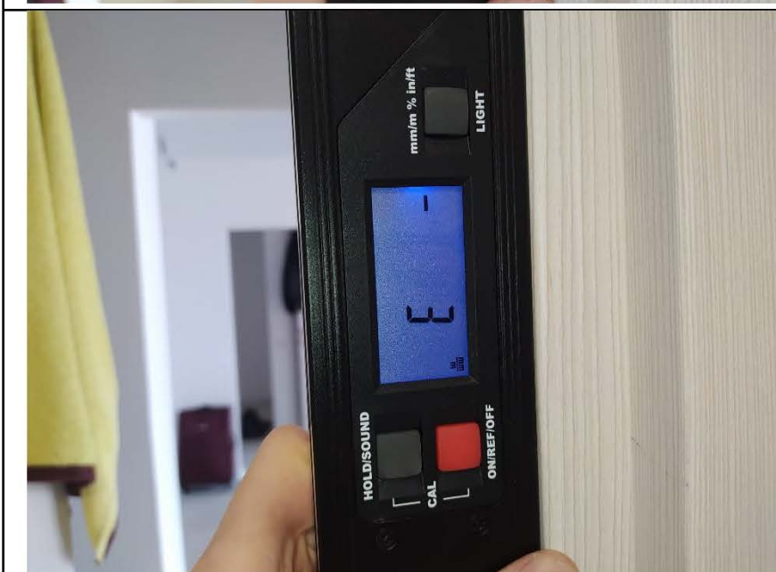
Фото №47. Отклонение коробки дверного блока в ванной комнате.
