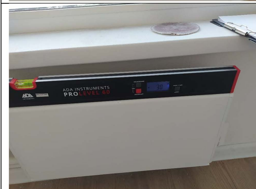
Фото №44. Отопительный прибор смонтирован неровно в спальне.
