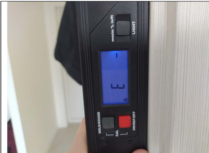
Фото №46. Отклонение коробки дверного блока в спальне.
