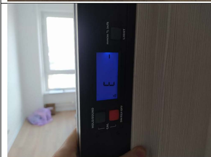
Фото №45. Отклонение коробки дверного блока в гостиной.
