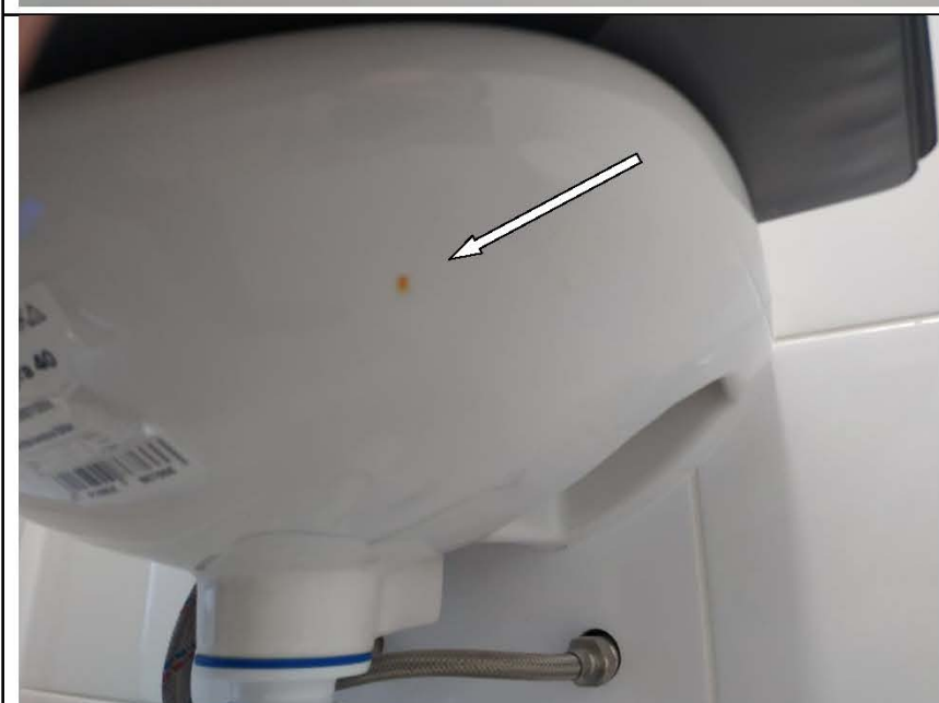
Фото №87. Загрязнение на раковине в санузле.
