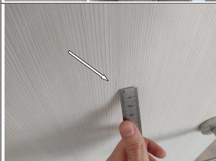
Фото №56. Дефекты (царапина) на лицевой поверхности полотна деревянного дверного блока в спальне.
