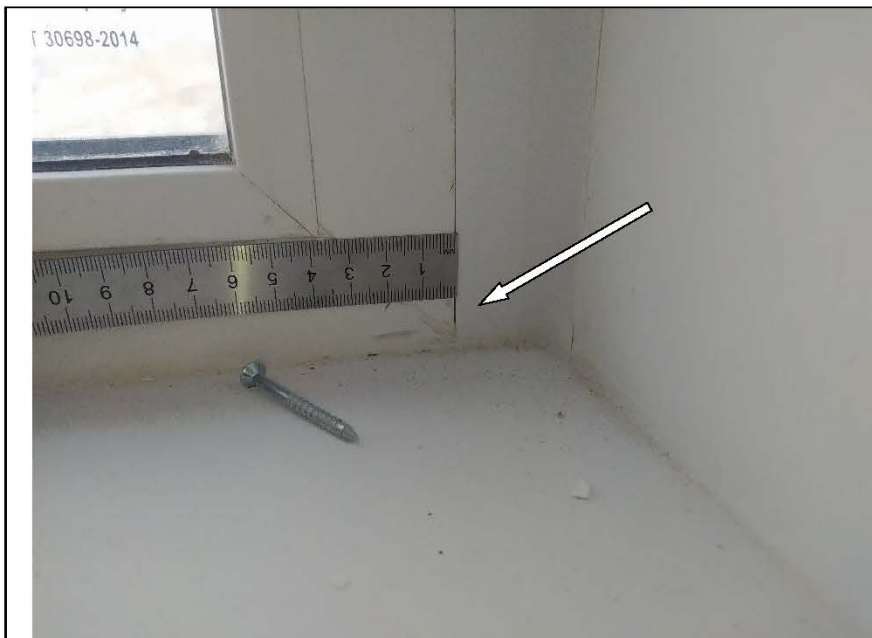
Фото №25. Профиль ПВХ оконного блока в кухне имеет дефекты (зазор).
