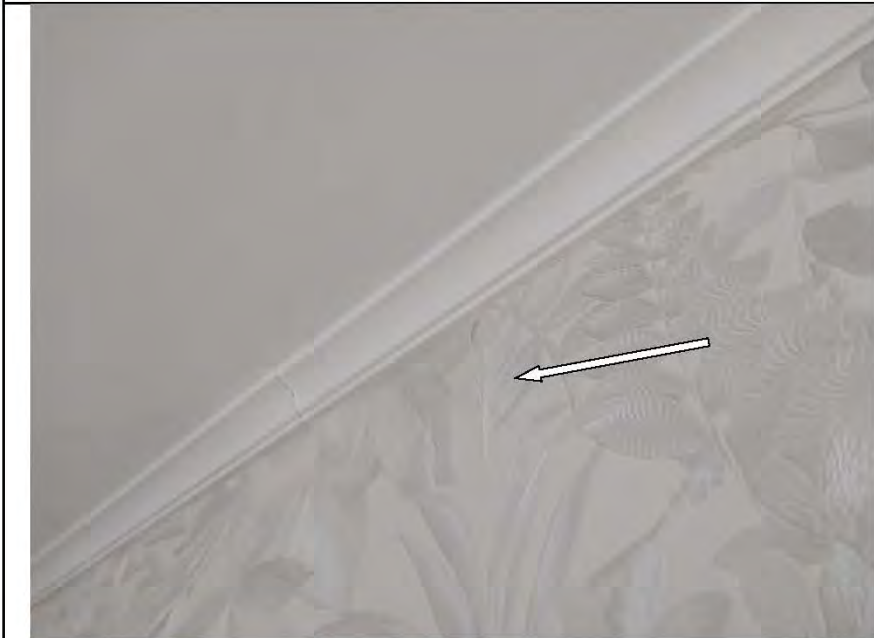
Фото №14. Стены, оклеенные обоями, в гостиной-спальне имеют дефекты характерные последствиям залива (отслоение).
