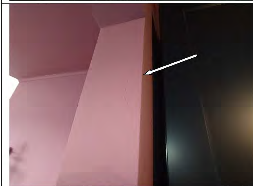
Фото №8. Оштукатуренные и окрашенные стены в гардеробной имеют дефекты характерные последствиям залива (отслоение).
