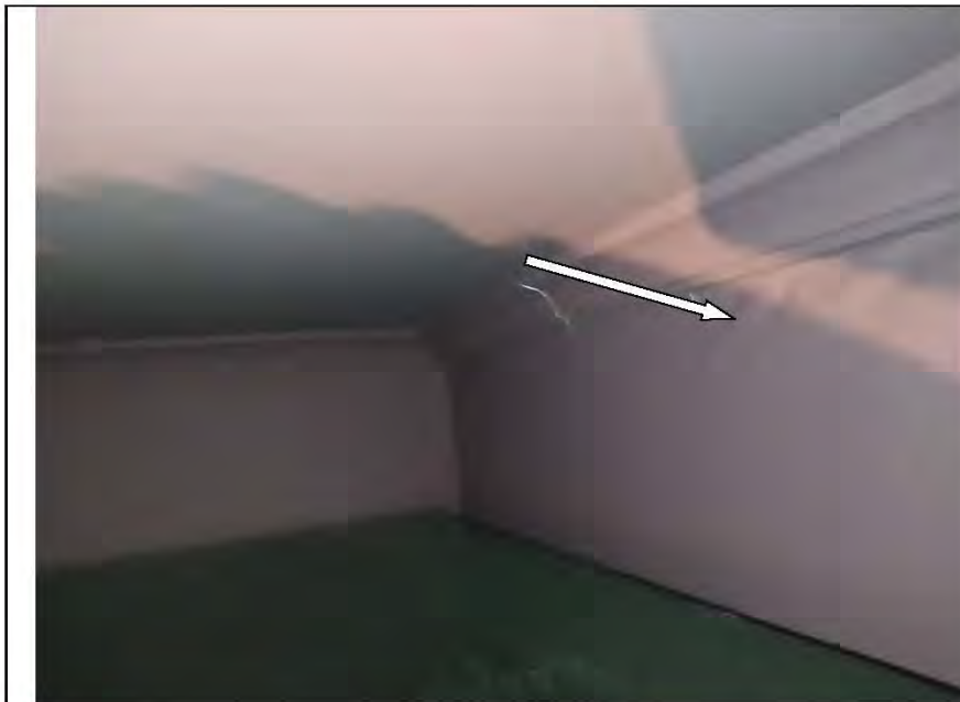
Фото №7. Оштукатуренные и окрашенные стены в гардеробной имеют дефекты характерные последствиям залива (отслоение).
