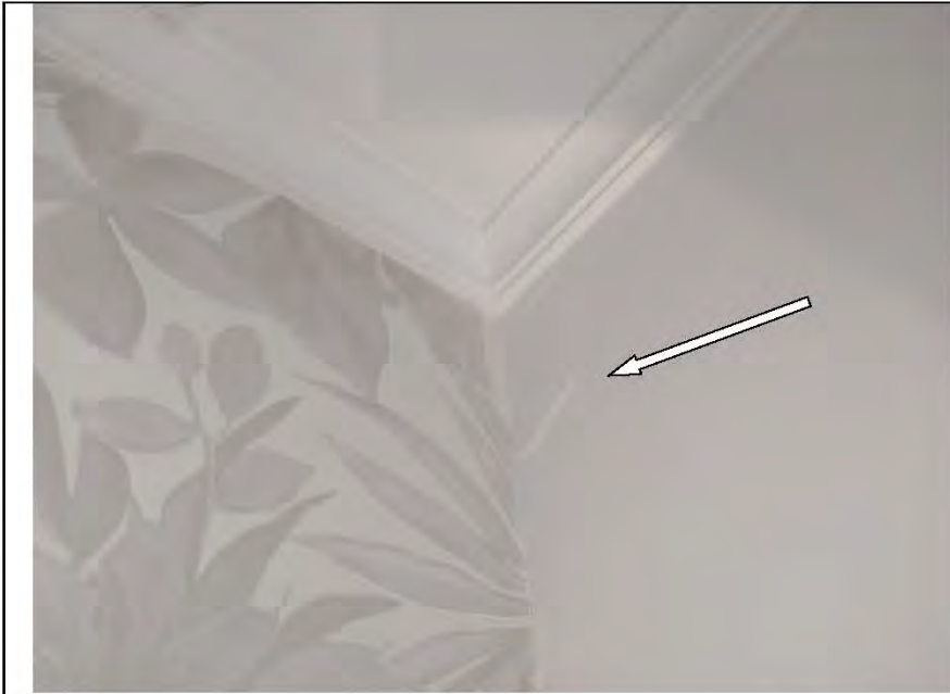
Фото №13. Оштукатуренные и окрашенные стены в гостиной-спальне имеют дефекты характерные последствиям залива (отслоения).
